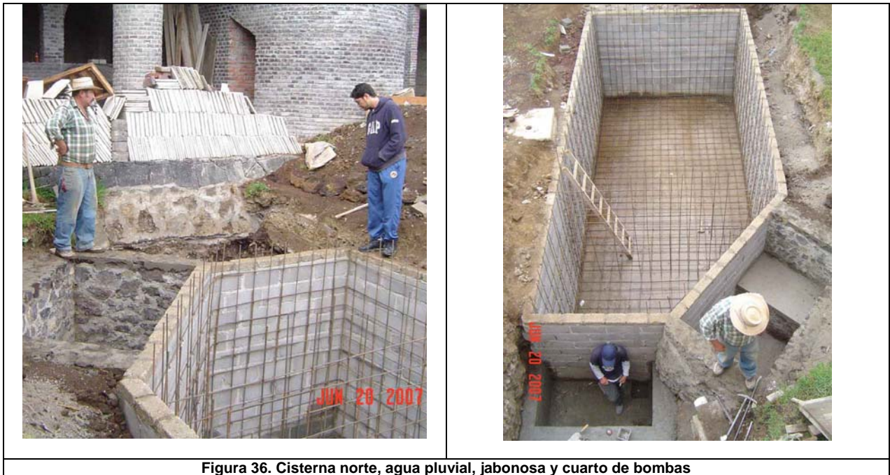
Figura 36. Cisterna norte, agua pluvial, jabonosa y cuarto de bombas
