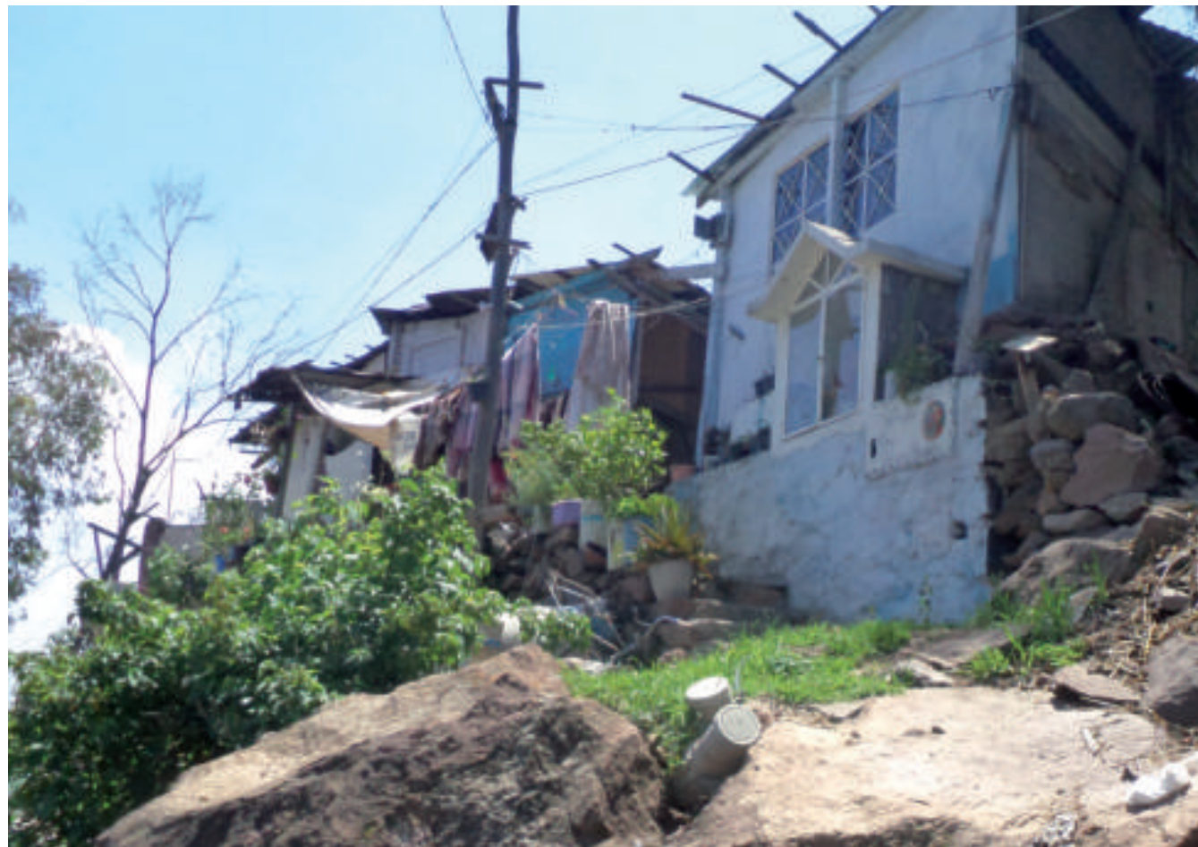
Figura 5.25. Fotografía C de los polígonos de peligro y vulnerabilidad. Vivienda establecida sobre bloques de roca inestables (19.2490° N, 99.0575° W. Calle: Acueducto San Gregorio Atlapulco).
