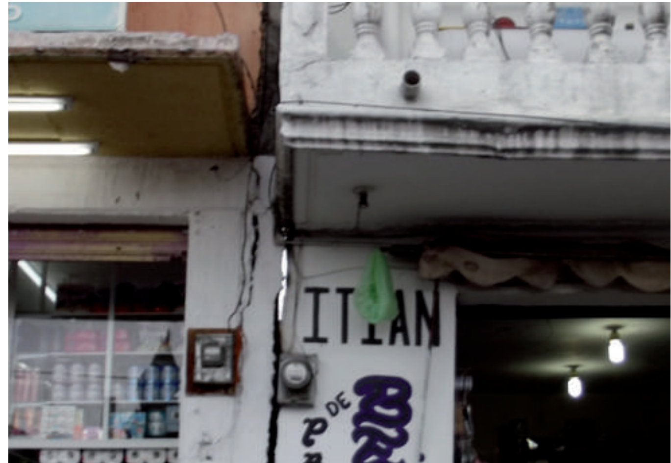
Figura 5.51. Fotografía C del polígono de riesgo. Separación desigual en la junta constructiva (19.2533° N, 99.0109° W. Calle: Belisario Domínguez).
