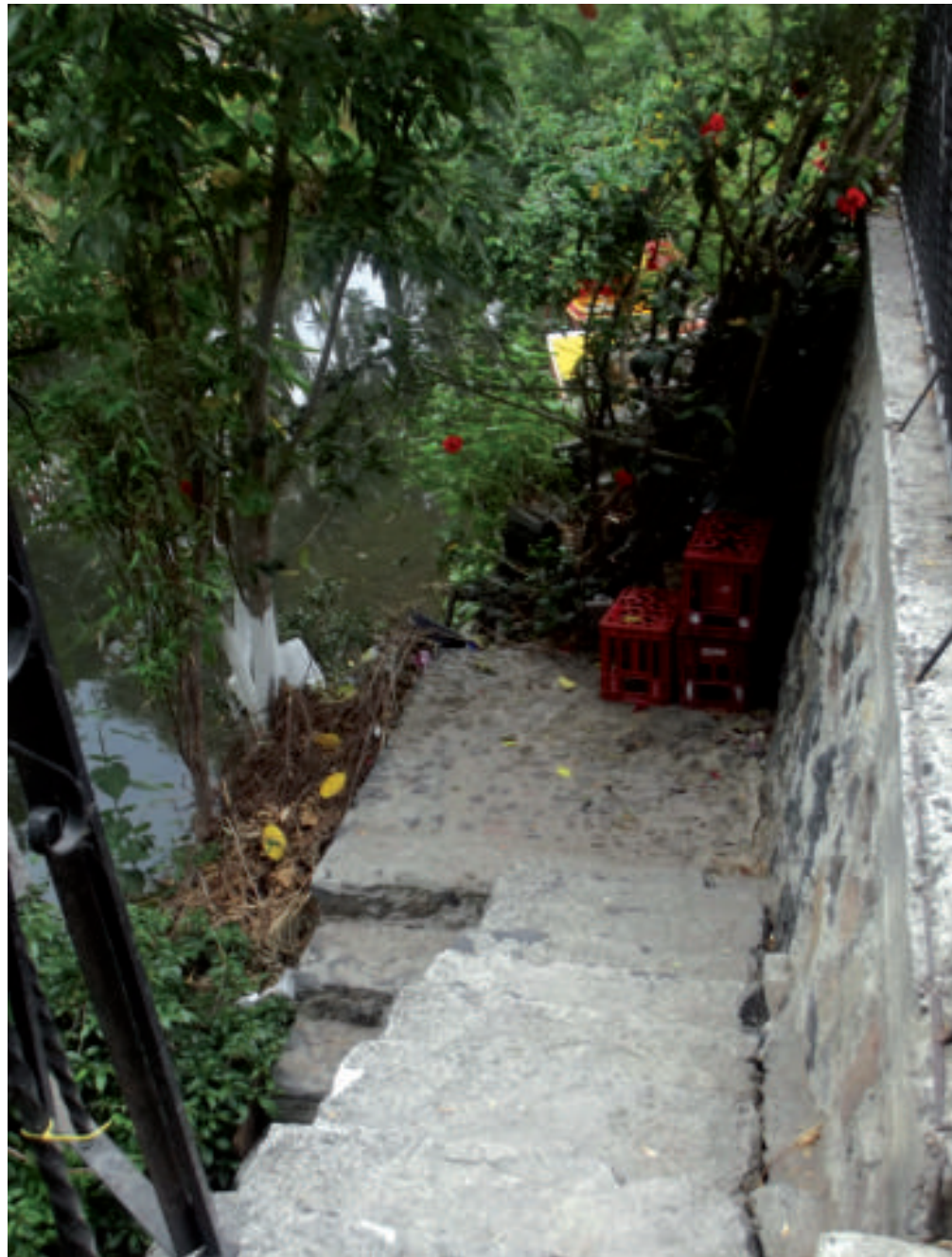
Figura 5.77. Fotografía D de la zona de riesgo. Hundimiento en la calle San Juan Manantiales donde se observan los daños en las escaleras y en la barda (19.2497° N, 99.0923° W. Calle: San Juan Manantiales).
