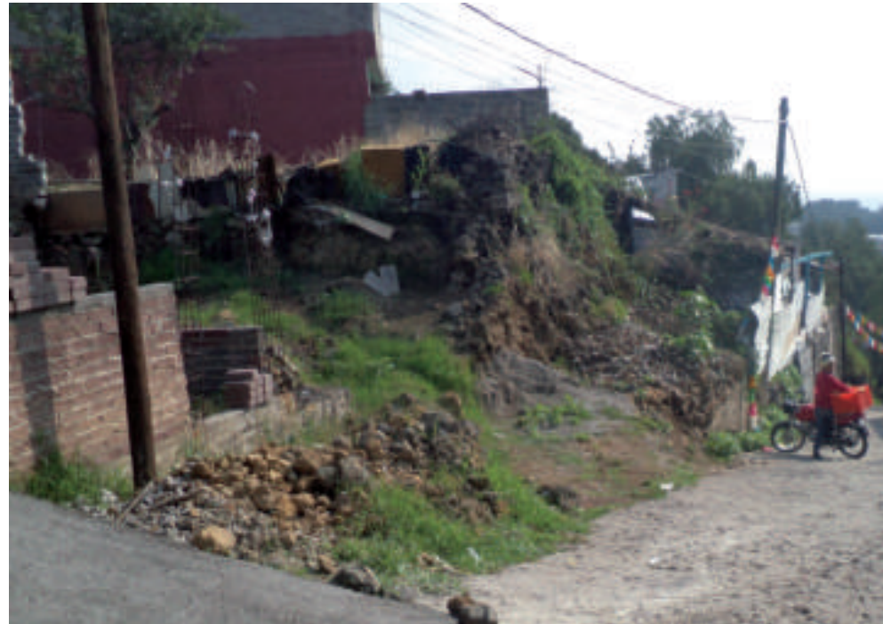
Figura 5.41. Fotografía B de los polígonos de peligro y vulnerabilidad. Viviendas con muros de mampostería sin mortero (19.2388° N, 99.1333° W. Calle: Xochitenco).
