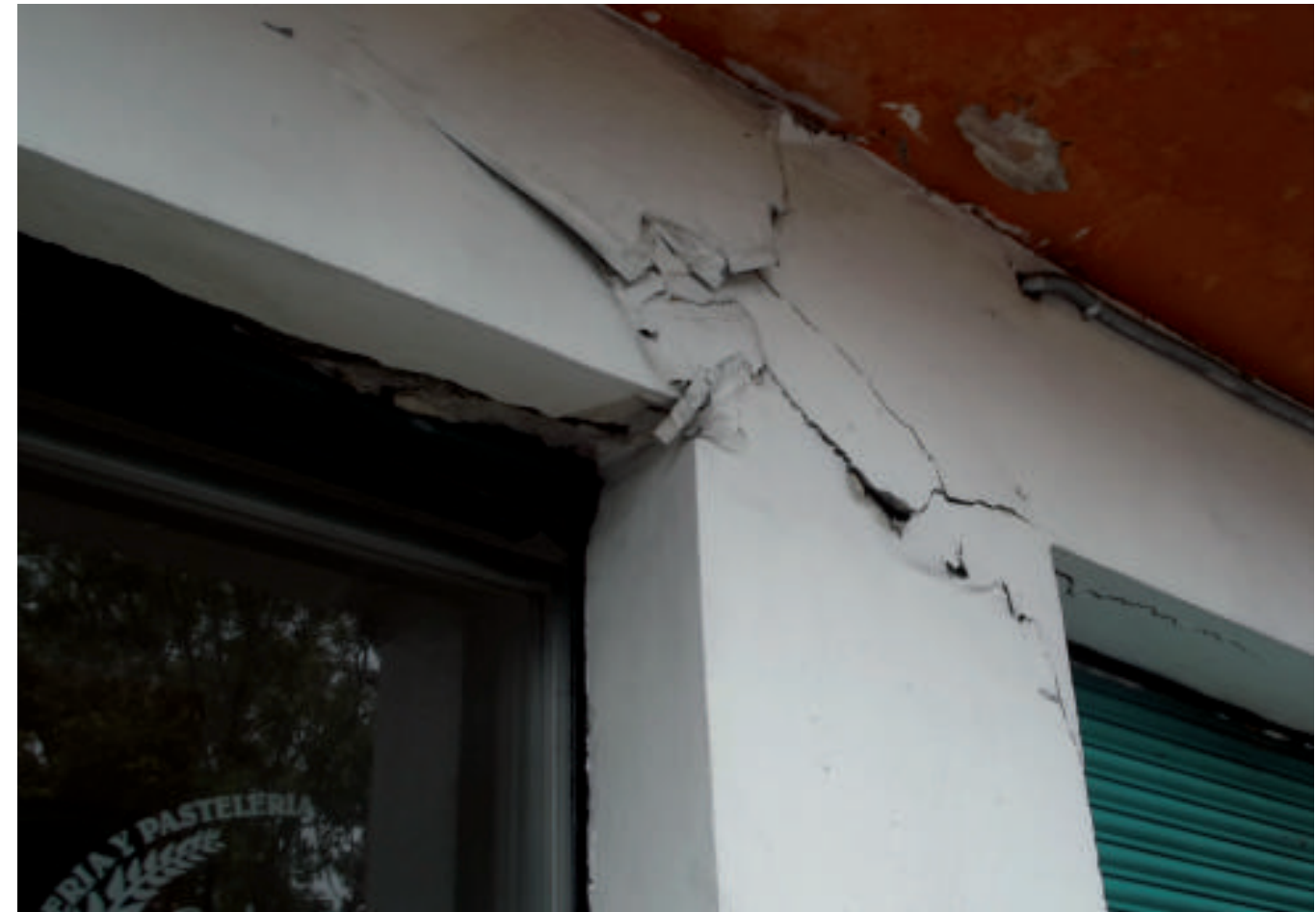
Figura 5.55. Fotografía C de la zona de riesgo. Comercio afectado por una fractura que ya presenta una apertura (19.2532° N, 99.0574° W. Avenida: México).
