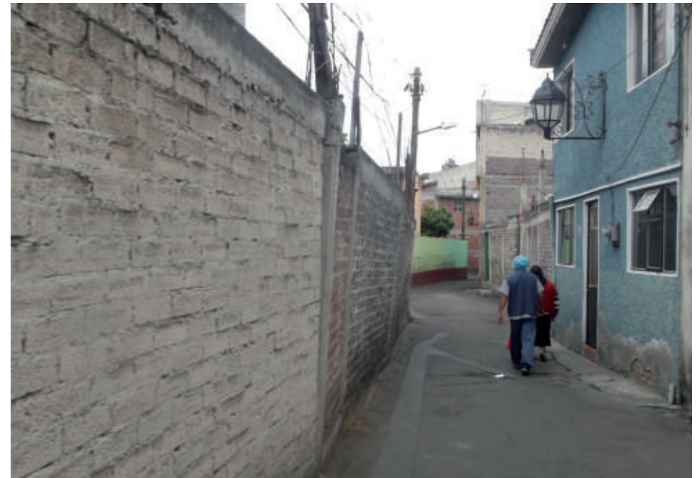
Figura 5.85. Fotografía C de la zona de riesgo. Curvatura en la barda debido al asentamiento diferencial de la zona. En este callejón se tienen varias bardas con el mismo problema (19.2627° N, 99.1071° W. Calle: Primer Callejón Matamoros).
