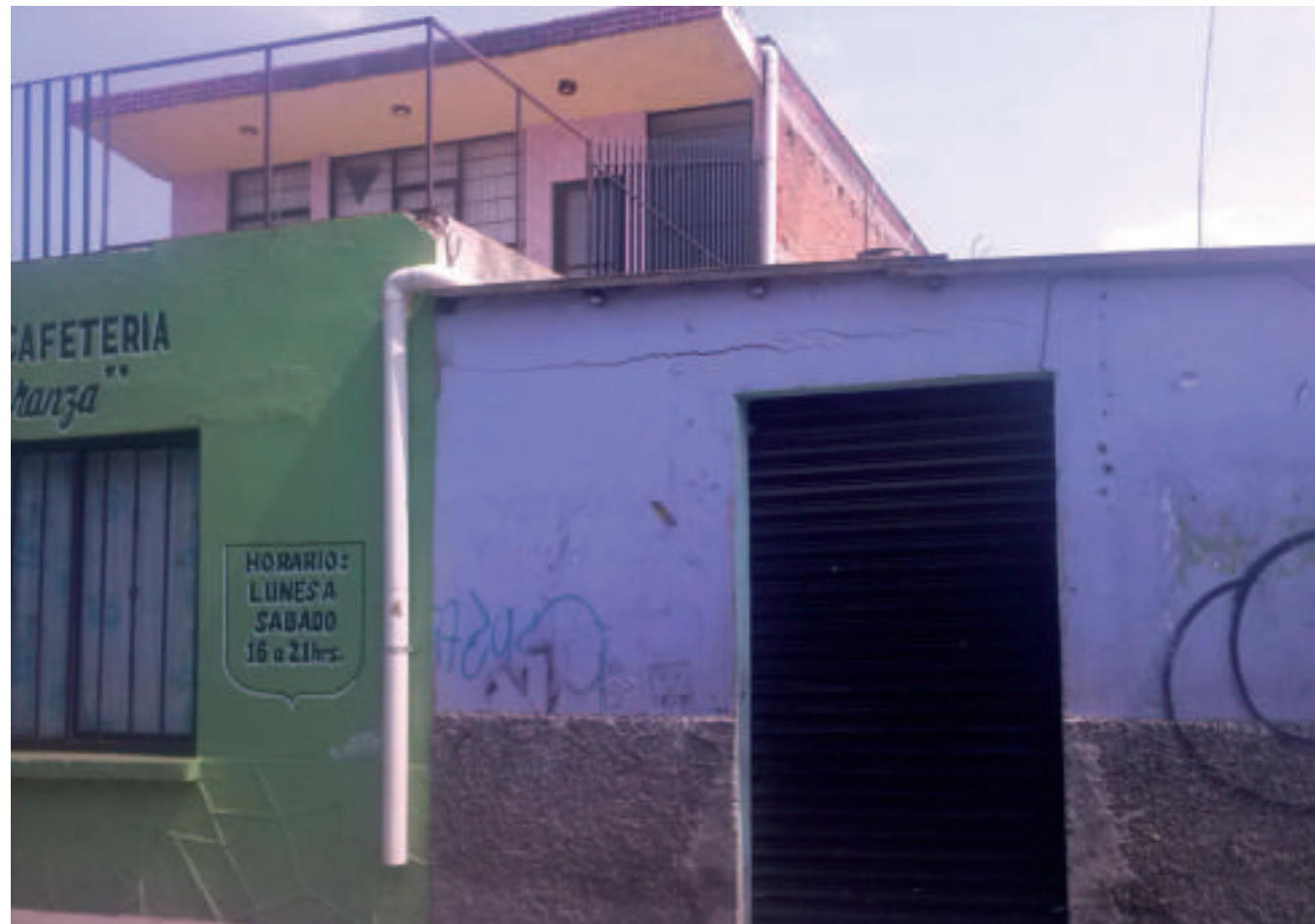
Figura 5.67. Fotografía B de la zona de riesgo. Vulnerabilidad de las viviendas al tener sistemas constructivos deficientes para mitigar el daño por fracturamiento (19.2438° N, 99.0932° W. Calle: Narciso Mendoza).
