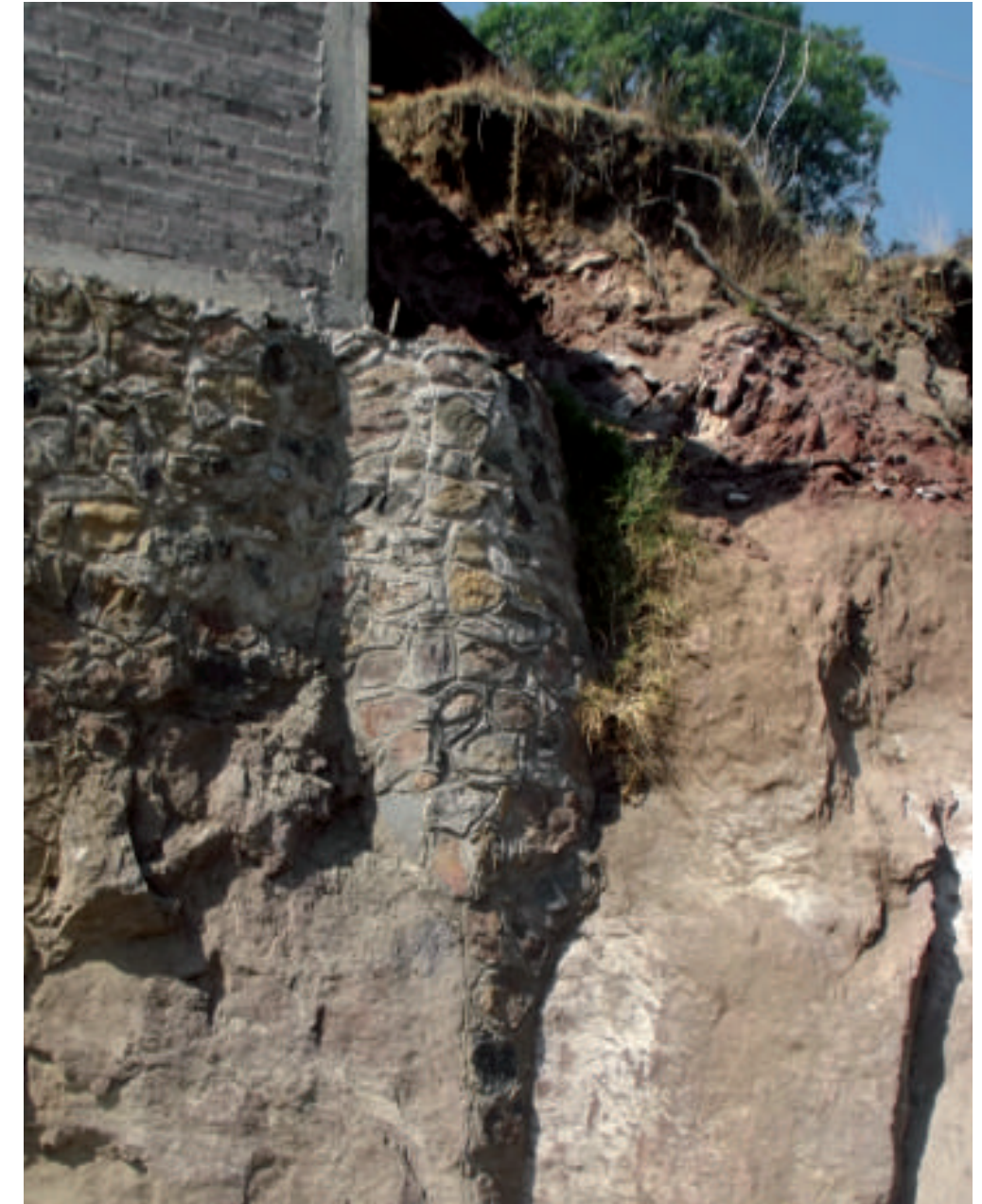
Figura 5.14. Fotografía C en los polígonos de peligro y vulnerabilidad. Muro de mampostería con mortero como medida de mitigación ante caída de roca (19.2140° N, 99.0999° W. Calle: Camino al cerro Tepetonco).
