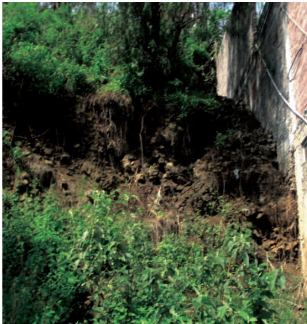
Figura 5.29. Fotografía A de los polígonos de peligro y vulnerabilidad. Corte con peligro de derrumbe en Acoca (19.2442° N, 99.1324° W. Calle: sin nombre oficial).
