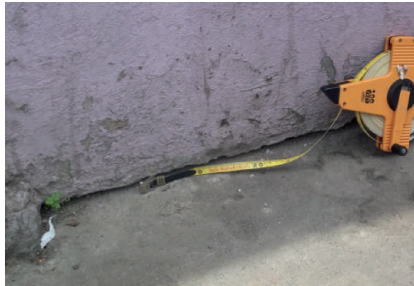
Figura 5.61. Fotografía B de la zona de riesgo. Separación de una vivienda con respecto a la acera (19.2505° N, 99.0566° W. Calle: Tepeyac).
