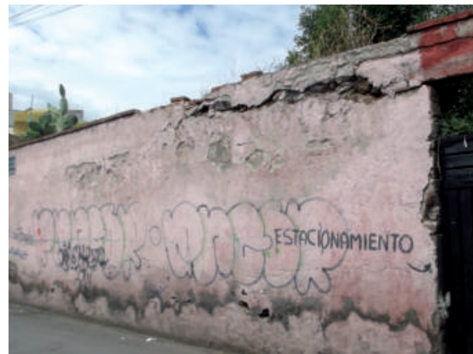
Figura 5.53. Fotografía A de la zona de riesgo. Afectaciones en uno de los muros de la vivienda (19.2530° N, 99.0560° W. Avenida: México).
