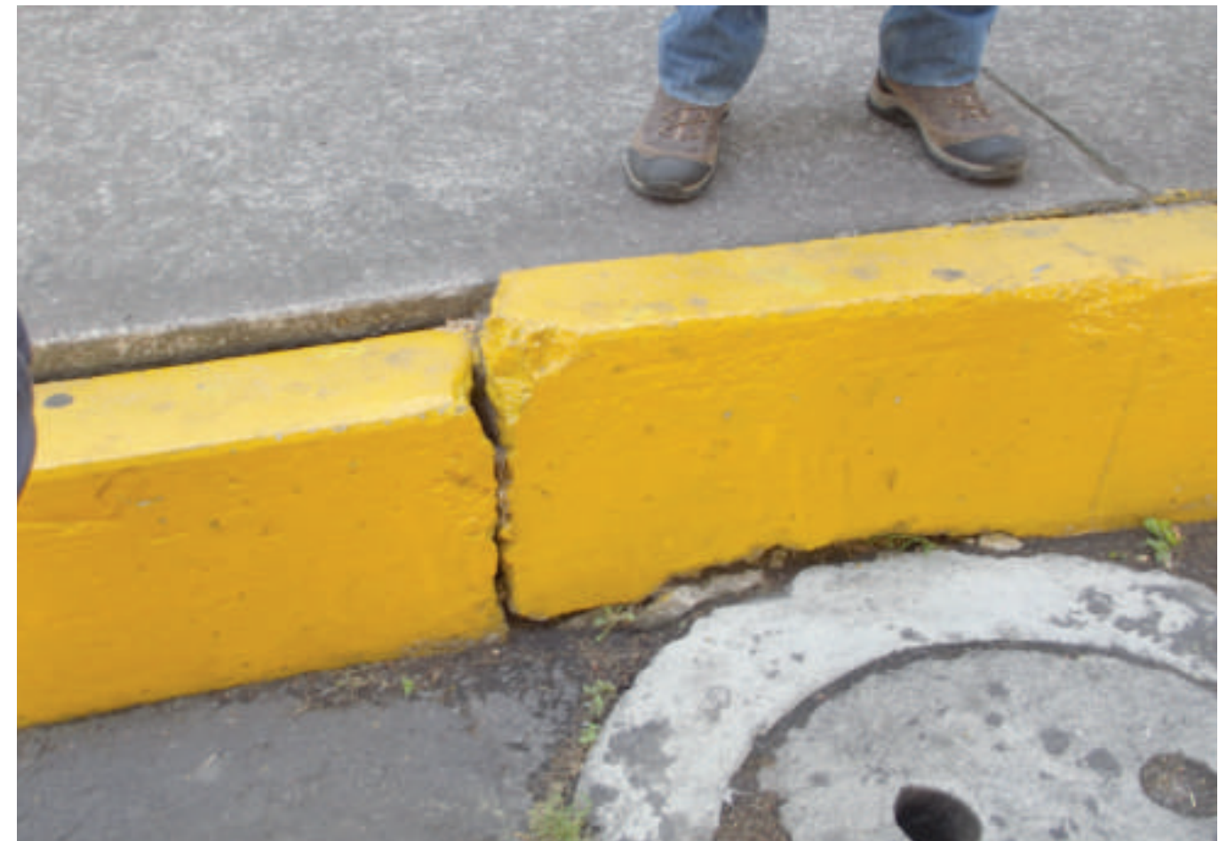
Figura 5.90. Fotografía C de la zona de riesgo. Fracturamiento asociado al drenaje en Jardines del Sur (19.2622° N, 99.1200° W. Calle: Mártires de Río Blanco).
