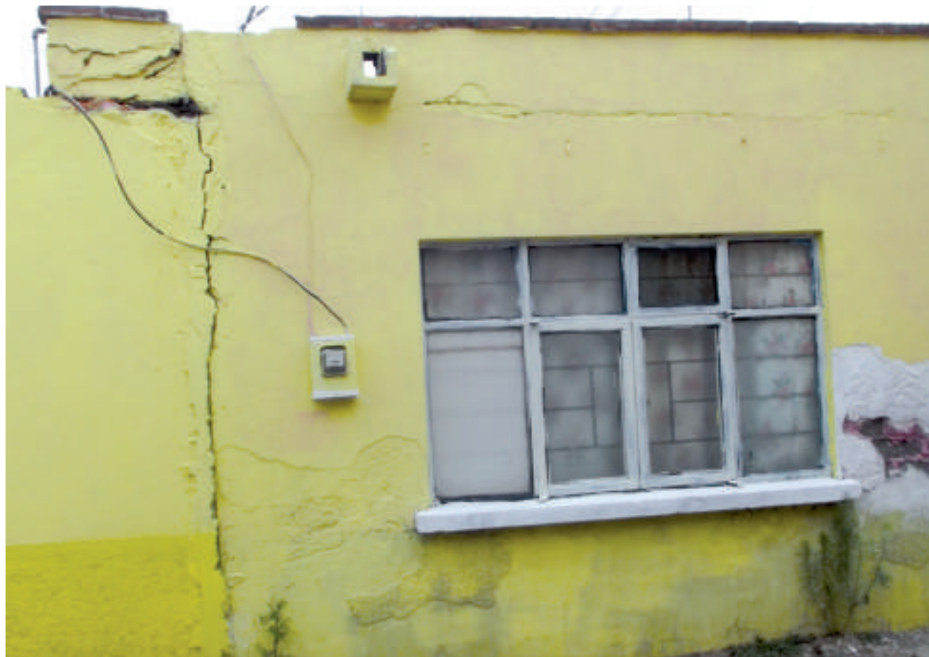
Figura 5.80. Fotografía A de la zona de riesgo. Daño físico en las viviendas de la colonia Guadalupe (19.2559° N, 99.0151° W. Cerrada: Aquiles Serdán).
