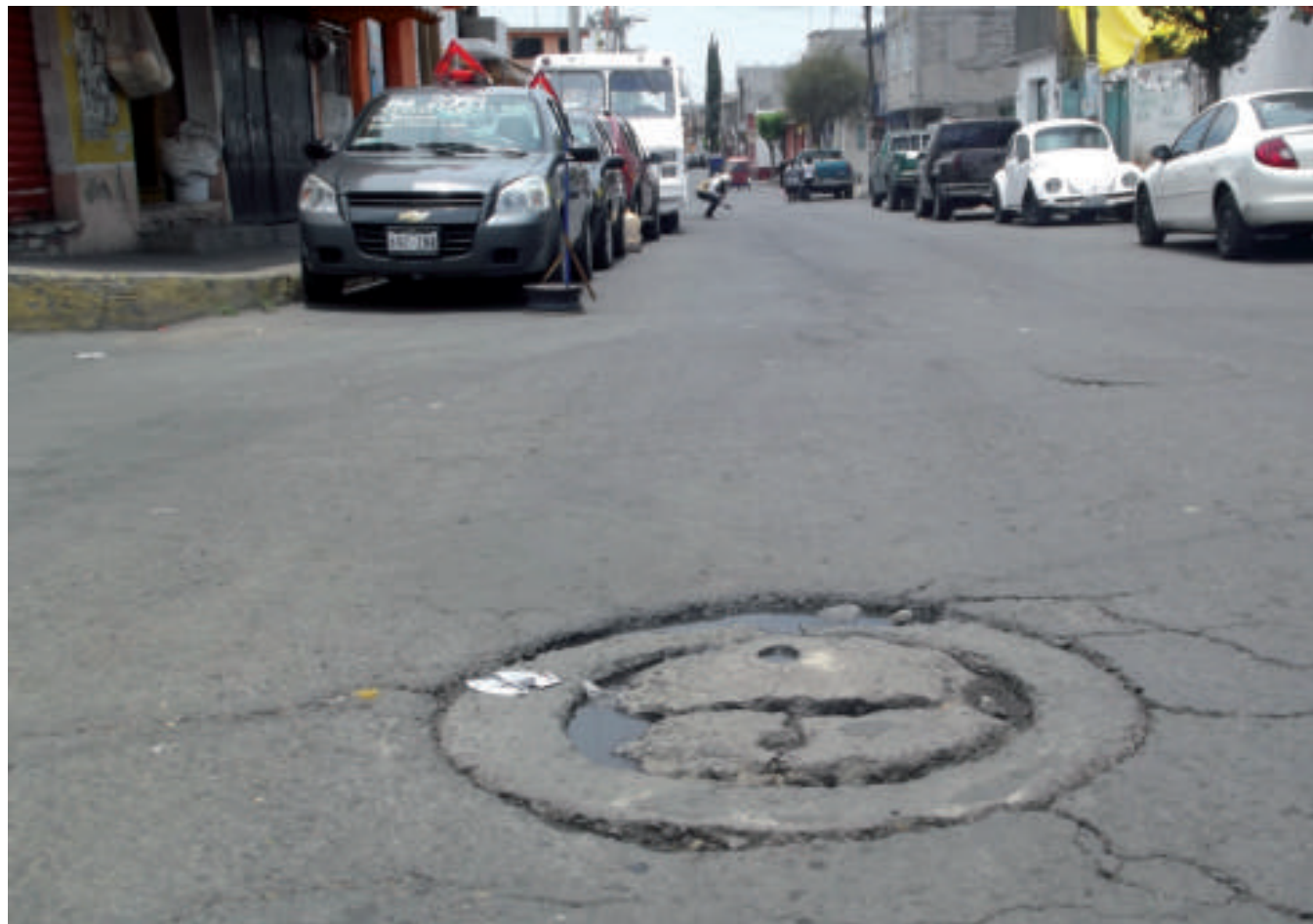
Figura 5.60. Fotografía A de la zona de riesgo. Evidencias del fracturamiento a lo largo de la avenida Cuauhtémoc (19.2506° N, 99.0566° W. Avenida: Cuauhtémoc).
