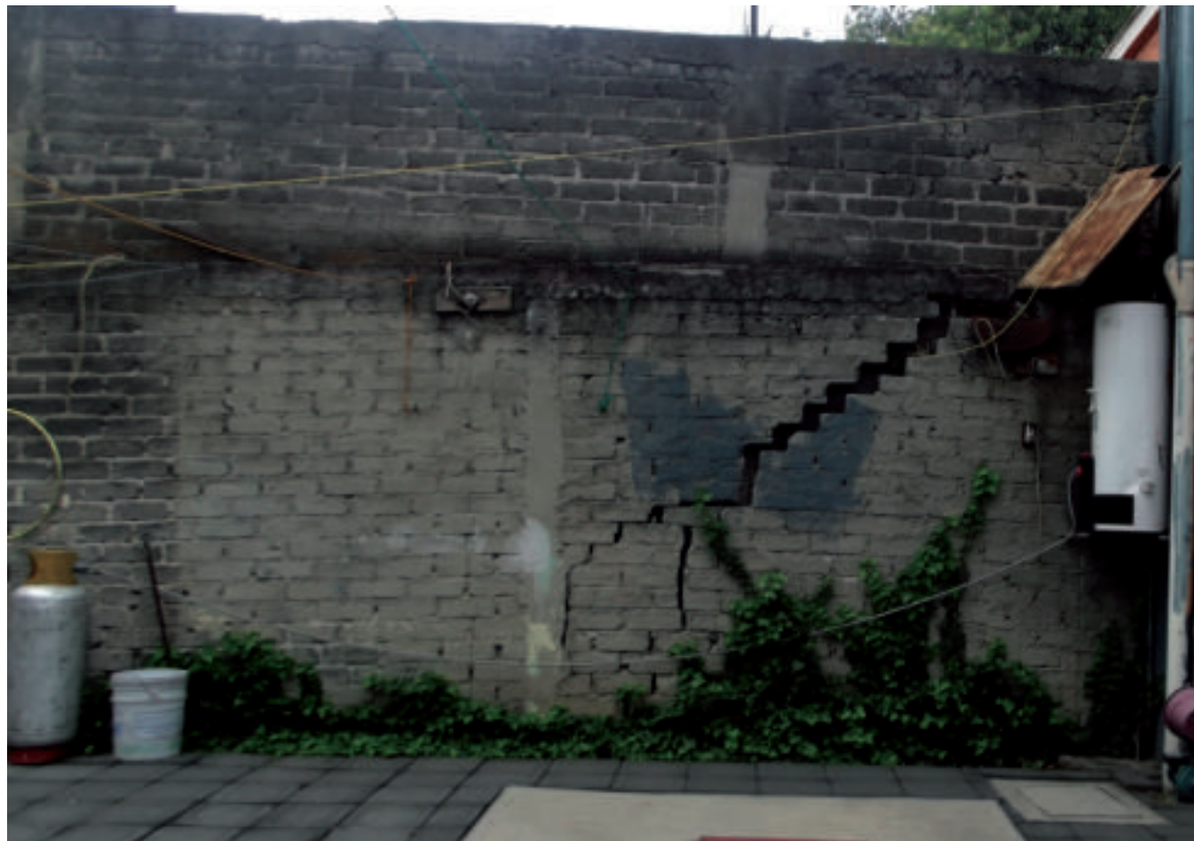
Figura 5.75. Fotografía B de la zona de riesgo. Inmueble se somete al hundimiento ocasionando fracturas en bardas, paredes y piso (19.2502° N, 99.0908° W. Calle: Cuauhtémoc).
