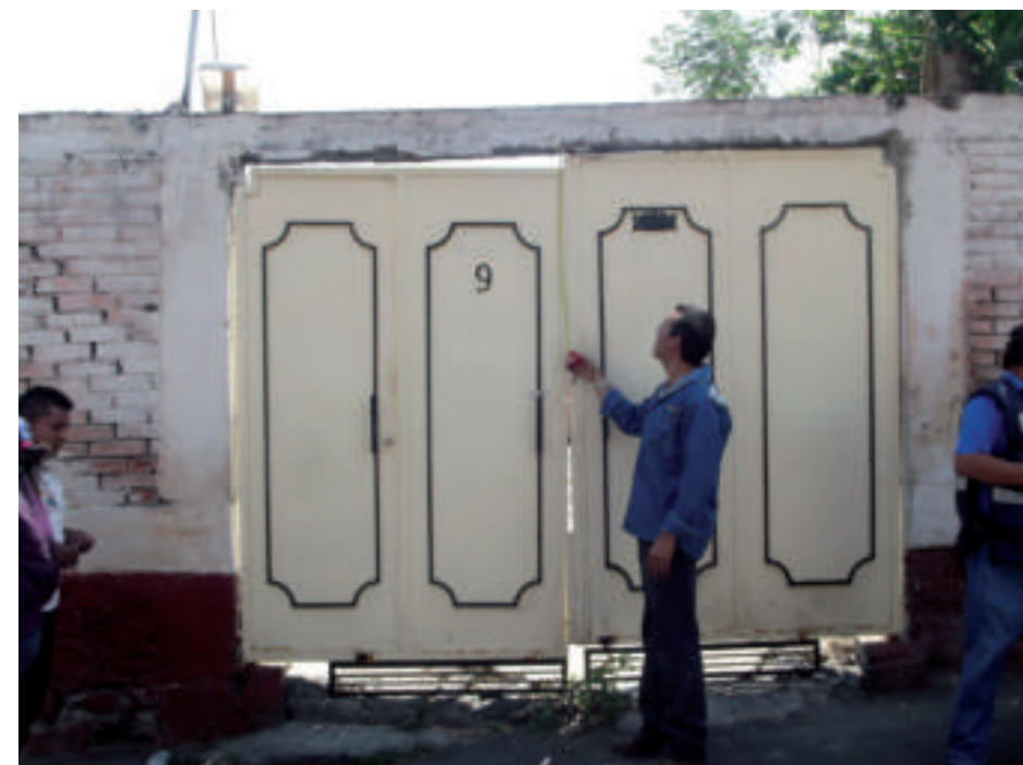
Figura 5.66. Fotografía A de la zona de riesgo. Fracturas en barda y el desnivel del portón (7 cm), (19.2439° N, 99.0926° W. Calle: Miguel Hidalgo).
