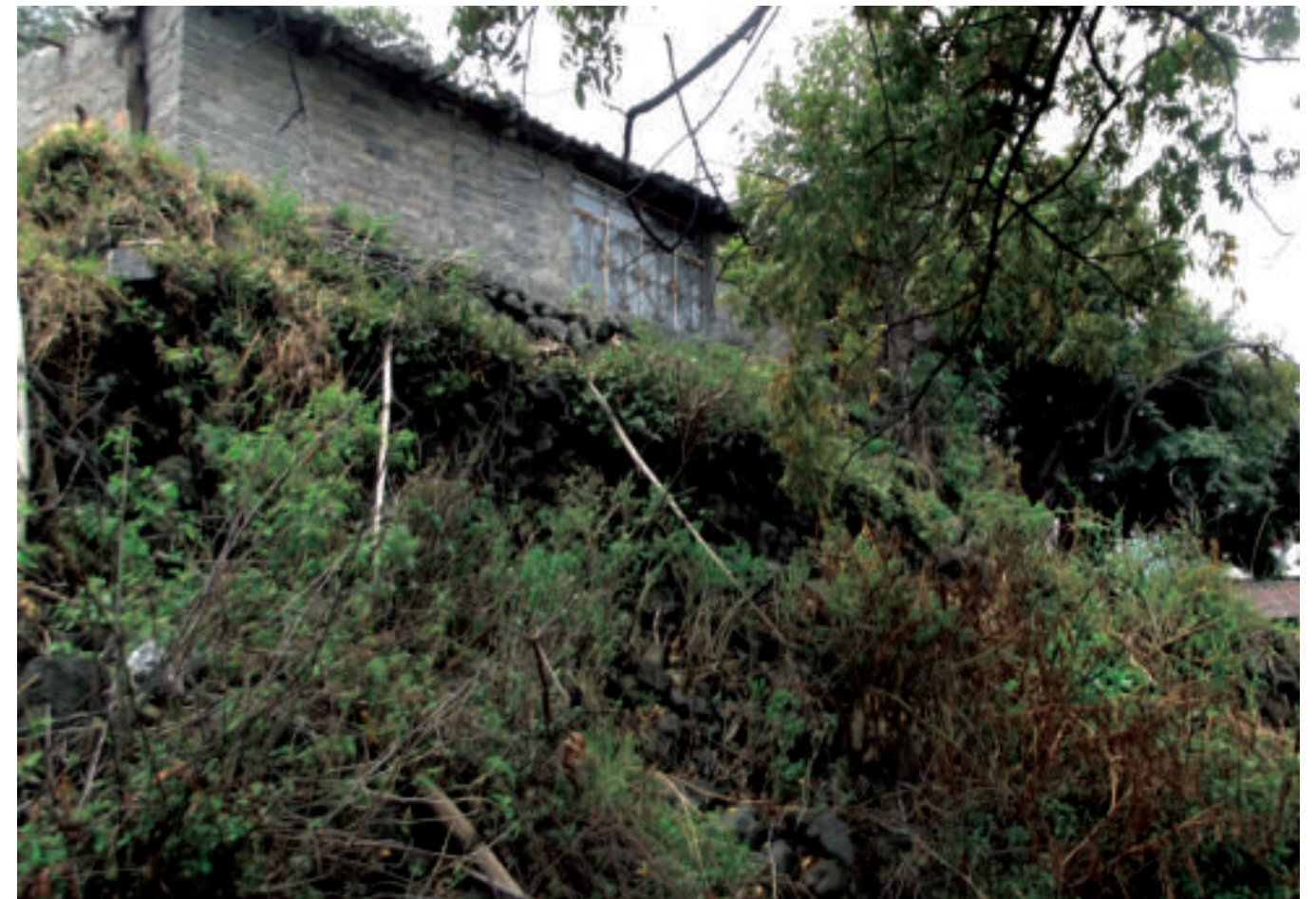
Figura 5.18. Fotografía B del polígono de peligro y vulnerabilidad. Vivienda a pie de ladera construida sobre muro sin mortero (19.2190° N, 99.1057° W. Calle: sin nombre oficial).
