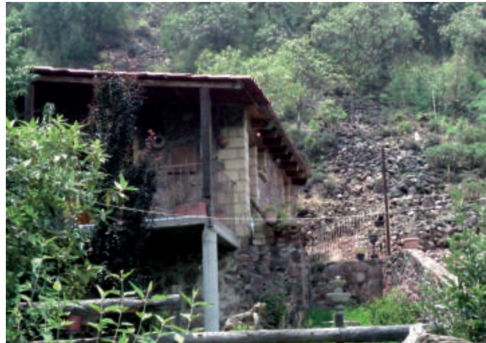
Figura 5.8. Fotografía B en los polígonos de peligro y vulnerabilidad. Vivienda altamente vulnerable a la caída de rocas (19.2301° N, 99.1271° W. Calle: sin nombre oficial).
