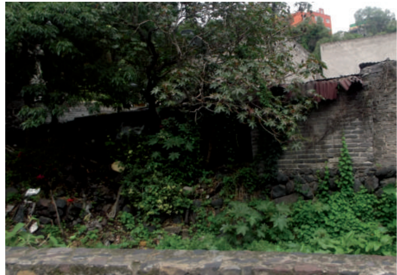
Figura 5.20. Fotografía D del polígono de peligro y vulnerabilidad. Vivienda sin cimientos ubicada en Camino del Río (19.2414° N, 99.1080° W. Calle: Camino del Río).
