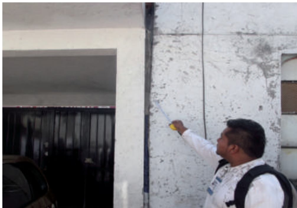
Figura 5.71. Fotografía B de la zona de riesgo. Hacia la parte superior de las viviendas hay un incremento en la junta constructiva respecto a la parte inferior de las mismas (19.2458° N, 99.0752° W. Calle: Licenciado Pedro Benavides).
