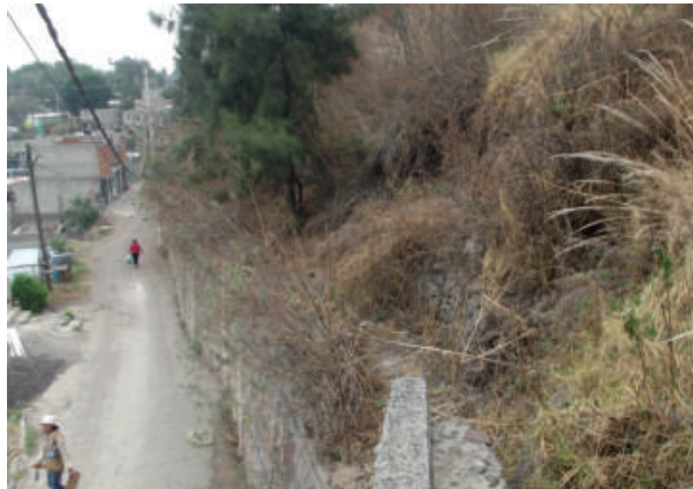
Figura 5.46. Fotografía B de los polígonos de peligro y vulnerabilidad. Muro de contención que está siendo sobrepasado por el material (19.2330° N, 99.0899° W. Calle: Camino Real).
