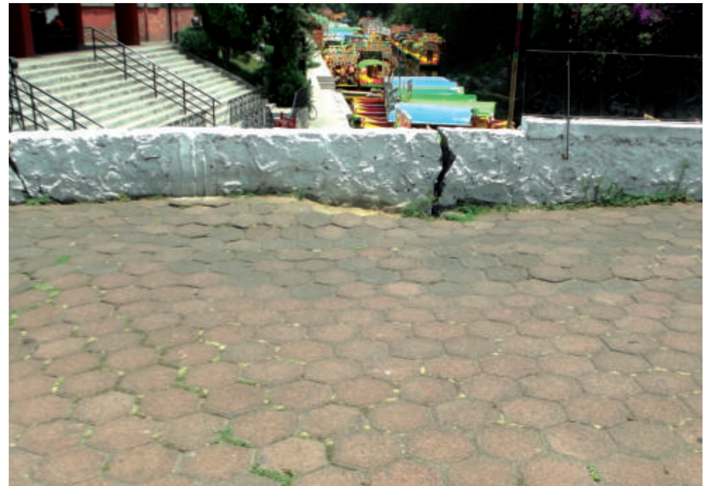
Figura 5.76. Fotografía C de la zona de riesgo. Hundimiento sobre la calle Canal 27, lo que ocasiona fracturas en patios y banquetas (19.2490° N, 99.0937° W. Calle: Canal 27).
