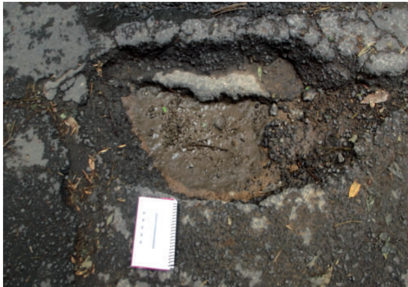
Figura 5.89. Fotografía B en la zona de riesgo. Daños sobre la carpeta asfáltica debido al hundimiento (19.2658° N, 99.1234° W. Avenida: México).
