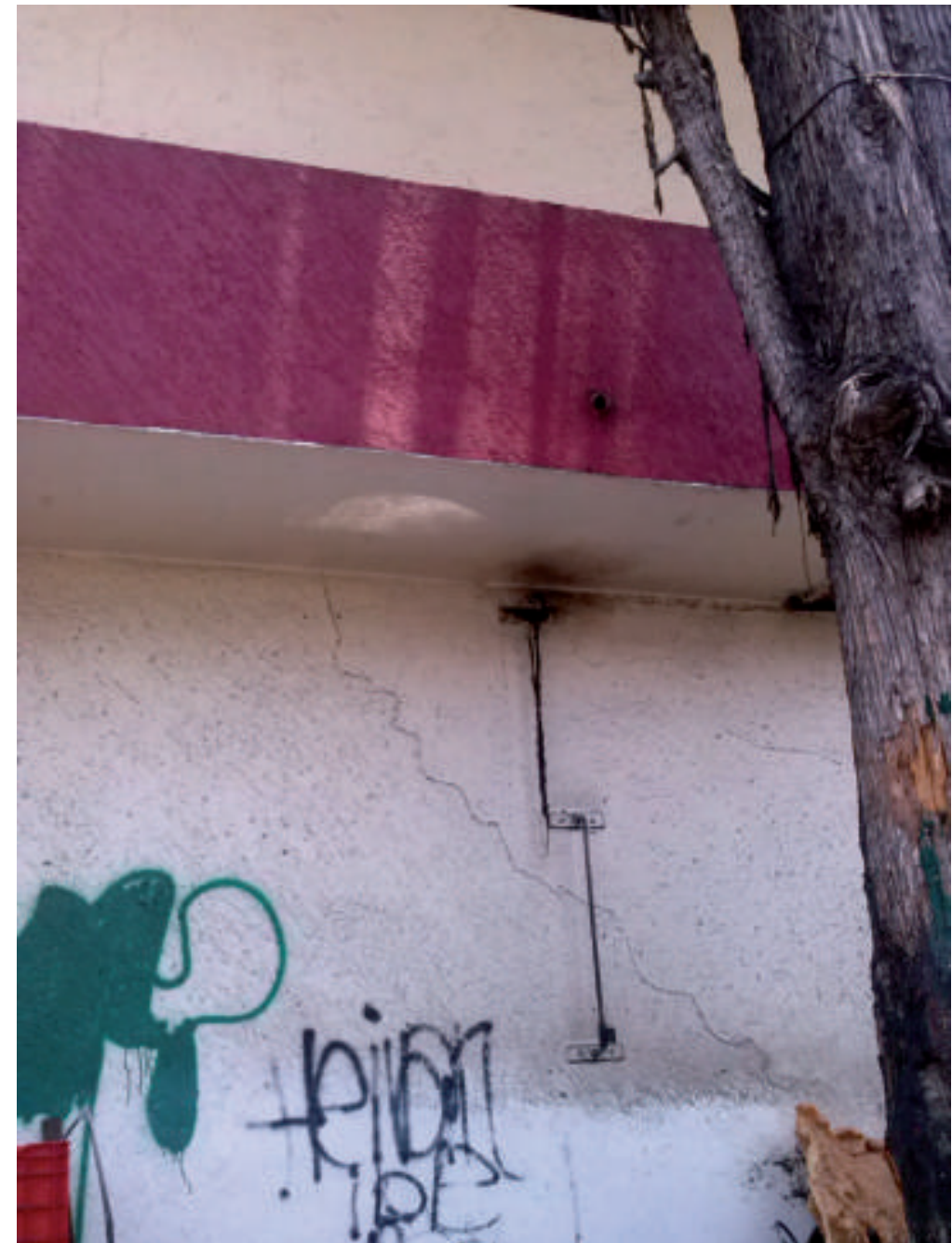
Figura 5.72. Fotografía C de la zona de riesgo. Fractura en la pared (19.2452° N, 99.0757° W. Calle: 2 de Abril).
