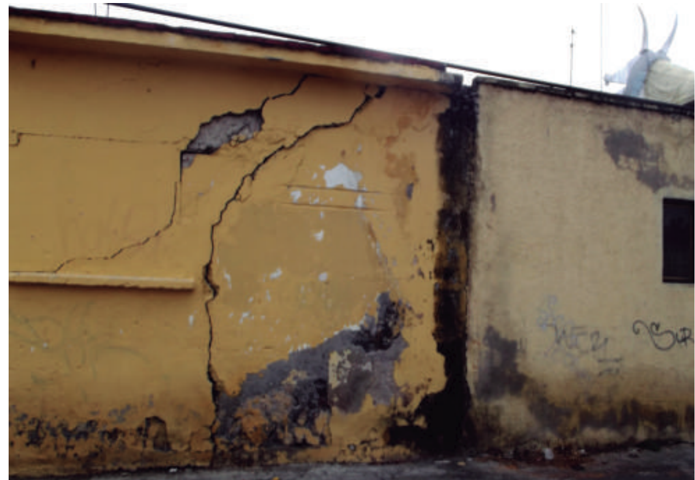
Figura 5.58. Fotografía B de la zona de riesgo. Vivienda afectada por fracturas diagonales (19.2579° N; 99.0379° W. Calle Agricultor).
