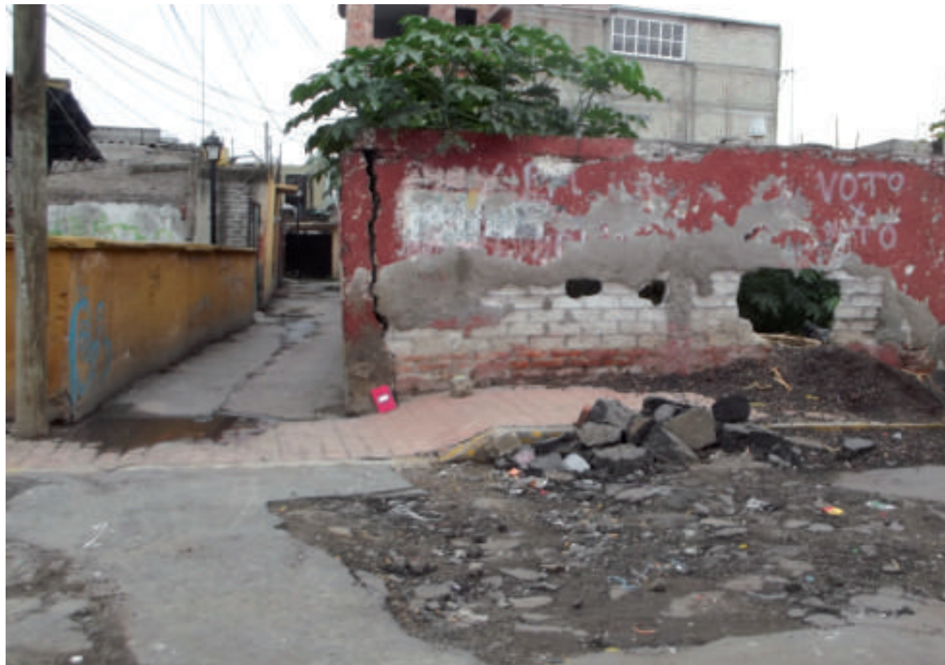
Figura 5.57. Fotografía A de la zona de riesgo. Fracturamiento y pérdida de material en la pared de una vivienda (19.2603° N, 99.0368° W. Calle: Floricultor).
