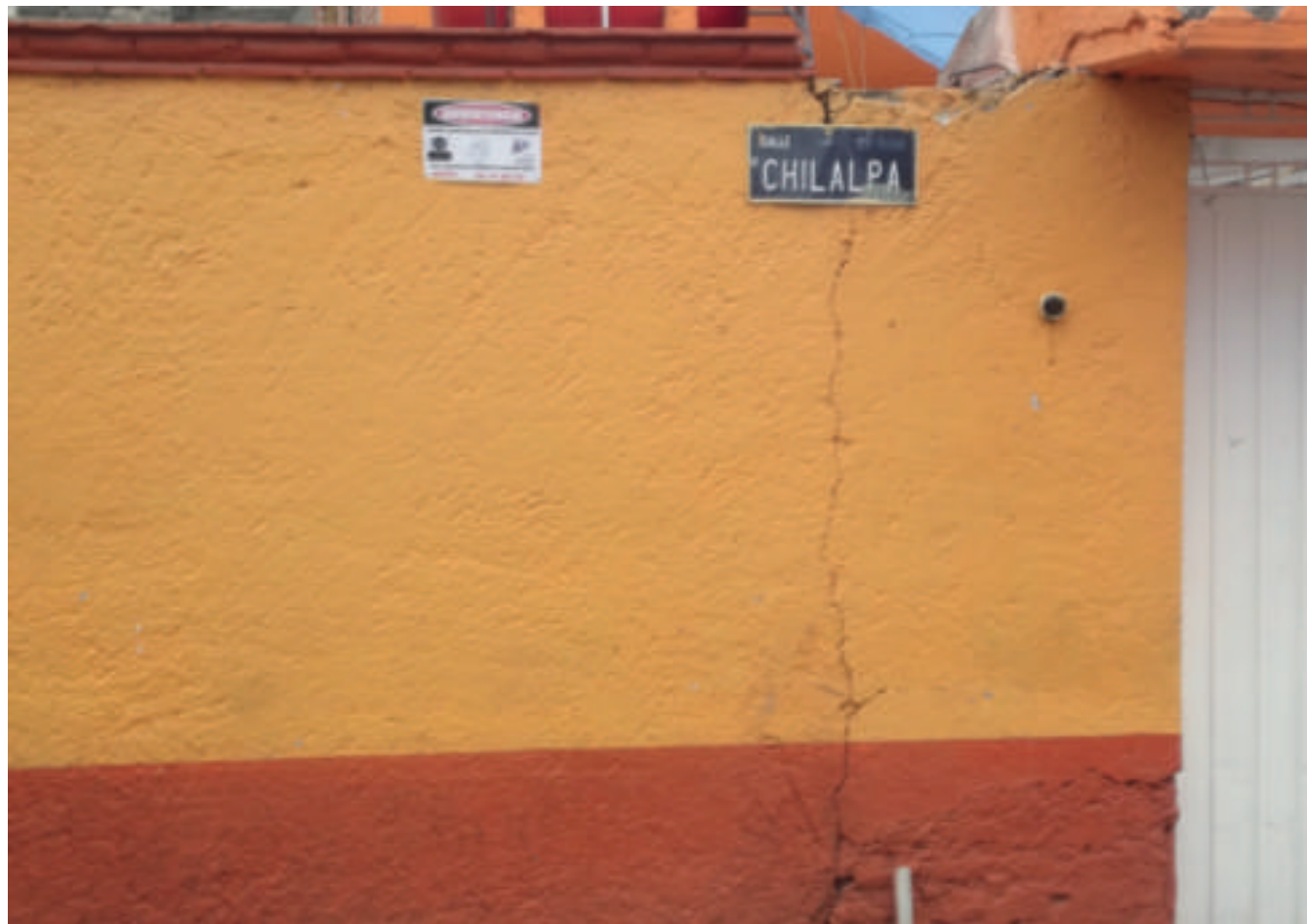
Figura 5.84. Fotografía B de la zona de riesgo. Fractura lateral en la barda (19.2633° N, 99.1068° W. Calle: Chilalpa).
