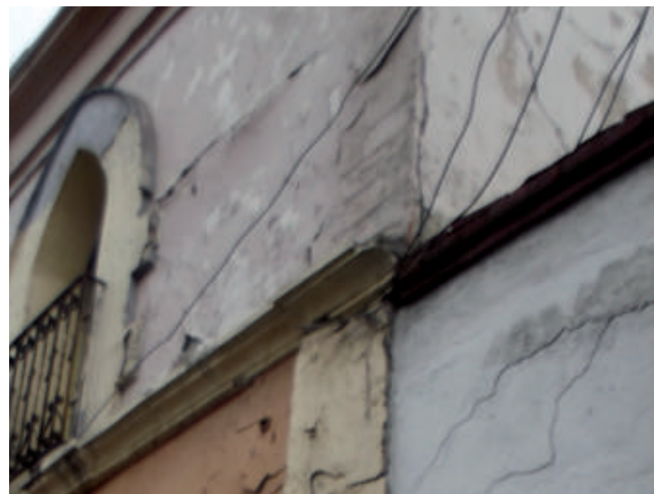
Figura 5.49. Fotografía A del polígono de riesgo. Inmueble afectado con fracturas diagonales (19.2536° N, 99.0132° W. Calle: Belisario Domínguez).
