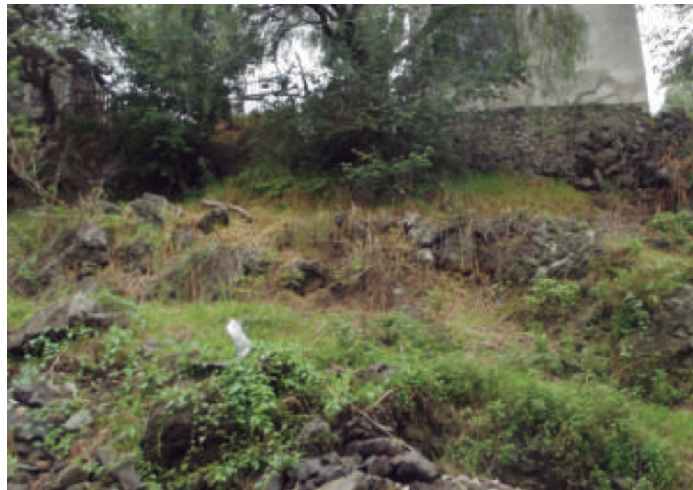
Figura 5.42. Fotografía C de los polígonos de peligro y vulnerabilidad. Vivienda asentada sobre bloques de roca inestables en el cerro Santiago (19.2368° N, 99.1338° W. Calle: sin nombre oficial).
