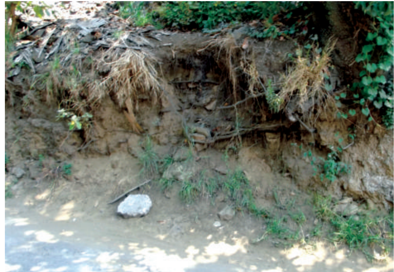
Figura 5.37. Fotografía D de los polígonos de peligro y vulnerabilidad. Se muestra el grado de erosión de los materiales presentes en el polígono (19.2250° N, 99.0958° W. Calle: Camino real a San Bartolo).
