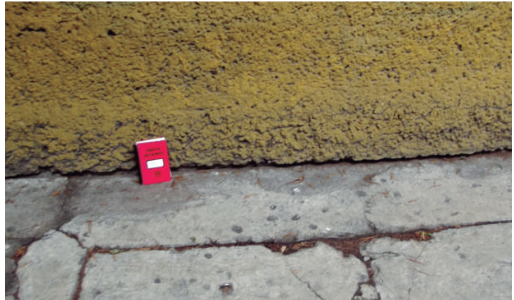
Figura 5.88. Fotografía A de la zona de riesgo. Separación entre la barda y la banquetta debido al hundimiento en el Centro de Capacitación ( 19.2661^\circ N, 99.1245^\circ W. Avenida: México).
