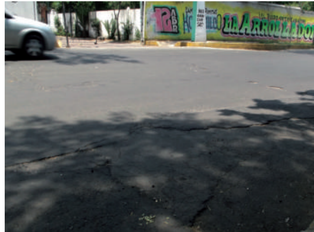
Figura 5.78. Fotografía E de la zona de riesgo. Fracturas en el Embarcadero Zacapa y en la barda de la Oficina Regional del Sistema de Aguas de la Ciudad de México, unidad Xochimilco (19.2483° N, 99.0936° W. Avenida: Francisco Goitia).
