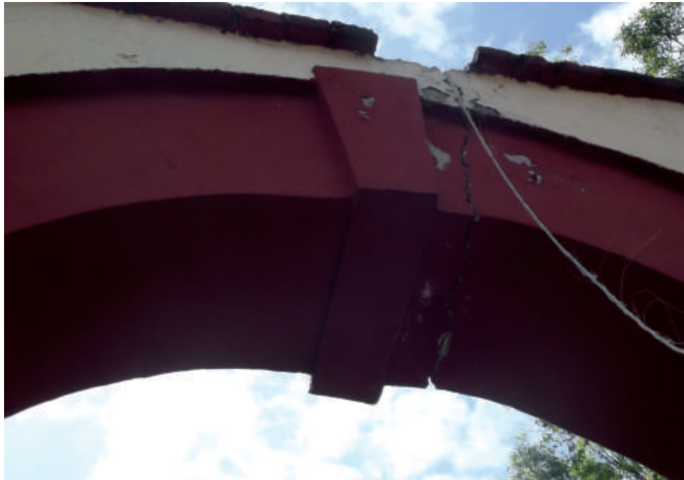
Figura 5.54. Fotografía B de la zona de riesgo. Fracturamiento en uno de los arcos de la iglesia del pueblo (19.2535° N; 99.0563° W. Calle: Insurgentes).
