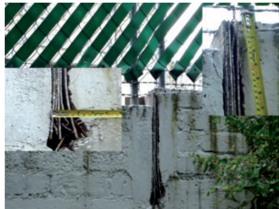
Figura 5.74. Fotografía A de la zona de riesgo. Vivienda afectada en donde se observa la separación (10 cm) entre las bardas y el desplazamiento entre ellas (2 cm), (19.2513° N, 99.0906° W. Calle: Cuauhtémoc).
