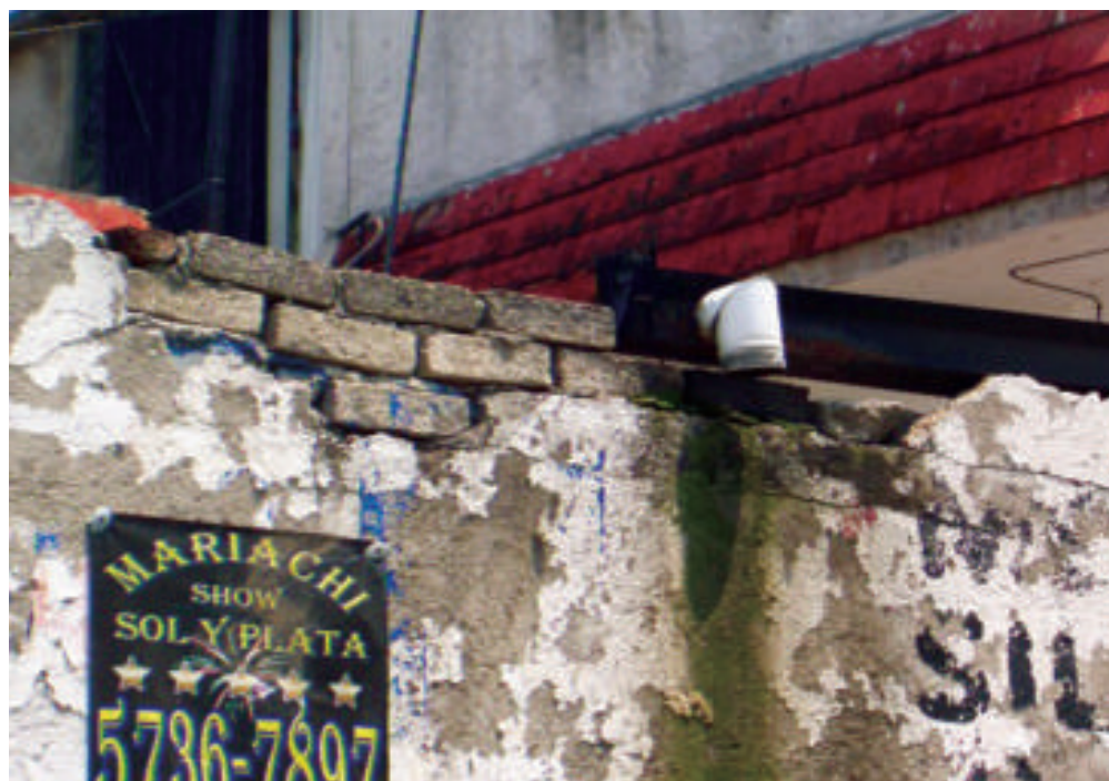
Figura 5.180. Fotografía J de la colonia Adolfo López Mateos. Muro fracturado de una vivienda que deja al descubierto el armado de la construcción por el desprendimiento de material (19.4215° N, 99.0737° W. Calle: Adolfo López Mateos).
