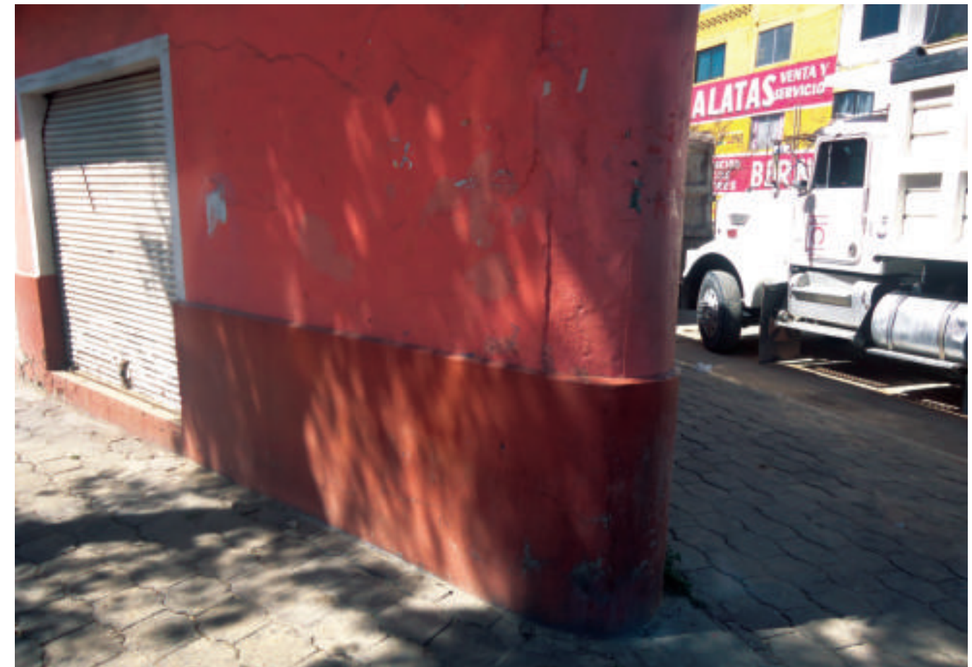
Figura 5.105. Fotografía C de la colonia Venustiano Carranza. Fracturas verticales en el muro de la construcción (19.4389° N, 99.1095° W. Calle: Floricultura).
