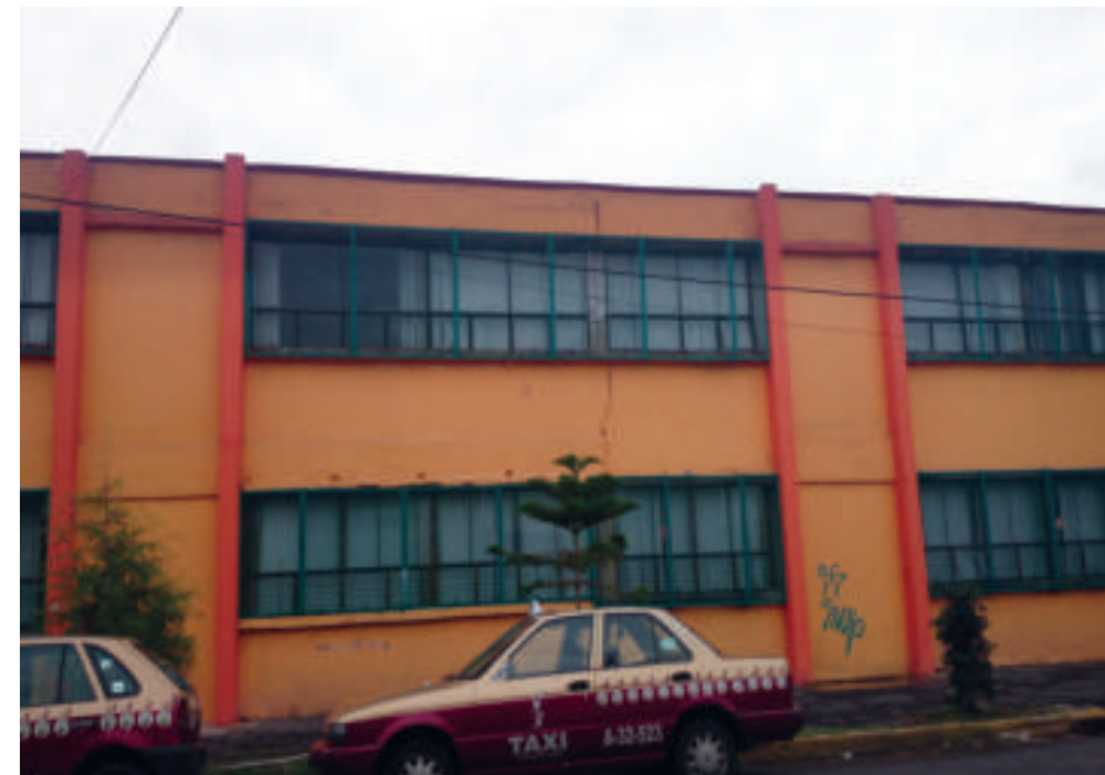
Figura 5.55. Fotografía A de la colonia Simón Bolívar. Muro de una de las escuelas de la zona que presenta fracturas verticales (19.4480° N, 99.0977° W. Calle: Cantón).
