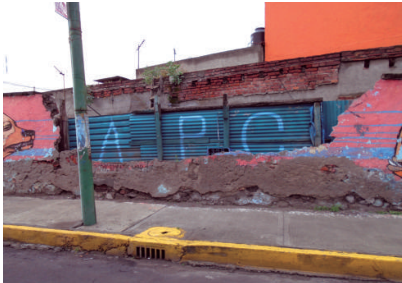
Figura 5.126. Fotografía B de la colonia Progresista. Muros de mampostería semiconfinada, uno de ellos parcialmente colapsado (19.4368° N, 99.1061° W. Calle: Tenería).
