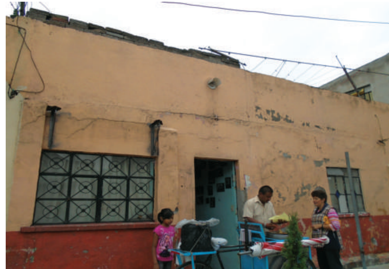
Figura 5.130. Fotografía A de la colonia Revolución. Vivienda con fracturas de forma diagonal y horizontal, así como desprendimiento de material en su muro (19.4384° N, 99.1045° W. Calle: 6 de Marzo).
