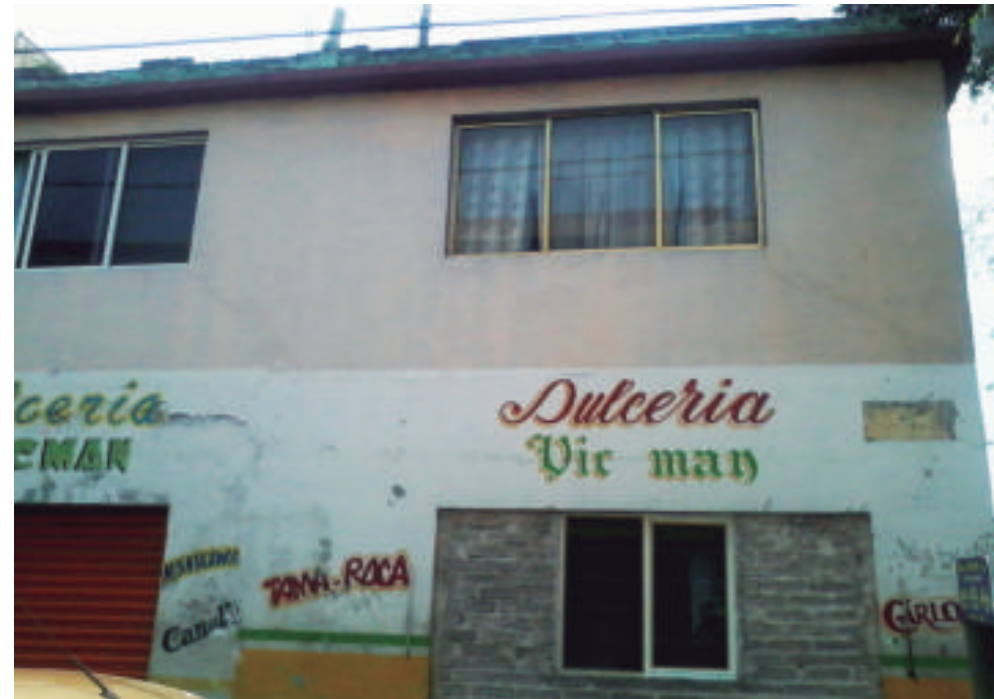
Figura 5.189. Fotografía A de la colonia Puebla. Inmueble con fracturas en la parte inferior de las ventanas del segundo nivel de la construcción (19.4105° N, 99.0826° W. Calle: 4).
