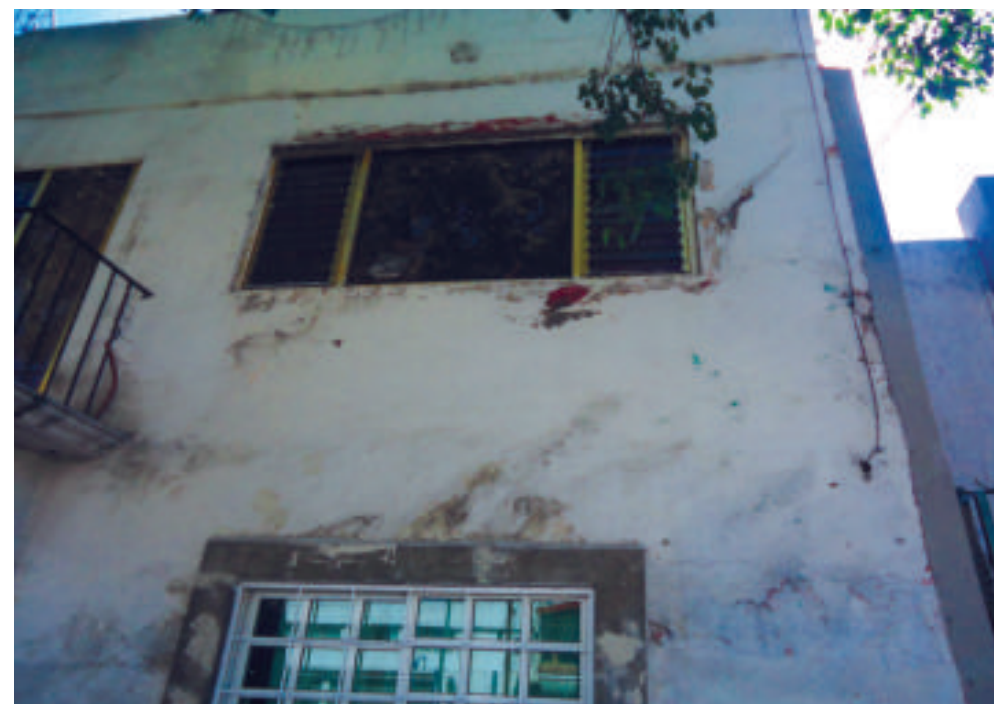
Figura 5.199. Fotografía B de la colonia Cuatro Árboles. Inmueble con fracturas diagonales cercanas a sus ventanas (19.4171° N, 99.0847° W. Calle: Economía).
