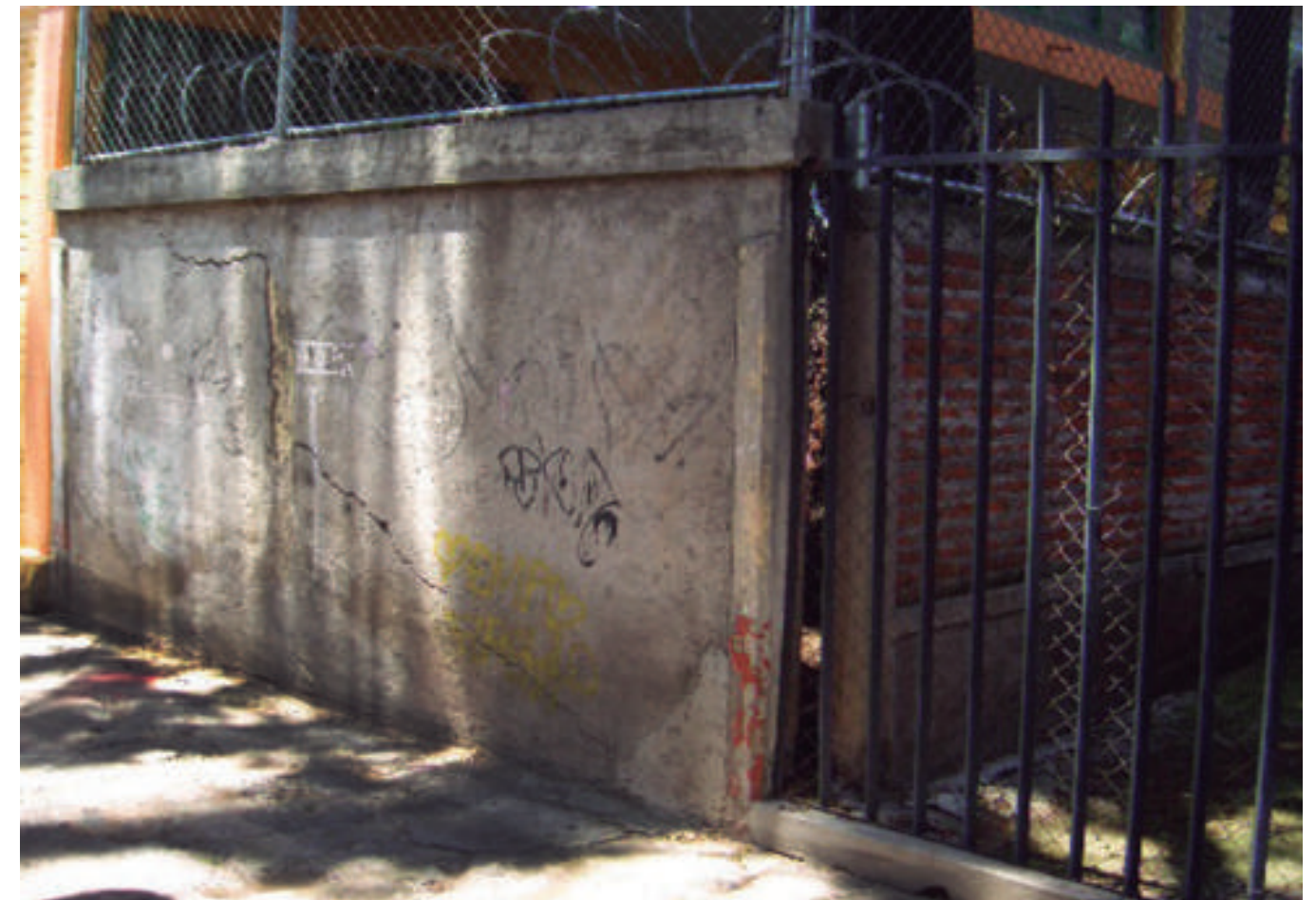
Figura 5.218. Fotografía C de la colonia Jardín Balbuena. Muro fracturado de una construcción (19.4130° N, 99.1018° W. Calle: 37 de Genaro García).
