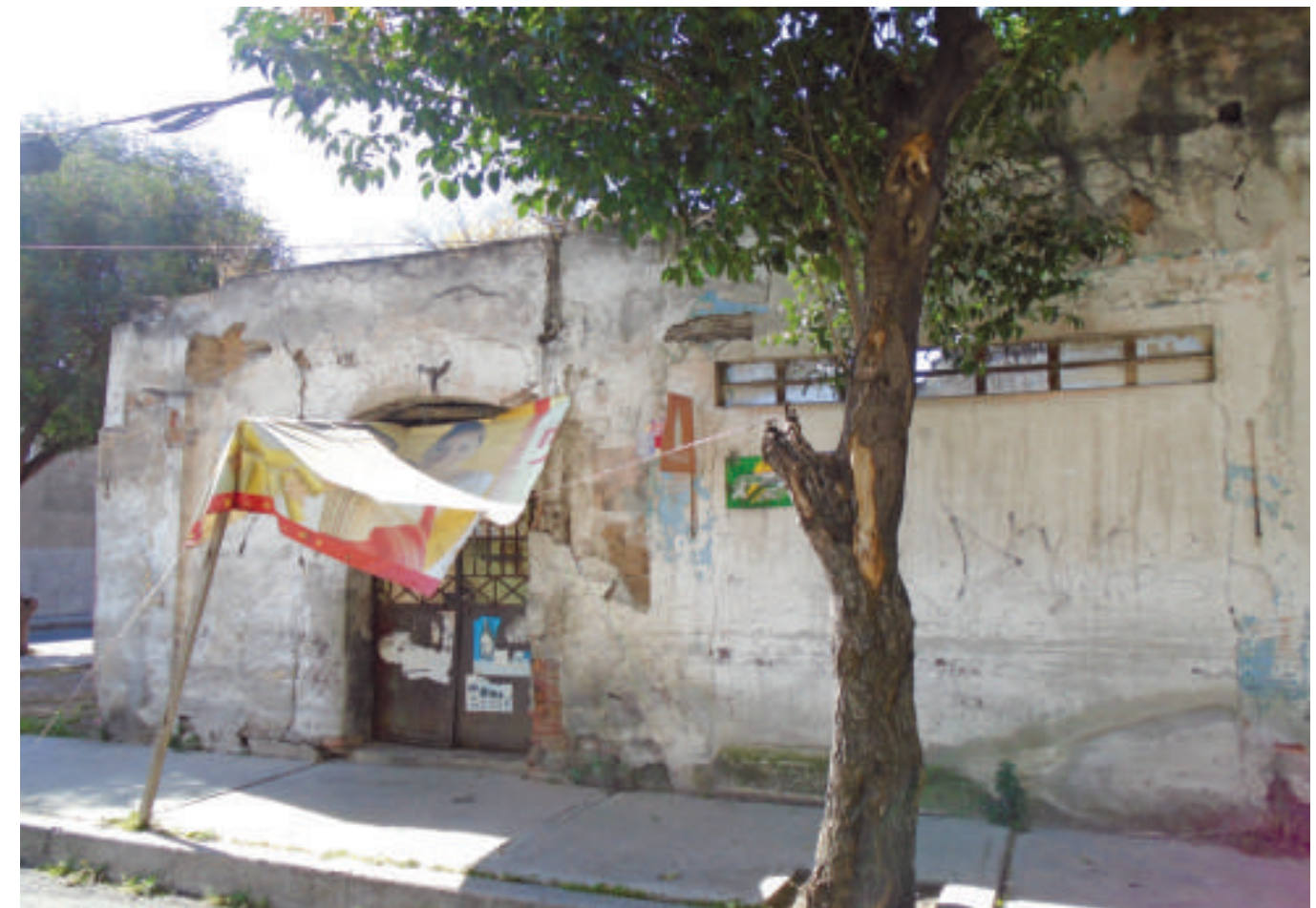
Figura 5.8. Fotografía A de la colonia Valle Gómez. Vivienda con diversas fracturas en su muro exterior, así como desprendimiento del material de construcción en la parte superior izquierda (19.4584° N, 99.1226° W. Calle: Vanadio).
