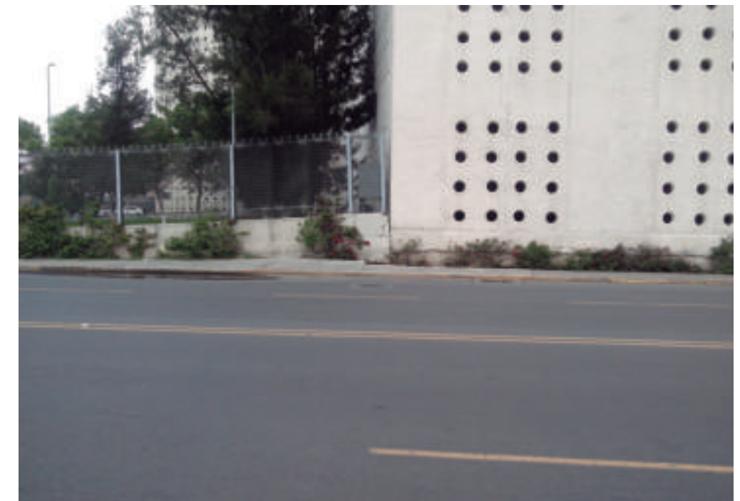
Figura 5.154. Fotografía en la que se observan fracturas en la parte inferior de la construcción, así como levantamiento de la banquetta (19.4336° N, 99.0657° W. Aeropuerto Internacional Benito Juárez).
