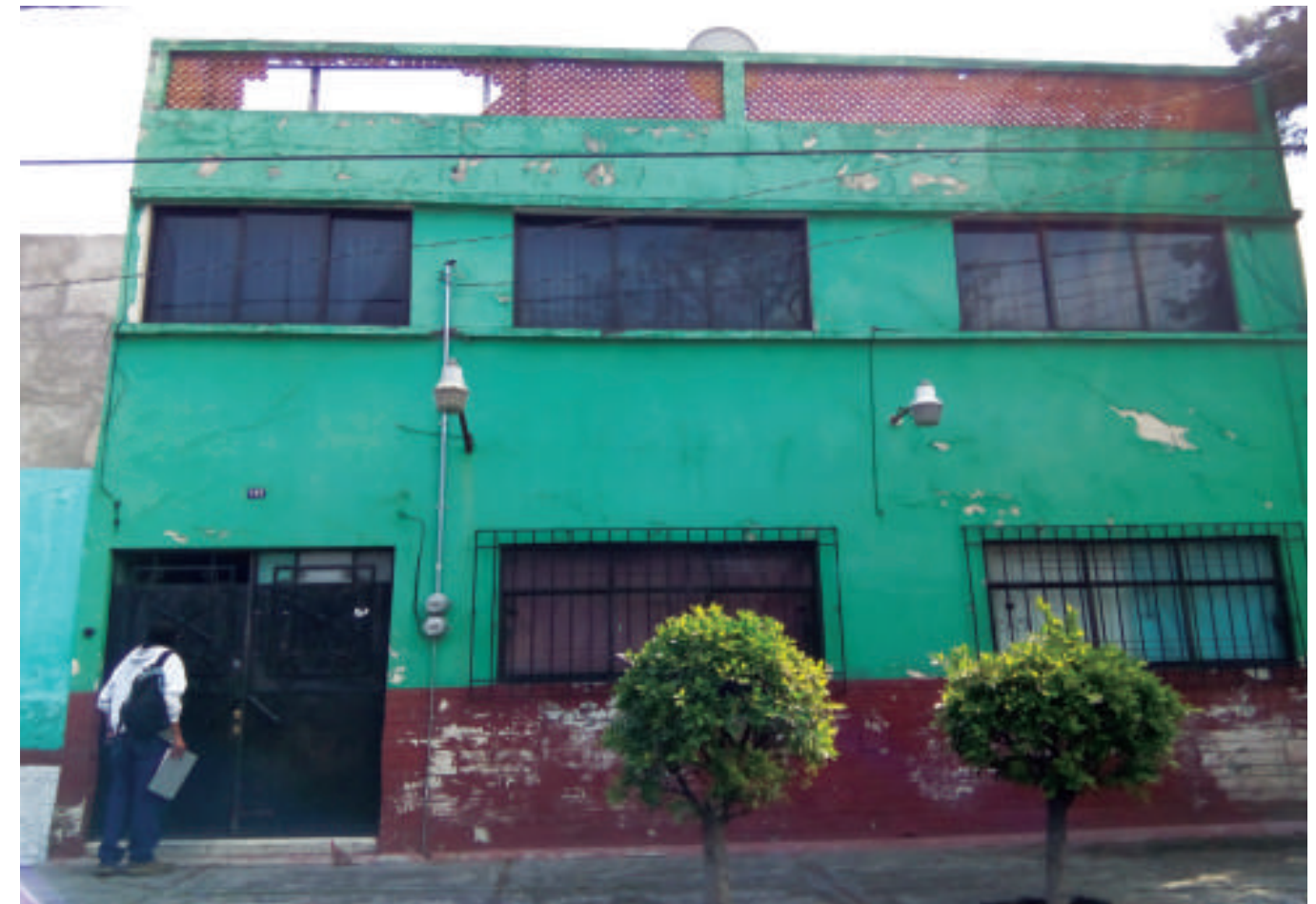
Figura 5.81. Fotografía E de la colonia 20 de Noviembre. Vivienda de mampostería semiconfinada con fracturas en forma diagonal y daño en piezas del pretil (19.4430° N, 99.1079° W. Calle: Decorado).
