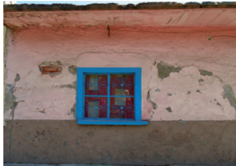
Figura 5.46. Fotografía A de la colonia 20 de Noviembre 5.º Tramo. Vivienda con su muro exterior deteriorado el cual se presenta diversas fracturas (19.4497° N, 99.1027° W. Calle: Cantería).
