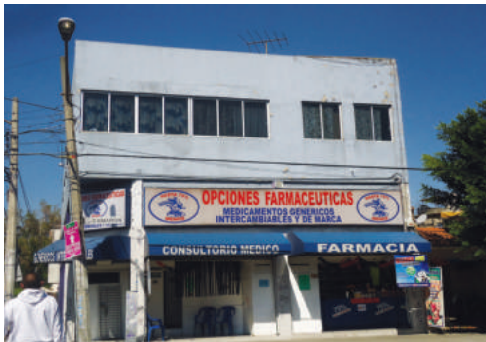
Figura 5.174. Fotografía D de la colonia Caracol. Construcción con una mala distribución de cargas, en la parte superior se observan fracturas en forma horizontal. (19.4246° N, 99.0696° W. Calle: Camarón).
