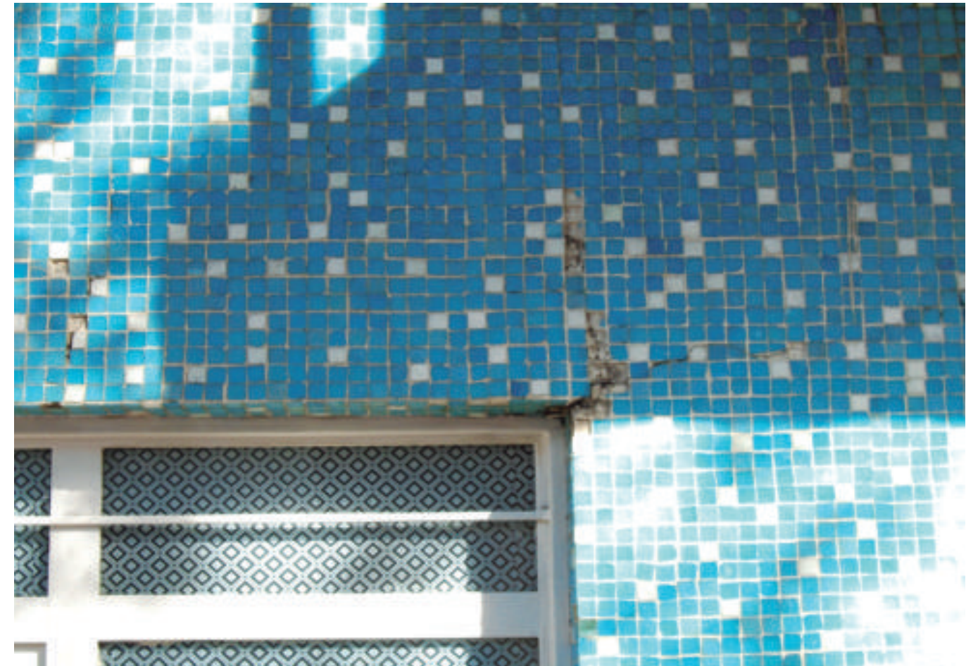
Figura 5.111. Fotografía D de la colonia Ampliación Penitenciaria. Muro exterior de una vivienda con presencia de fracturas en la parte superior de la ventana y desprendimiento de material (19.4349° N, 99.1136° W. Calle: Segunda cerrada San Antonio Tomatlán).
