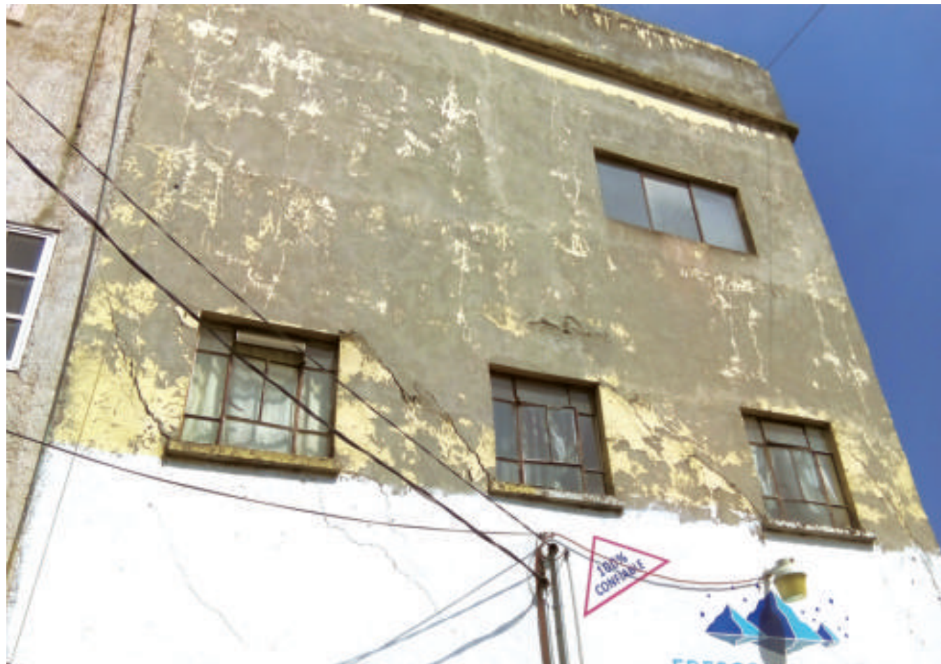
Figura 5.80. Fotografía D de la colonia 20 de Noviembre. Vivienda con fracturas en forma diagonal entre las ventanas (19.4402° N, 99.1089° W. Calle: Hortelanos).
