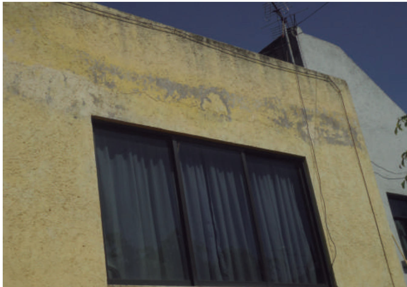
Figura 5.73. Fotografía B de la colonia Ampliación Venustiano Carranza. Vivienda con fracturas horizontales en la parte superior de la construcción (19.4418° N, 99.1061° W. Calle: Avicultura).
