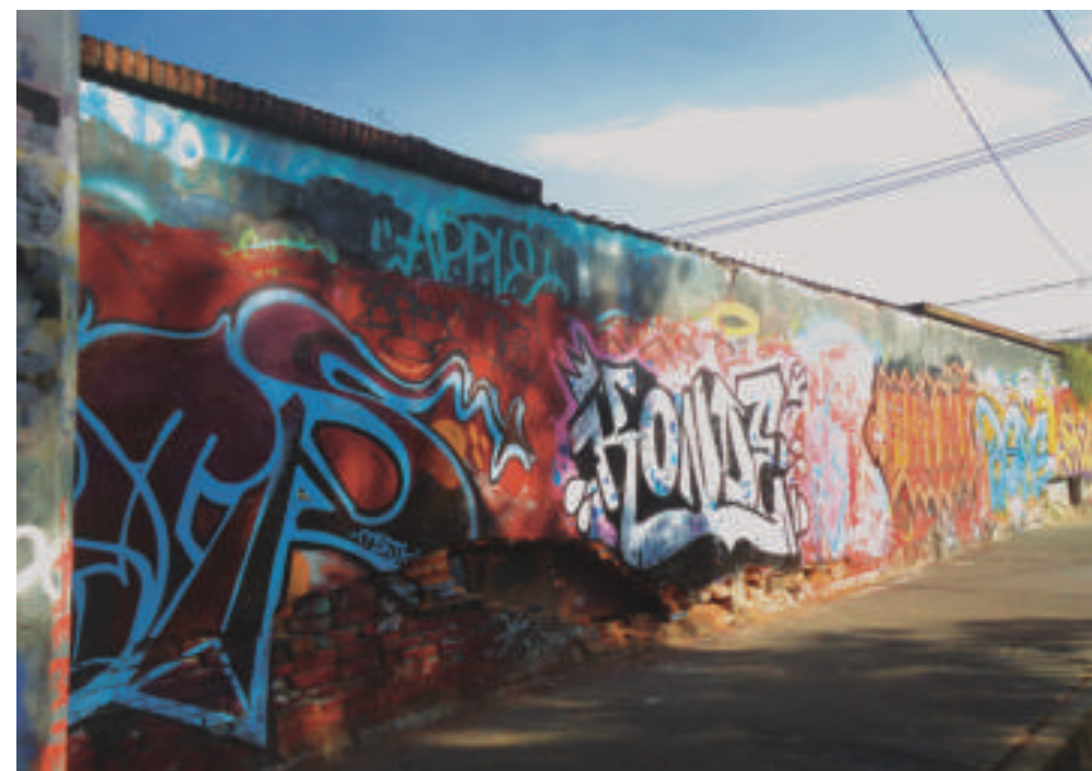
Figura 5.166. Fotografía B de la colonia Arenal 1.ª Sección. Muro con fracturas diagonales y horizontales, así como desprendimiento de material, ocasionando orificios como se observa en la parte inferior de la imagen (19.4249° N, 99.0620° W. Calle: Nezahualcóyotl).
