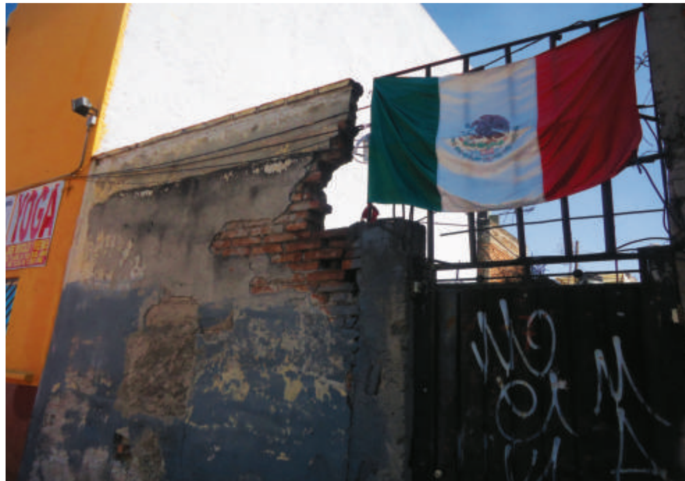
Figura 5.136. Fotografía B de la colonia Azteca. Construcción con desprendimiento y colapso del material de su muro externo (19.4376° N, 99.1093° W. Calle: Cerrajería).
