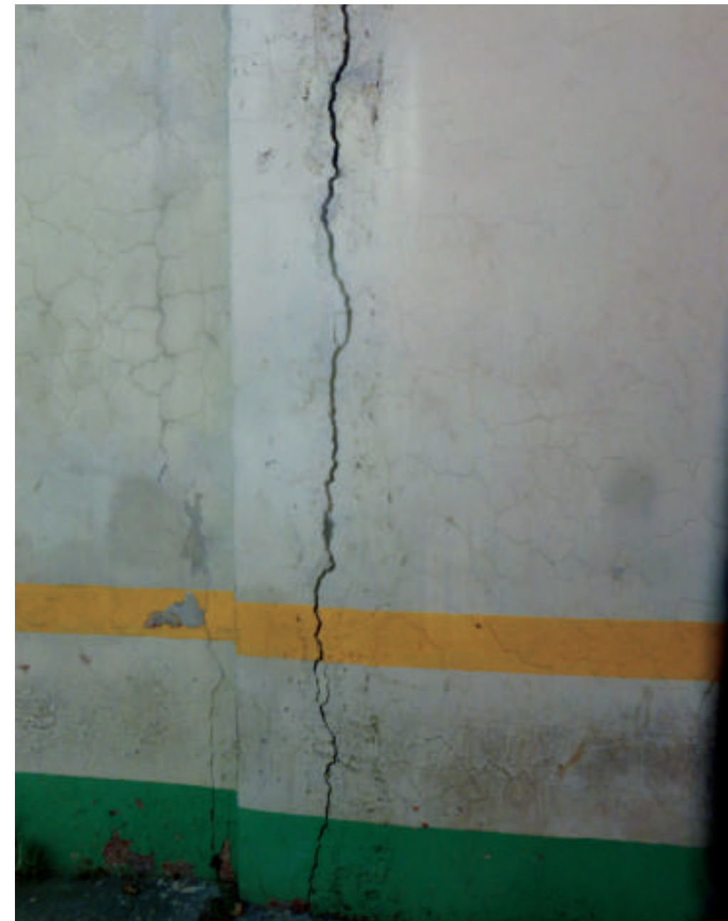
Figura 5.145. Fotografía C de la colonia Peñón de los Baños. Muro afectado por una fractura vertical (19.4401° N, 99.0812° W. Calle: Puebla).
