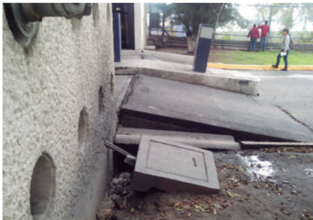
Figura 5.153. Fotografía que muestra el desnivel de la construcción con respecto al pavimento, este último con presencia de fracturas (19.4336° N, 99.0657° W. Aeropuerto Internacional Benito Juárez).
