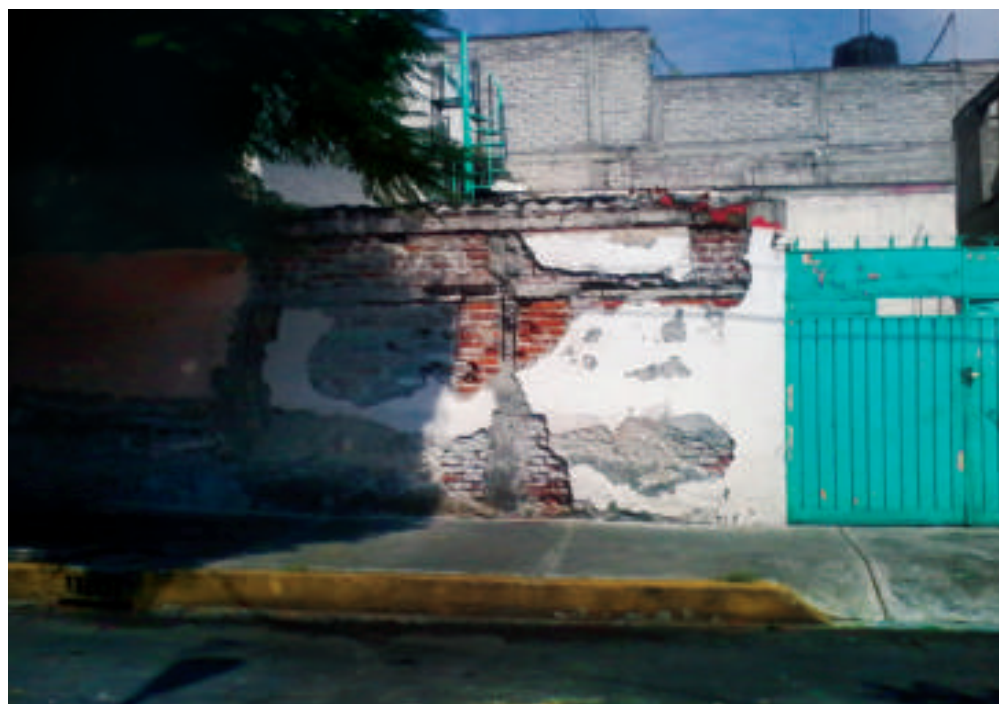
Figura 5.192. Fotografía D de la colonia Puebla. Abundante desprendimiento de material dejando expuesto el armado de la construcción (19.4116° N, 99.0845° W. Calle: 59).
