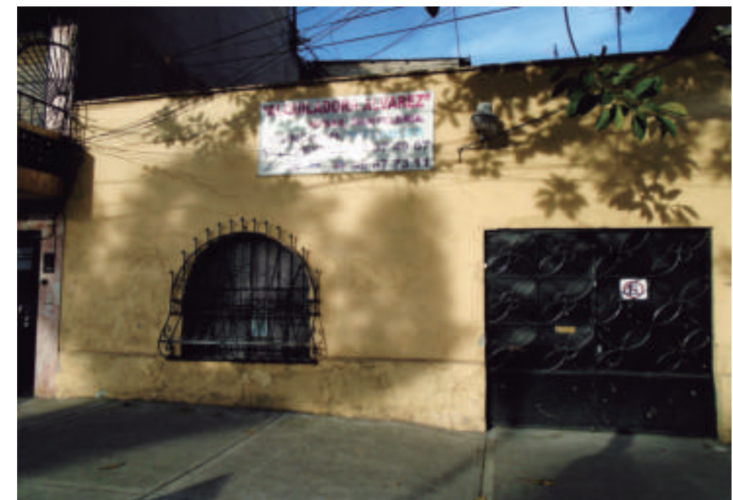
Figura 5.100. Fotografía G de la colonia Ampliación 20 de Noviembre. Inmueble con fracturas en el muro externo de la construcción (19.4414° N, 99.1146° W. Calle: Circunvalación).
