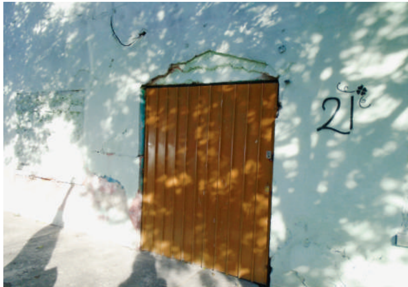
Figura 5.86 Fotografía C de la colonia Ampliación Michoacana. Vivienda con fracturas horizontales y desprendimiento de material (19.4479° N, 99.1134° W. Calle: Bondojoito).
