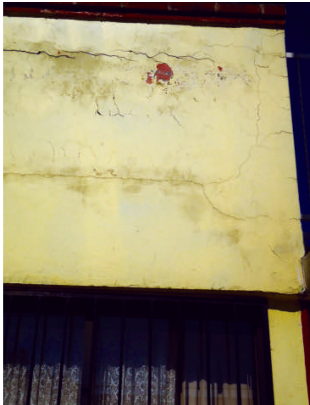
Figura 5.207. Fotografía B de la colonia Ignacio Zaragoza. Serie de fracturas en la parte superior de una vivienda (19.4100° N, 99.0879° W. Calle: 51).
