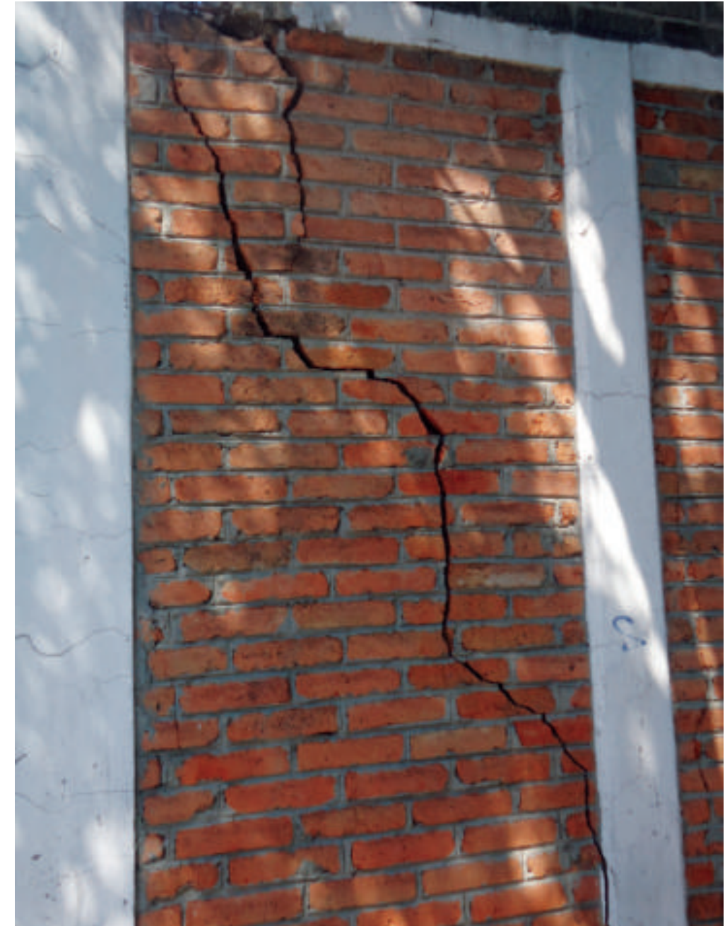
Figura 5.213. Fotografía C de la colonia Santa Cruz Aviación. Inmueble con fracturas, una de ellas atravesando el muro (19.4228° N, 99.0967° W. Calle: Privada Francisco Sarabia).
