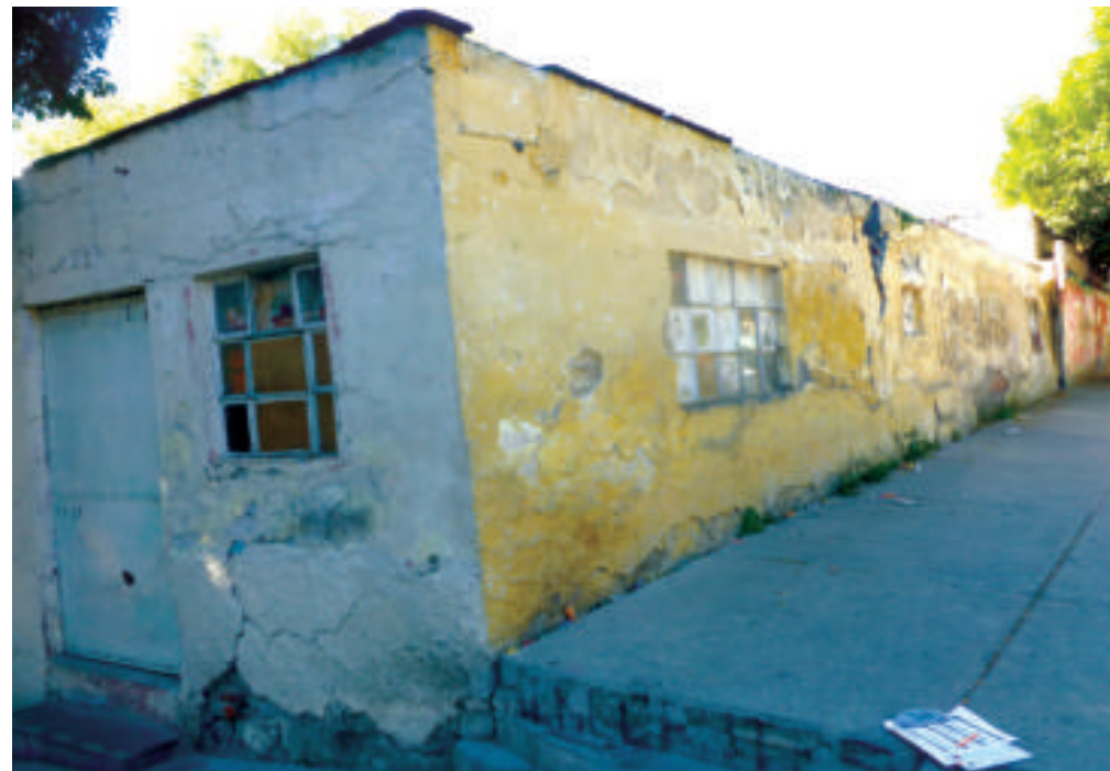
Figura 5.143. Fotografía A de la colonia Peñón de los Baños. Vivienda con fracturas y desprendimiento de material (19.4397° N, 99.0826° W. Calle: Sinaloa).
