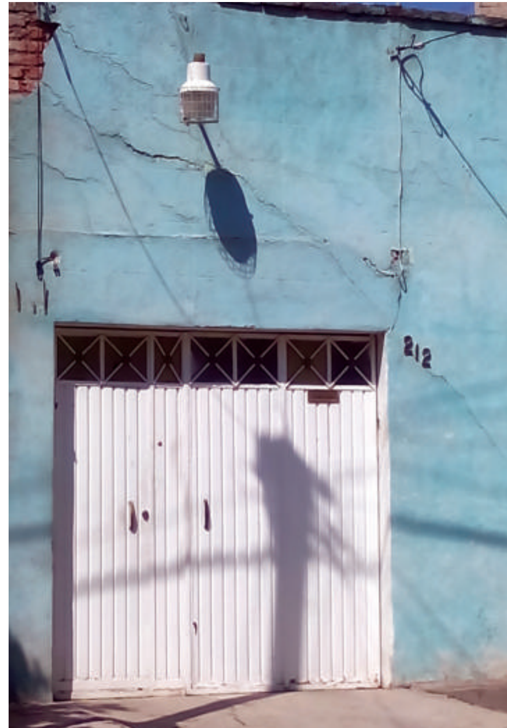
Figura 5.77. Fotografía A de la colonia 20 de Noviembre. Vivienda con fracturas en forma diagonal y horizontal. Presenta además desprendimiento del material (19.4462° N, 99.1105° W. Calle: Tipografía).
