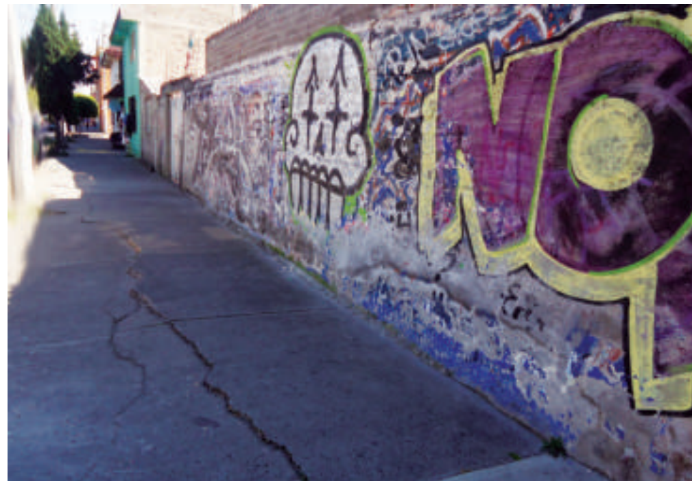
Figura 5.171. Fotografía A de la colonia Adolfo López Mateos. Fracturas tanto en el muro como en el pavimento (19.4192° N, 99.0740° W. Calle: Adolfo López Mateos).
