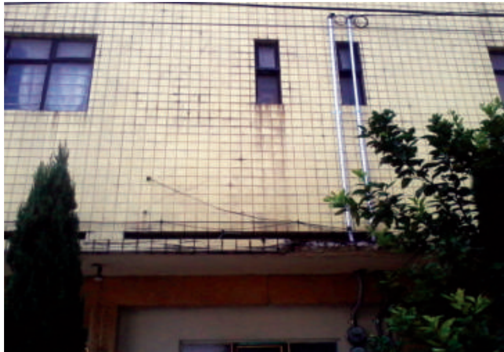
Figura 5.191. Fotografía C de la colonia Puebla. Fracturas en la parte superior de la construcción (19.4116° N, 99.0842° W. Calle: 59).
