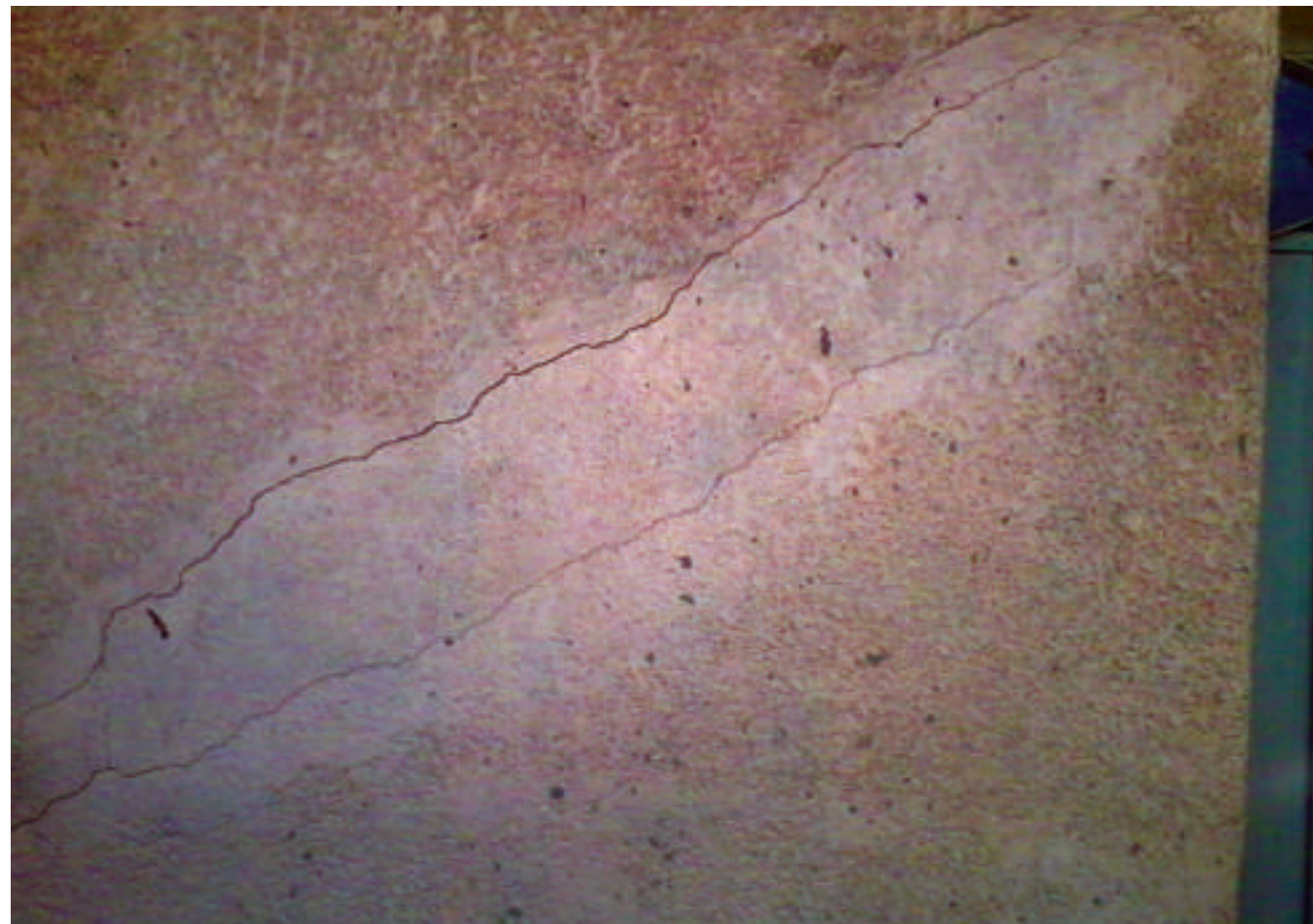
Figura 5.194. Fotografía F de la colonia Puebla. Se aprecia un muro de un inmueble en el que se observan dos fracturas paralelas de forma diagonal (19.4100° N, 99.0841° W. Calle: 63).
