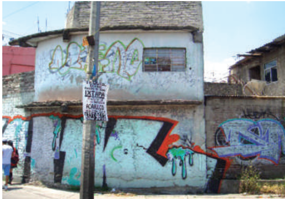
Figura 5.179. Fotografía I de la colonia Adolfo López Mateos. Inmueble con fracturas en la parte exterior del muro (19.4179° N, 99.0714° W. Calle: Río Churubusco).
