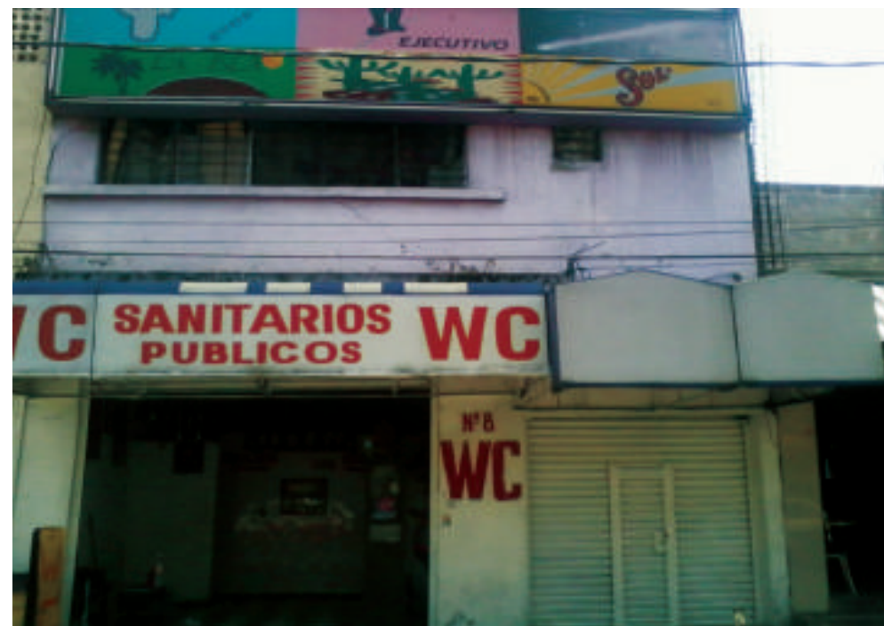
Figura 5.190. Fotografía B de la colonia Puebla. Construcción con fracturas en la parte superior de la misma (19.4109° N, 99.0822° W. Calle: 67).
