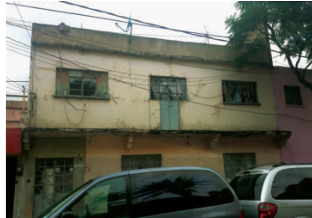
Figura 5.59. Fotografía A de la colonia Aquiles Serdán. Vivienda semiconfinada en la que se observan fracturas en forma horizontal y vertical, además de daños y desprendimiento de material (19.444° N, 99.0893° W. Calle: Bolívars).
