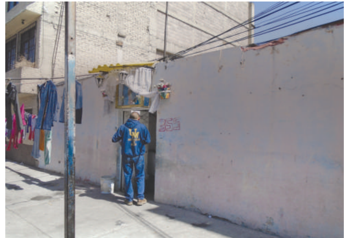
Figura 5.43. Fotografía C de la colonia 2.º Tramo 20 de Noviembre. Se observan fisuras en el muro externo de la vivienda, asimismo el inmueble presenta un desnivel con respecto a la calle (19.4517° N, 99.1077° W. Calle: Sericultura).
