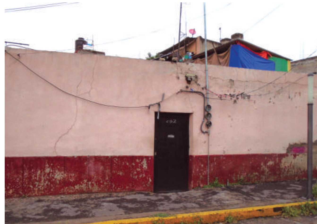
Figura 5.125. Fotografía A de la colonia Progresista. Vivienda de mampostería con agrietamiento horizontal y vertical en su muro exterior (19.4368° N, 99.1075° W. Calle: Zapata).
