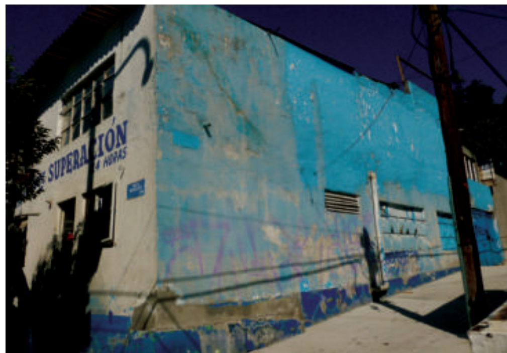
Figura 5.144. Fotografía B de la colonia Peñón de los Baños. Inmueble con fracturas en su muro externo (19.4400° N, 99.0818° W. Calle: La Paz).
