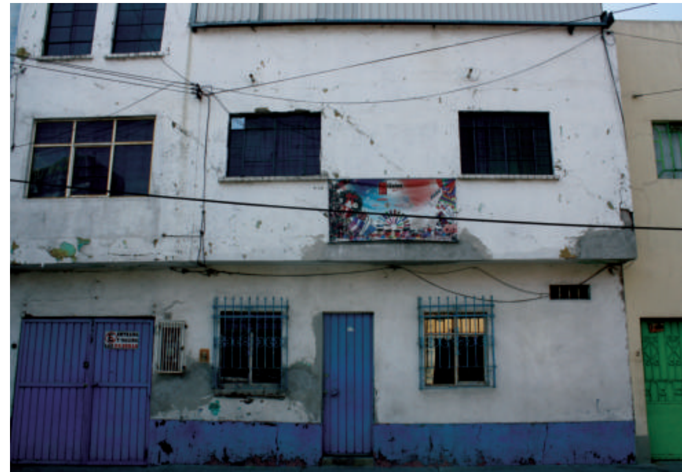
Figura 5.234. Fotografía A de la colonia Merced Balbuena. Se observa desprendimiento de material, reparaciones en algunas de las zonas de la vivienda y fracturas en la fachada de la construcción (19.4295° N, 99.1246° W. Calle: R. Heliodoro Valle).
