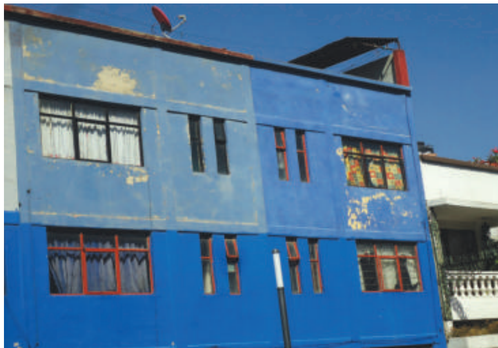
Figura 5.177. Fotografía G de la colonia Caracol. Desprendimiento de material y una fractura en la parte superior derecha de la construcción (19.4274° N, 99.0660° W. Calle: Angulas).
