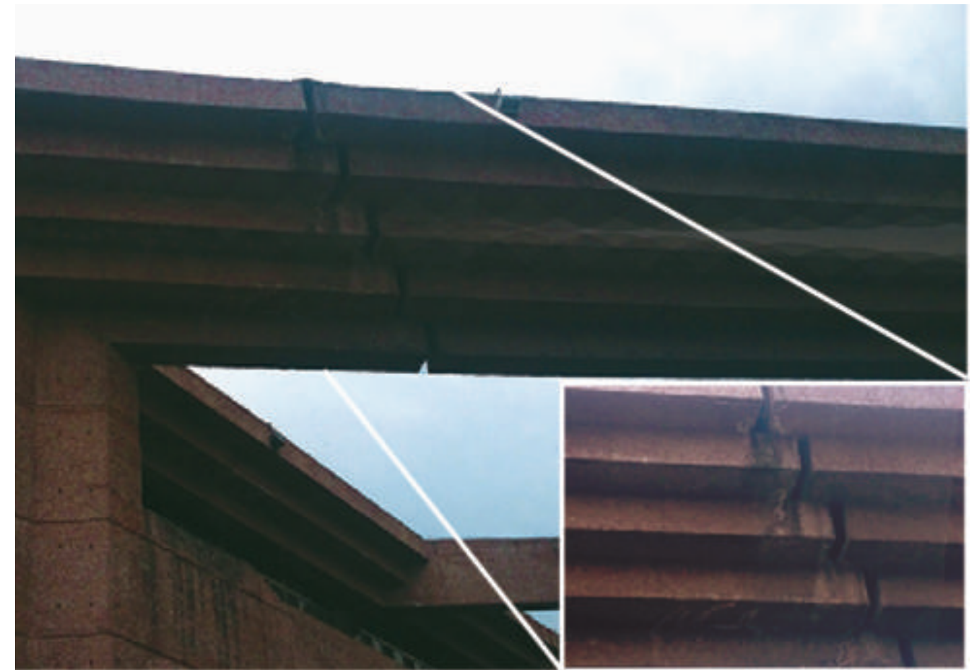
Figura 5.225. Fotografía C de la colonia Aeronáutica Militar. Fracturas en la entrada principal del Congreso de la Unión (19.4297° N, 99.1173° W. Calle: Emiliano Zapata).
