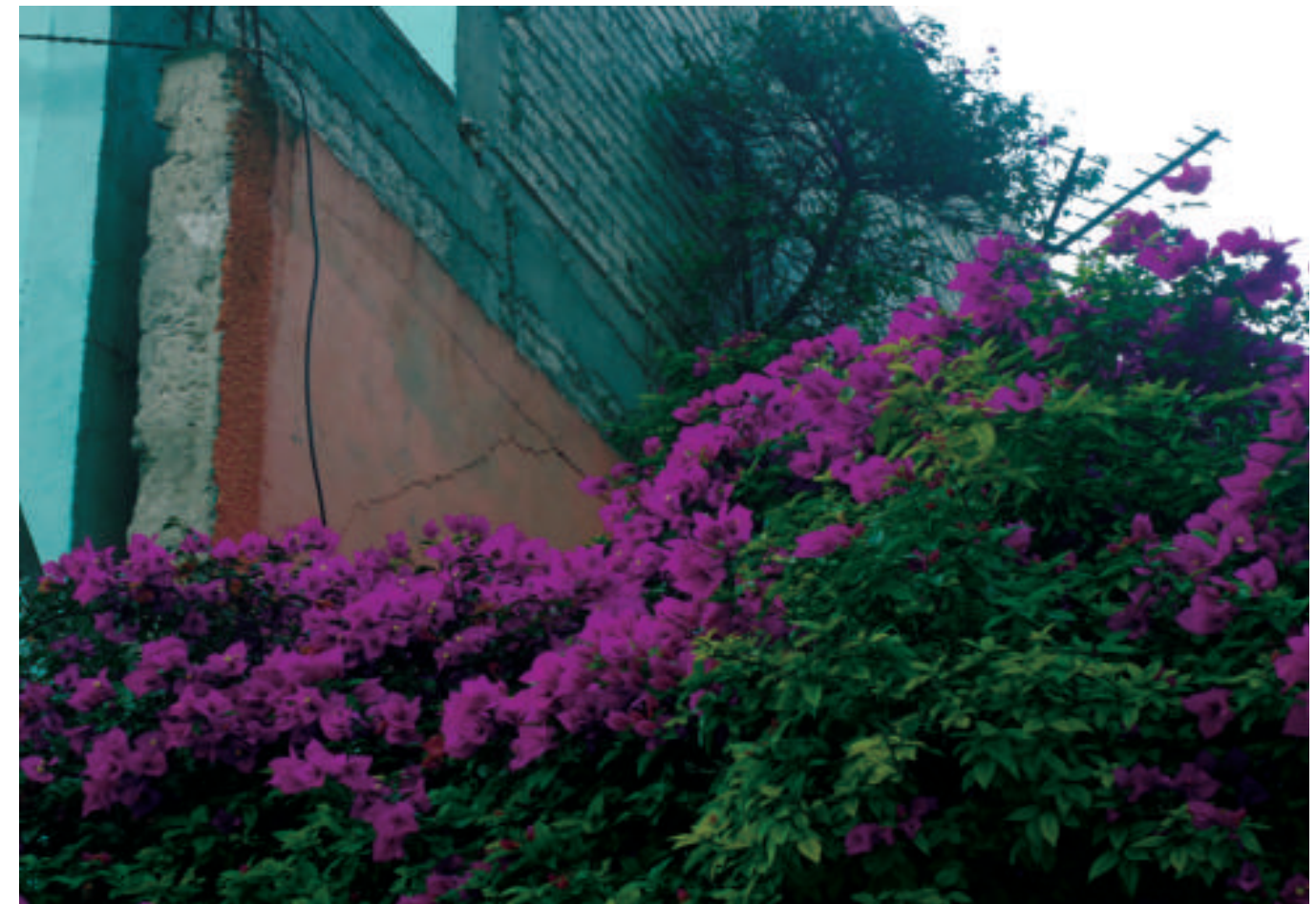
Figura 5.162. Fotografía F de la colonia El Arenal 4.ª Sección. Se observa fracturado el muro exterior de una vivienda (19.4309° N, 99.0575° W. Calle: Xochitlán Norte).
