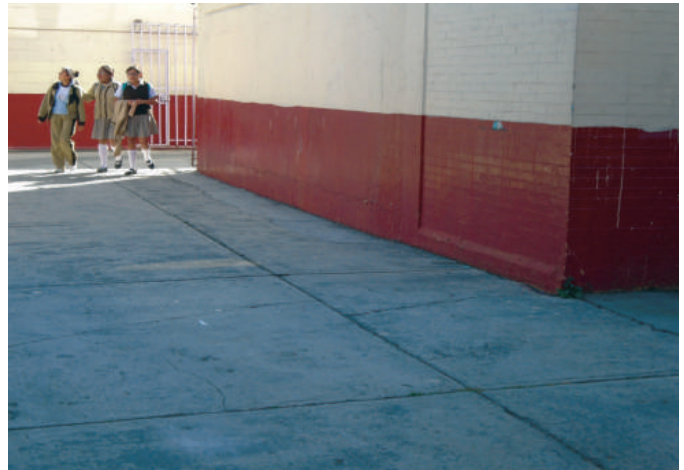
Figura 5.27. Fotografía A de la colonia Morelos. Escuela que presenta fracturas horizontales en la parte inferior del muro y fracturas verticales (19.438° N, 99.120° W. Calle: José J. Herrera).
