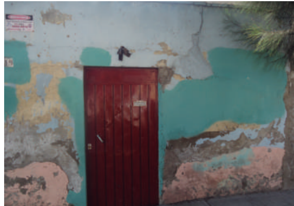
Figura 5.198. Fotografía A de la colonia Cuatro Árboles. Vivienda con fracturas y desprendimiento de material en el muro (19.4148° N, 99.0856° W. Calle: Recursos Hidráulicos).
