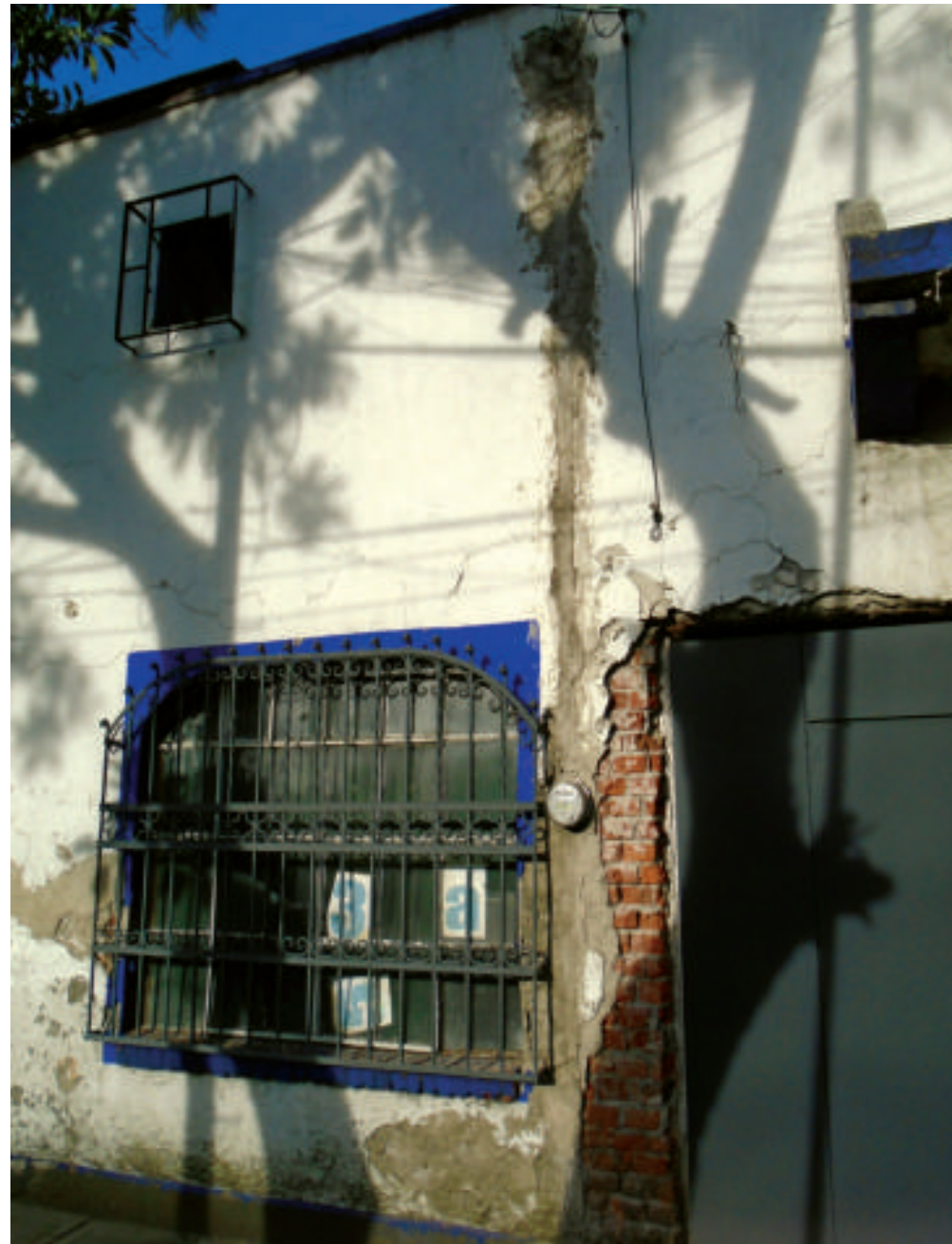
Figura 5.99 Fotografía F de la colonia Ampliación 20 de Noviembre. Inmueble con desprendimiento de material y fracturas en su muro exterior (19.4414° N, 99.1146° W. Calle: Circunvalación).
