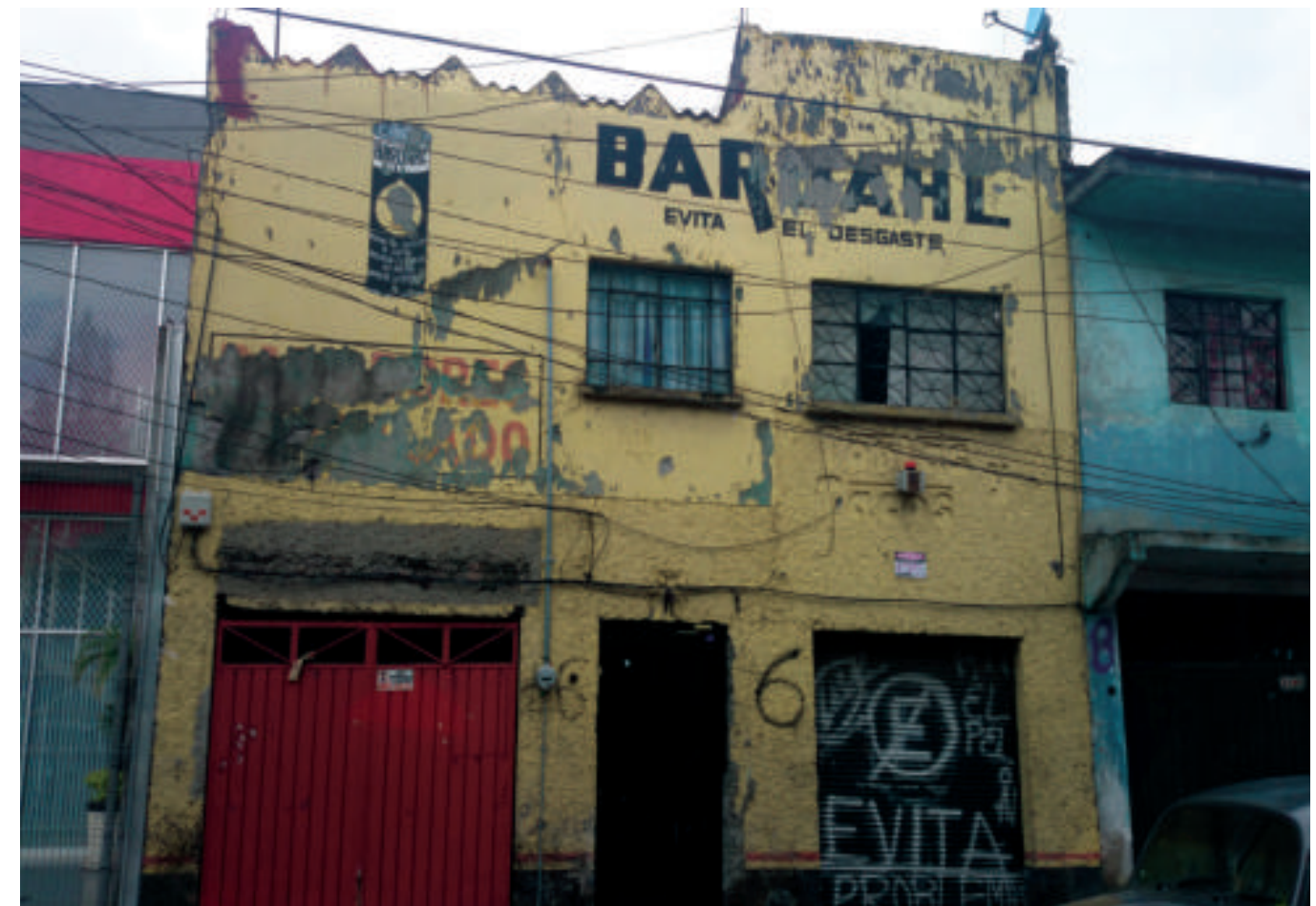
Figura 5.52. Fotografía C de la colonia Ampliación Simón Bolívar. Construcción con múltiples fracturas diagonales, verticales y horizontales y desprendimiento de material (19.4494° N, 99.0990° W. Calle: Florines).
