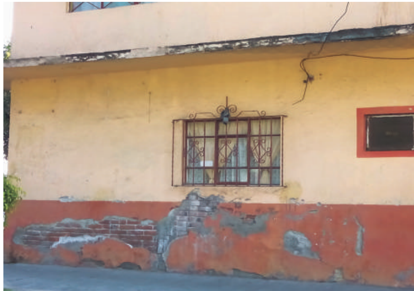
Figura 5.78. Fotografía B de la colonia 20 de Noviembre. Vivienda de mampostería semiconfinada con fracturas diagonales que van desde la cornisa hacia la ventana, así como con desprendimiento de material (19.4424° N, 99.1088° W. Calle: Grabados).
