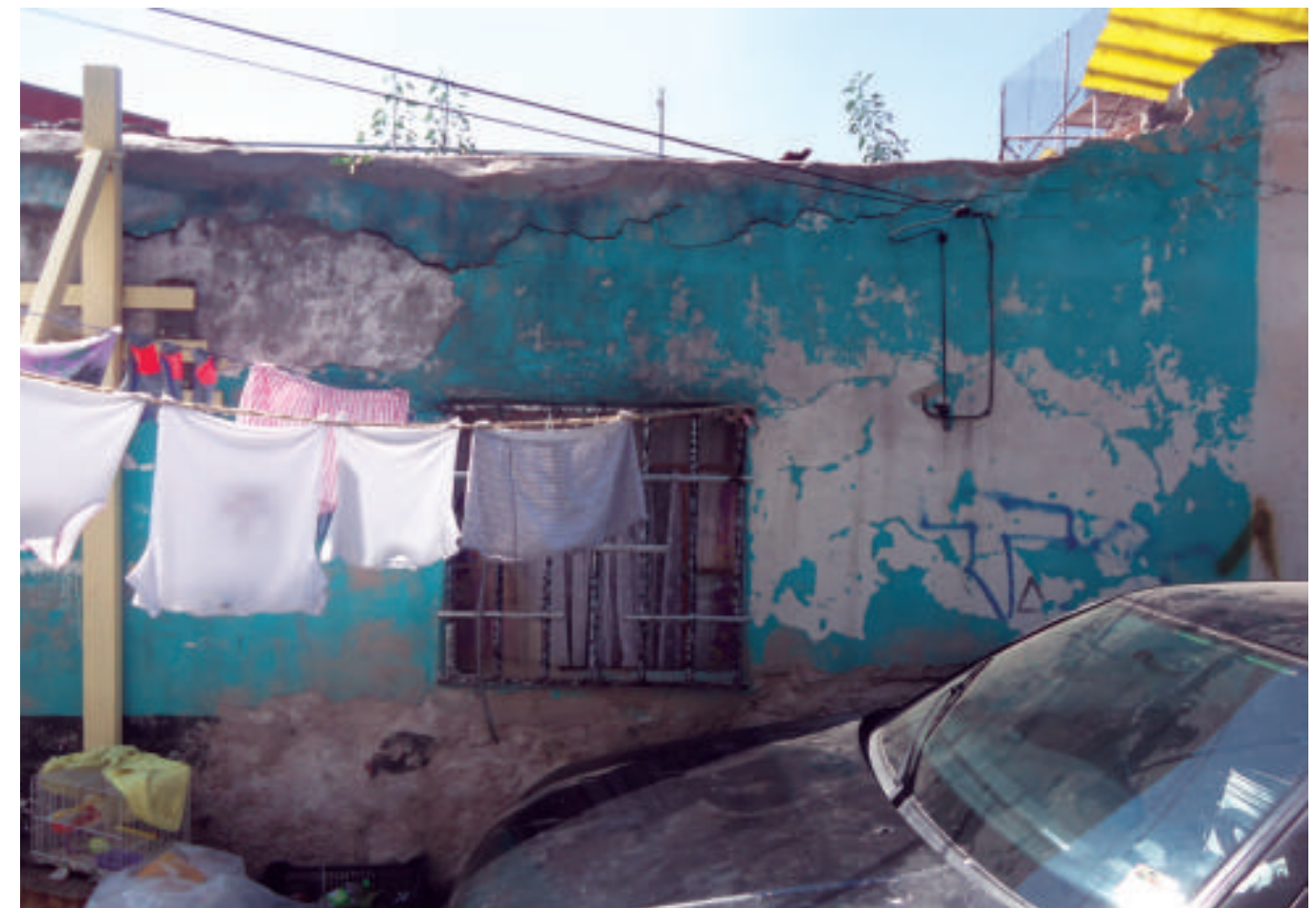
Figura 5.67. Fotografía A de la colonia Damián Carmona. Vivienda que muestra daños en su fachada principal como son fracturas diagonales, horizontales y deterioro en su acabado (19.4409° N, 99.1033° W. Calle: Dos).
