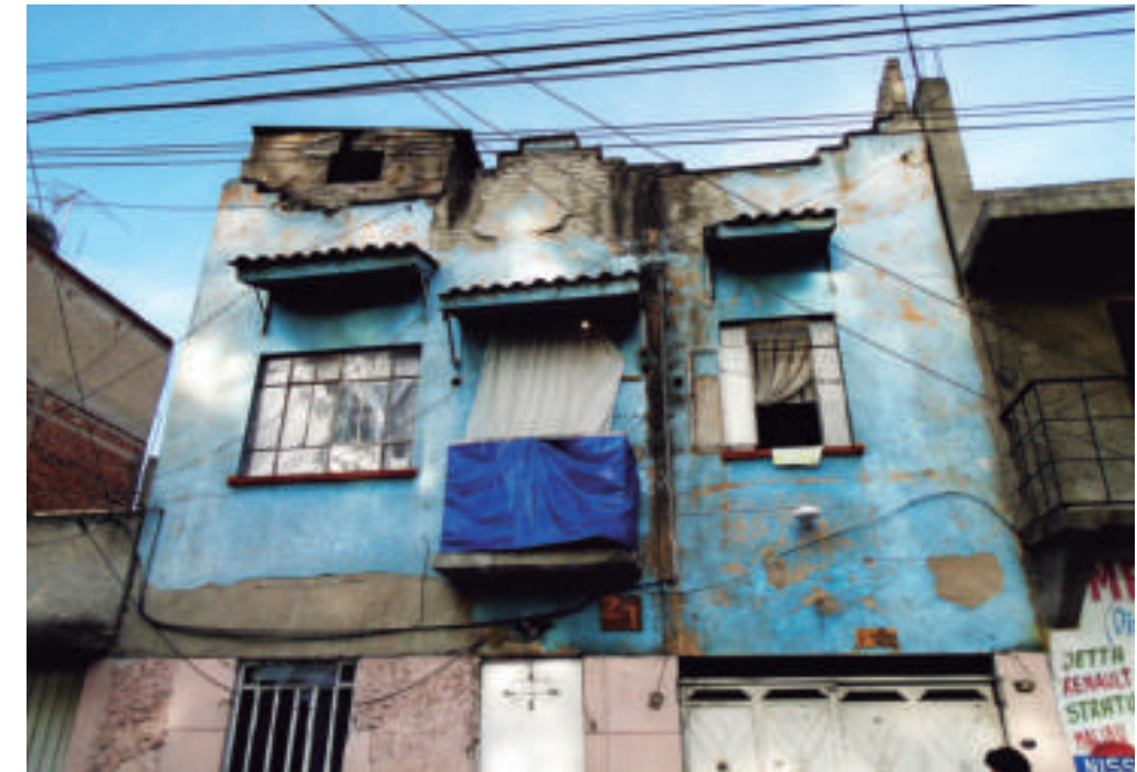
Figura 5.98. Fotografía E de la colonia Ampliación 20 de Noviembre. Inmueble con desprendimiento de material, principalmente en la parte superior de la construcción (19.4410° N, 99.1143° W. Calle: Circunvalación).
