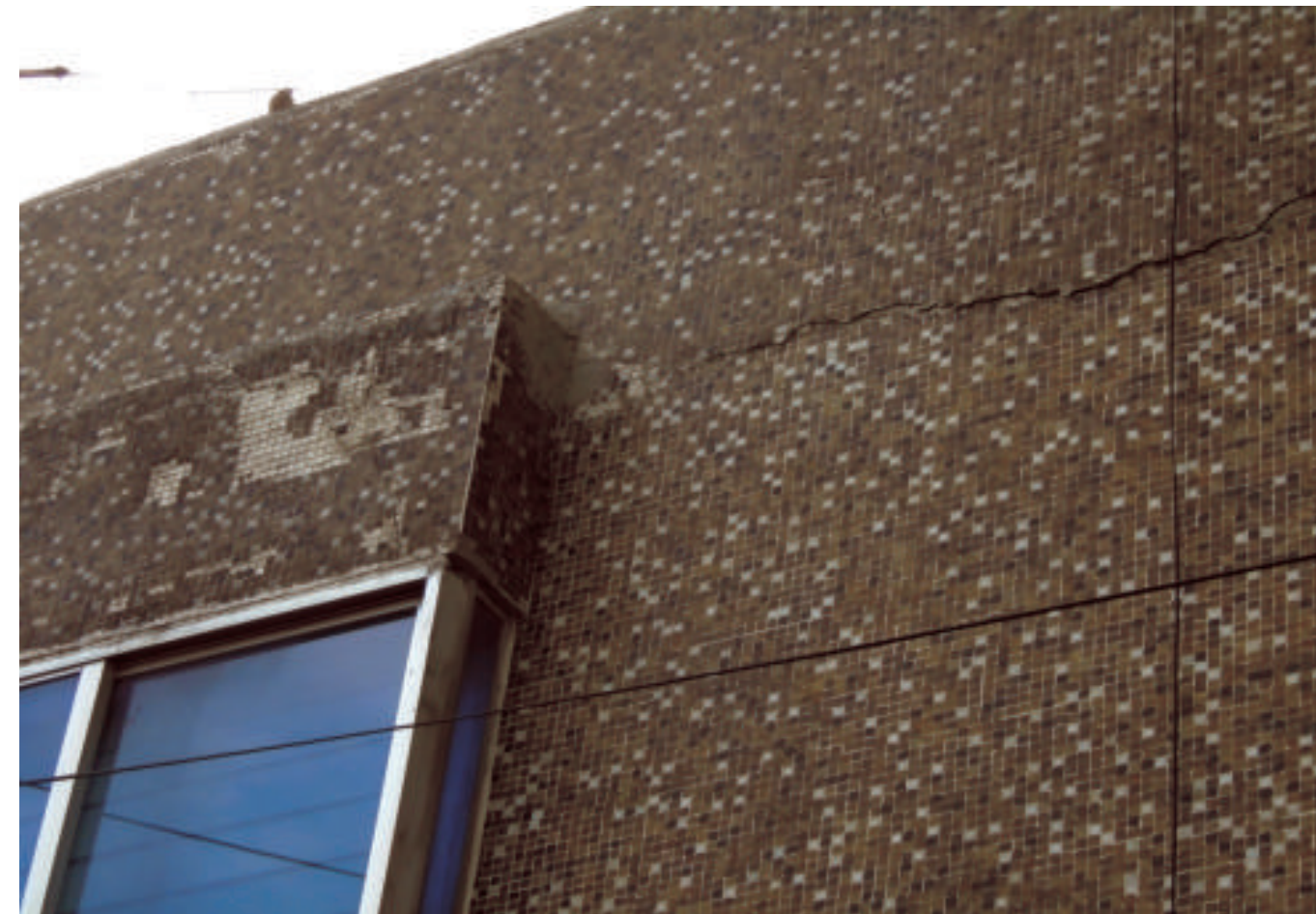
Figura 5.32. Fotografía A de la colonia Janitzio. Vivienda que presenta fracturas horizontales y diagonales en los volados de las ventanas del nivel superior. Asimismo se observa una fractura horizontal en la esquina de la parte superior de la edificación debido a un mal confinamiento (19.4459° N, 99.1176° W. Calle: Jiquilpan).
