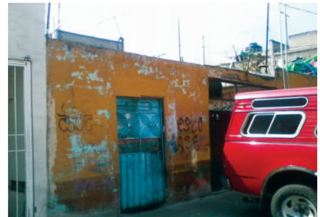
Figura 5.193. Fotografía E de la colonia Puebla. En ella se muestra desprendimiento de material y fracturas principalmente en la parte superior de uno de los accesos de la vivienda (19.4110° N, 99.0846° W. Calle: 59).
