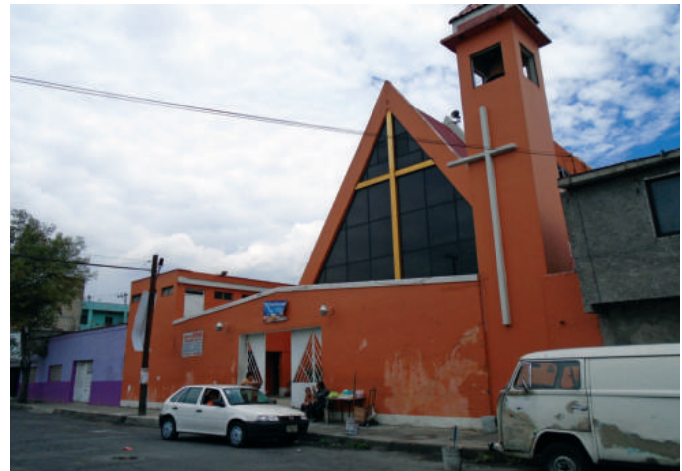
Figura 5.132 Fotografía C de la colonia Revolución. Iglesia con daño en acabados y fracturas diagonales en el muro exterior (19.4394° N, 99.1034° W. Calle: General L. Blanco).
