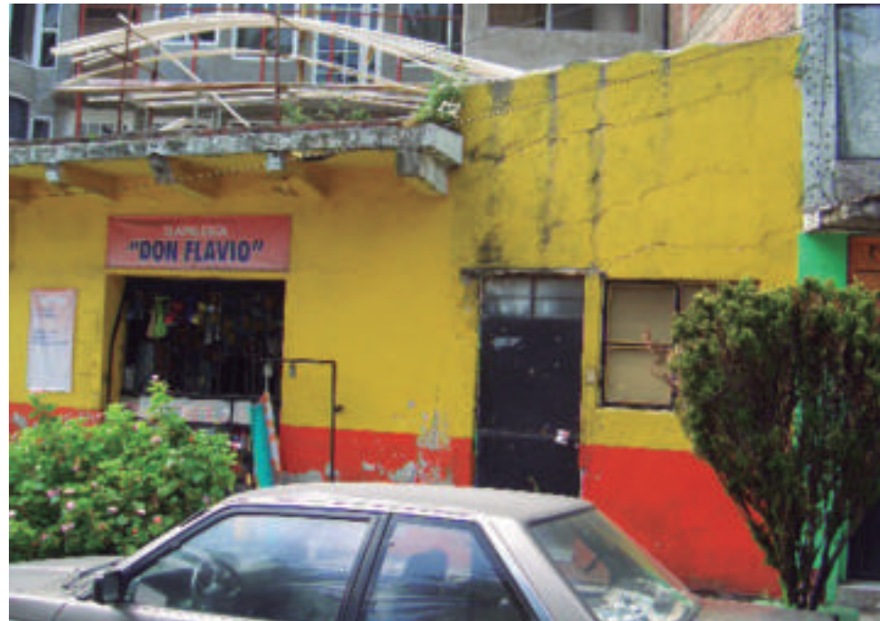
Figura 5.202. Fotografía A de la colonia Federal. Se observan diversas fracturas en el muro de un inmueble así como desprendimiento de material (19.4198°N, 99.0894° W. Calle: Universidad Nacional).
