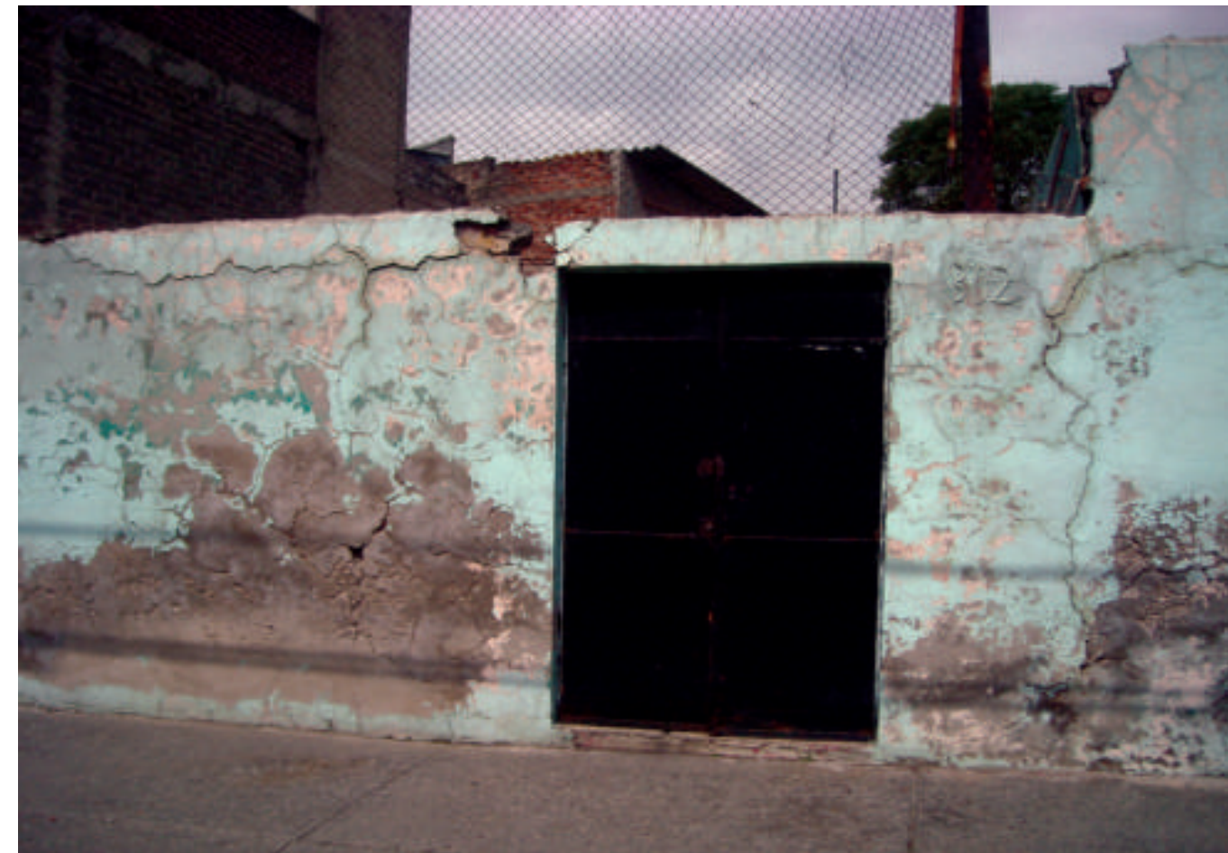
Figura 5.148. Fotografía A de la colonia Moctezuma 2.ª Sección. Inmueble con fracturamiento en su muro y desprendimiento de acabados (19.4365° N, 99.0983° W. Calle: Industria).
