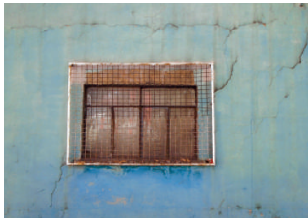
Figura 5.14. Fotografía B de la colonia Nicolás Bravo. Inmueble con fracturas en la parte superior, así como a un costado de la ventana (19.4543° N, 99.1239° W. Calle: Cadmio).
