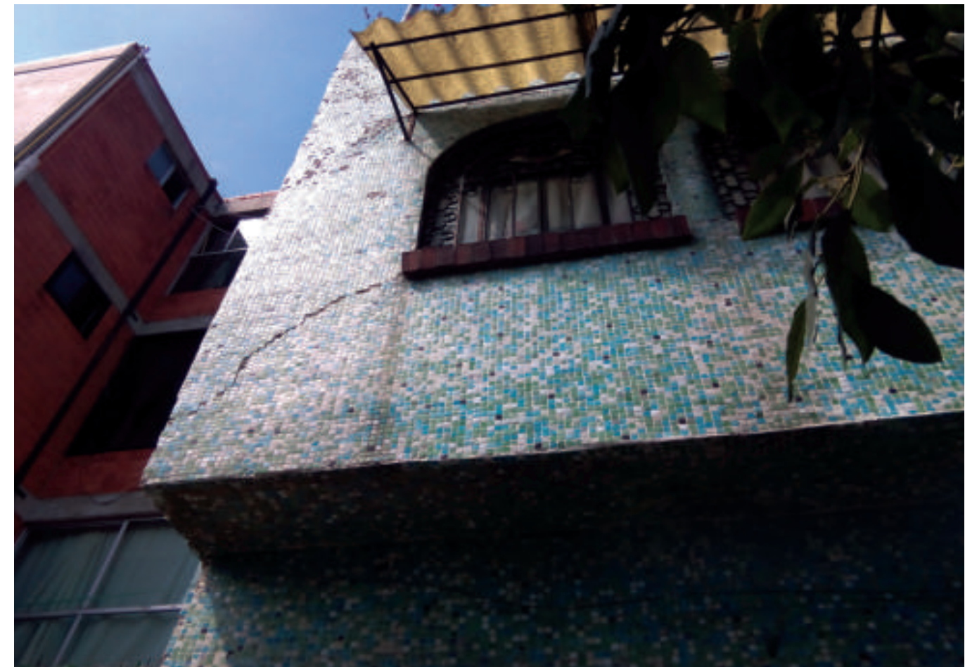
Figura 5.79. Imagen C de la colonia 20 de Noviembre. Vivienda semiconfinada con fracturas en forma diagonal (19.4412° N, 99.1091° W. Calle: Grabados).
