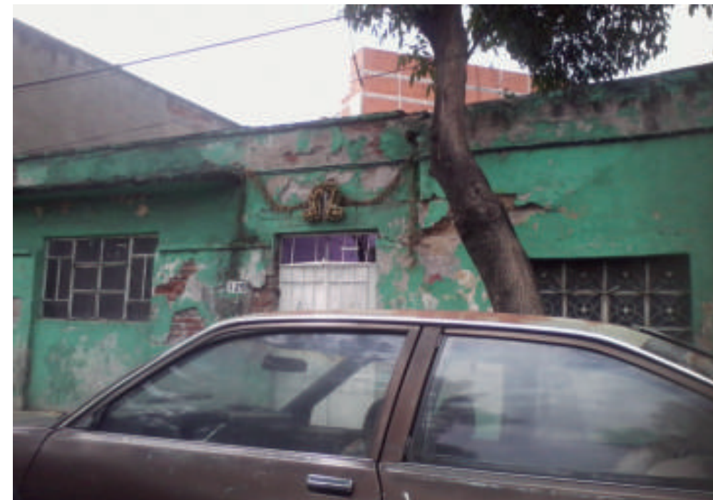
Figura 5.63. Fotografía A de la colonia Romero Rubio. Vivienda con fracturas a lo largo del muro del acceso principal, así como desprendimiento de material de construcción (19.4414° N, 99.0944° W. Calle: Marruecos).
