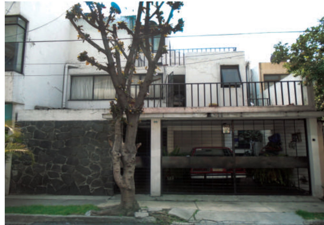
Figura 5.216. Fotografía A de la colonia Jardín Balbuena. Vivienda con fracturas en el segundo nivel de construcción (19.4179° N, 99.1065° W. Calle: Retorno 9 de Fray Servando Teresa de Mier).
