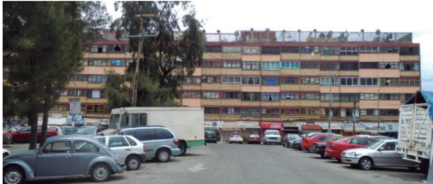
Edificio habitacional en la colonia Jardín Balbuena que se hunde al ser más pesado que la carpeta asfáltica.
