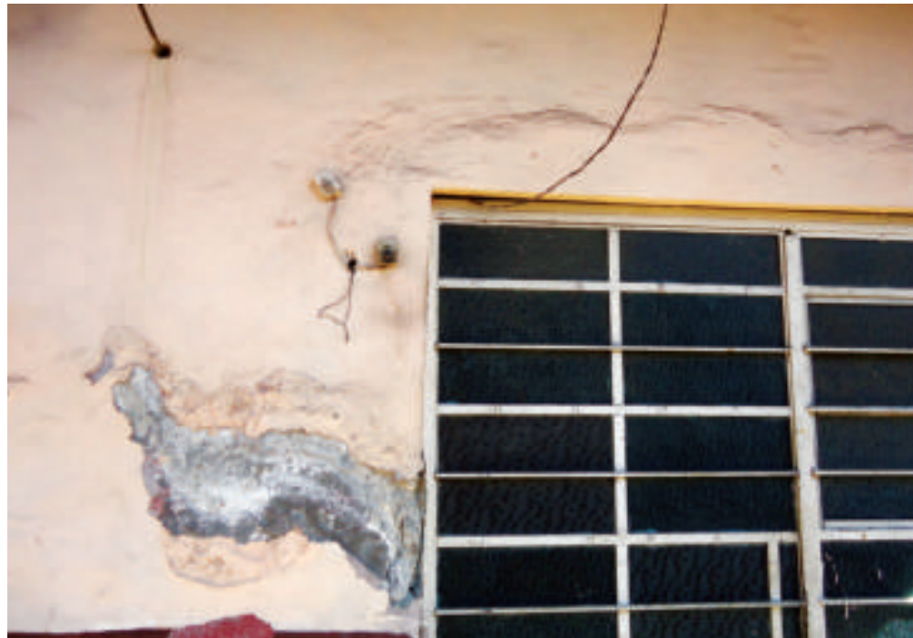
Figura 5.173. Fotografía C de la colonia Adolfo López Mateos. Desprendimiento de material en el muro del inmueble, principalmente en la parte inferior izquierda de la ventana (19.4225° N, 99.0715° W. Calle: Fernando Román Lugo).
