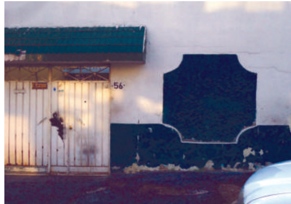
Figura 5.157. Fotografía A de la colonia El Arenal 3.º Sección. Vivienda con fracturas horizontales en la parte media del muro y fracturas verticales en la parte superior (19.4263° N, 99.0559° W. Calle: Moctezuma II).
