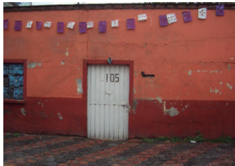
Figura 5.249. Fotografía B de la colonia Magdalena Mixhuca. Inmueble con fracturas a lo largo del muro exterior y ligeramente hundida con respecto a la banquetta (19.4093° N, 99.1207° W. Calle: Vicente Guerrero).
