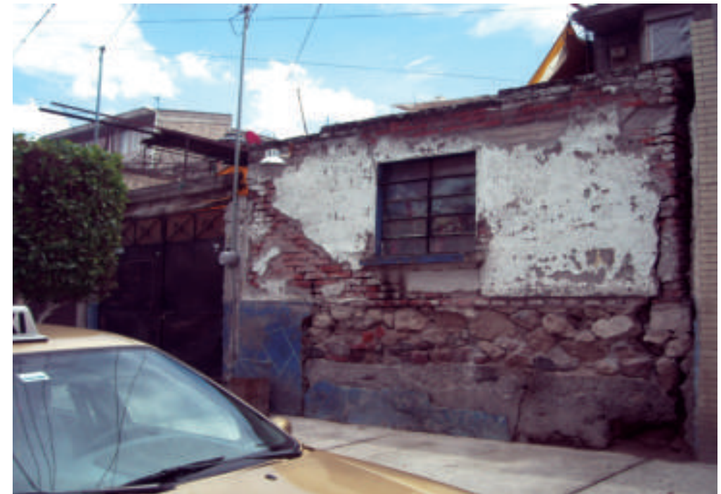
Figura 5.141. Fotografía C de la colonia Pensador Mexicano. Vivienda con fracturas, así como desprendimiento de material dejando al descubierto el armado de la construcción (19.4394° N, 99.0875° W. Calle: Norte 180).
