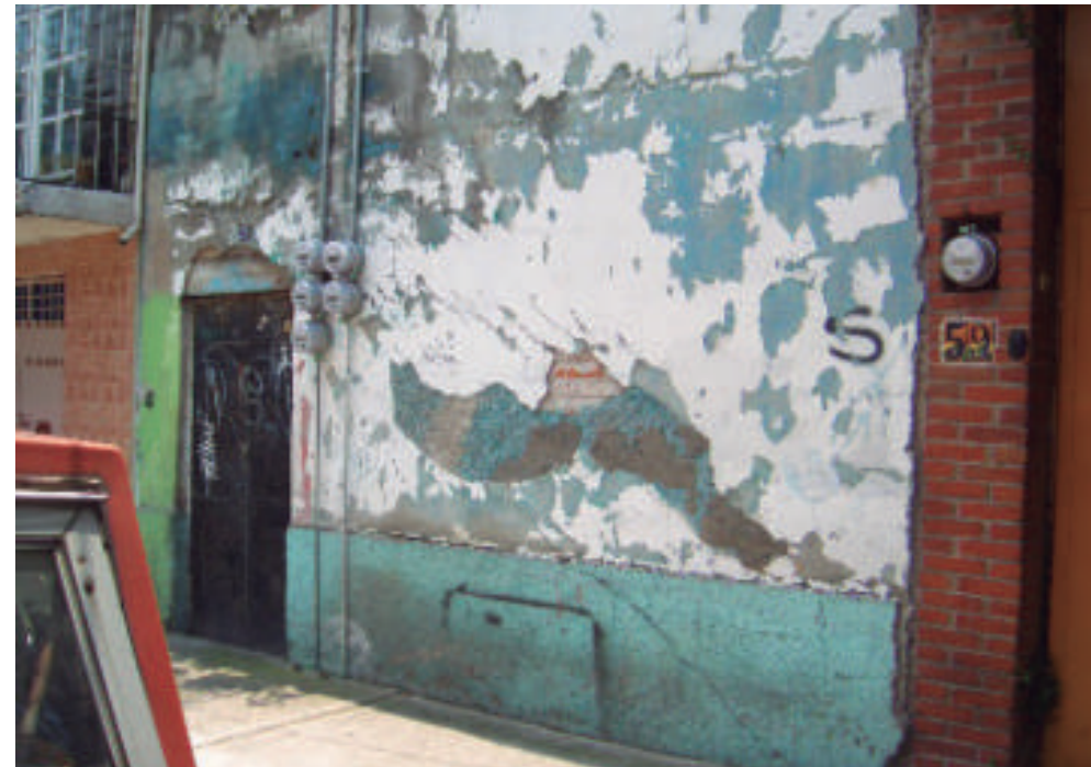
Figura 5.248. Fotografía A de la colonia Magdalena Mixhuca. Vivienda con abundante desprendimiento de material y fracturas en la entrada principal de vivienda (19.4063° N, 99.1159° W. Calle: Platón Sánchez).
