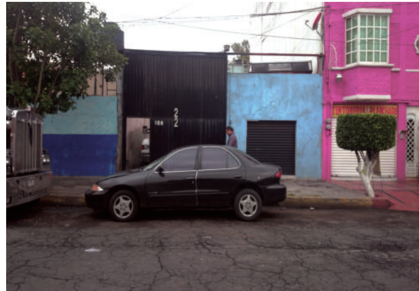
Figura 5.50. Fotografía A de la colonia Ampliación Simón Bolívar. Vivienda que presenta en la fachada exterior múltiples fracturas diagonales y horizontales (19.4474° N, 99.0998° W. Calle: Bolívars).
