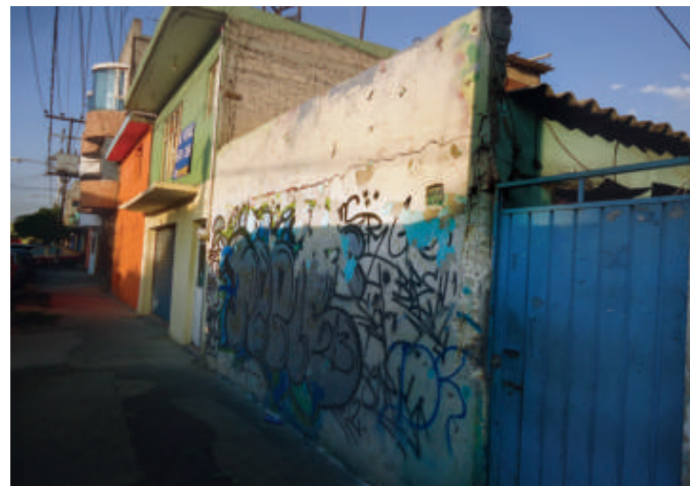
Figura 5.158. Fotografía B de la colonia El Arenal 3.º Sección. Inmueble con fracturas horizontales en la parte superior del muro exterior y desprendimiento de material (19.4264° N, 99.0550° W. Calle: Tonatiuh).
