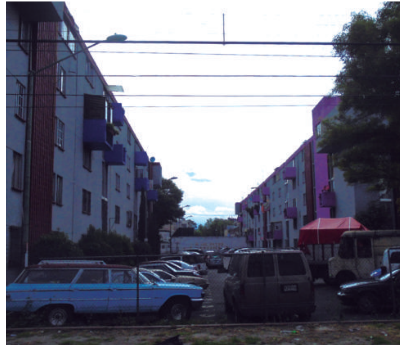
Hundimiento que se presenta en la Unidad Habitacional Candelaria en la colonia Centro
