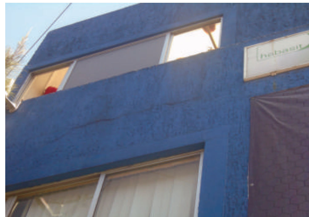
Figura 5.38. Fotografía B de la colonia Felipe Ángeles. Inmueble con una fractura de forma horizontal en la parte intermedia de la construcción (19.4531° N, 99.1118° W. Calle: Aviadero).
