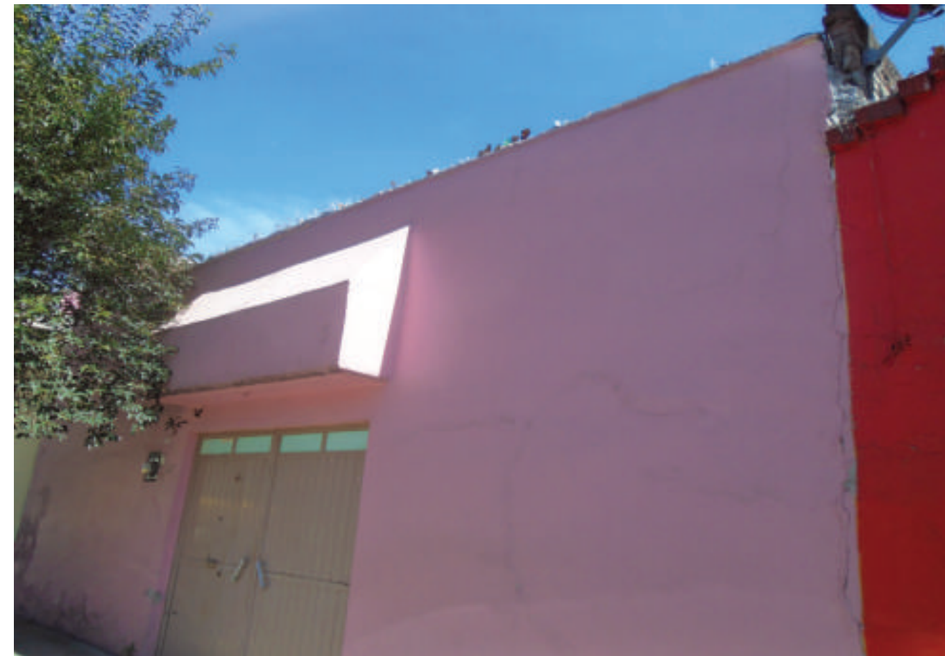
Figura 5.120. Fotografía A de la colonia 10 de Mayo. Vivienda con fracturas a lo largo de su muro exterior (19.4330° N, 99.1165° W. Calle: Tapicería).
