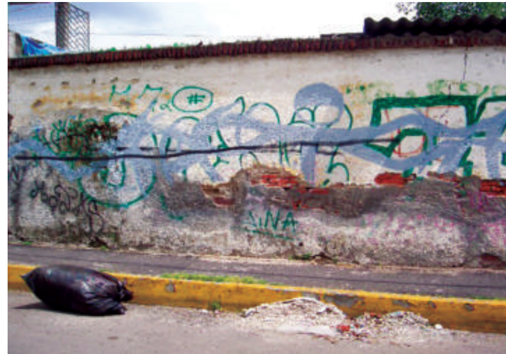
Figura 5.165. Fotografía A de la colonia Cuchilla Pantitlán. Inmueble con fracturamiento y desprendimiento de material ocasionando daños en su estructura (19.4225° N, 99.0677° W. Calle: 1).
