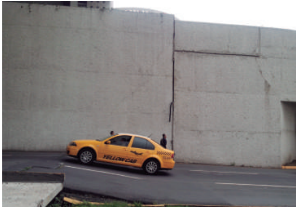
Figura 5.152. Fotografía en la que se observan fracturas diagonales en el muro externo del Aeropuerto, así como un ángulo de inclinación en el pavimento (19.4336° N, 99.0657° W. Aeropuerto Internacional Benito Juárez).
