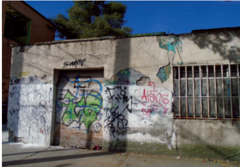
Figura 5.115. Fotografía H de la colonia Penitenciaría. Inmueble con desprendimiento de material y fracturas en su muro exterior (19.4345° N, 99.1156° W. Calle: Ferrocarril interoceánico).
