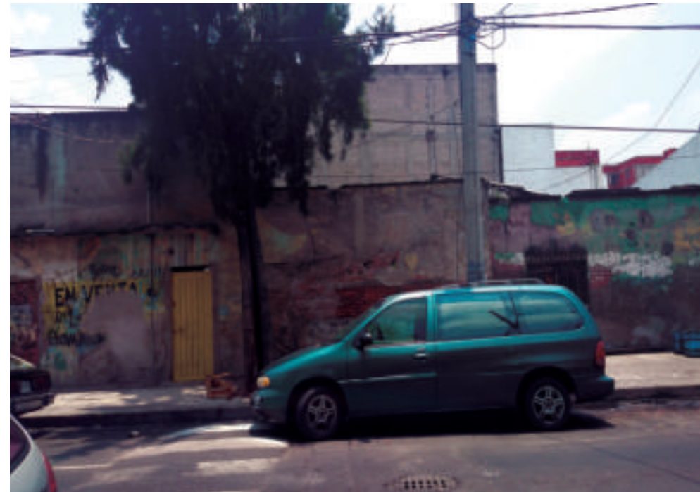
Figura 5.244. Fotografía A de la colonia Artes Gráficas. Vivienda con fracturas y desprendimiento de material en el muro (19.4109° N, 99.1259° W. Calle: Prolongación Roa Bárcenas).
