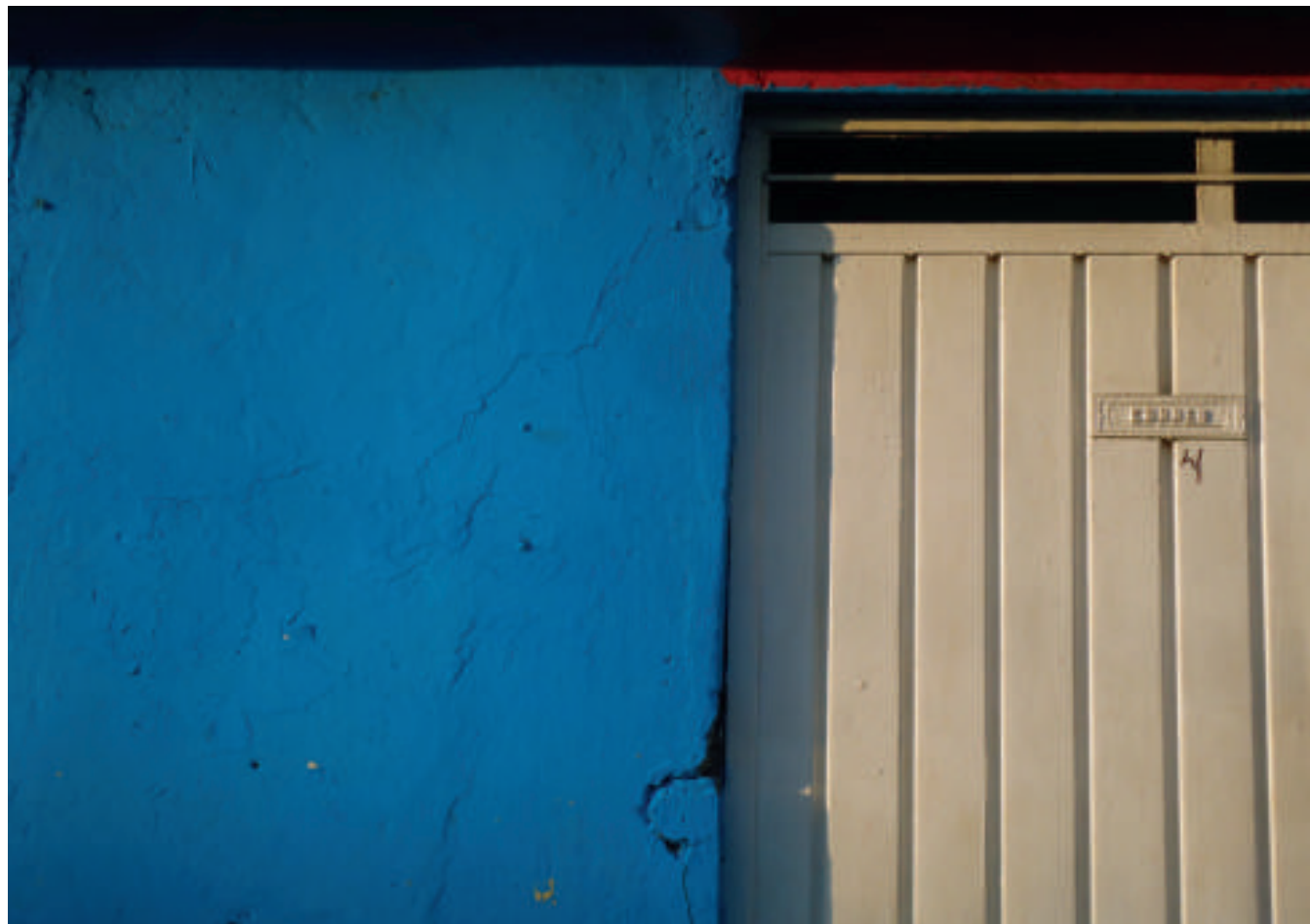
Figura 5.161. Fotografía E de la colonia El Arenal 4.ª Sección. Muro de una vivienda que presenta fracturas a un costado del acceso principal (19.4307° N, 99.0554° W. Calle: Xocoyote).
