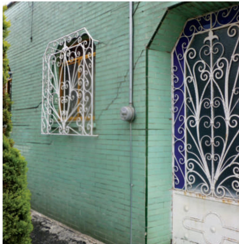
Figura 5.220. Fotografía A de la colonia Moctezuma 1. a Sección. Muro exterior de mampostería con múltiples fracturas en forma diagonal y horizontal (19.4238° N, 99.1008° W. Calle: 18).
