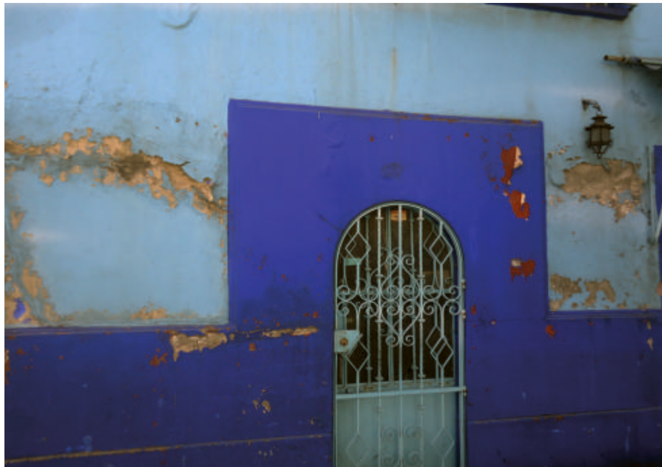
Figura 5.104. Fotografía B de la colonia Venustiano Carranza. Fracturas horizontales y verticales en el muro, así como el desprendimiento de material de construcción (19.4389° N, 99.1095° W. Calle: Floricultura).
