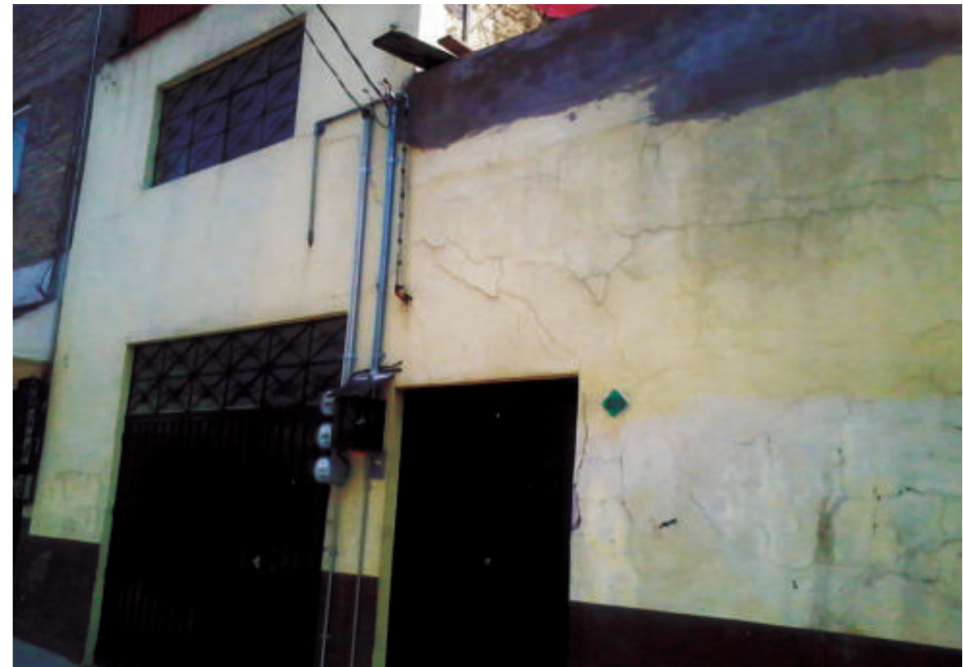
Figura 5.195. Fotografía G de la colonia Puebla. Inmueble con fracturas en el muro, una de ellas va desde la parte inferior de la ventana hacia la puerta de la vivienda (19.4084° N, 99.0850° W. Calle: 63).
