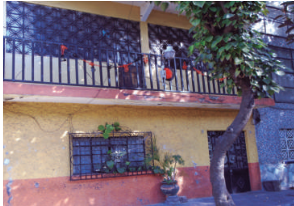
Figura 5.112. Fotografía E de la colonia Ampliación Penitenciaría. Vivienda en la que se observa la losa de marquesina fracturada en forma horizontal, ocasionando desprendimiento de material (19.4346° N, 99.1141° W. Calle: Primera cerrada San Antonio Tomatlán).
