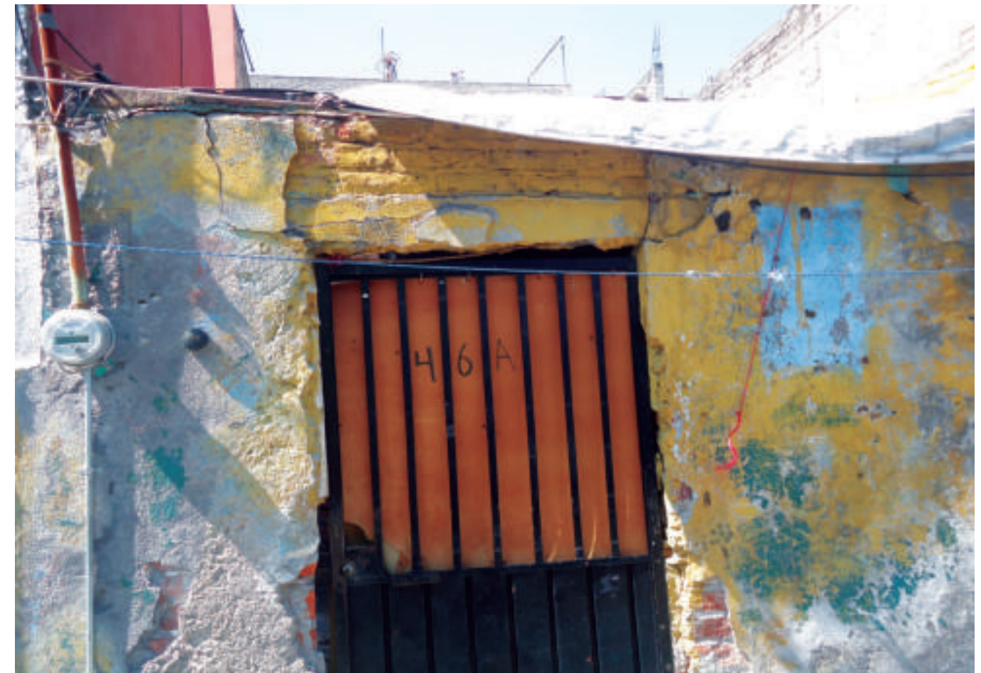
Figura 5.74. Fotografía C de la colonia Ampliación Venustiano Carranza. Construcción con fracturas verticales y horizontales alrededor de la entrada así como desprendimiento del material de construcción (19.4418° N, 99.1060° W. Calle: Cantería).
