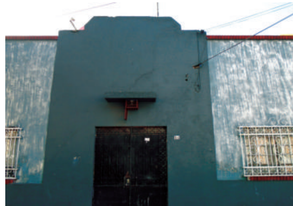
Figura 5.108. Fotografía A de la colonia Penitenciaría. Inmueble con fracturas en la parte superior de la fachada (19.4362° N, 99.1175° W. Calle: Sastrería).
