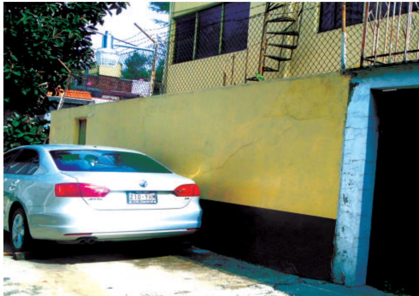
Figura 5.217. Fotografía B de la colonia Jardín Balbuena. Muro exterior de un inmueble afectado por fracturas diagonales (19.4164° N, 99.1045° W. Calle: Retorno 1 de Fernando I. Calderón).
