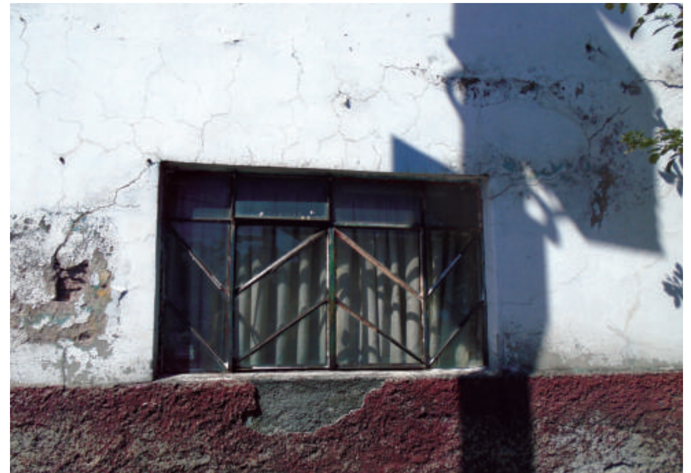
Figura 5.239. Fotografía A de la colonia 24 de Abril. Vivienda con desprendimiento de material y fracturas en el muro exterior (19.4158° N, 99.1162° W. Calle: Oriente 42).
