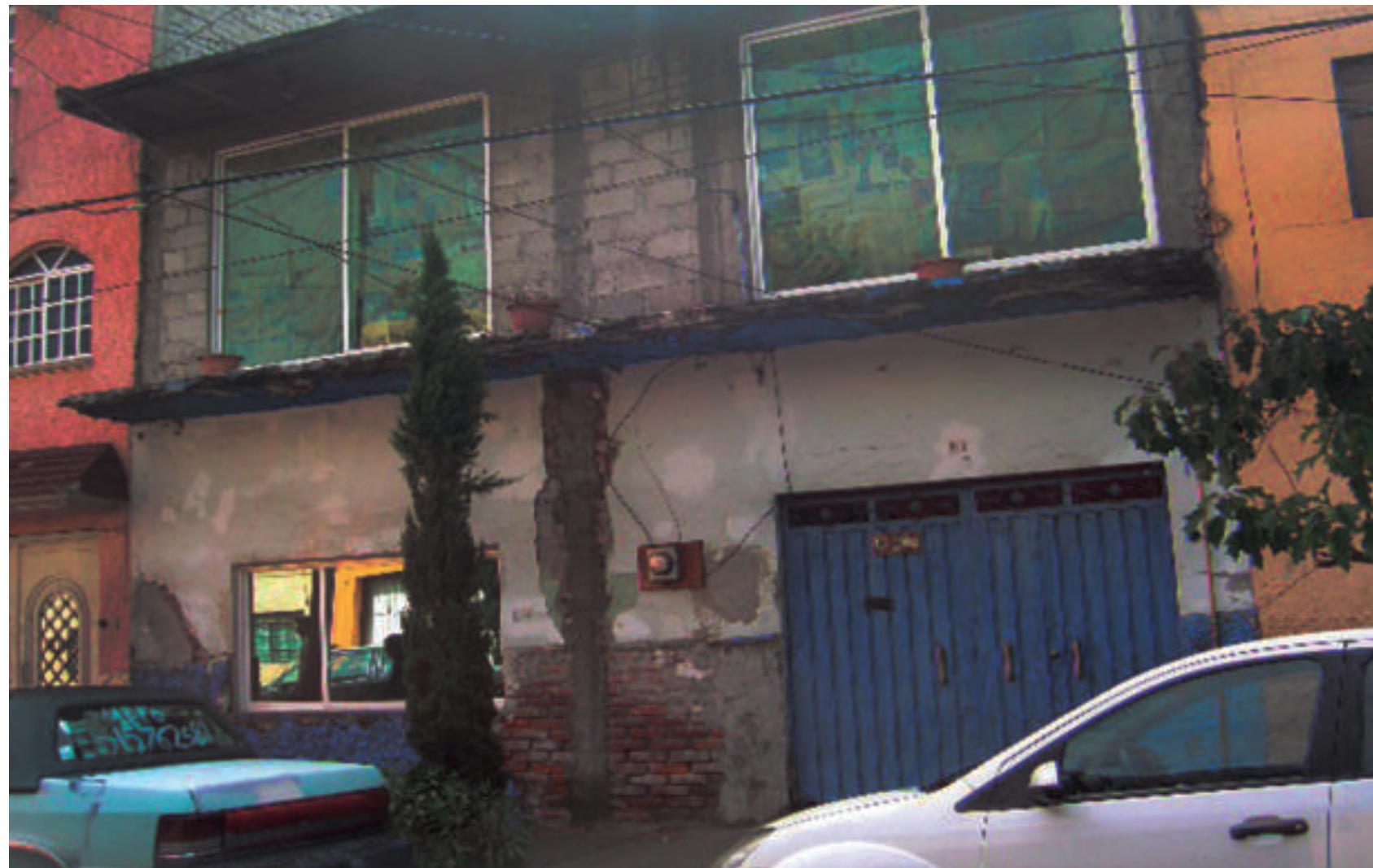
Figura 5.68. Fotografía B de la colonia 1.º de Mayo. Vivienda con daños en su estructura, deterioro de su acabado y desprendimiento de los mismos (19.4463° N, 99.1020° W. Calle: José Stalin).
