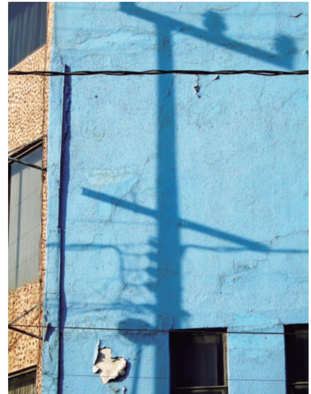
Figura 5.97. Fotografía D de la colonia Ampliación 20 de Noviembre. Construcción con fracturas y desprendimiento de material (19.4407° N, 99.1139° W. Calle: Hortelanos).
