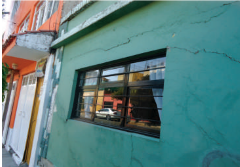
Figura 5.176. Fotografía F de la colonia Caracol. Fracturas verticales, horizontales y diagonales en el muro exterior de una vivienda (19.4267° N, 99.0665° W. Calle: Tiburón).
