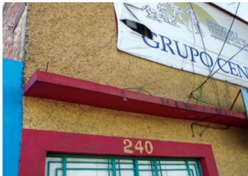
Figura 5.95. Fotografía B de la colonia Ampliación 20 de Noviembre. Inmueble con fracturas en sus dos niveles de construcción (19.4417° N, 99.1135° W. Calle: Ingeniero Eduardo Molina).
