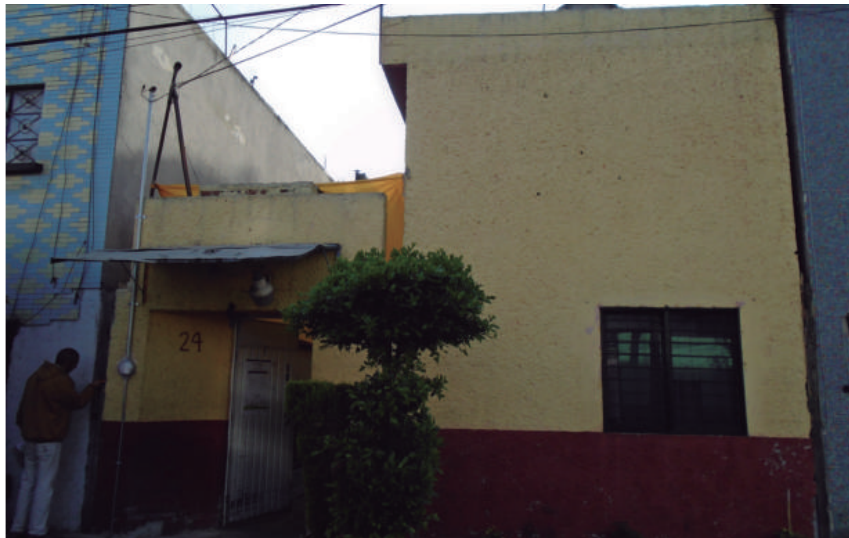
Figura 5.96. Fotografía C de la colonia Ampliación 20 de Noviembre. Vivienda en la que se observa la separación de la junta constructiva (19.4413° N, 99.1143° W. Calle: Zapatería).
