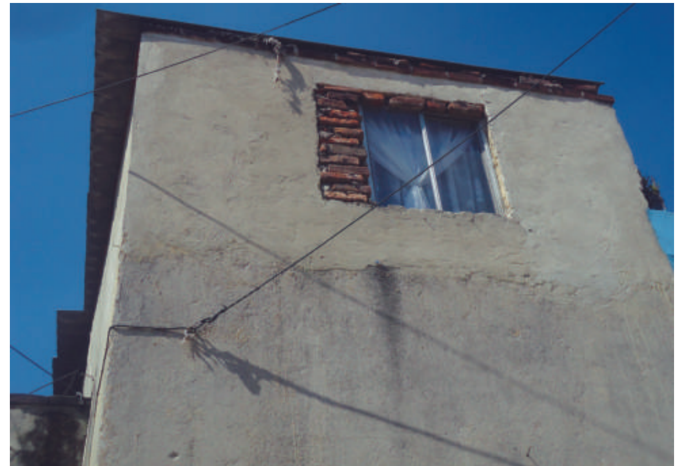
Figura 5.135. Fotografía A de la colonia Azteca. Se observa el mal empleo de un procedimiento constructivo en la ventana de la vivienda, así como pequeñas fracturas en la parte superior de la misma (19.4376° N, 99.1073° W. Calle: Pirotecnia).
