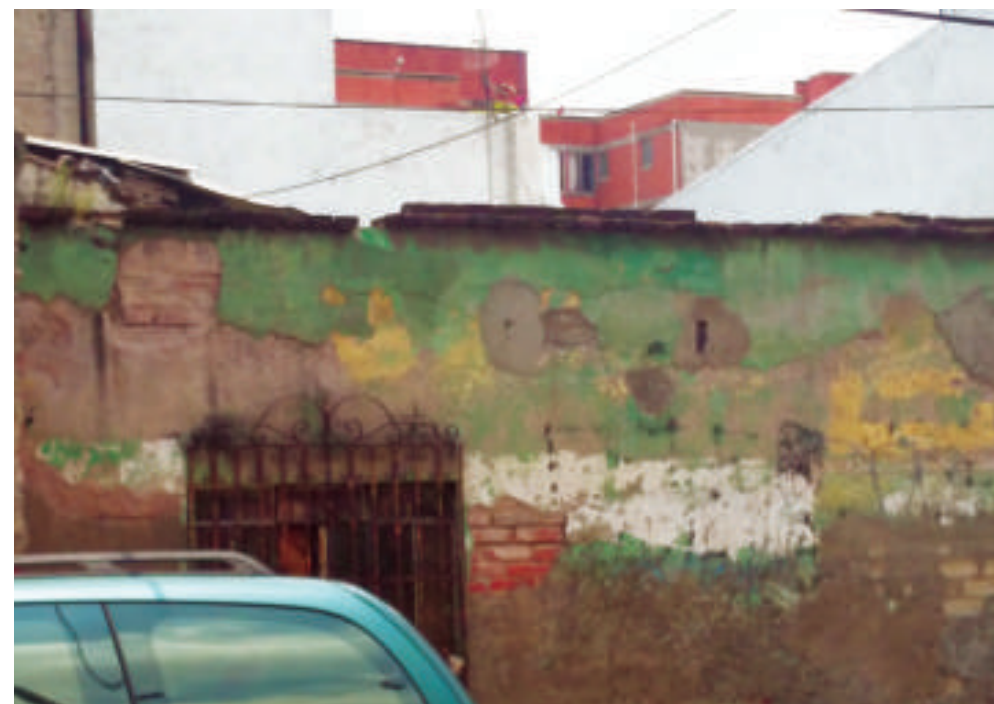
Figura 5.245. Fotografía B de la colonia Artes Gráficas. Vivienda con fracturas en la parte superior del muro así como desprendimiento de material (19.4109° N, 99.1258° W. Calle: Prolongación Roa Bárcenas).
