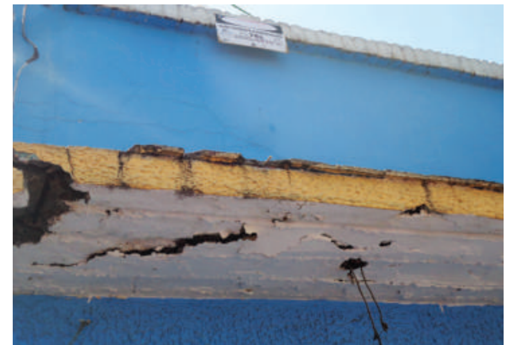
Figura 5.175. Fotografía E de la colonia Caracol. Inmueble en el que se observa desprendimiento de material y fracturas en la parte superior del muro (19.4246° N, 99.0678° W. Calle: Ostión).
