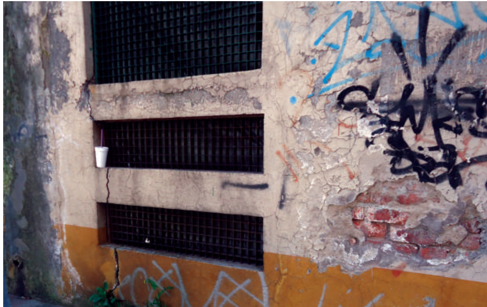
Figura 5.212. Fotografía B de la colonia San Cruz Aviación. Construcción con presencia de fracturas y desprendimiento de material en el muro (19.4219° N, 99.0960° W. Calle: 23).
