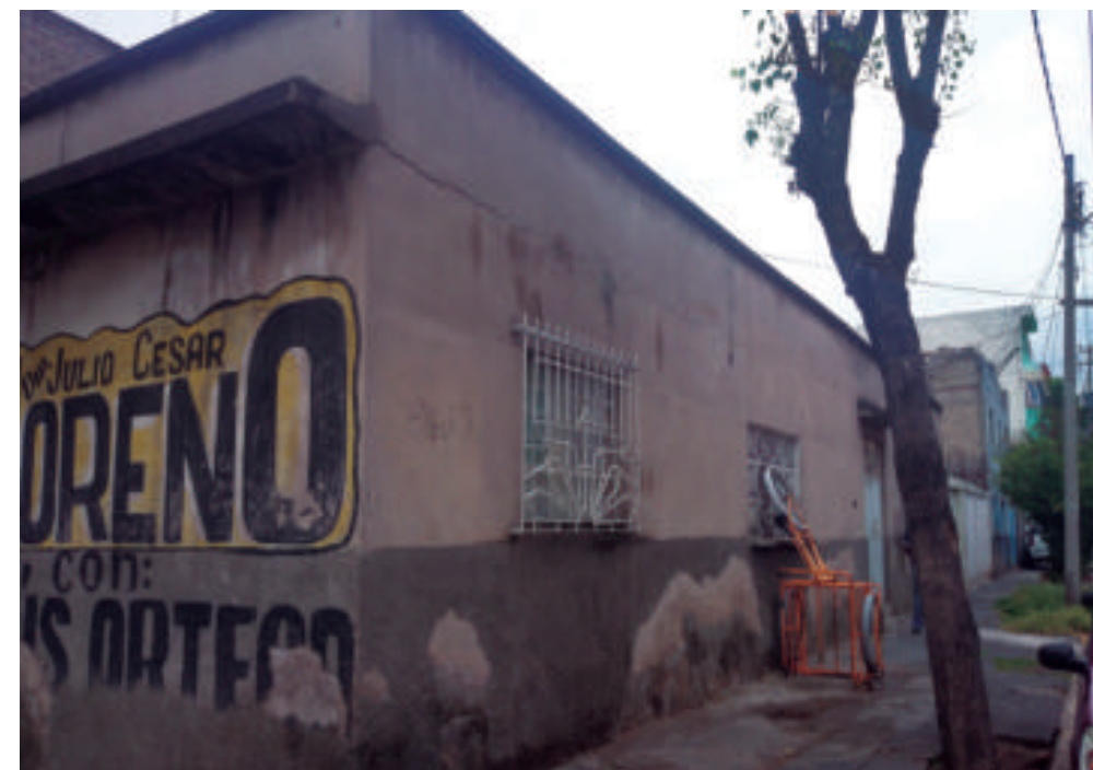
Figura 5.60. Fotografía B de la colonia Aquiles Serdán. Vivienda con fracturas horizontales en la parte superior (19.4448° N, 99.0917° W. Calle: Balboas).
