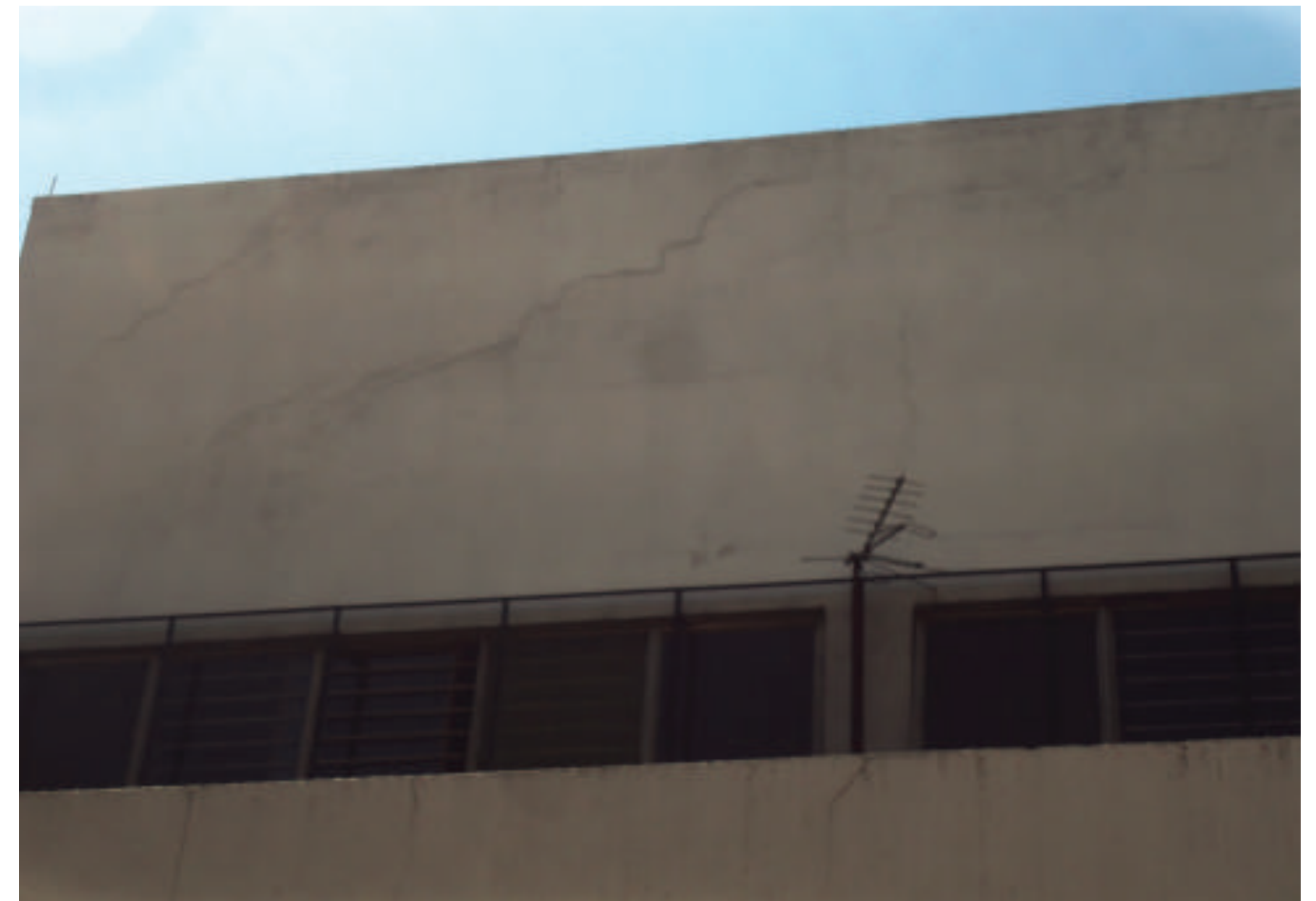
Figura 5.211. Fotografía A de la colonia Santa Cruz Aviación. Construcción con fracturas en su parte superior (19.4223° N, 99.0980° W. Calle: Recreo).
