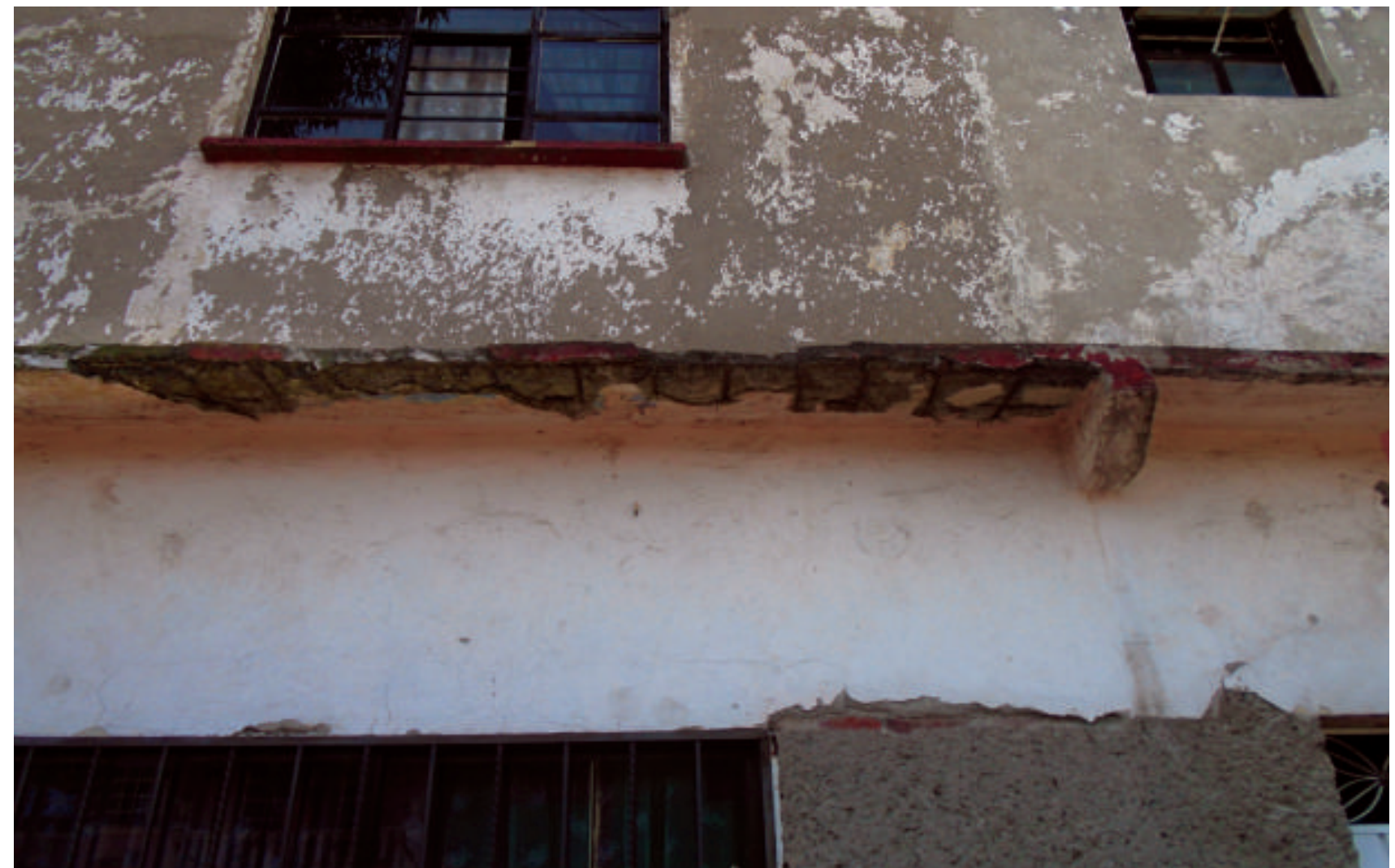
Figura 5.122 Fotografía C de la colonia 10 de Mayo. Vivienda con desprendimiento de material exponiendo el armado de la construcción (19.4326° N, 99.1178° W. Calle: Sastrería).
