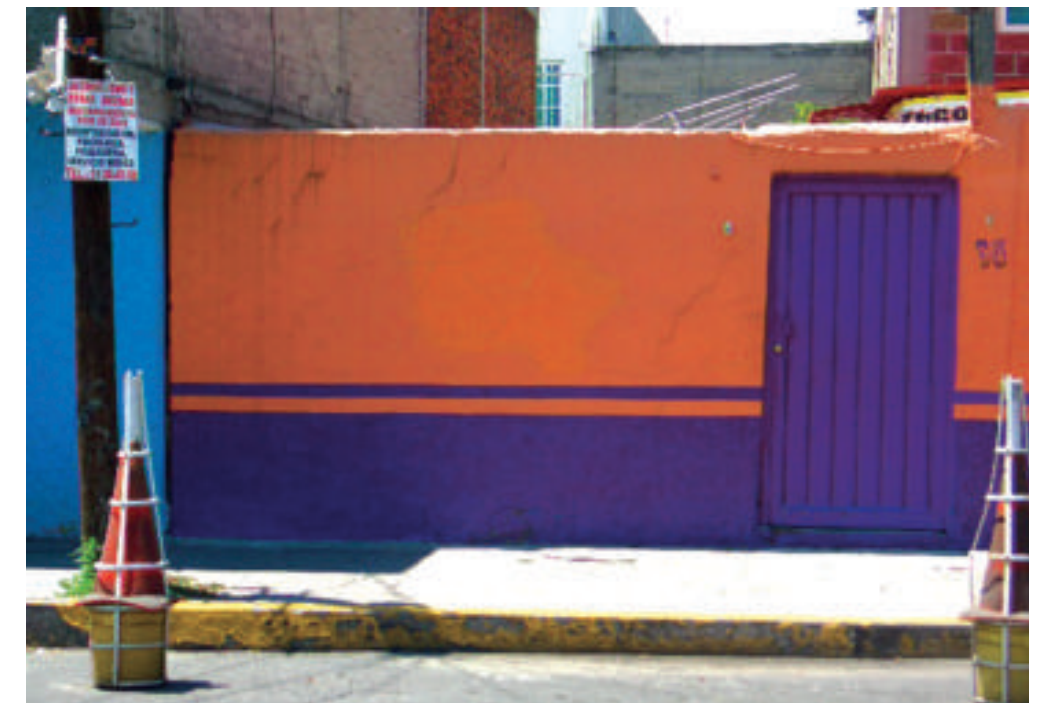
Figura 5.181. Fotografía K de la colonia Adolfo López Mateos. Vivienda con presencia de fracturas verticales en su muro, así como una ligera separación en la junta constructiva (19.4229° N, 99.0707° W. Calle: Pulpo).
