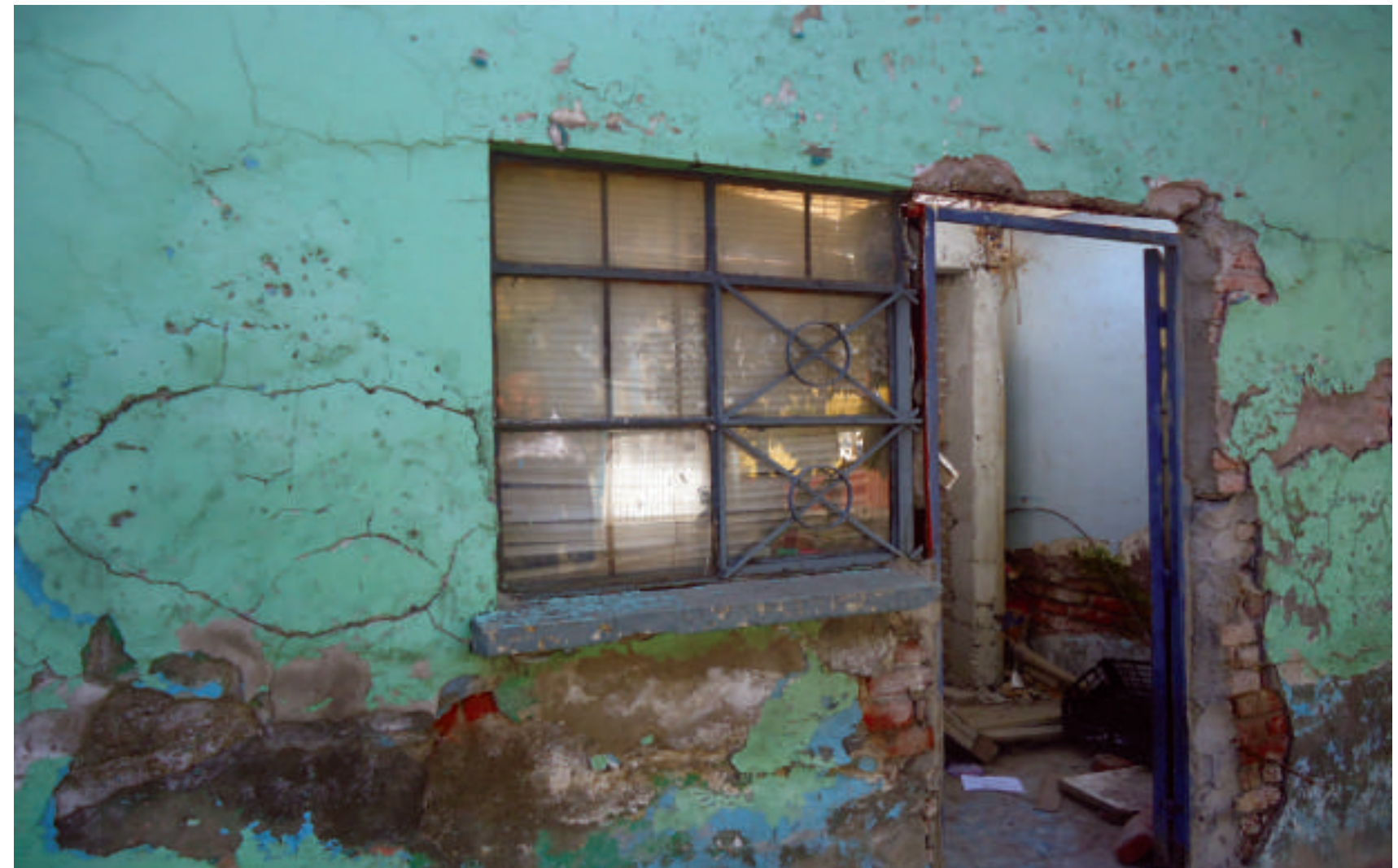
Figura 5.208. Fotografía C de la colonia Ignacio Zaragoza. Inmueble dañado con diversas fracturas en el muro así como con desprendimiento de material (19.4111° N, 99.0863° W. Calle: 53).
