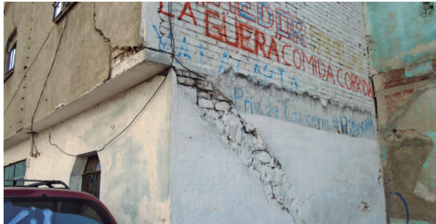
Vivienda afectada con múltiples fracturas en la colonia Penitenciaría.
