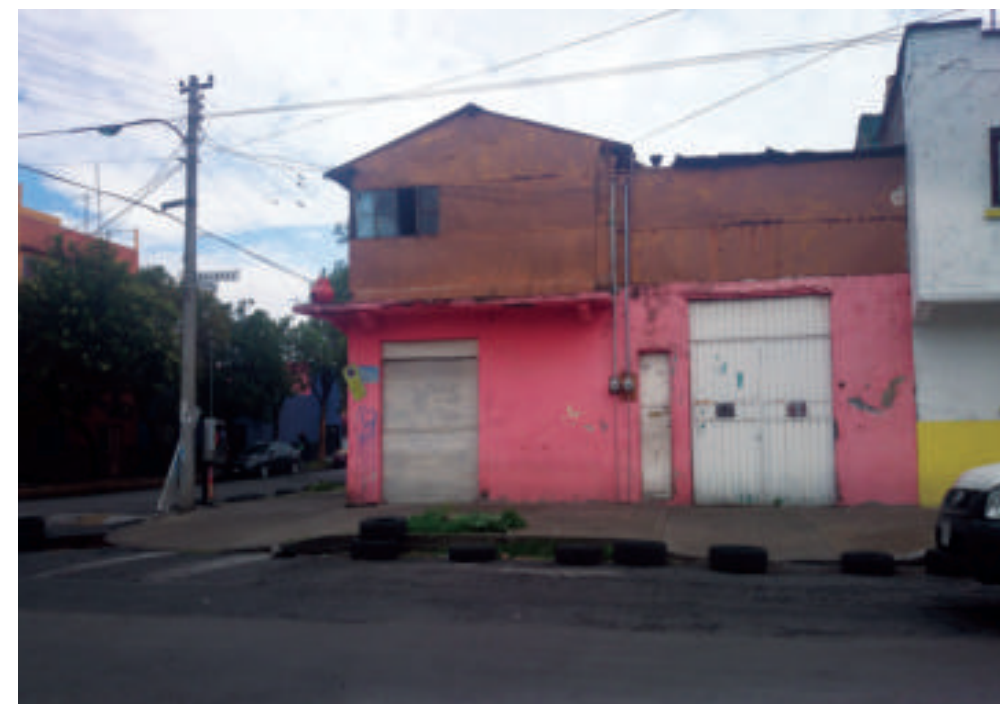
Figura 5.56. Fotografía B de la colonia Simón Bolívar. Inmueble de dos niveles en el que se observan fracturas y desprendimiento de material (19.4471° N, 99.0992° W. Calle: Carlos Marx).
