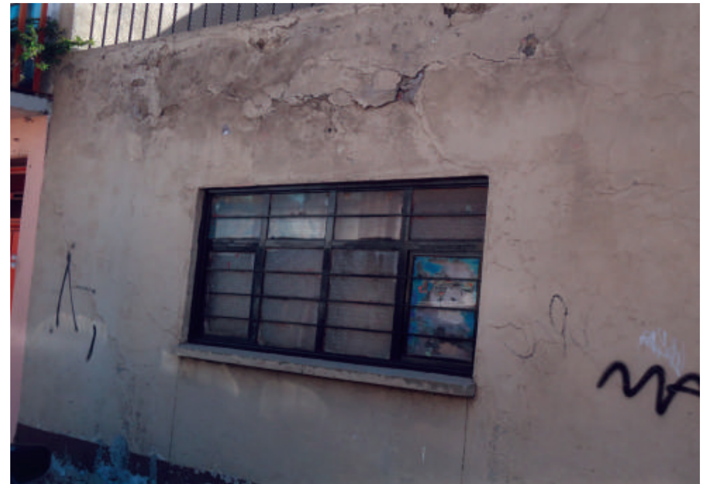
Figura 5.184. Fotografía A de la colonia Aviación Civil. Vivienda con fracturas principalmente en la parte superior de la construcción, lo que ocasiona el desprendimiento de material (19.4128° N, 99.0765° W. Calle: Simón Audenaro).
