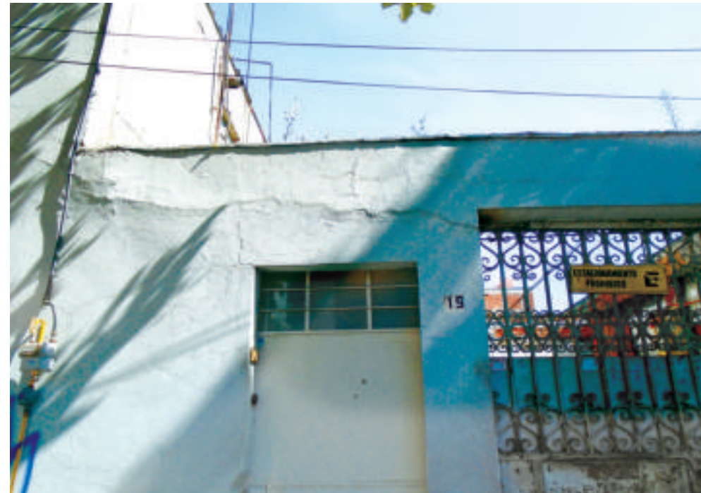
Figura 5.17. Fotografía A de la colonia Popular Rastro. Inmueble con fracturas en la parte superior de la construcción (19.4518° N, 99.1207° W. Calle: Aluminio).
