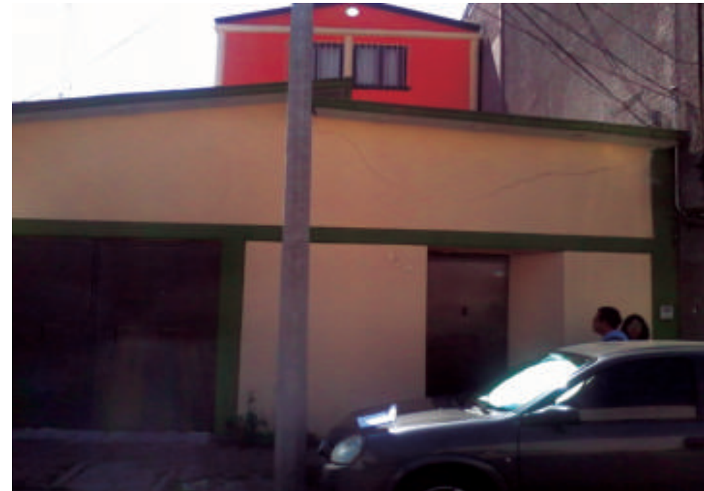
Figura 5.37. Fotografía A de la colonia Felipe Ángeles. Inmueble con fracturas diagonales en la parte superior de la fachada (19.4534° N, 99.1128° W. Calle: Cieneguillas).
