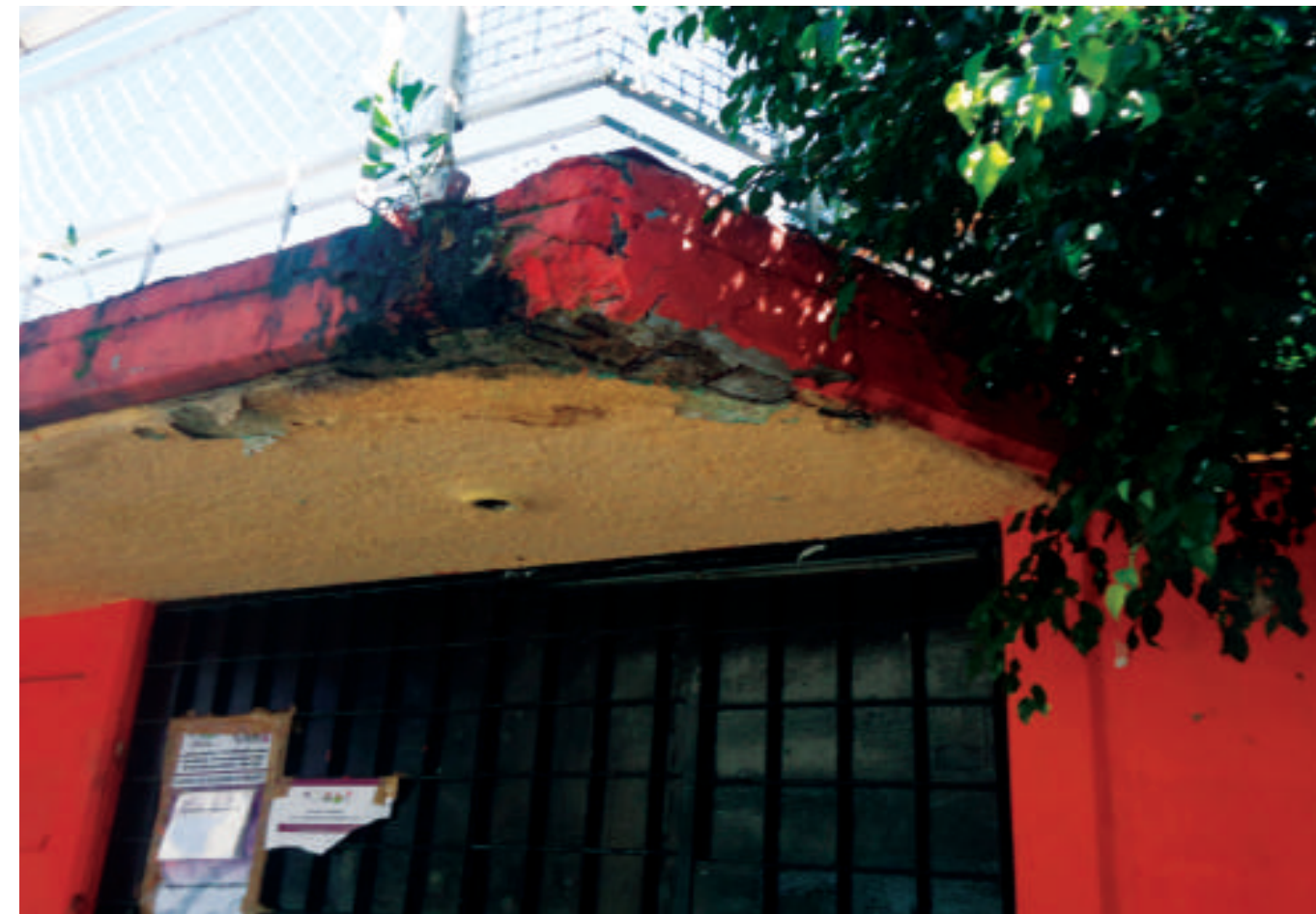
Figura 5.72. Fotografía A de la colonia Tres Mosqueteros. Fracturas y desprendimiento del material de construcción lo cual afecta la estructura de la escuela (19.4402° N, 99.1063° W. Calle: Cantería).
