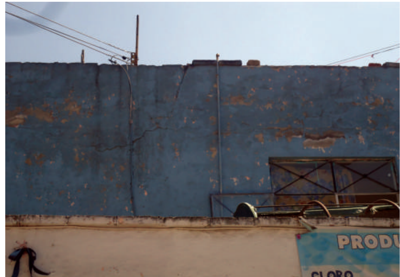
Figura 5.137. Fotografía C de la colonia Azteca. Se observa el segundo nivel de una vivienda con presencia de fracturas (19.4377° N, 99.1074° W. Calle: Vidriería).
