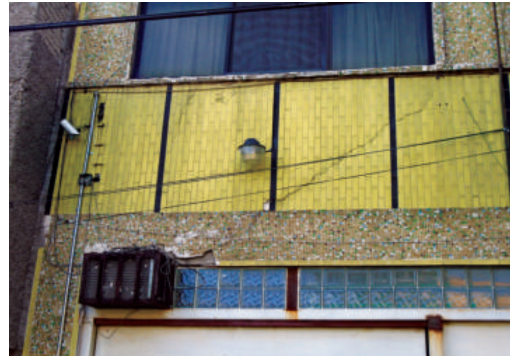
Figura 5.84. Fotografía A de la colonia Ampliación Michoacana. Fractura diagonal y desprendimiento del material de la construcción (19.4474° N, 99.1125° W. Calle: Maravillas).
