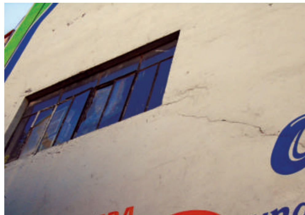
Figura 5.18. Fotografías B de la colonia Popular Rastro. Inmueble con fracturas en la parte inferior de la ventana (19.4517° N, 99.1181° W. Calle: Aluminio).
