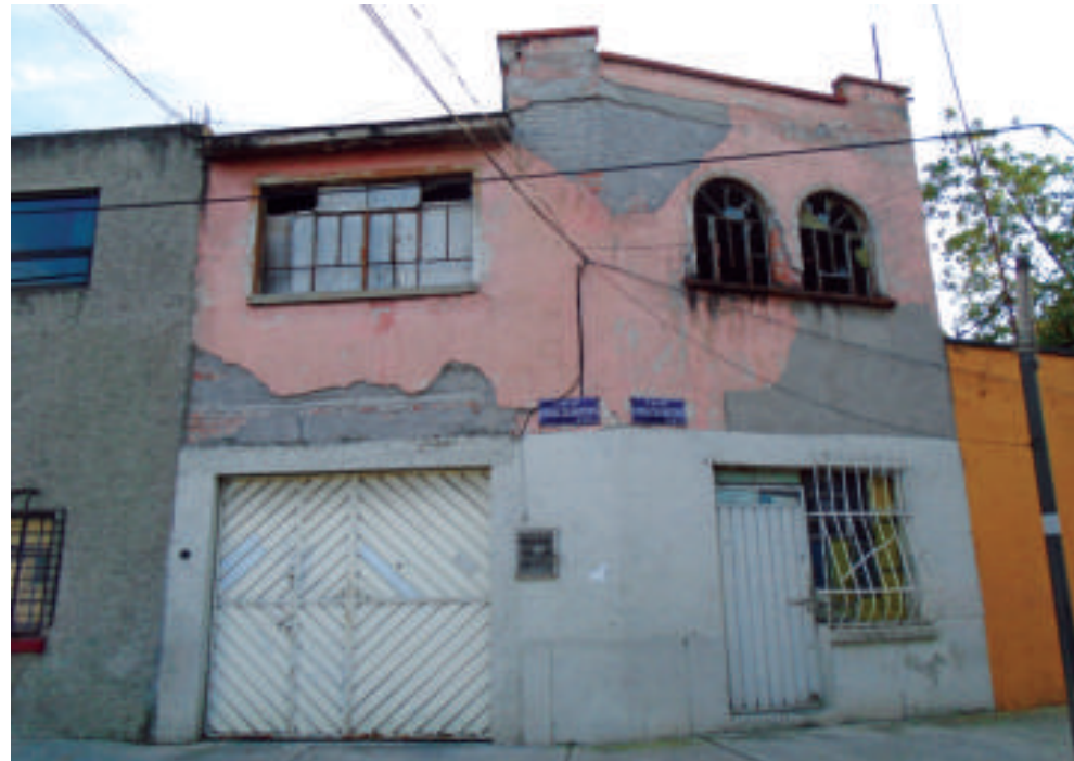
Figura 5.21. Fotografía A de la colonia Emilio Carranza. Vivienda de mampostería semiconfinada que presenta daños en su acabado, fracturas horizontales en la parte superior y desprendimiento de material (19.4504° N, 99.1201° W. Calle: Central de Talabarteros).
