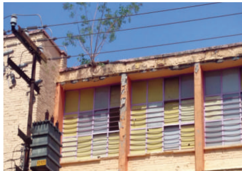
Figura 5.91. Fotografía B de la colonia Michoacana. Muestra el desprendimiento de material del muro externo de la escuela (19.4470° N, 99.1160° W. Calle: Plomeros).
