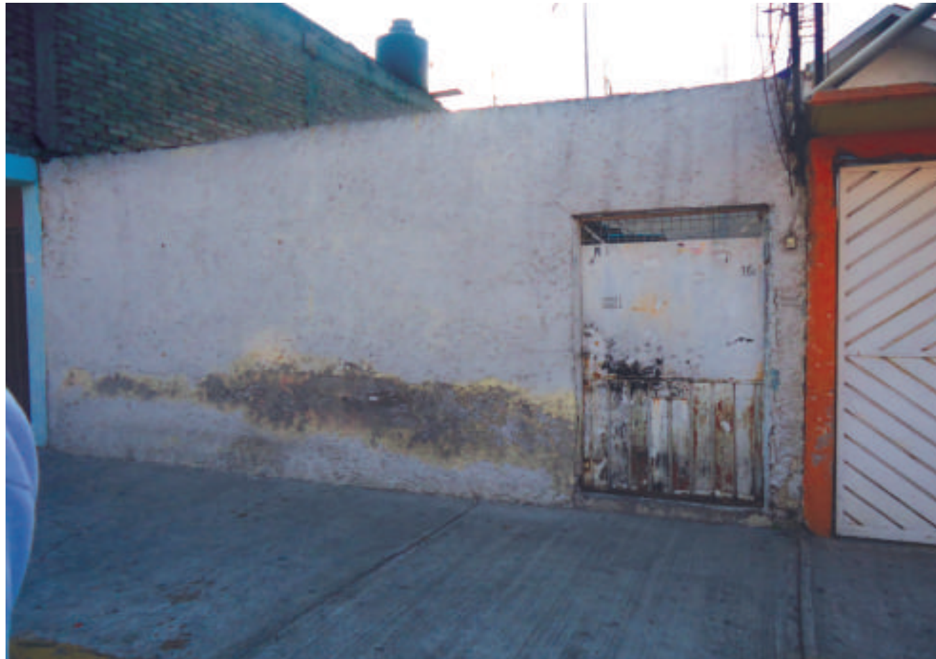
Figura 5.159. Fotografía C de la colonia El Arenal 3.ª Sección. Vivienda con fracturas y desprendimiento de material (19.4274° N, 99.0552° W. Calle: Tonatiuh).
