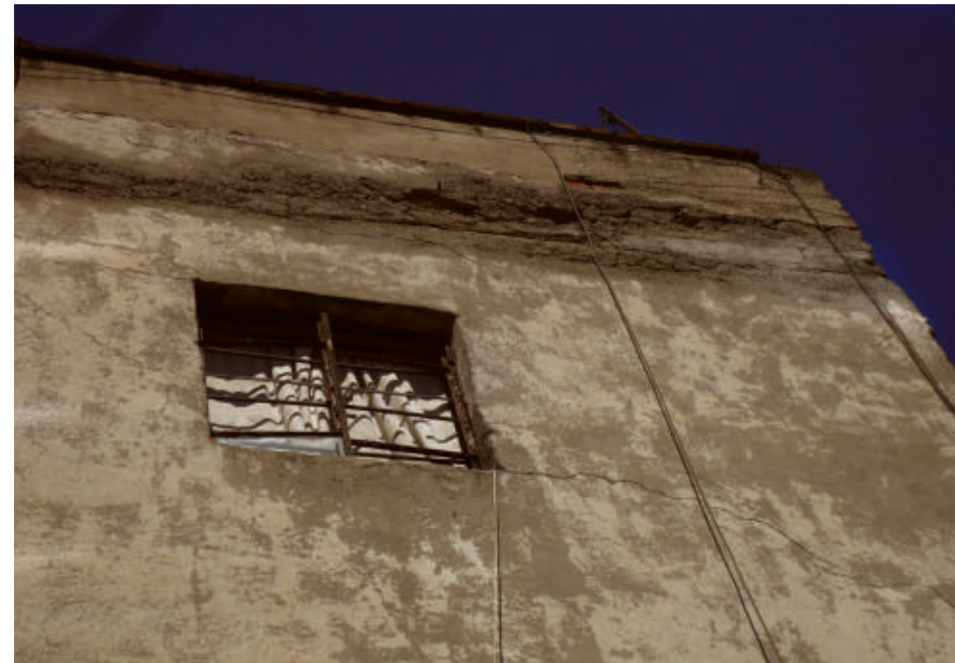
Figura 5.103. Fotografía A de la colonia Venustiano Carranza. Fracturas diagonales y horizontales principalmente en la parte superior de la construcción (19.4391° N, 99.1095° W. Calle: Floricultura).
