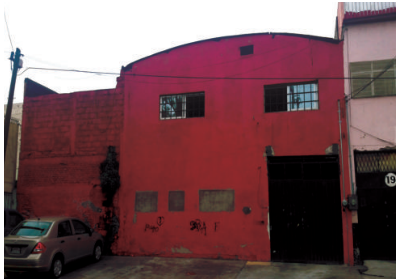
Figura 5.51. Fotografía B de la colonia Ampliación Simón Bolívar. Bodega que presenta fracturas en forma diagonal y vertical en la parte superior, así como entre las ventanas debido a la falta de refuerzos (19.4484° N, 99.0999° W. Calle: Coronas).
