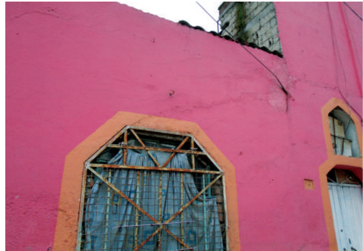
Figura 5.127. Fotografía C de la colonia Progresista. Fracturas en el muro exterior de una vivienda, ocasionadas por un mal confinamiento (19.4367° N, 99.1080° W. Calle: Rueda Quijano).
