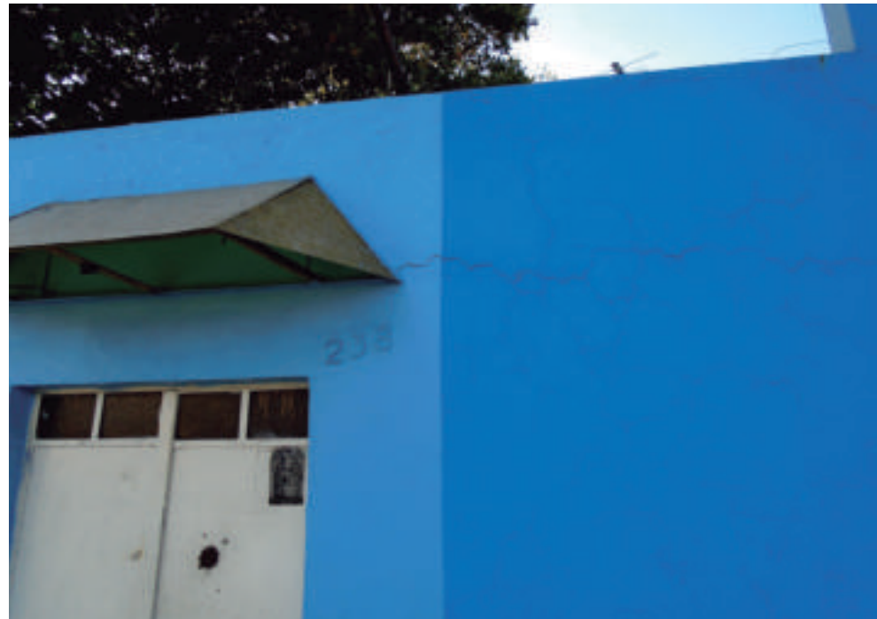
Figura 5.94. Fotografía A de la colonia Ampliación 20 de Noviembre. Inmueble con fracturas en su muro exterior (19.4416° N, 99.1135° W. Calle: Ingeniero Eduardo Molina).
