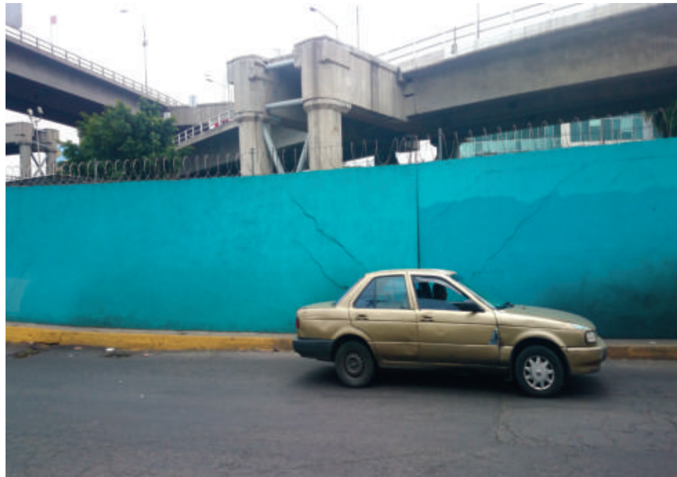
Figura 5.224. Fotografía B de la colonia Aeronáutica Militar. Muro afectado por fracturamiento (19.4274° N, 19.4274° W. Calle: Calzada Ignacio Zaragoza).
