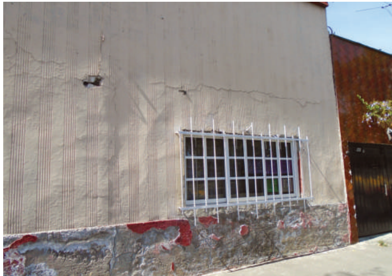
Figura 5.42. Fotografía B de la colonia 2.º Tramo 20 de Noviembre. Inmueble con desprendimiento en los materiales que conforman la fachada exterior, así como fracturas horizontales, verticales y diagonales (19.4511° N, 99.1059° W. Calle: Grabados).
