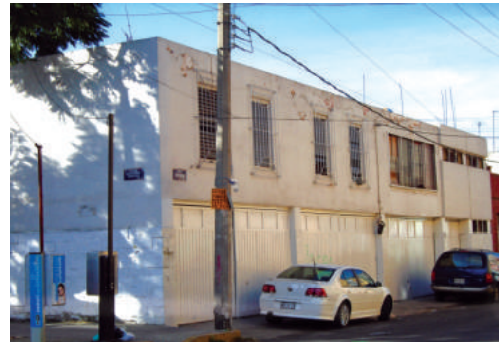
Figura 5.117. Fotografía J de la colonia Penitenciaría. Inmueble con fracturas en muros del segundo nivel alrededor de las ventanas, debido a un mal confinamiento (19.4348° N, 99.1171° W. Calle: Curtiduría).
