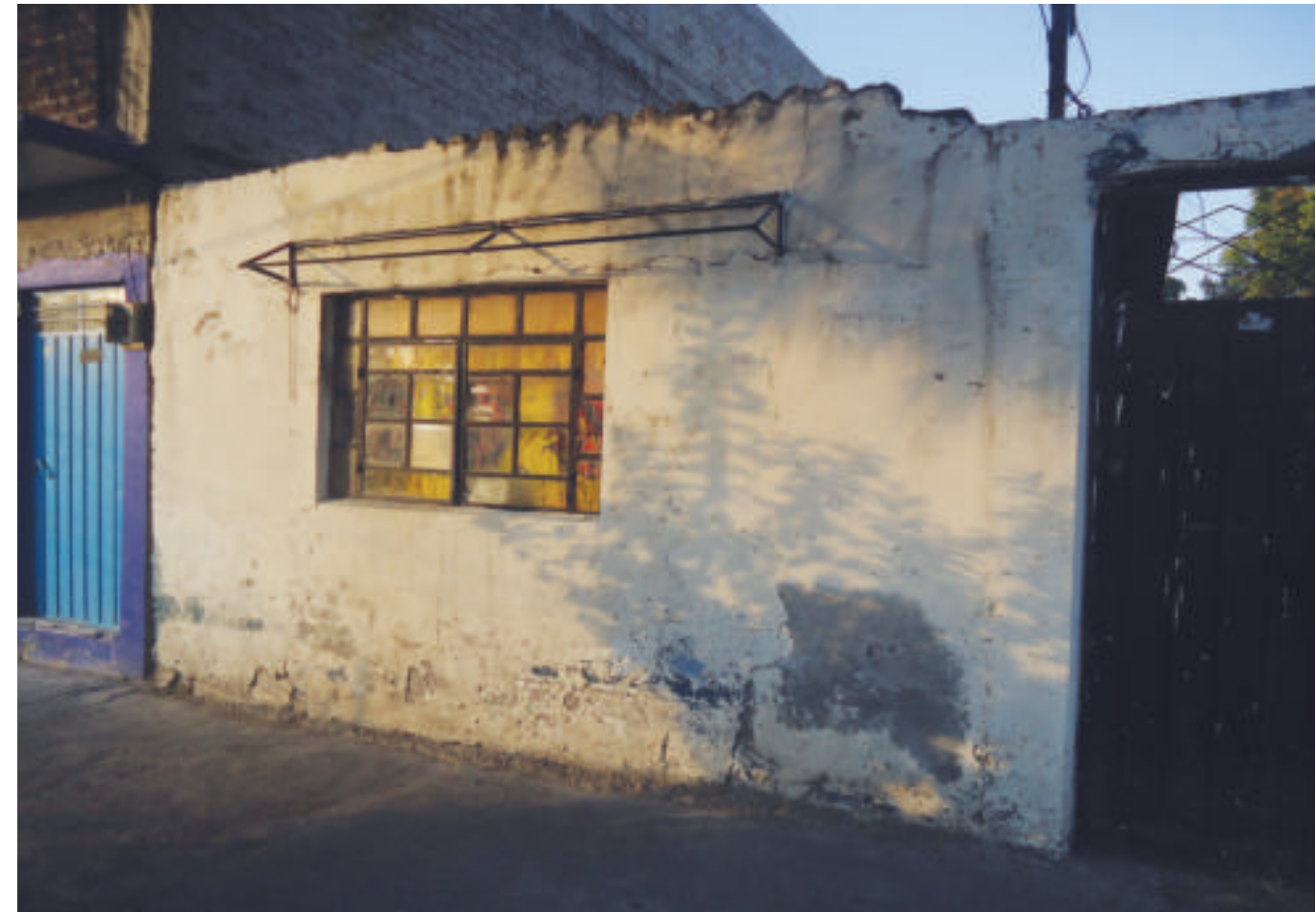
Figura 5.160. Fotografía D de la colonia El Arenal 4.ª Sección. Vivienda con desprendimiento de material y fracturamiento en su muro exterior (19.4306° N, 99.0546° W. Calle: Xocoyote).
