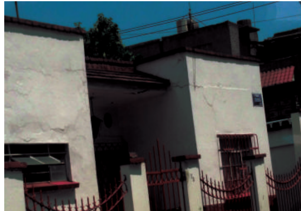
Figura 5.90. Fotografía A de la colonia Michoacana. Vivienda semiconfinada con fracturas horizontales y diagonales en el muro externo (19.4467° N, 99.1120° W. Calle: Plomeros).
