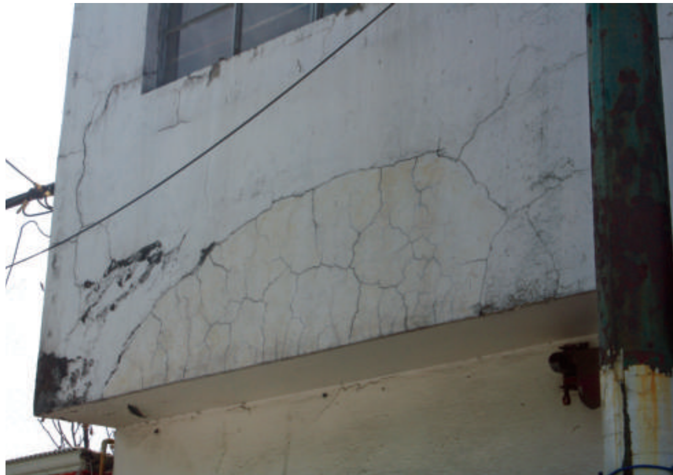
Figura 5.235. Fotografía B de la colonia Merced Balbuena. Se observa el muro de una vivienda afectado por fracturas (19.4200° N, 99.1236° W. Calle: Oriente 30).
