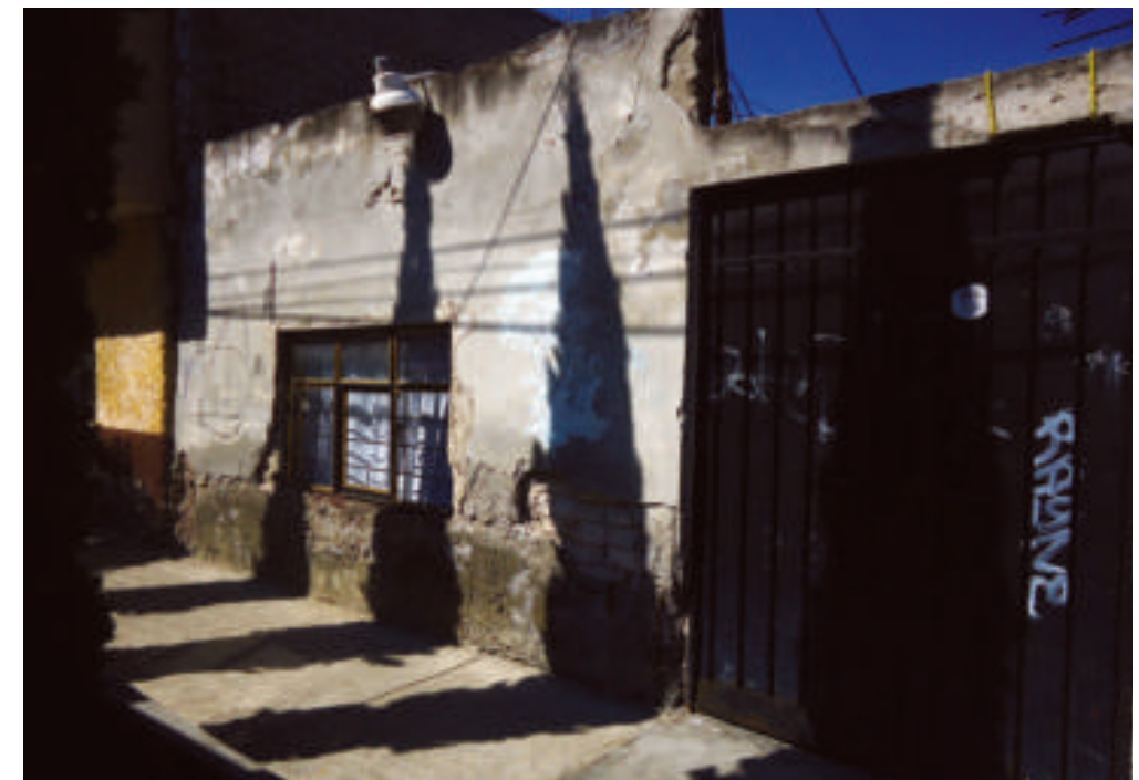
Figura 5.178. Fotografía H de la colonia Ampliación Caracol. Vivienda con fracturas en su muro exterior ocasionando desprendimiento de material (19.4284° N, 99.0650° W. Calle: Manuel Ávila Camacho).
