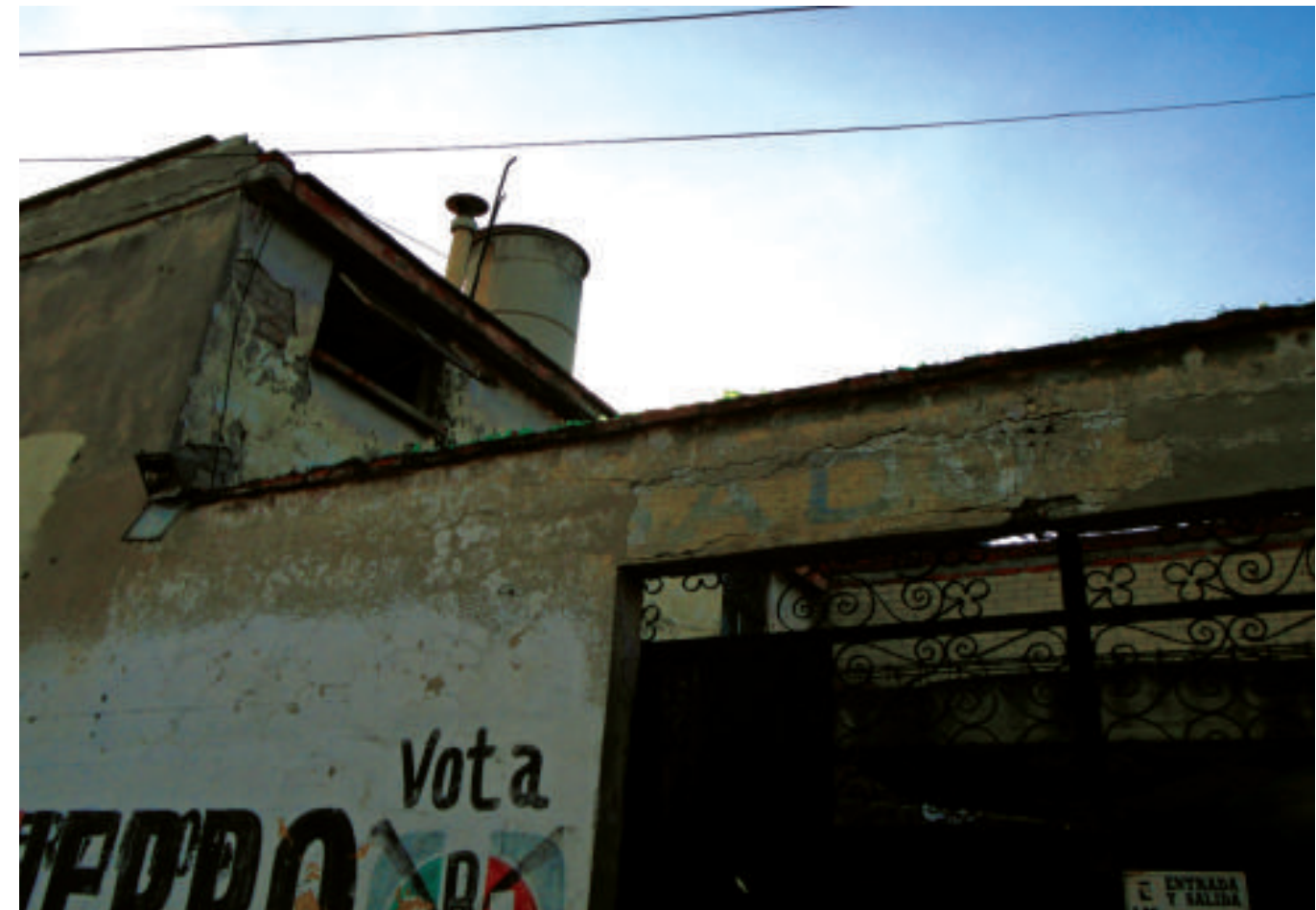
Figura 5.87. Fotografía D de la colonia Ampliación Michoacana. Inmueble con fracturas en la parte superior del muro externo y desprendimiento de material de construcción (19.4478° N, 99.1154° W. Calle: Platería).
