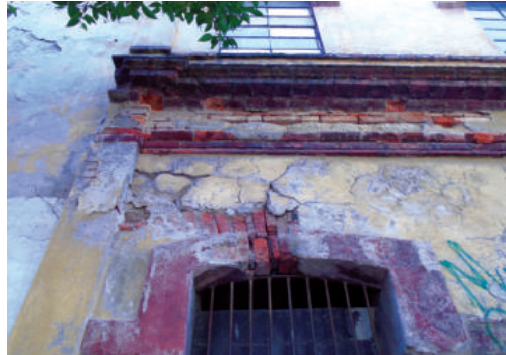
Figura 5.13. Fotografía A de la colonia Nicolás Bravo. Muro de un inmueble dañado por fracturas y desprendimiento de material (19.4534° N, 99.1223° W. Calle: Cobre).
