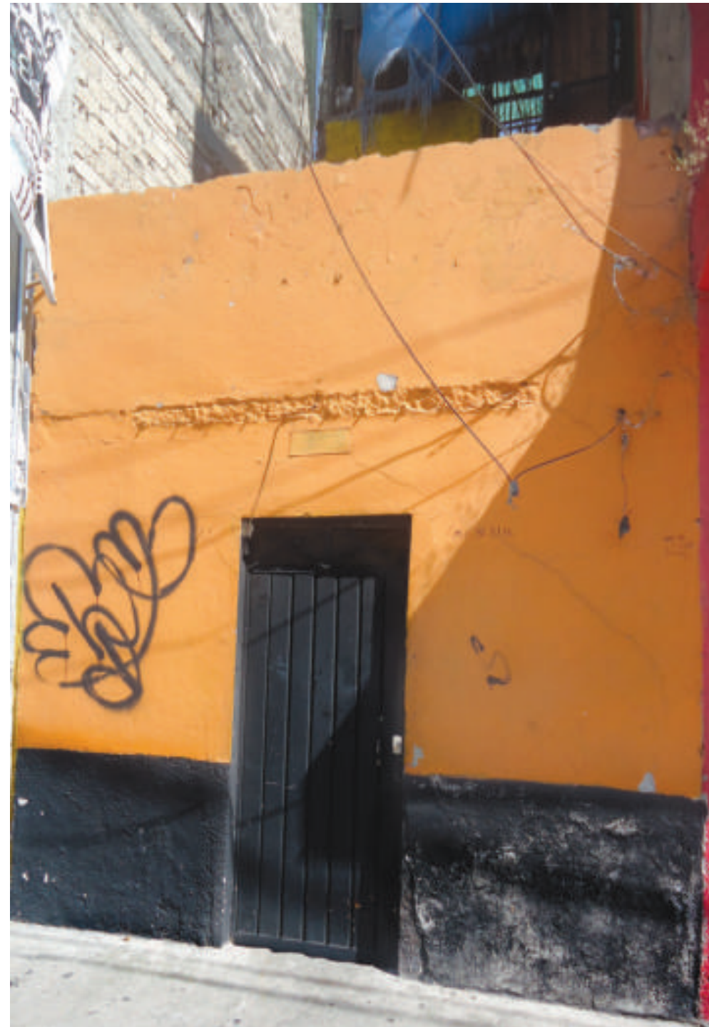
Figura 5.172. Fotografía B de la colonia Adolfo López Mateos. Inmueble con fracturas en su muro (19.4200° N, 99.0718° W. Calle: Fernando Román Lugo).
