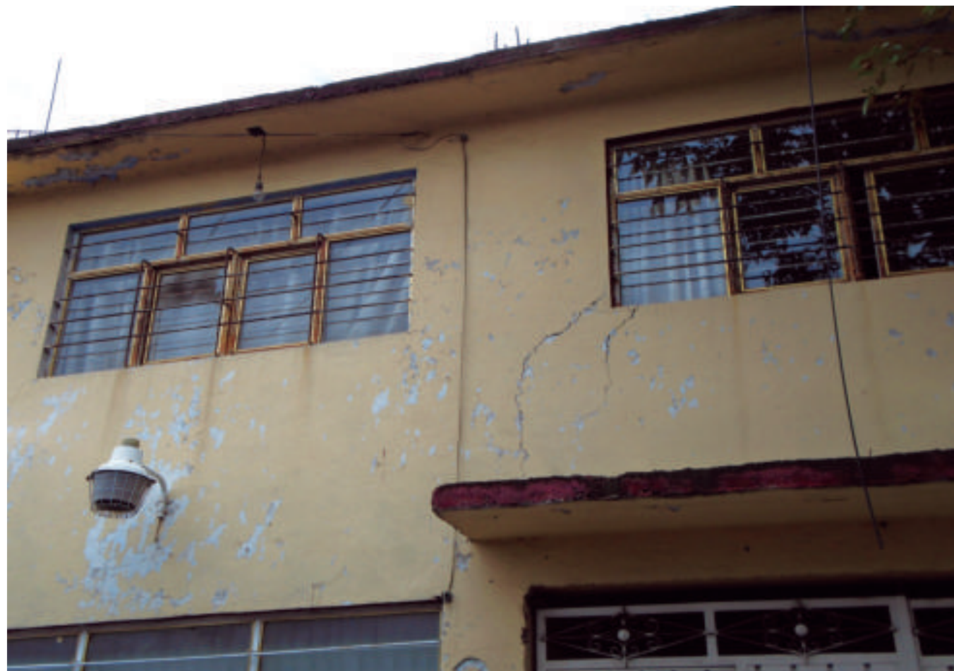
Figura 5.131. Fotografía B de la colonia Revolución. Inmueble con fracturas verticales y desprendimiento de material en el nivel superior de la construcción (19.4391° N, 99.1032° W. Calle: Coronel Darío Garza).
