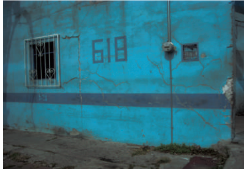
Figura 5.139. Fotografía A de la colonia Pensador Mexicano. Vivienda con fracturas de forma diagonal, vertical y horizontal (19.4443° N, 99.0861° W. Calle: Norte 174).
