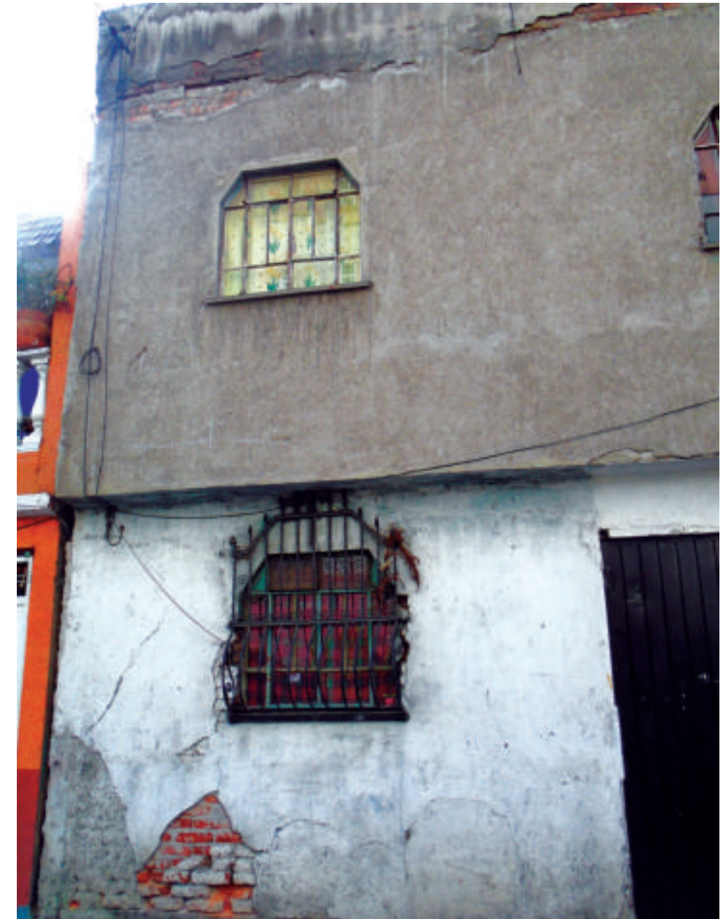
Figura 5.114. Fotografía G de la colonia Penitenciaría. Vivienda con fracturas verticales, horizontales y diagonales que ocasionan desprendimiento de material (19.4351° N, 99.1158° W. Calle: Ferrocarril Interoceánico).
