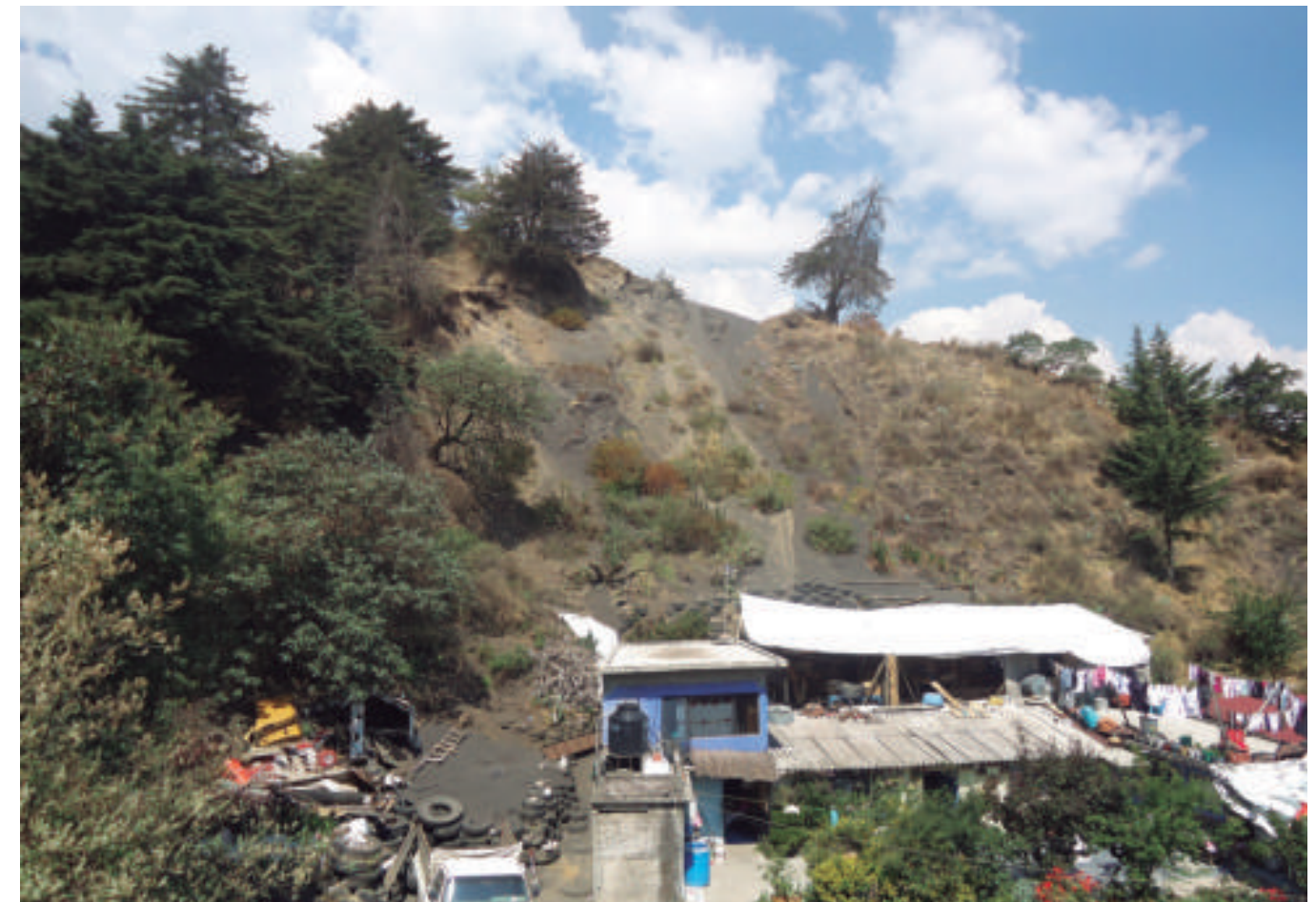
Figura 5.21. Fotografía E en el polígono de vulnerabilidad. La falta de vegetación favorece la erosión y remoción de la ceniza volcánica del suelo. El material desplazado por dicho fenómeno invade el patio de la vivienda, pese al muro de contención (construido con llantas) que ha sido levantado en varias ocasiones (19.3374° N, 99.1841° W. Calle: Río Seco).
