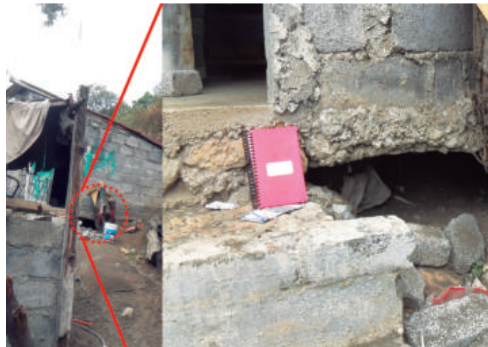
Figura 5.30. Fotografía D en el polígono de vulnerabilidad. Hueco debajo de la vivienda. Del lado derecho se puede ver a detalle la pérdida del material sobre el que se encuentra construida (19.0833° N 99.13551° W. Carretera México – Cuernavaca).
