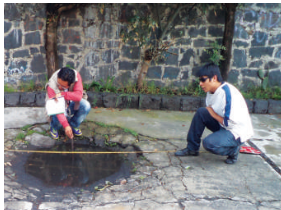
Figura 5.71. Fotografía A. Hundimiento concéntrico cubierto de asfalto y las fracturas que tiene la banquetta. Por las dimensiones, pareciera ser una coladera (19.2810° N, 99.2188° W. Calle: Conkal).
