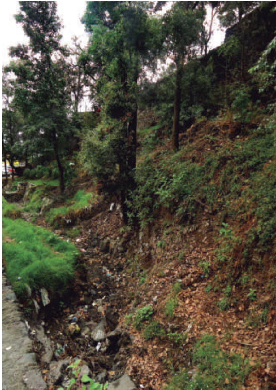
Figura 5.61. Fotografía A en el polígono de peligro. Socavamiento y generación de cárcavas producido por la corriente de agua. La manera en que debilita la ladera facilitando la ocurrencia de derrumbes (19.7144° N, 99.2414° W. Calle: Río Seco).
