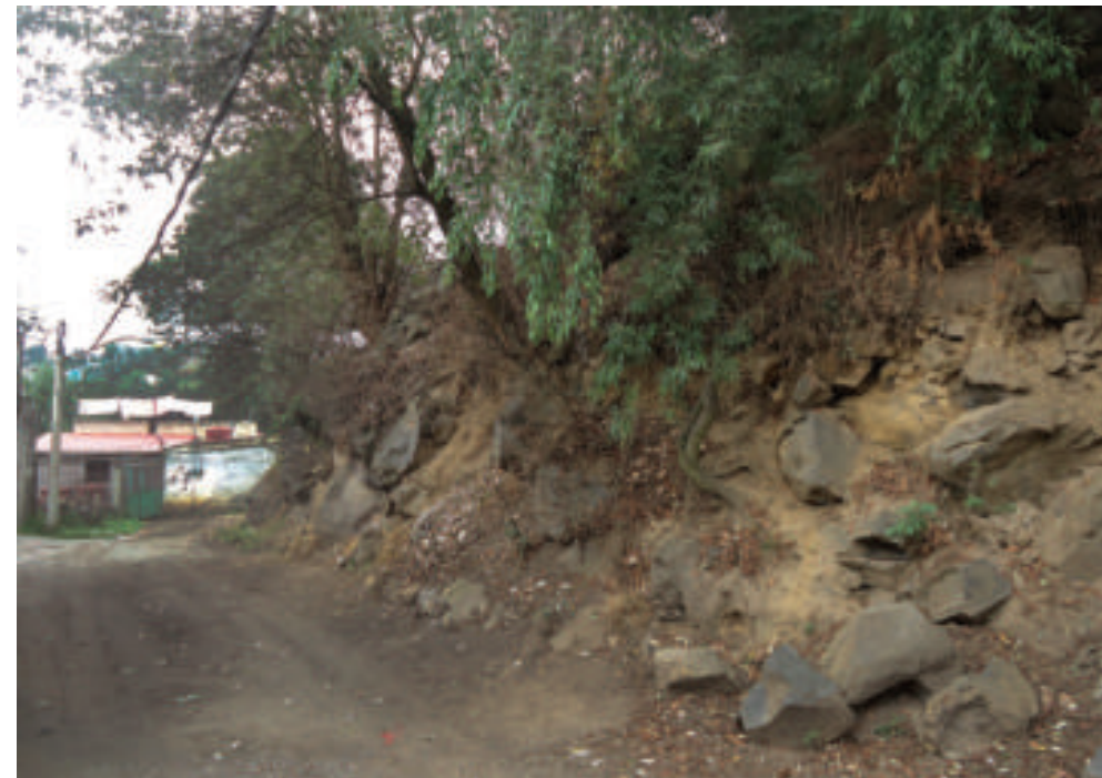
Figura 5.36. Fotografía A en el polígono de vulnerabilidad. La ladera está compuesta principalmente por bloques que se encuentran expuestos. Muestran una gran inestabilidad y representan peligro de caída de rocas en el camino (19.9578° N, 99.1397° W. Calle: Tlaltepec).
