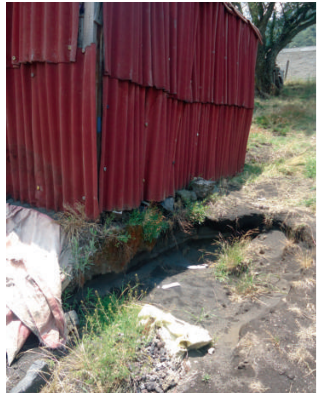
Figura 5.53. Fotografía A en el polígono de vulnerabilidad. A la orilla de la vivienda se puede observar la inestabilidad del terreno (19.2390° N, 99.2313° W. Asentamiento humano).
