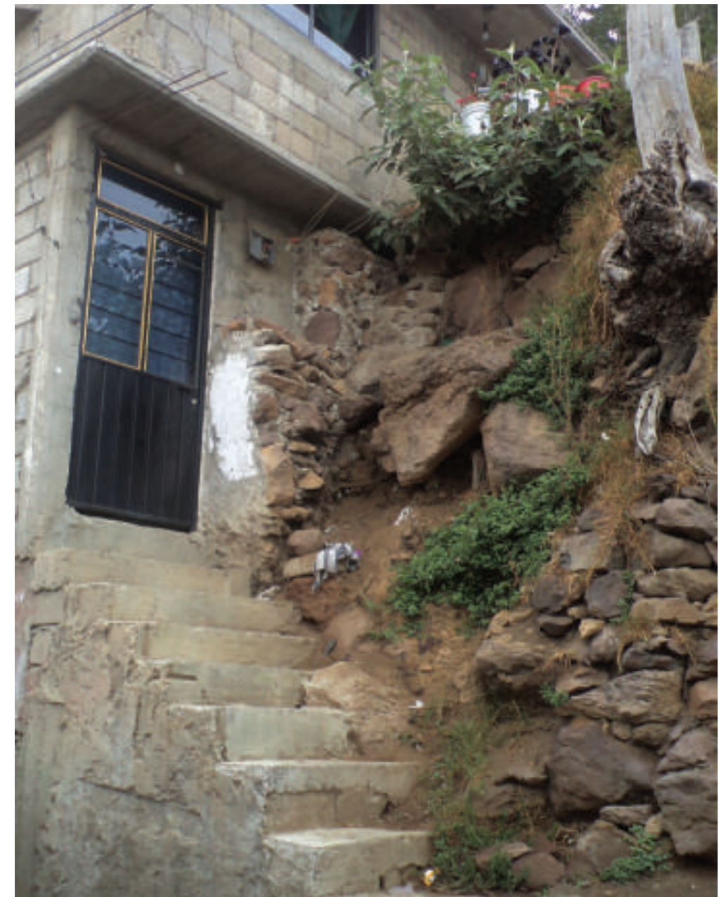
Figura 5.26. Fotografía B en el polígono de peligro. Bloques de roca expuestos con peligro de caída que se localizan en los cortes realizados sobre la ladera debido a la construcción de la vivienda (19.0487° N, 99.1457° W. Calle: Las Cruces).
