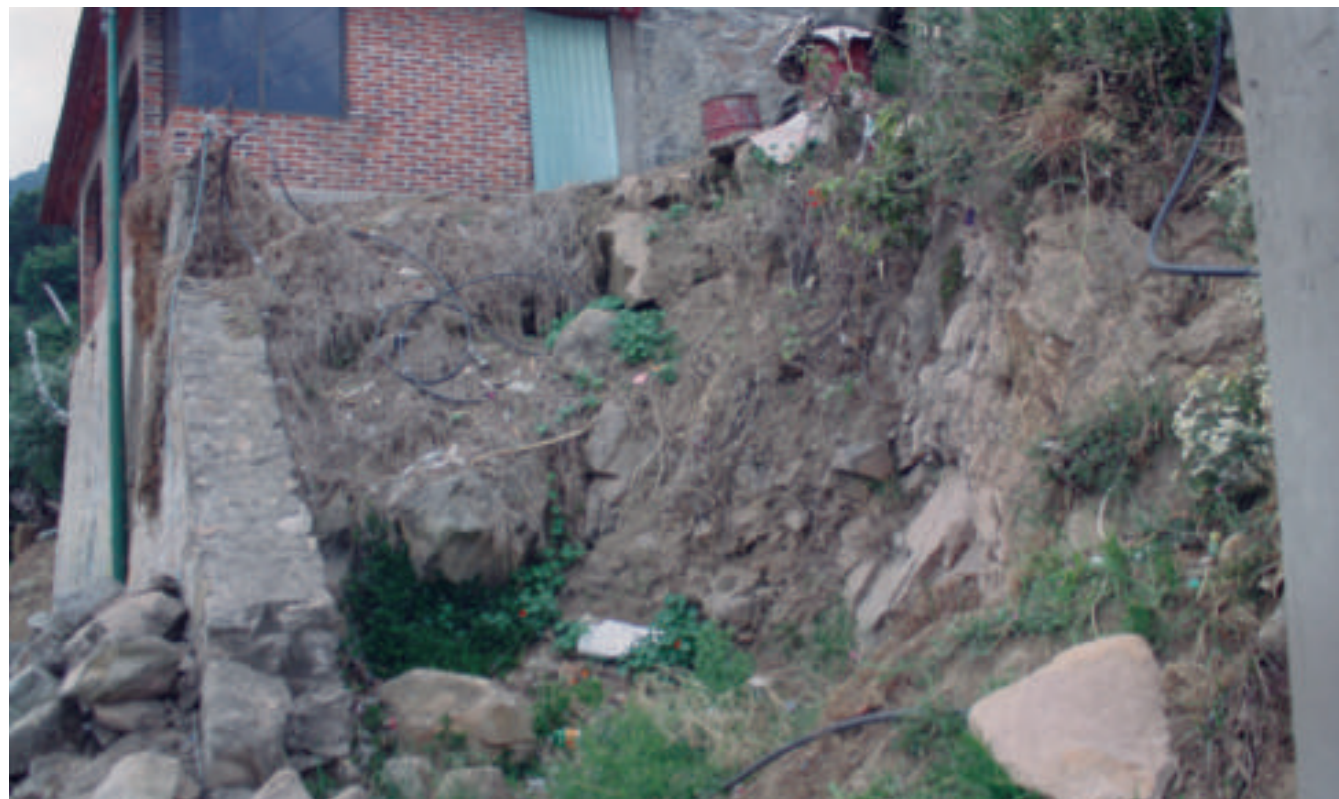
Figura 5.16. Fotografía E en el polígono de peligro. Derrumbe en el patio de la vivienda, también se pueden apreciar bloques de diferentes tamaños en una matriz de material fino (19.3707° N, 99.1827° W. Calle: Arenal).
