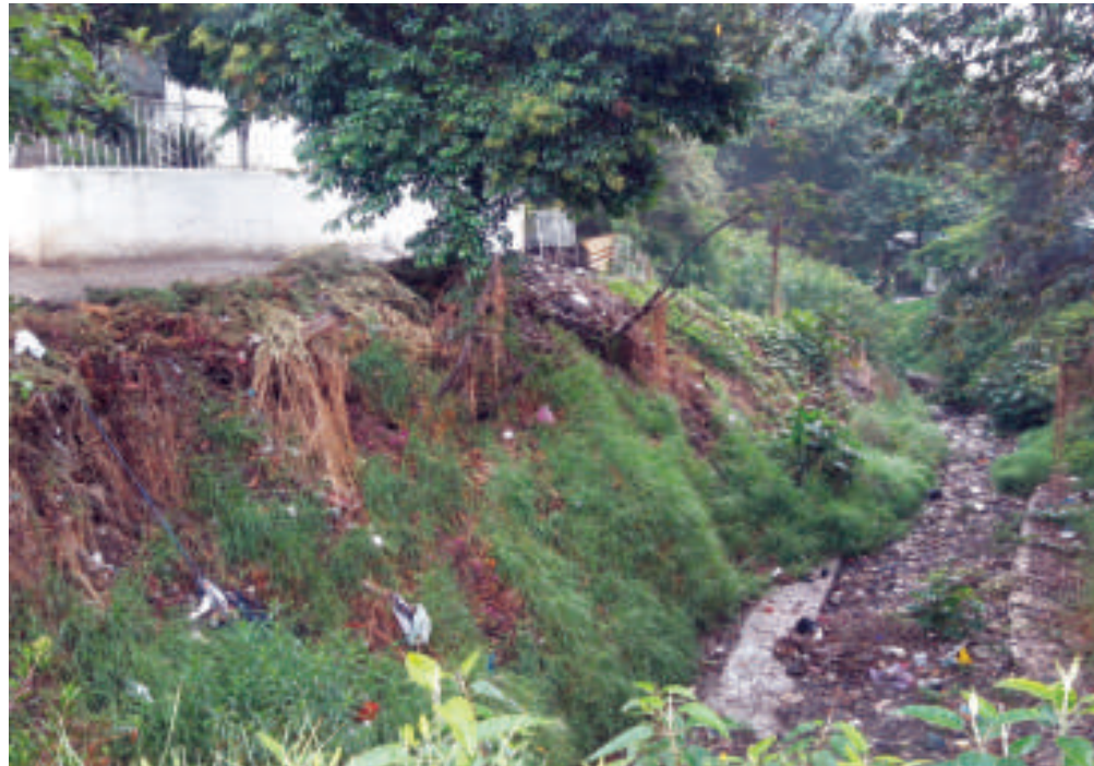
Figura 5.56. Fotografía A en el polígono de peligro. Los sedimentos y bloques de distintos tamaños que han sido transportados por el caudal han afectado por completo las obras de mitigación, lo que aumenta el peligro de flujos de lodo y rocas (19.9431° N, 99.2379° W. Calle: Ferrocarril De Cuernavaca).
