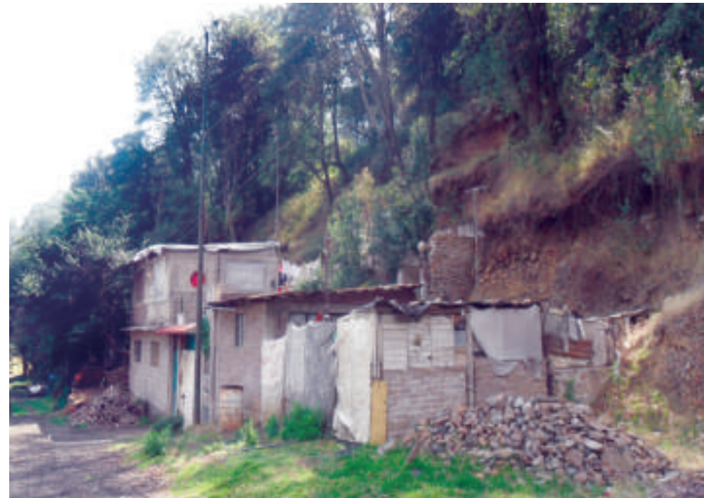
Figura 5.40. Fotografía A en el polígono de peligro. Los escarpes producidos por actividad antrópica representan un peligro alto por derrumbe y caída de rocas en la parte baja de la ladera del polígono de Ayocaititla (19.8152° N, 99.1440° W. Calle: Prolongación Ayocaititla).
