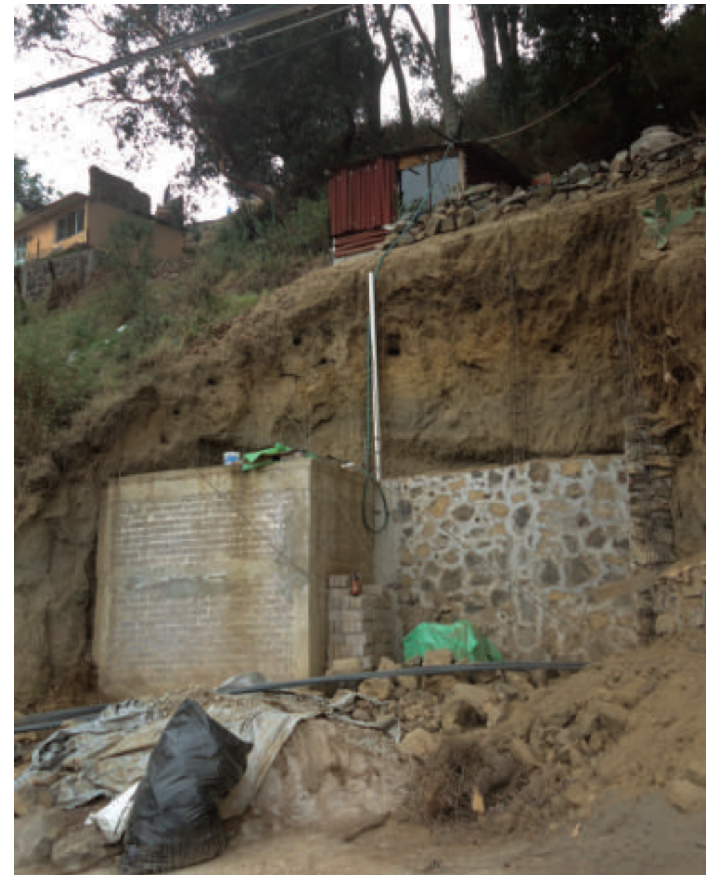
Figura 5.35. Fotografía B en el polígono de peligro. Se aprecian el corte en la ladera y los depósitos compuestos por suelo y bloques de distintos tamaños que representan un peligro alto por derrumbe para la construcción (19.9197° N, 99.1357° W. Calle: Las Rosas).
