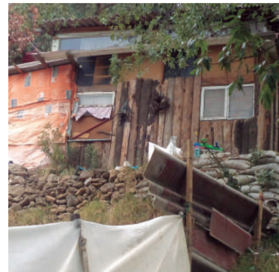
Vivienda desplantada sobre materiales inestables.
