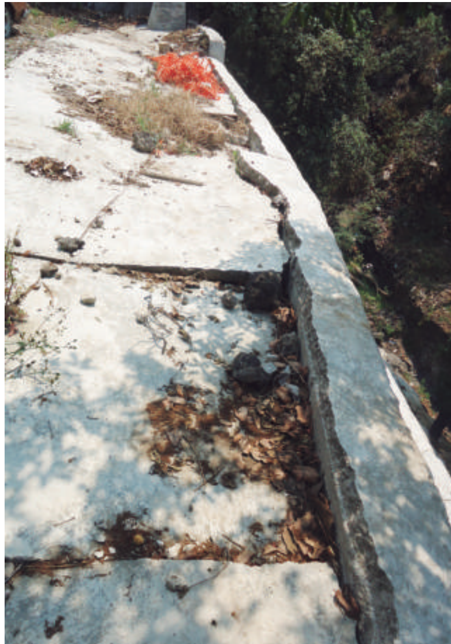
Figura 5.62. Fotografía B en el polígono de peligro. Parte baja del muro de contención de mampostería tipo gravedad en la calle Río Seco (19.7144° N, 99.2414° W. Calle: Río Seco).
