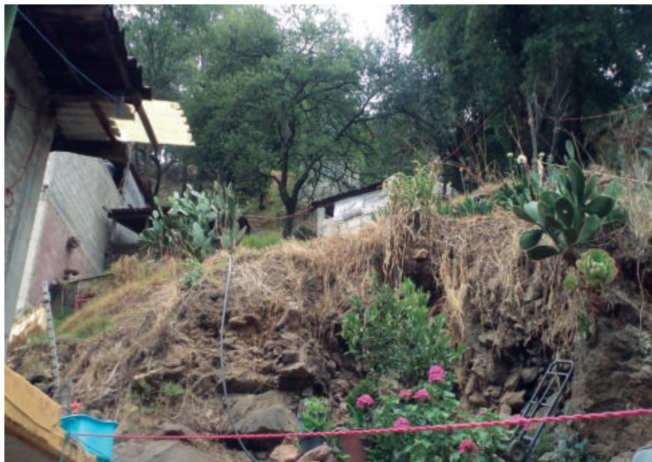
Figura 5.27. Fotografía C en el polígono de peligro. Zona de posible derrumbe que representa un peligro alto para las viviendas aledañas (19.0454° N, 99.1474° W. Calle: Tetequilo).
