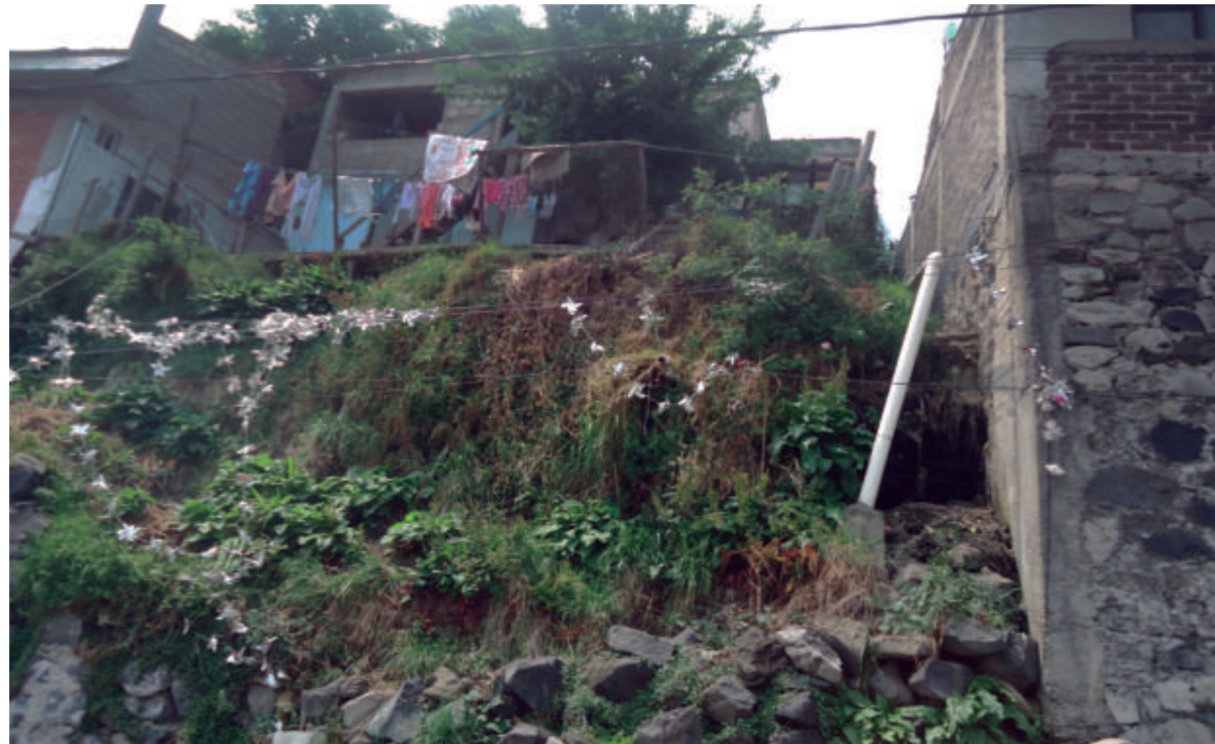
Figura 5.15. Fotografía F en el polígono de peligro. Vivienda sobre una ladera inestable. (19.2345° N, 99.1831° W. Calle: Cuautlalpan).
