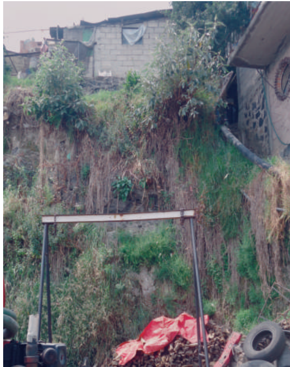
Figura 5.14. Fotografía D en el polígono de peligro. Vivienda construida sobre un talud con peligro por derrumbe (19.3510° N, 99.1835° W. Calle: Xitle).
