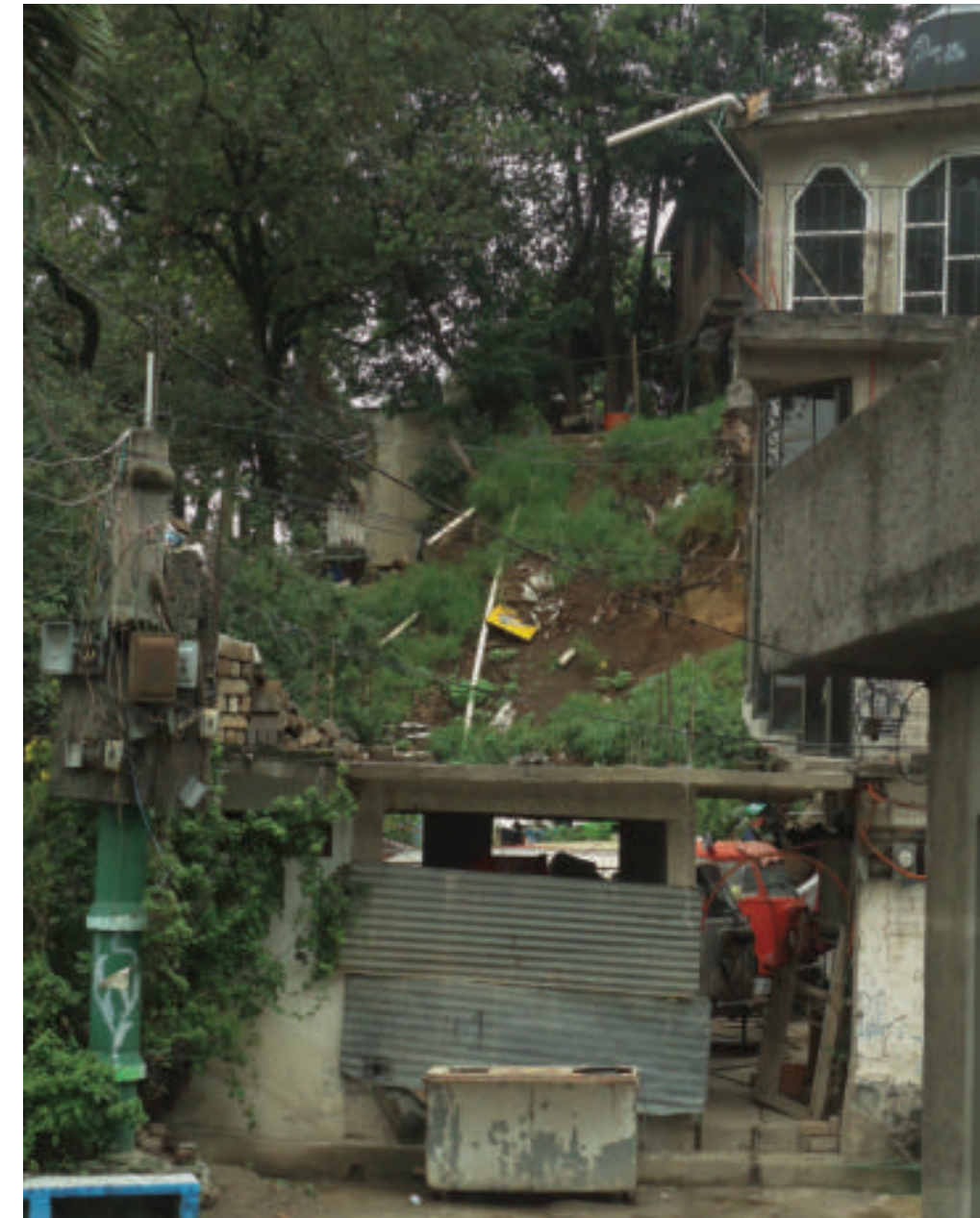
Figura 5.67. Fotografía A en el polígono de vulnerabilidad. Construcciones cercanas a una pendiente con escalones y áreas sin cubierta vegetal. Estas condiciones en el terreno representan un peligro alto para las viviendas localizadas en la parte baja (19.5020° N, 99.1756° W. Calle: 5 de Febrero).
