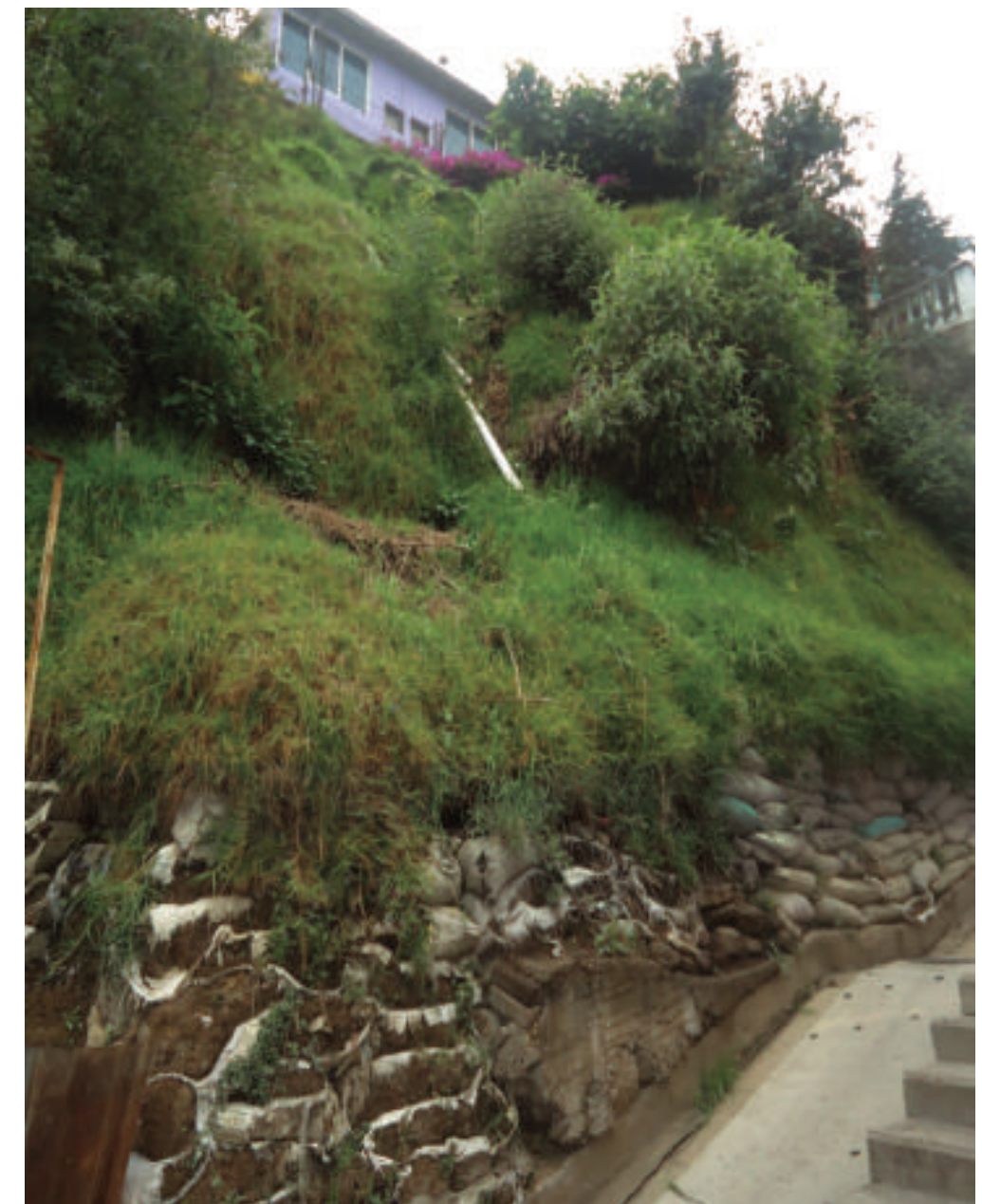
Figura 5.69. Fotografía B en el polígono de vulnerabilidad. Vivienda en el límite de un talud y un muro de contención improvisado a base de costales acomodados en la parte inferior (19.5019° N, 99.1758° W. Calle: 5 de Febrero).
