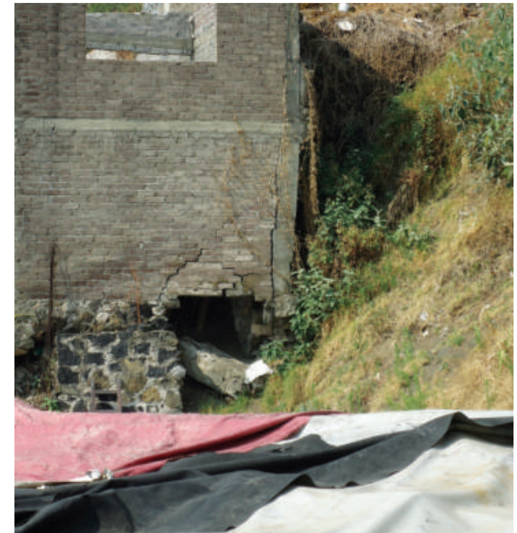
Figura 5.13. Fotografía C en el polígono de peligro. Muestra el peligro que representan los derrumbes y caídas de roca que provocan importantes daños en las construcciones y las vuelven inestables (19.3445° N, 99.1830° W. Calle: Xitle).
