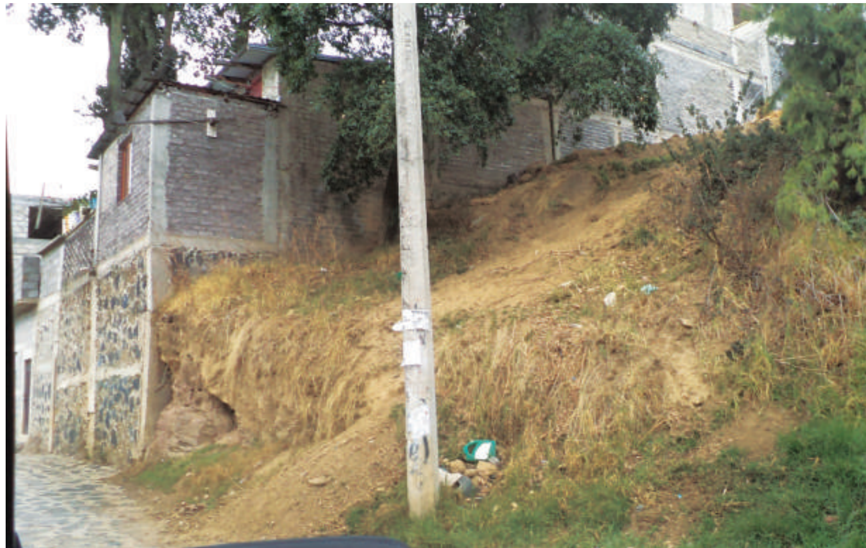
Figura 5.25. Fotografía A en el polígono de peligro. Corte de la ladera para la construcción de viviendas; se aprecia la dirección del movimiento de los materiales y el depósito de los mismos (19.2089° N, 99.1492° W. Calle: Camino Al Calvario).
