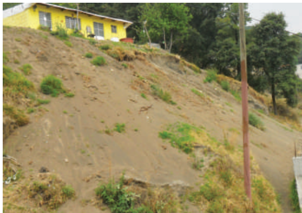
Figura 5.12. Fotografía B en el polígono de peligro. Se aprecia la erosión remontante y el consecuente desplazamiento de cenizas ladera abajo (19.2742° N, 99.1779° W. Calle: Primavera).
