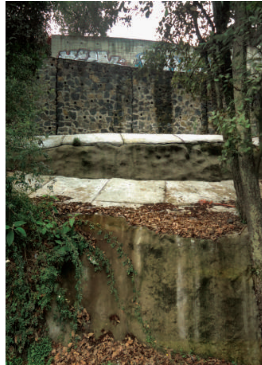
Figura 5.63. Fotografía A en el polígono de vulnerabilidad. Vista de la parte superior del muro de contención. Se pueden observar fracturas que obedecen a un desplazamiento a favor de la pendiente (19.7189° N, 99.2414° W. Calle: Río Seco).
