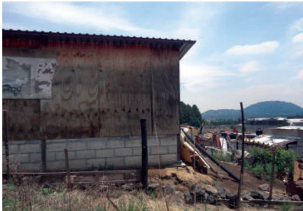
Figura 5.51. Fotografía A en el polígono de peligro. Las viviendas se encuentran construidas sobre cenizas que son fácilmente removidas por el agua, el paso de las personas al transitar en la zona también representa un peligro alto por deslizamiento (19.2375° N, 99.2307° W. Asentamiento humano).
