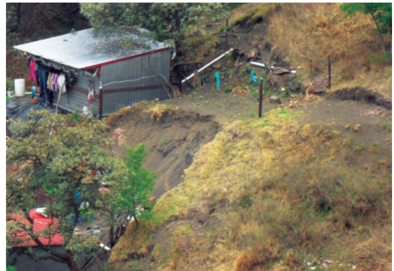
Figura 5.28. Fotografía A en el polígono de vulnerabilidad. La ceniza, al ser un material muy deleznable, es removida fácilmente, en especial en los taludes hechos para viviendas, ya que se reduce el nivel de estabilidad de los materiales. En la fotografía se puede apreciar la gran actividad que se presenta en los escarpes (19.0735° N, 99.1393° W. Calle: Independencia).
