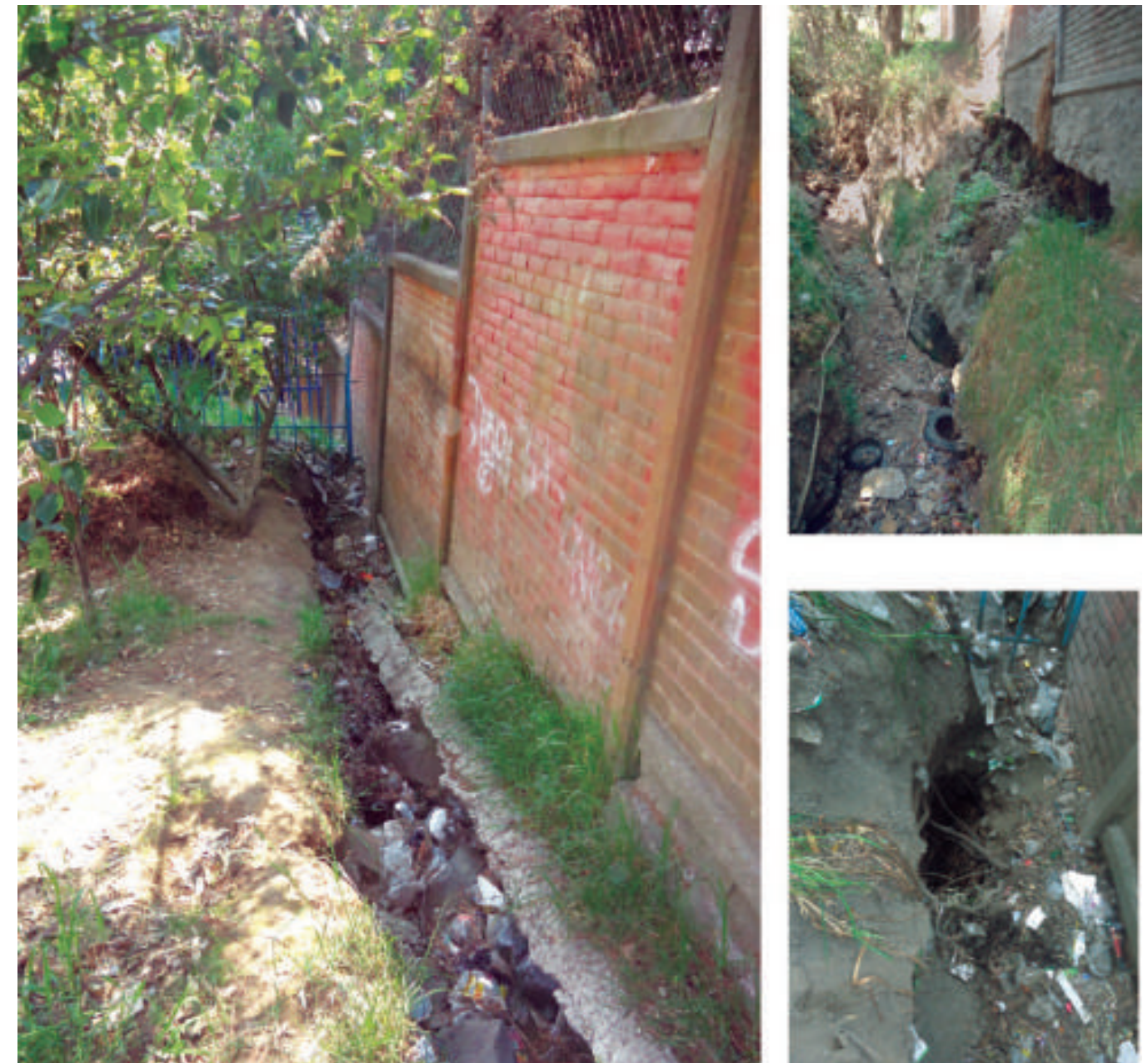
Figura 5.17. Fotografía A en el polígono de vulnerabilidad. Barda que delimita a la secundaria «Estado de Quintana Roo». A un costado de la barda se encuentra un canal donde en temporada de lluvias fluye una corriente que erosiona el suelo a su paso (19.3479° N, 99.1865° W. Carretera México - Ajusco).
