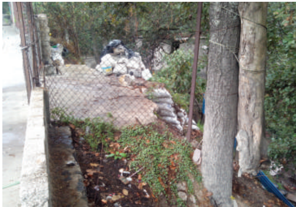
Figura 5.58. Fotografía A en el polígono de vulnerabilidad. Vivienda altamente vulnerable por derrumbe, donde la línea roja señala el límite de la barranca (19.9412° N, 99.2398° W. Calle: Tlamahualca).
