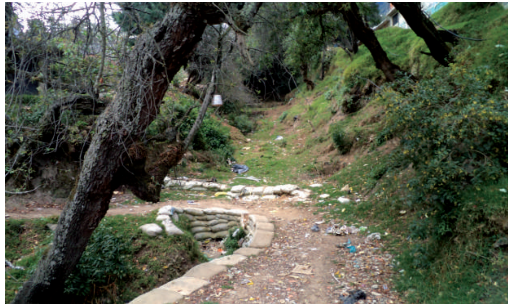
Figura 5.57. Fotografía E de la sección cuatro (4.4) de Anzaldo. Camino estabilizado por costales apilados, los árboles inclinados son una evidencia de la inestabilidad de la ladera (19.3001° N, 99.2639° W. Calle: Flor de Loto).
