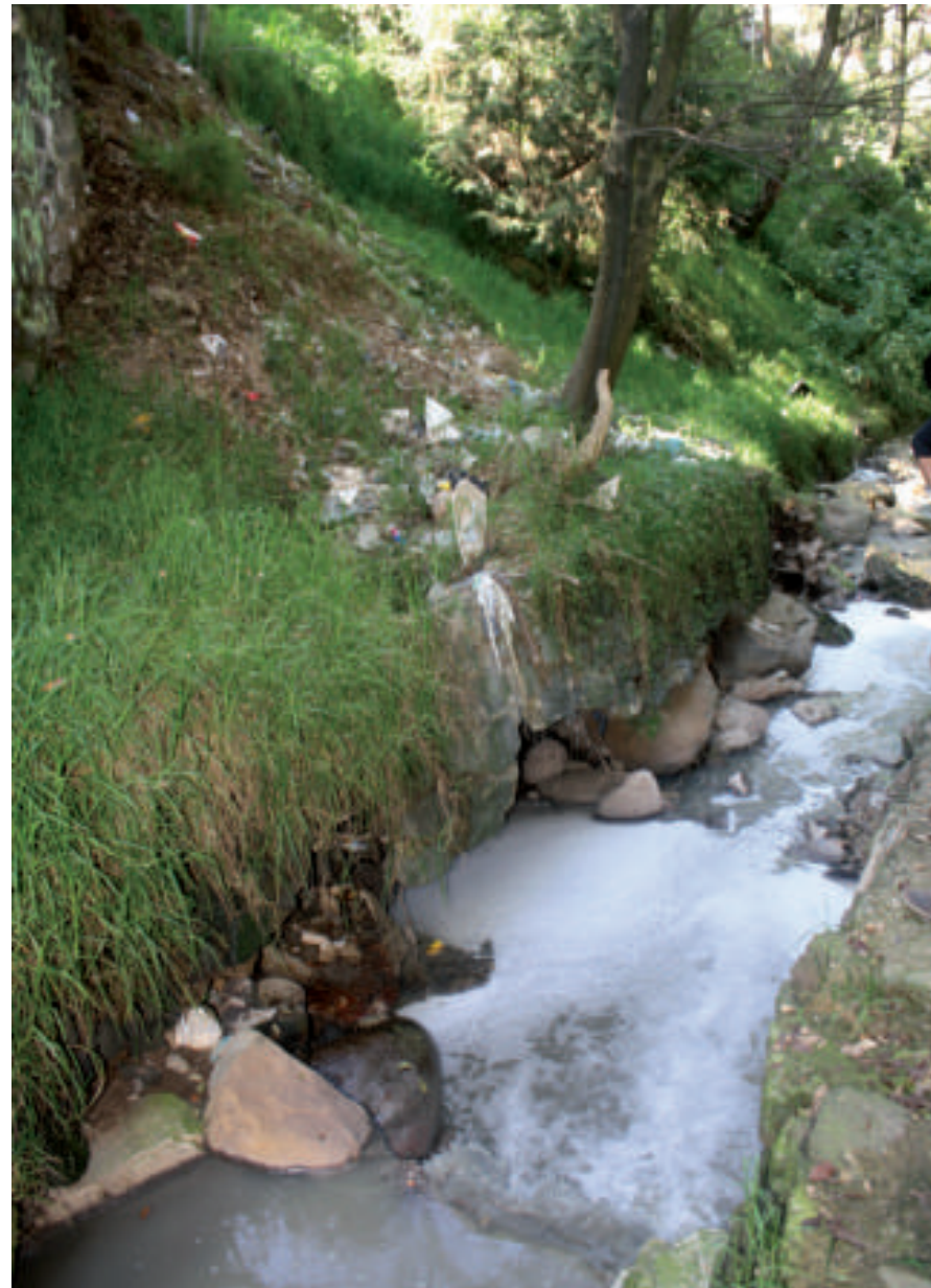
Figura 5.23. Fotografía A de la sección cuatro (2.4) de Texcalatlaco. Daños provocados por la erosión hídrica en uno de los muros para encauzar la corriente, la vegetación se encuentra inclinada a favor de la pendiente y se observa un derrumbe en la parte central de la imagen (19.3124° N, 99.2660° W. Calle: Astilleros).
