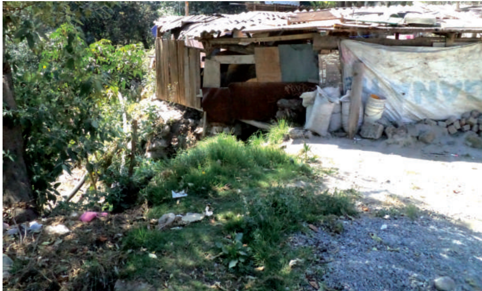
Figura 5.67. Fotografía A de la sección tres (5.3) de Eslava. Vivienda precaria, próxima a la barranca establecida sobre costales para estabilizar el terreno, sin embargo se puede apreciar la pérdida de material y la inestabilidad de la ladera (19.2824° N, 99.2436° W. Calle: Sin nombre oficial).
