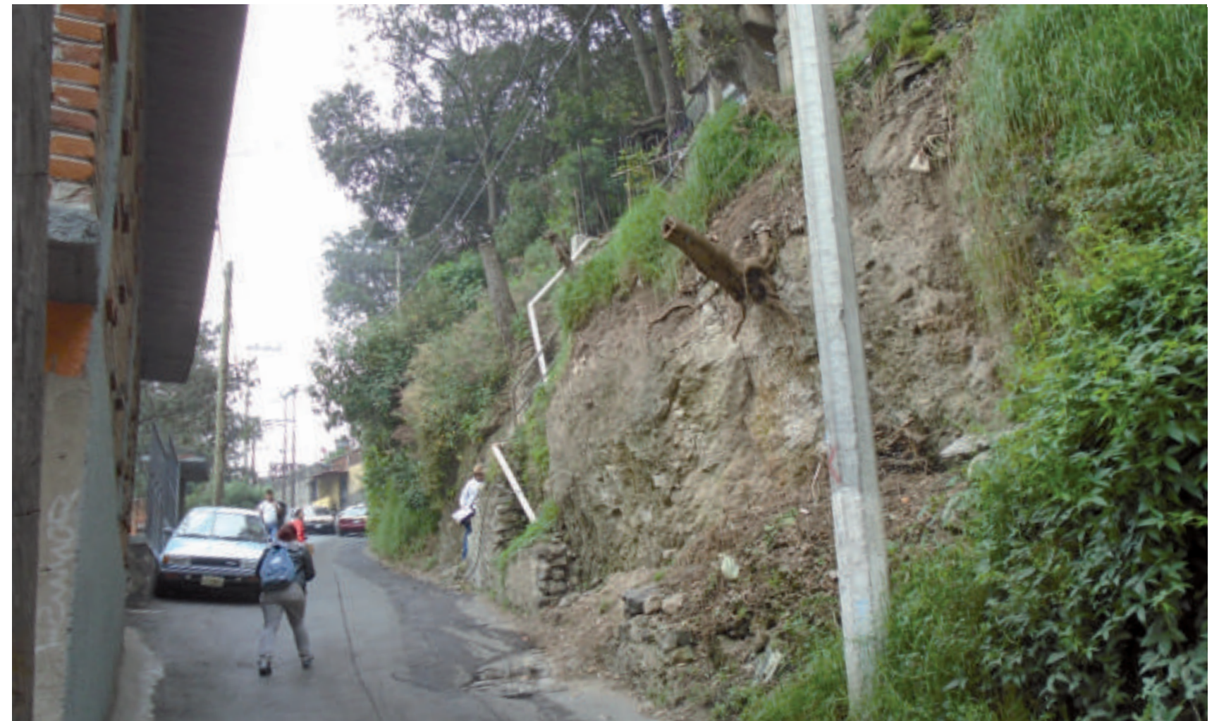
Figura 5.83. Fotografía D en el polígono de peligro Buenavista. Talud con materiales expuestos y poco consolidados. En la parte baja de la pendiente se observa un muro dañado y material removido; en la parte alta se encuentran viviendas en peligro por derrumbe (19,3004° N, 99,2455° W. Calle: Mina).
