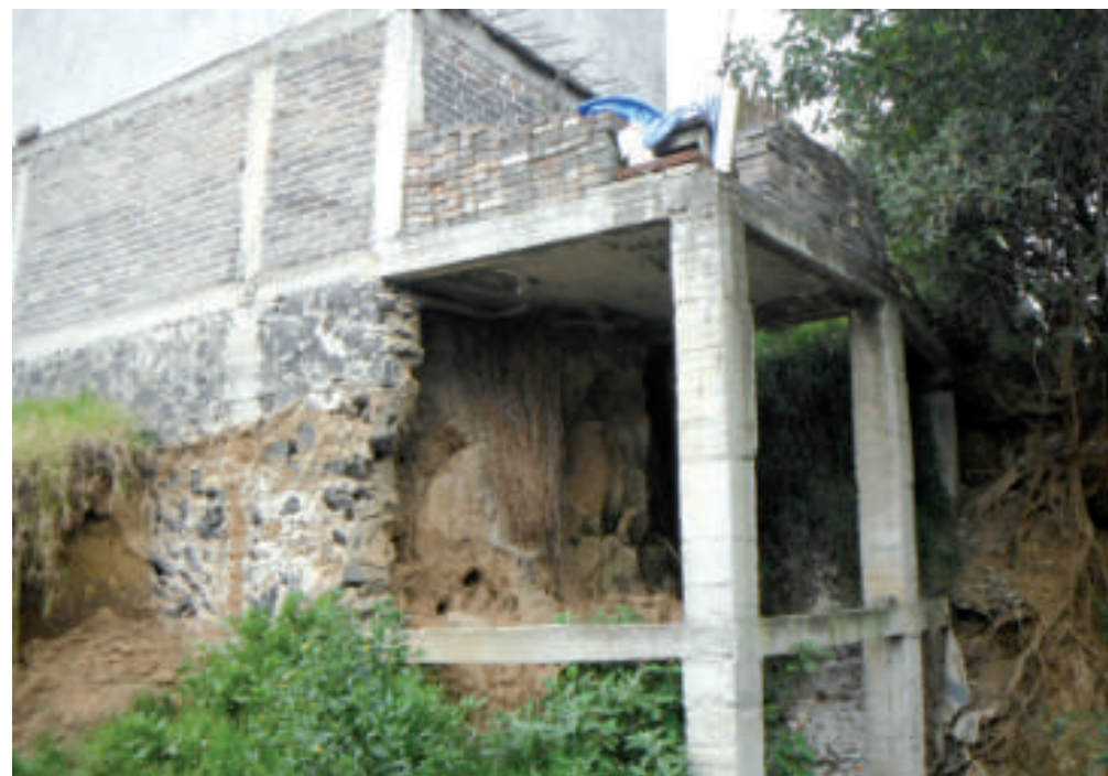
Figura 5.76. Fotografía B de vulnerabilidad en Sayula-Carbonera. Inmueble desplantado sobre una pendiente con material inestable y muy erosionado. Del lado derecho se observa un árbol con la raíz expuesta, lo que indica la pérdida del material así como la inestabilidad del terreno (19,3008° N, 99,2532° W. Calle: 2da. Cerrada de Buenavista).
