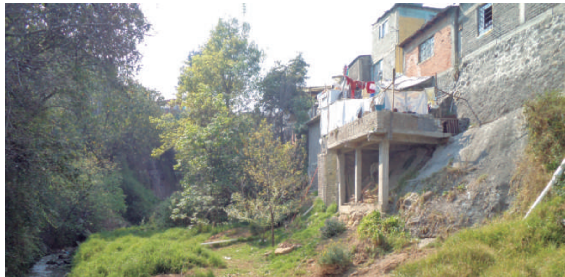
Vivienda en peligro por fenómeno de derrumbe al haberse construido en las paredes inestables de la barranca Anzaldo.
