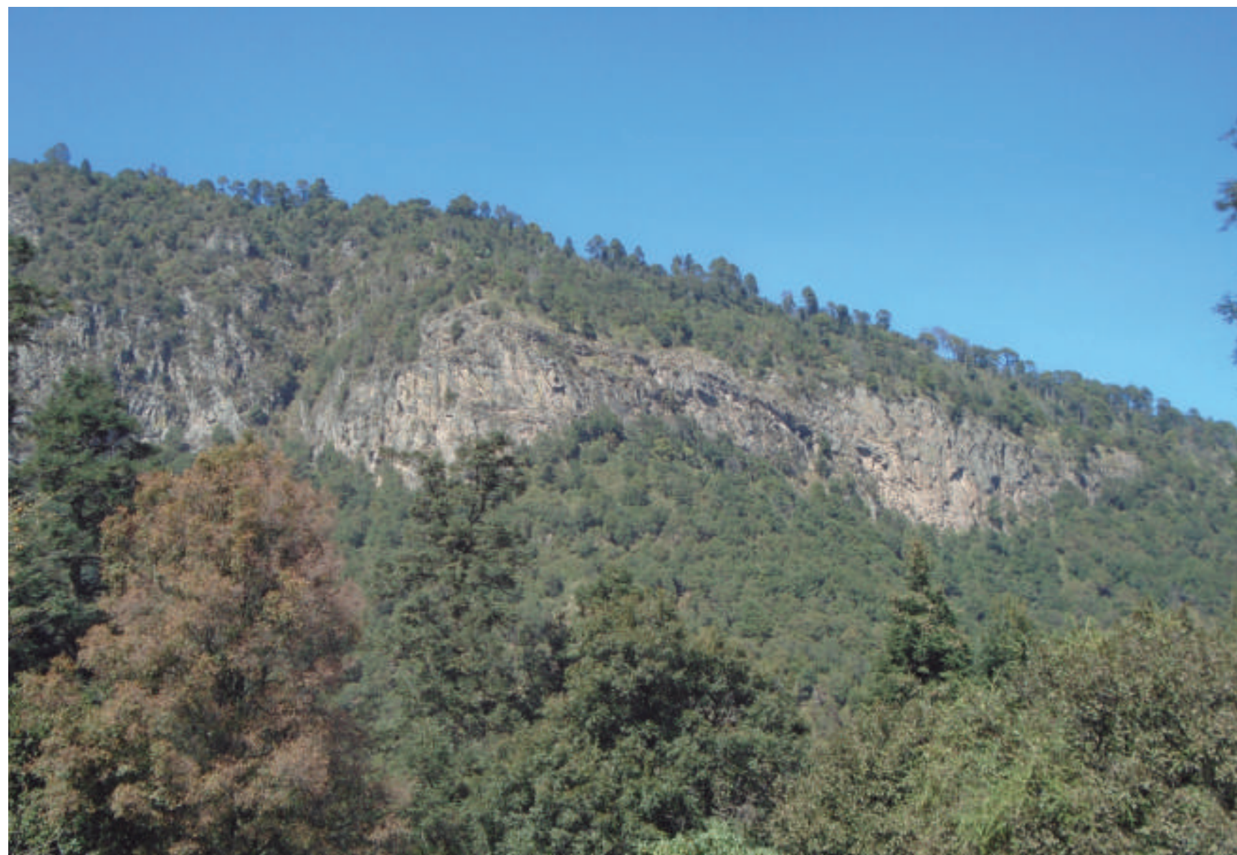
Talud constituido por macizo rocoso altamente fragmentado y susceptible a caída de rocas.
