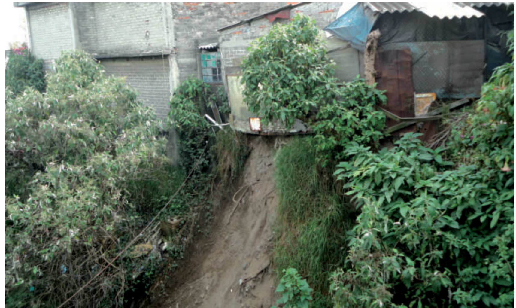
Figura 5.31. Fotografía D de la sección uno (3.1) de Coyotera. Derrumbe que ha dejado a la vivienda altamente vulnerable (19.3142° N, 99.2454° W. Calle: Jacarandas).
