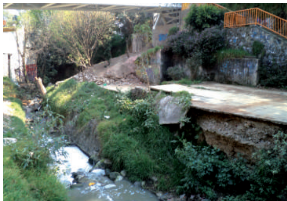
Figura 5.46. Fotografía C de la sección dos (4.2) de Anzaldo. Escombros de una construcción que colapsó. Debajo de la plancha de concreto se observa material de relleno sobre el que construyeron la estructura, el cual ha sido erosionado provocando el colapso (19.3057° N, 99.2527° W. Calle: Primera de San Jerónimo).
