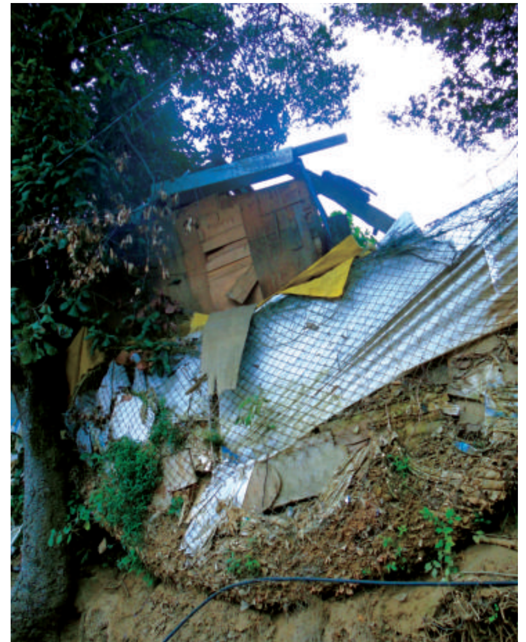
Figura 5.88. Fotografía A en el polígono de peligro Paraje Ixtlahualtongo. Material poco compacto sobre el que se encuentra desplantada una vivienda de sistema precario. El enmallado que delimita la propiedad retiene el material del basamento (19.2824° N, 99.2485° W. Calle: Vía Chiquita).
