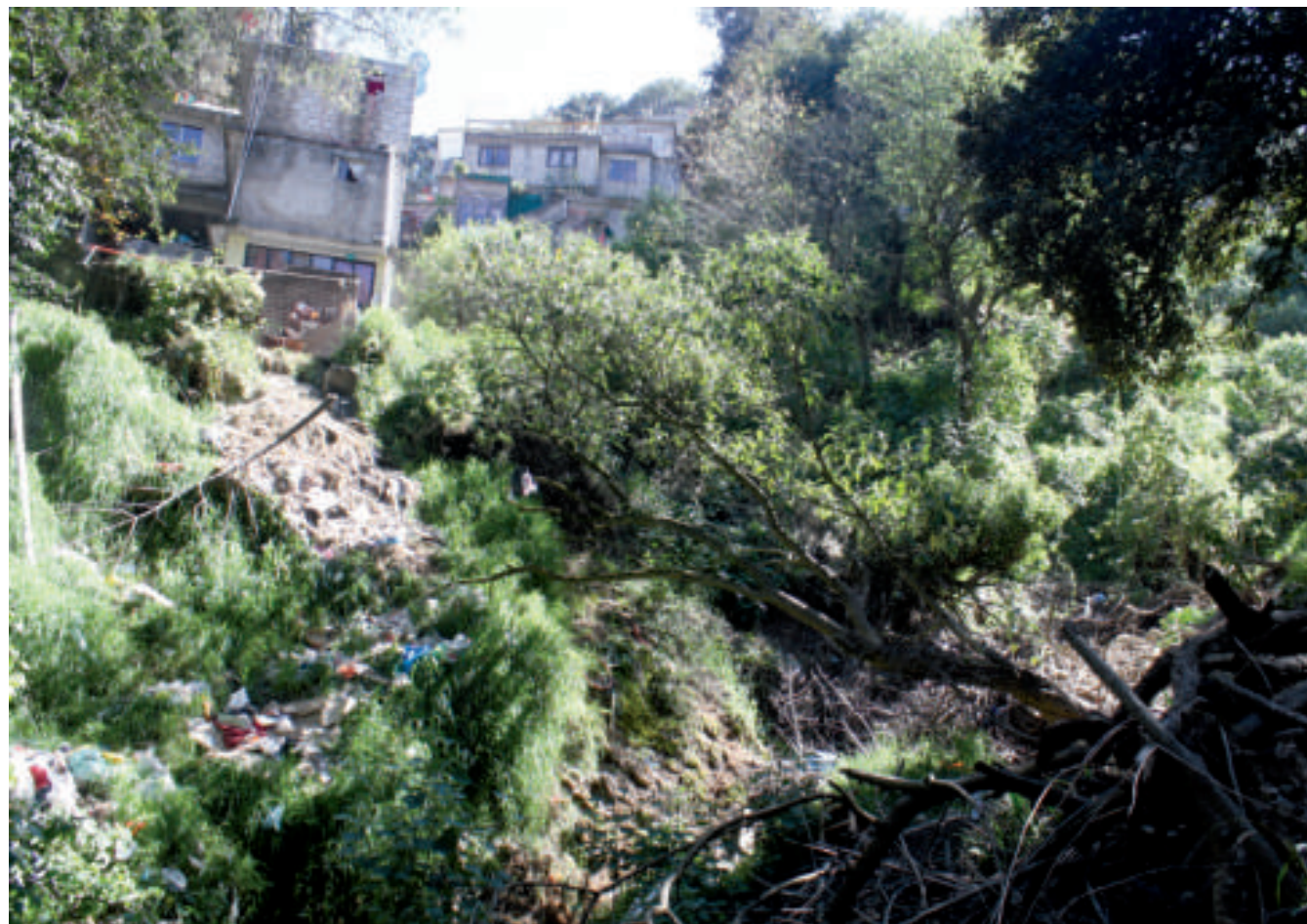
Figura 5.9. Fotografía B en la barranca Guadalupe (1). Vivienda establecida en uno de los flancos de la barranca donde se observa material inestable en su base. En la parte inferior derecha se muestra un árbol colapsado debido a la poca compactación del terreno (19.3201° N, 99.2419° W. Calle: Encinal esquina con Del Parque).
