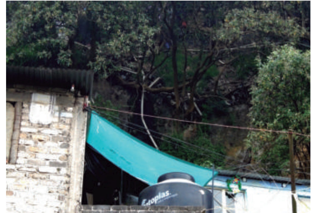
Figura 5.85. Fotografía B de vulnerabilidad en Buenavista. En la parte central de la imagen se puede observar un talud inestable que ha sufrido un derrumbe. Algunos de los árboles están inclinados y a punto de colapsar sobre las viviendas (19,3001° N, 99,2458° W. Calle: Mina).
