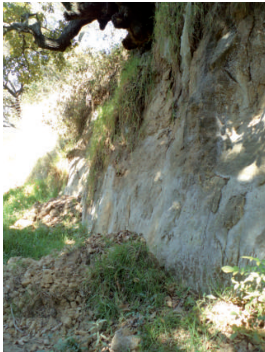
Figura 5.65. Fotografía B de la sección dos (5.2) de Eslava. Talud y depósitos de un derrumbe (19.2943° N, 99.2369° W. Calle: Tlamahacala).
