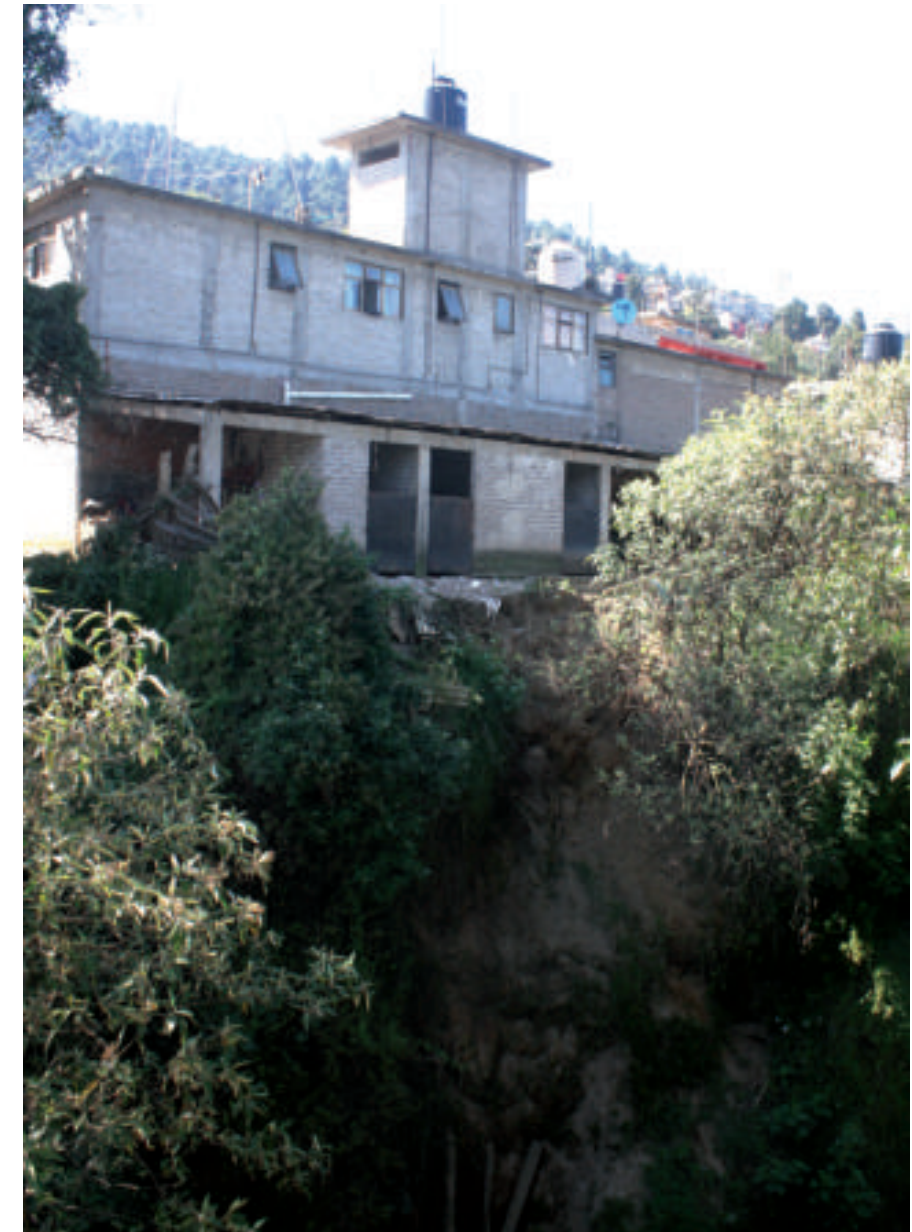
Figura 5.25. Fotografía C de la sección cuatro (2.4) de Texcalatlaco. Se puede apreciar el derrumbe de los materiales que han dejado a la vivienda expuesta a nuevos eventos (19.3080° N, 99.2668° W. Calle: Carbonero).
