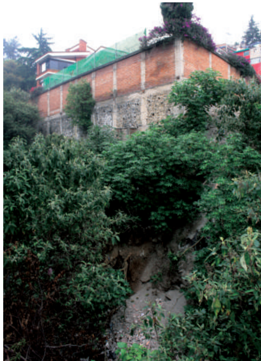
Figura 5.36. Fotografía C de la sección dos (3.2) de Coyotera. Se observa una vivienda que se encuentra en la parte superior de la barranca, la cual presenta derrumbes cercanos al cauce y por debajo de la construcción. El derrumbe está compuesto por material autóctono y cascajo de la base de la estructura (19.3161° N, 99.2528° W. Calle: Icatl).
