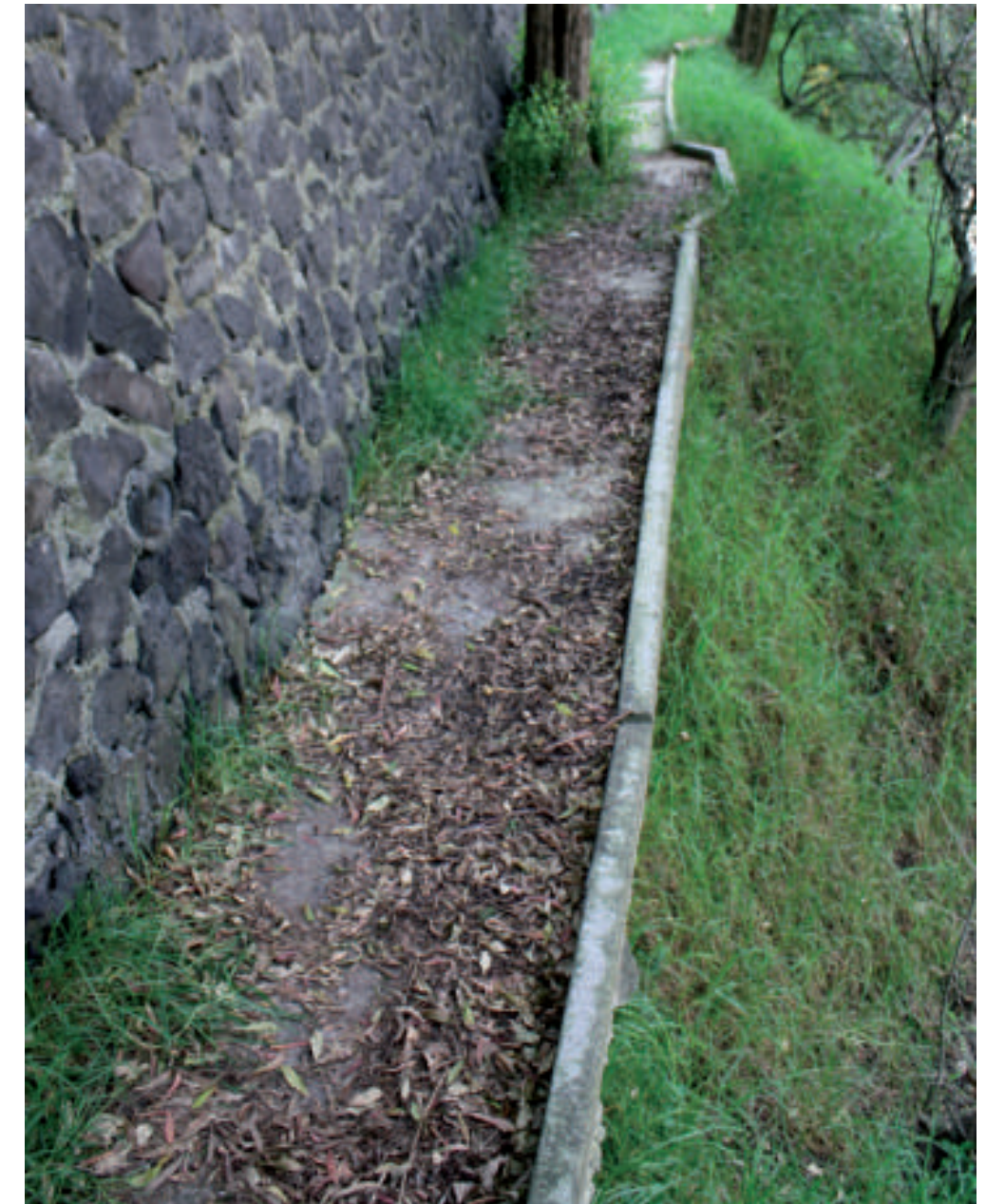
Figura 5.18. Fotografía B de la sección dos (2.2) de Texcalatlaco. Camino peatonal a lo largo del talud de la barranca a la altura de la avenida San Bernabé. Se puede observar una fractura y la pérdida de basamento (19.3315° N, 99.2277° W. Calle: Miahuatlán).
