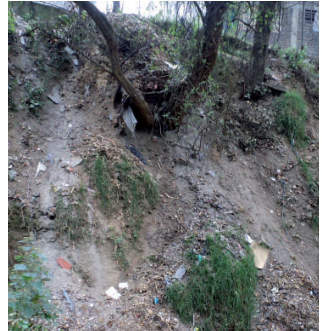
Figura 5.53. Fotografía A de la sección cuatro (4.4) de Anzaldo. Material removido a causa de un derrumbe. Se puede observar que el material se encuentra muy suelto y los árboles muestran inclinación a favor de la pendiente (19.3002° N, 99.2602° W. Calle: Capulín).
