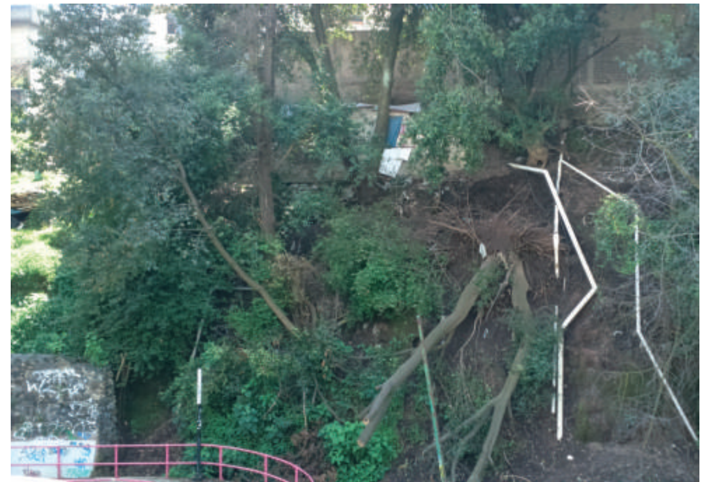
Figura 5.10. Fotografía C en la barranca Guadalupe (1). Se aprecia uno de los flancos de la barranca con un derrumbe que ha causado la caída de árboles. En la esquina inferior izquierda se observa un muro de contención de mampostería con mortero. En la parte alta del talud una vivienda. La pendiente es pronunciada y tiene materiales poco compactos (19.3142° N, 99.2683° W. Calle: Mina).
