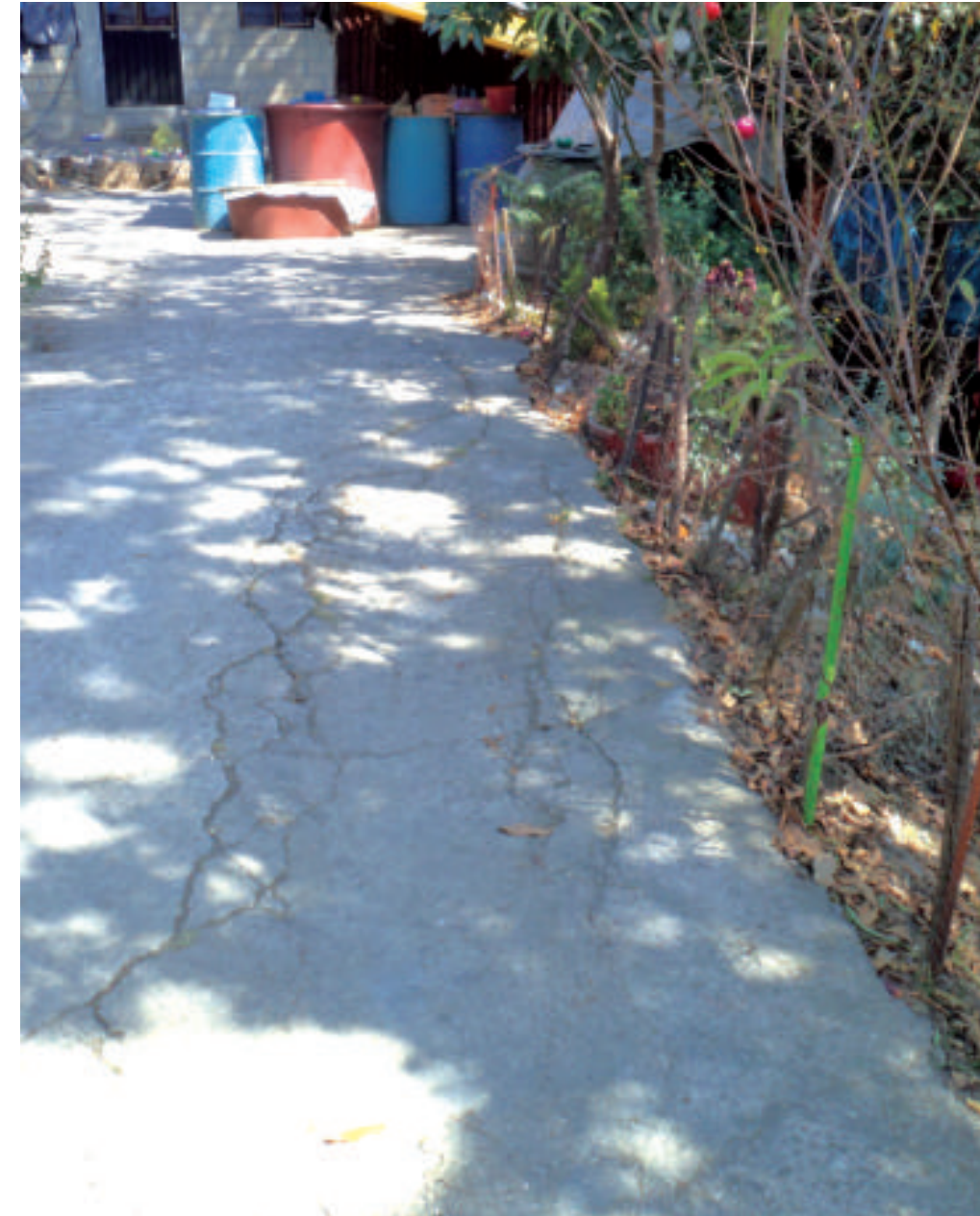
Figura 5.68. Fotografía B de la sección tres (5.3) de Eslava. Fractura perpendicular a la pendiente generada por el desplazamiento de material (19.2807° N, 99.2440° W. Calle: Sin nombre oficial).
