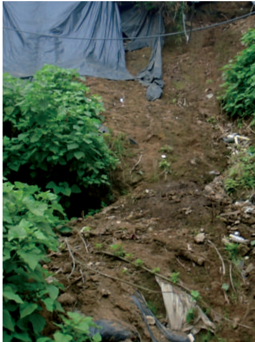
Figura 5.96. Fotografía A en el polígono de peligro Tierra Colorada. Inmuebles situados al borde del talud del camino. El talud está compuesto por materiales volcánicos deleznable muy alterados y sin compactación, el corte de talud aceleró la inestabilidad del terreno lo que incrementó el peligro por derrumbe. Se distingue el material que ha sido depositado en la parte inferior del talud: bloques de roca rodeados de arcillas, suelo y vegetación (19,2732° N, 99,2477° W. Calle: Acros).
