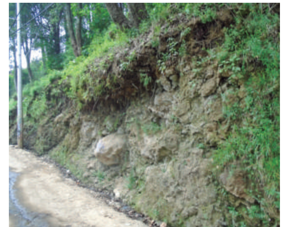
Figura 5.98. Fotografía C en el polígono de peligro Tierra Colorada. Corte de talud con bloques expuestos que dejan la vía de comunicación altamente vulnerable al fenómeno de caída de roca (19,2725° N, 99,2483° W. Calle: Sin nombre oficial).
