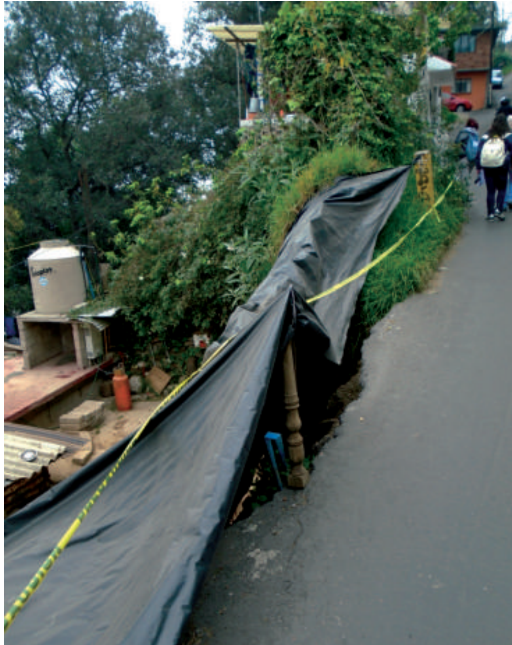
Figura 5.84. Fotografía A de vulnerabilidad en Buenavista. Vivienda con un derrumbe en el talud que colinda con la calle Mina. Los habitantes protegieron con plástico la zona afectada a remoción en masa para evitar la acción de agentes erosivos (19,3002° N, 99,2460° W. Calle: Mina).
