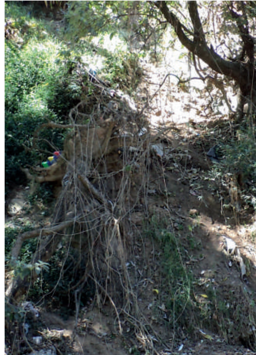
Figura 5.61. Fotografía B de la sección uno (5.1) de Eslava. La exposición de las raíces de los árboles en la parte superior de la barranca denota la constante remoción del material y la pérdida de estabilidad de la ladera (19.2979° N, 99.2327° W. Calle: Mariano Matamoros).
