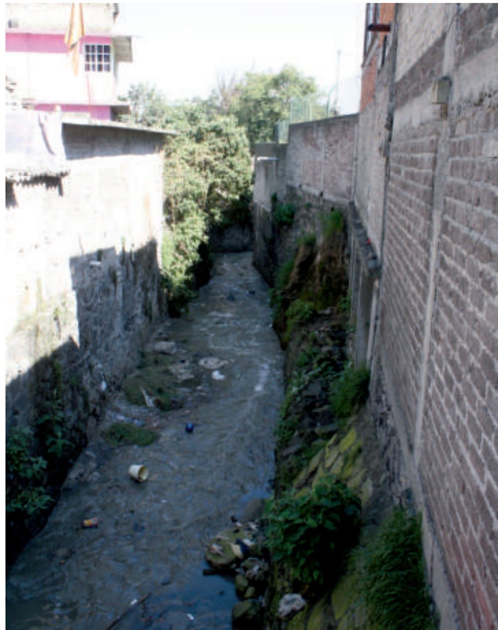
Figura 5.30. Fotografía C de la sección uno (3.1) de Coyotera. Integración del afluente al cauce principal. Se puede observar que la cimentación de las viviendas encausa la corriente de agua (19.3142° N, 99.2454° W. Calle: Violeta).
