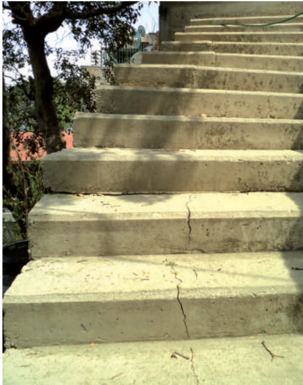
Figura 5.82. Fotografía C en el polígono de peligro Buenavista. Escalera con múltiples fracturas horizontales y transversales, las primeras generan una separación entre los escalones debido al desplazamiento de materiales en la cual estaba apoyada. Las fracturas transversales cortan los escalones (19.2994° N, 99.2461° W. Calle: Mina).
