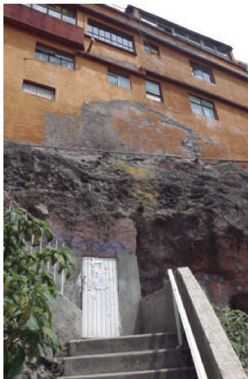
Figura 5.53. Fotografía C de la imagen 6 de vulnerabilidad del polígono Tamarindos. Talud parcialmente cubierto de concreto lanzado que presenta erosión. Sobre el mismo se encuentra desplantada una vivienda de varios niveles (19.3840° N, 99.2558° W. Calle: 3.º Cerrada).
