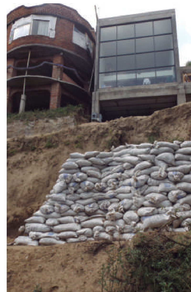
Figura 5.62. Fotografía B de la imagen 7 de vulnerabilidad del polígono Santa Rosa. Construcciones asentadas en la parte alta de un talud en el que se han realizado cortes verticales; al centro de la fotografía se observa un muro de contención dispuesto con costales rellenos y apilados para sostener los materiales que componen al talud (19.3252° N, 99.2969° W. Calle: sin nombre oficial).
