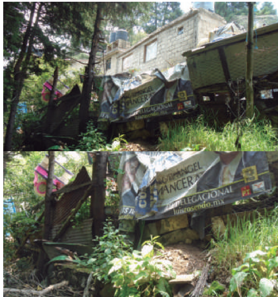
Figura 5.132. Fotografía C de la imagen 15 de vulnerabilidad del polígono Las Lajas. Vivienda asentada en la orilla del cauce sobre un talud artificial para construcción; sus cimientos constan de materiales de bajo costo y nula resistencia. En la fotografía de abajo se puede observar el depósito de los materiales que han caído, además de un muro de contención hecho con materiales de sitio y mortero que presenta una inclinación ocasionada por el peso de la construcción (19.3121° N, 99.3332° W. Calle: sin nombre oficial).
