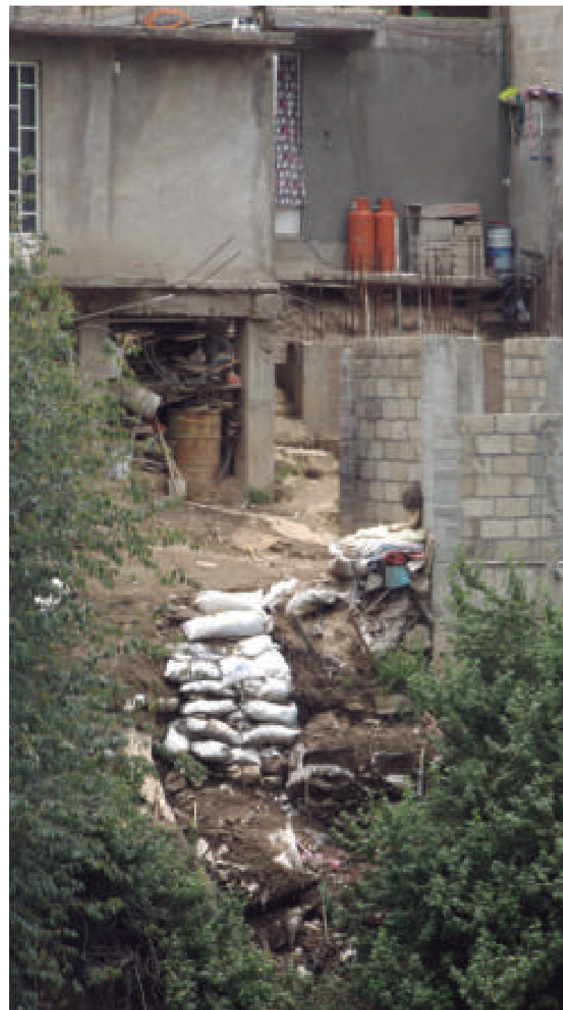
Figura 5.130. Fotografía A de la imagen 15 de vulnerabilidad del polígono Las Lajas. Costales rellenos de material de sitio como muro de contención, apilados sobre una pendiente de 60°. Algunos de ellos han caído en dirección favorable a la pendiente debido a la inestabilidad del material. El estado de deterioro en el que se encuentran los costales rellenos es evidente (19.3146° N, 99.3337° W. Calle: Las Lajas).
