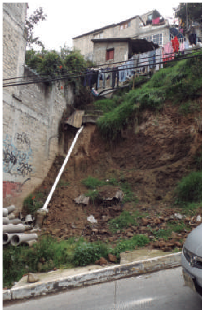
Figura 5.84. Fotografía A del polígono de peligro San Pablo Chimalpa. Vivienda construida en la cima de un talud compuesto de material inestable; al pie del mismo, se pueden observar los depósitos del material que ha colapsado, además se denota la humedad que se ha infiltrado en el talud debido a la coloración de los materiales (19.3520° N, 99.3155° W. Calle: Del Tecnológico).
