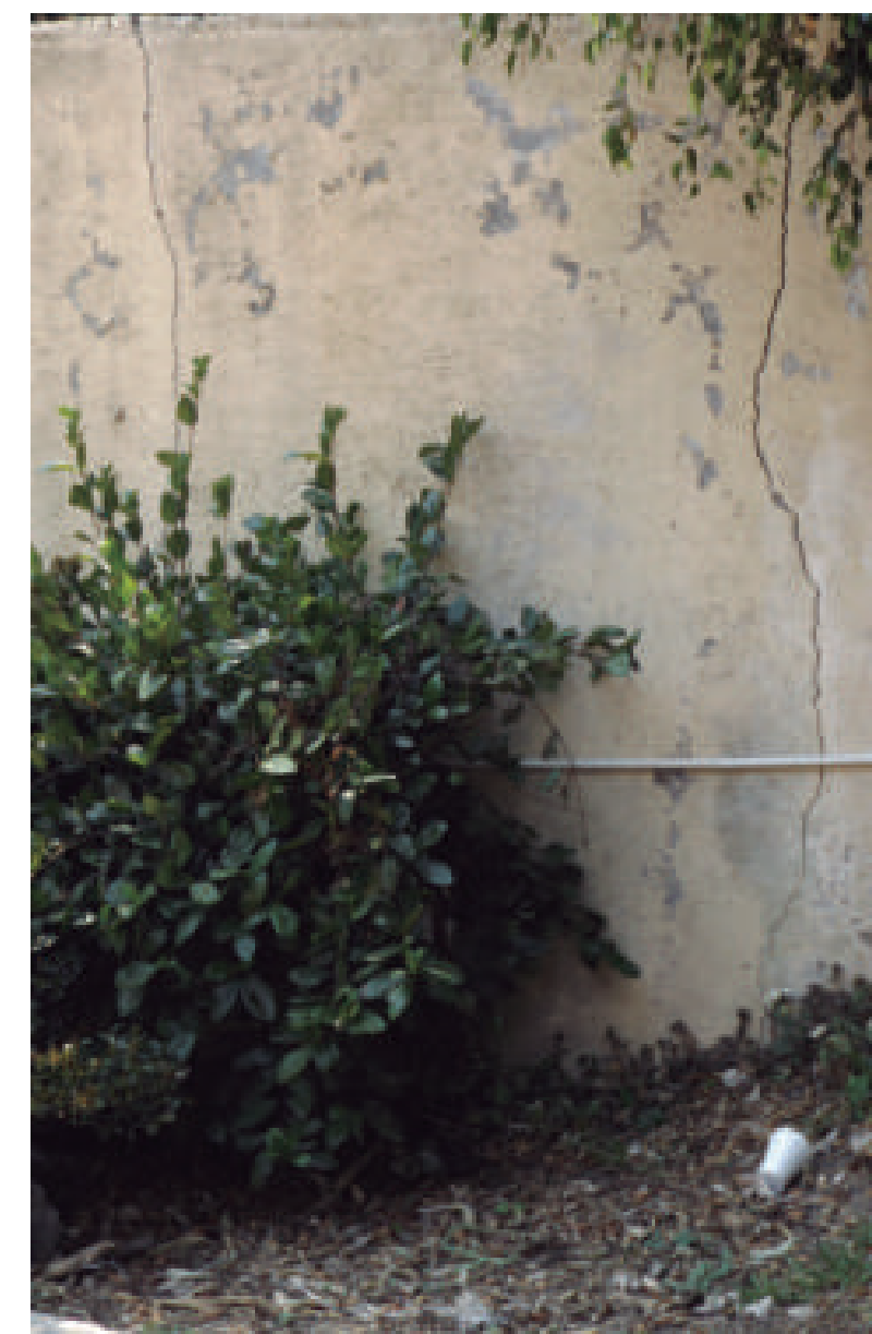
Figura 5.52. Fotografía B de la imagen 6 de vulnerabilidad del polígono Tamarindos. Barda perimetral asentada sobre una ladera inestable; dicha barda presenta fracturas por la remoción del material sobre el que se encuentra desplantada (19.3836° N, 99.2589° W. Calle: Bosque de Cazuarinas).
