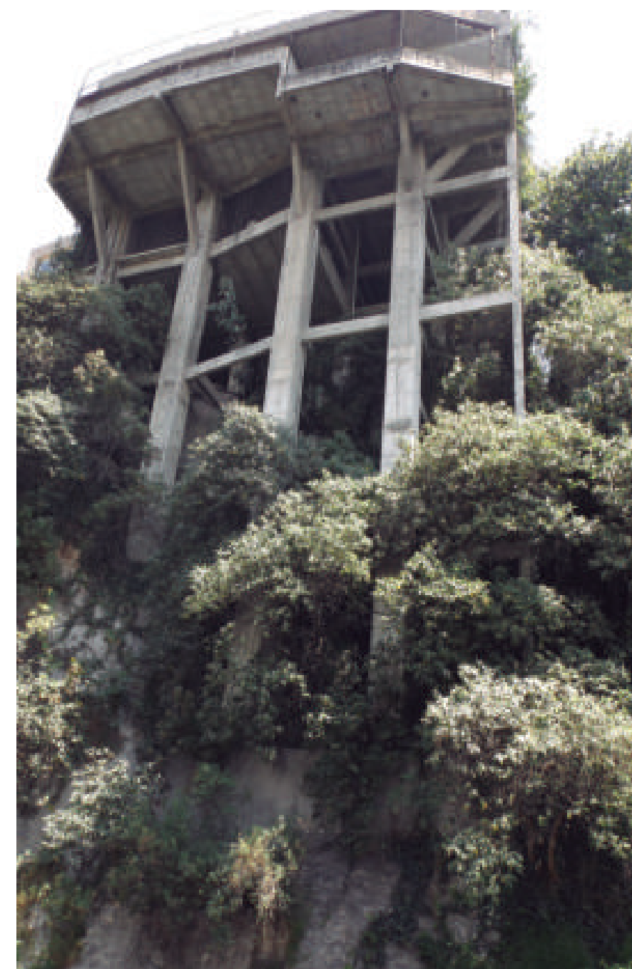
Obra negra desplantada en un talud sostenida por columnas delgadas de cemento en la colonia Tamarindos.
