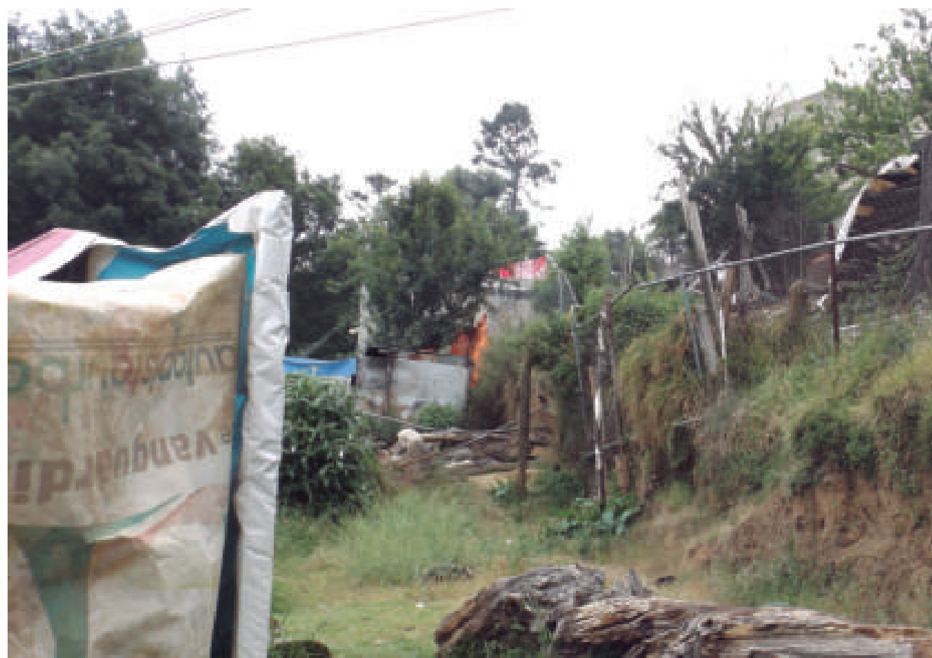
Figura 5.63. Fotografía C de la imagen 7 de vulnerabilidad del polígono Santa Rosa. Construcción precaria asentada sobre un talud con una pendiente de 40° aproximadamente (19.3237° N, 99.2954° W. Calle: sin nombre oficial).
