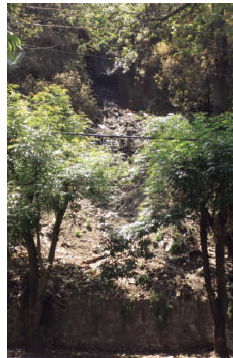
Figura 5.47. Fotografía B del polígono de peligro Tamarindos. Cicatriz de derrumbe en un talud expuesto. Se observa que los materiales que componen la ladera están altamente hidratados debido a la ruptura de un tubo de drenaje de una vivienda que se encuentra en la parte superior del talud, esto favorece al transporte de los materiales hacia la parte baja debido al aumento de peso y lubricación de los mismos (19.3756° N, 99.2633° W. Calle: Lomas de Tlapexco).
