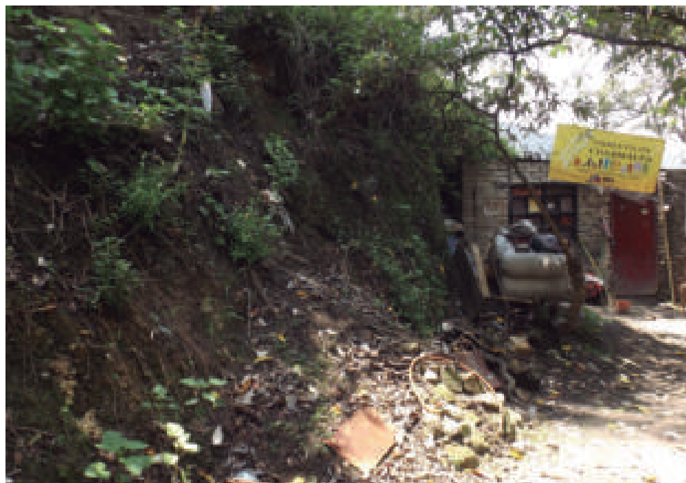
Figura 5.67. Fotografía B del polígono de peligro Ahuatenco. Construcción precaria ubicada debajo de un talud vertical inestable; dicha construcción se encuentra desplantada a menos de un metro de otro talud vertical en la parte frontal de la misma. Se puede observar en los depósitos que el material es altamente deleznable (19.3685° N, 99.3052° W. Calle: sin nombre oficial).
