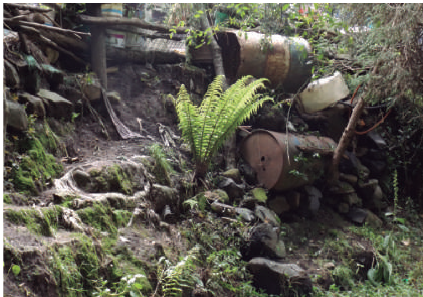
Figura 5.99. Fotografía B de la imagen 11 de vulnerabilidad del polígono Acopilco. Muro de contención elaborado con costales apilados rellenos, desechos y botes de aluminio oxidado sobre el cual se desplanta una vivienda; se puede apreciar el deterioro de los materiales (19.3372° N, 99.3225° W. Calle: sin nombre oficial).
