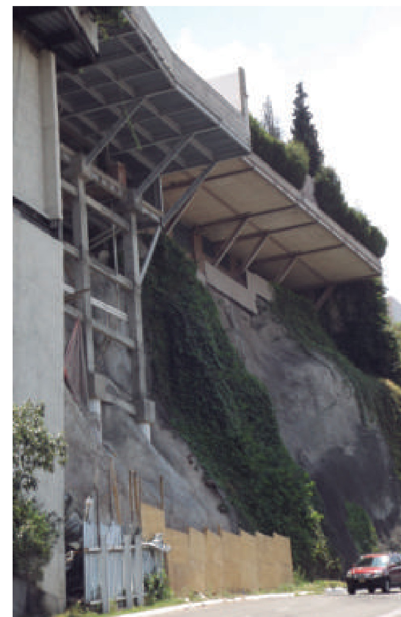
Figura 5.54. Fotografía D de la imagen 6 de vulnerabilidad del polígono Tamarindos. Construcciones que presentan volados, asentadas sobre un talud cubierto de concreto lanzado; las mismas son sostenidas por pilotes de cemento reforzado e infraestructura de hierro; los pilotes de la construcción están cimentados sobre una plancha de concreto (19.3929° N, 99.2486° W. Calle: Bosque de Guanábanos).
