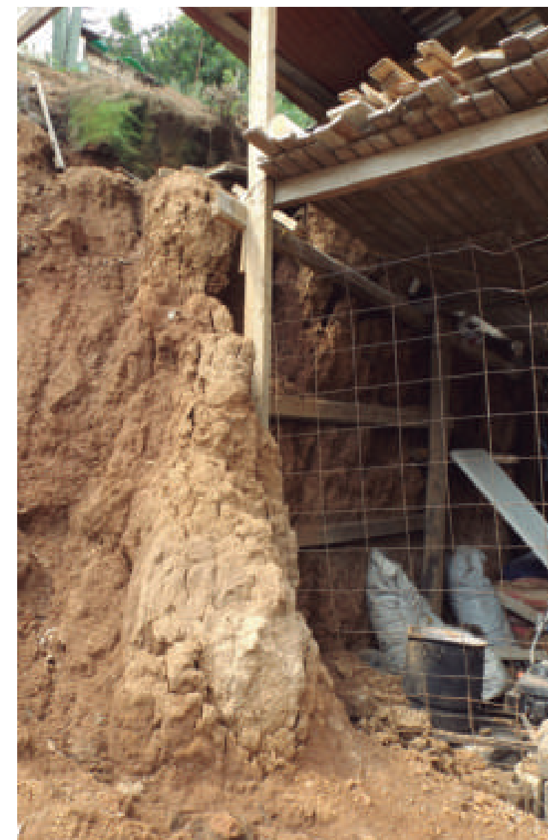
Figura 5.81. Fotografía B de la imagen 9 de vulnerabilidad del polígono 16 de Septiembre. Corte vertical en un talud inestable con los depósitos volcánicos expuestos que están siendo removidos por erosión; el corte se hizo con fines constructivos (19.3694° N, 99.3110° W. Calle: sin nombre oficial).
