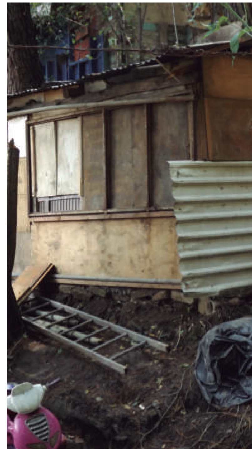
Figura 5.156. Fotografía A de la imagen 18 de vulnerabilidad del polígono Valle Conejos. Vivienda precaria construida con materiales como madera y lámina, que tiene como basamento tabiques sobrepuestos en terreno irregular (19.3391° N, 99.2897° W. Calle: sin nombre oficial).
