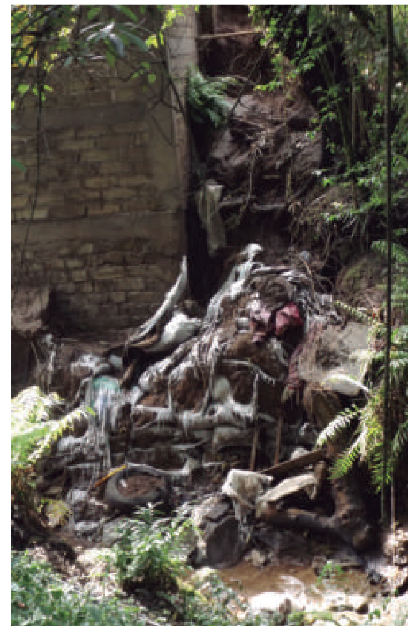
Figura 5.100. Fotografía C de la imagen 11 de vulnerabilidad del polígono Acopilco. Costales rellenos, apilados con el propósito de conformar un muro de contención; el deterioro por la erosión de los mismos es avanzado. Al fondo de la fotografía se observa un talud aledaño a una construcción, el cual presenta remoción del material (19.3357° N, 99.3243° W. Calle: sin nombre oficial).
