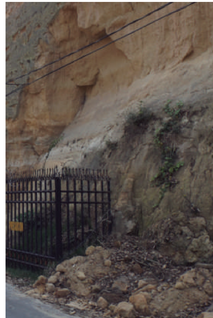
Derrumbe de un talud en la colonia Tejocotes.
