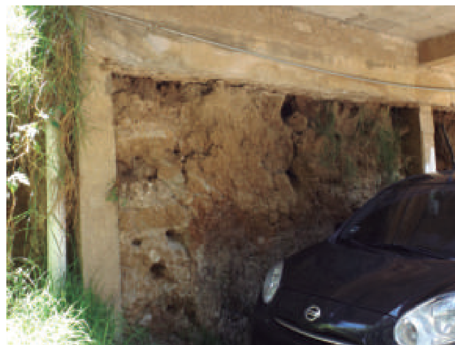
Figura 5.106. Fotografía A de la imagen 12 de vulnerabilidad del polígono Texcalco. Basamento erosionado carente de protección o recubrimiento, sobre el cual se asienta una construcción. La vivienda es sostenida por algunos pilares de cemento (19.3329° N, 99.3296° W. Calle: Pitorreal).
