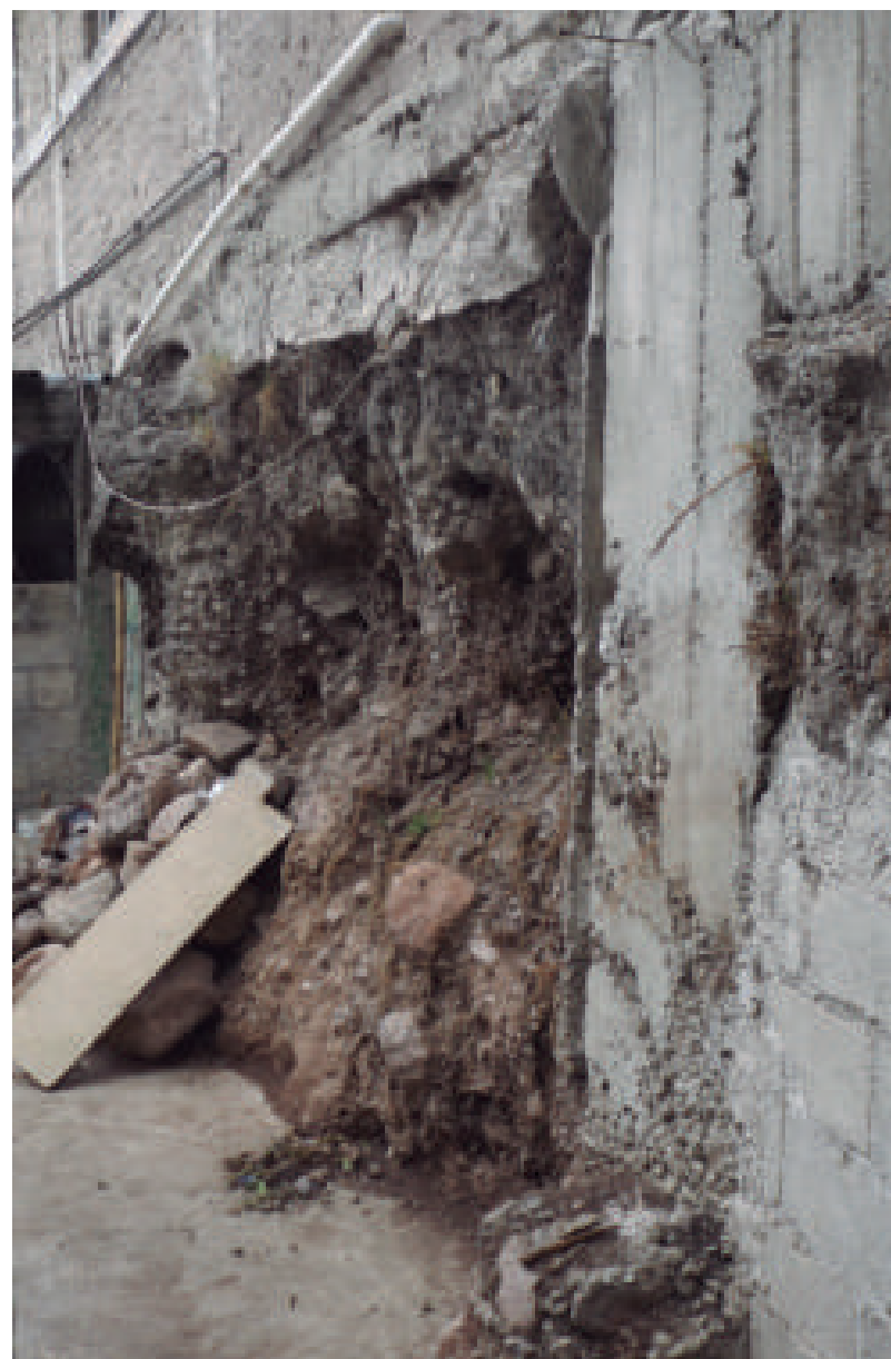
Figura 5.14. Fotografía B del polígono de peligro 25 de Diciembre. Cimientos descubiertos de una vivienda desplantada sobre terreno inestable; la erosión y otros factores ambientales provocan que los materiales deleznable se desprendan, lo cual causa afectaciones en la construcción (19.3810° N, 99.2816° W Calle: sin nombre oficial).
