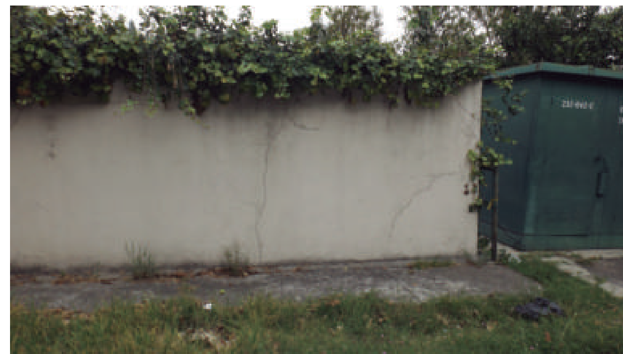
Figura 5.44. Fotografía D de la imagen 5 de vulnerabilidad del polígono Tejocotes. Muro perimetral fracturado desplantado en la parte alta de una ladera; a un costado se observa una subestación eléctrica que presenta inclinación en dirección a la pendiente (19.3922° N, 99.2562° W. Calle: Bosque de Bugambilias).
