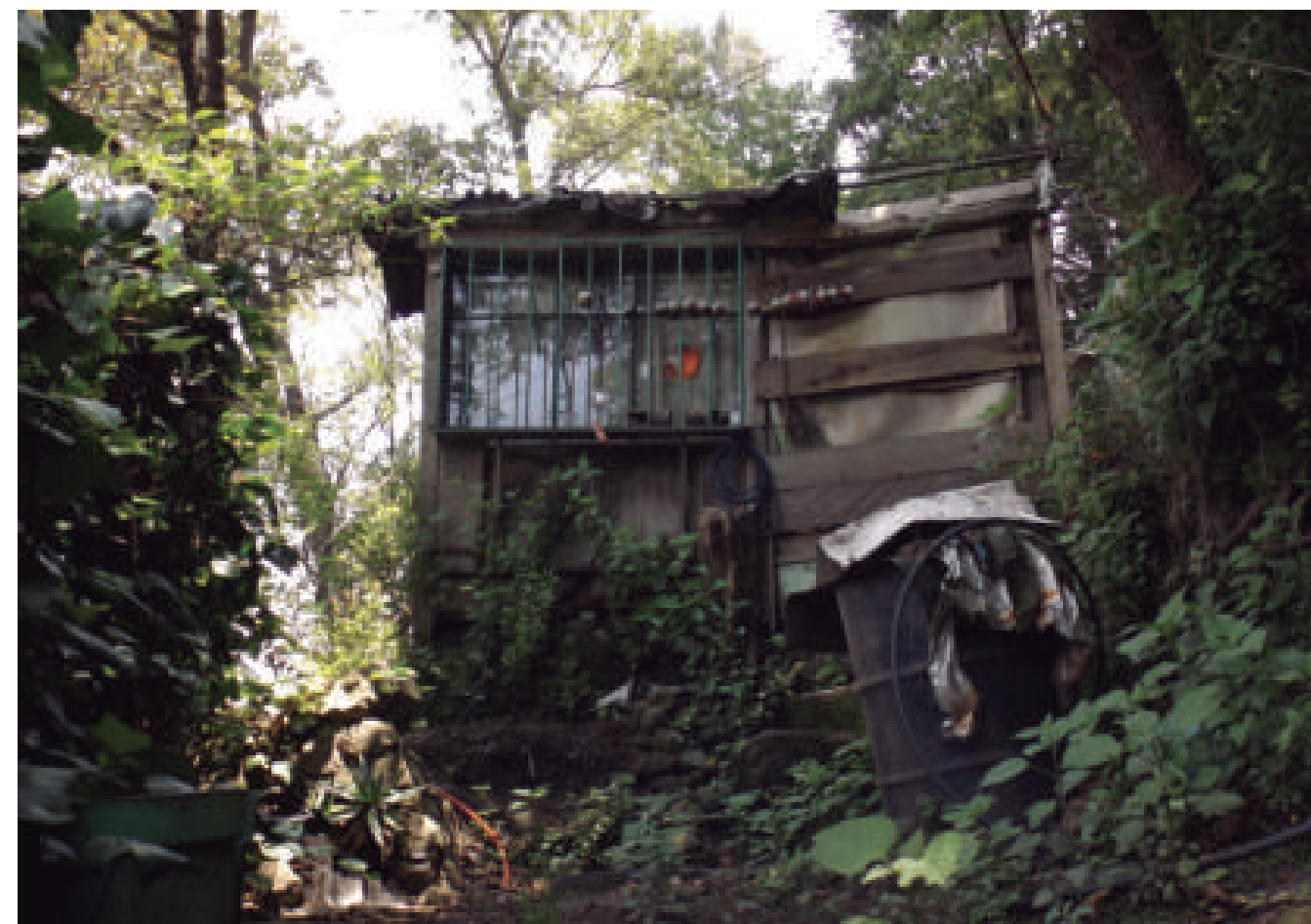
Figura 5.74. Fotografía D de la imagen 8 de vulnerabilidad del polígono Ahuatenco. Vivienda desplantada sobre una terraza antrópica. La construcción está elaborada con tablas de madera y láminas en el techo. Se puede distinguir que la vivienda presenta inclinación con respecto a la dirección de la remoción de los materiales ladera abajo (19.3687° N, 99.3053° W. Calle: sin nombre oficial).
