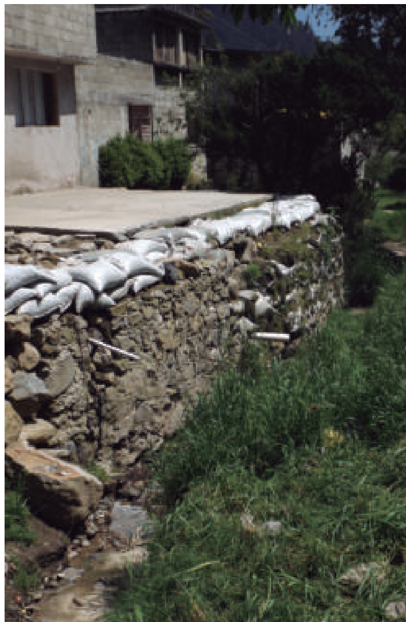
Figura 5.123. Fotografía C de la imagen 14 de vulnerabilidad del polígono San Bernabé. Vivienda a orillas de un cauce que intenta ganar espacio sobre el muro de contención, compuesto de mampostería con mortero y costales rellenos apilados con un nivel avanzado de erosión (19.3101° N, 99.3374° W. Calle: sin nombre oficial).
