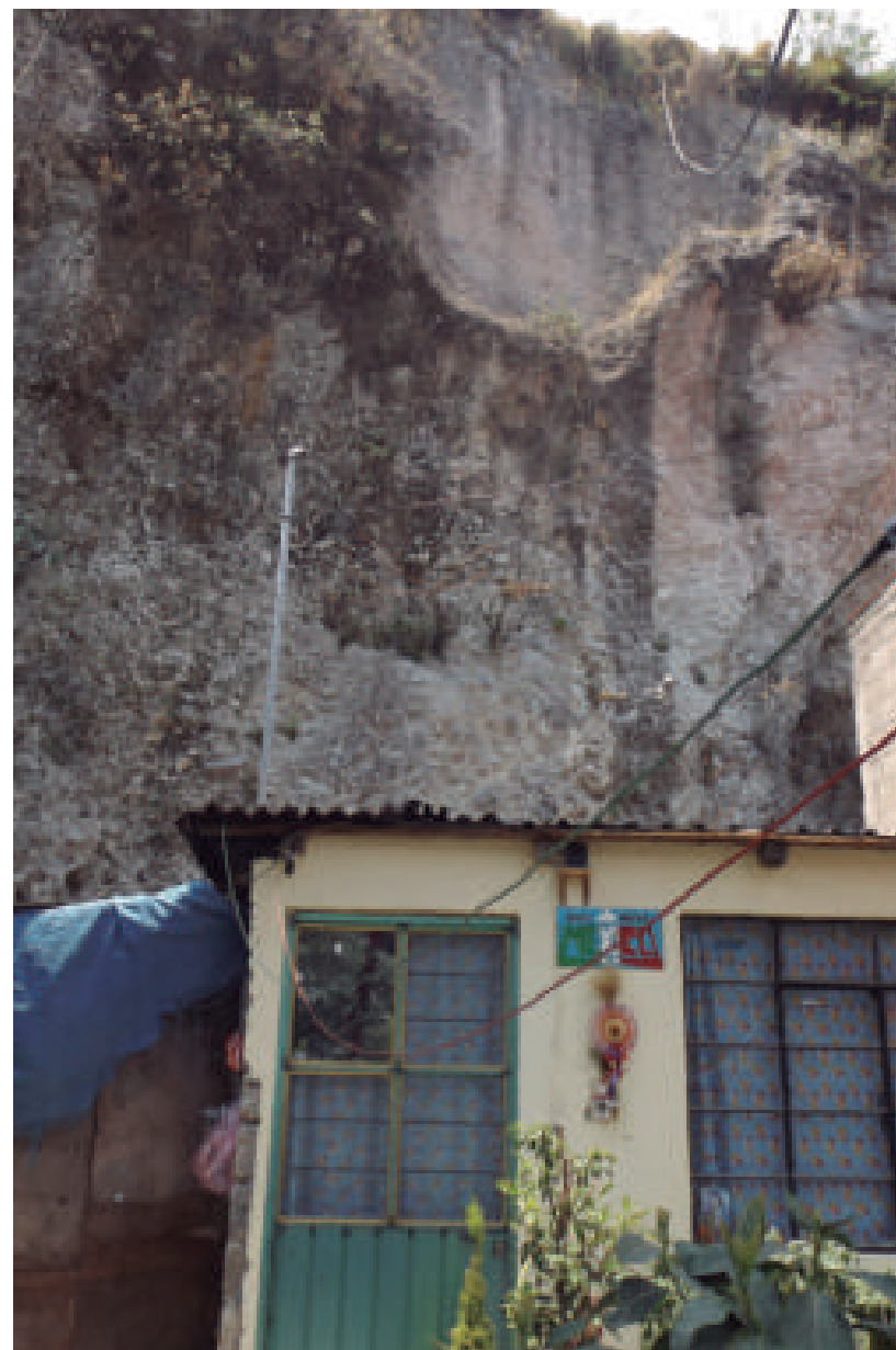
Figura 5.144. Fotografía B del polígono de peligro Vista Hermosa. Vivienda desplantada al pie de un talud de aproximadamente 20 m compuesto de depósitos de flujos piroclásticos que no cuenta con algún tipo de protección o recubrimiento; en la parte superior se distingue una cicatriz de derrumbe (19.3682° N, 99.2769° W. Calle: sin nombre oficial).
