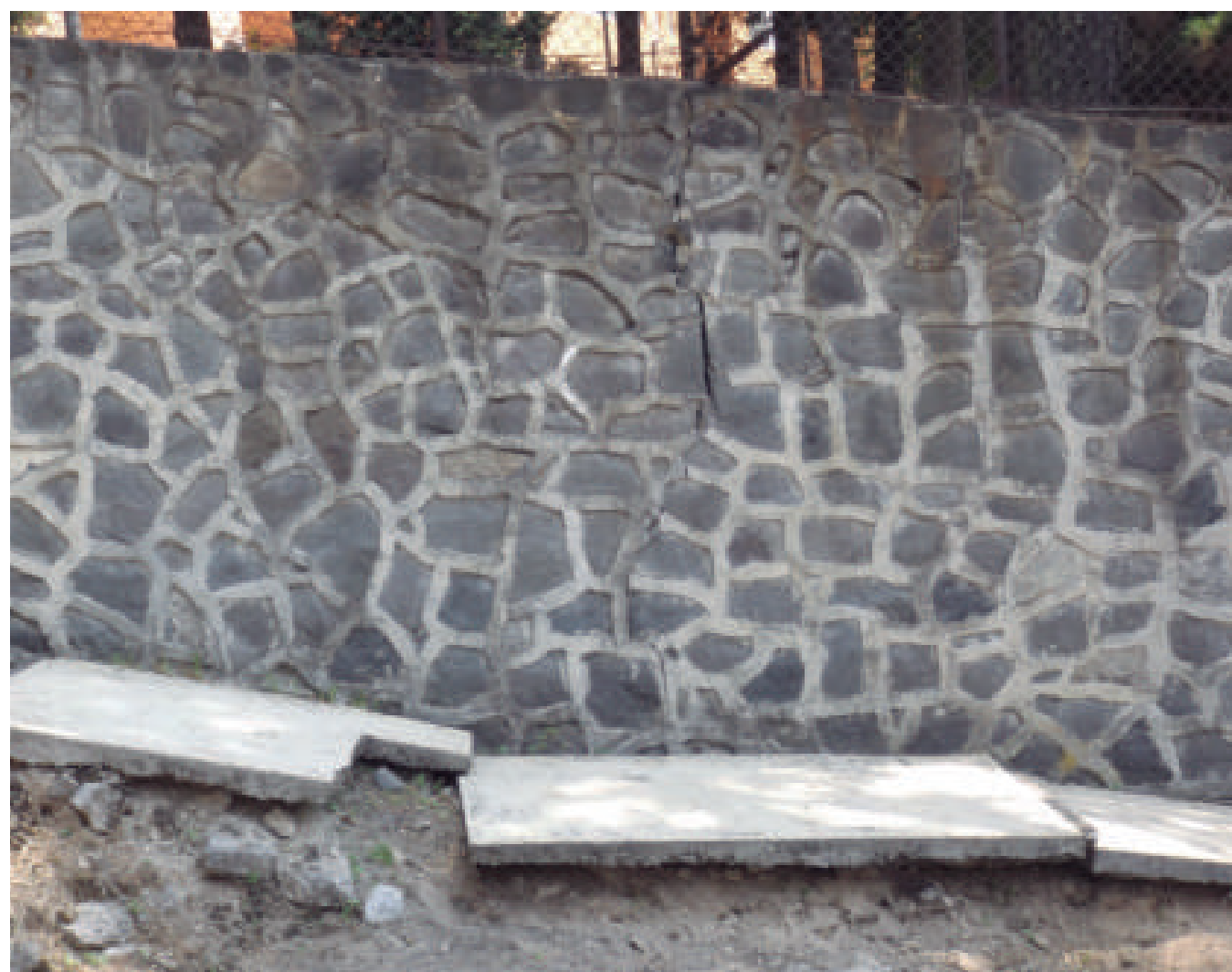
Figura 5.51. Fotografía A de la imagen 6 de vulnerabilidad del polígono Tamarindos. Muro de mampostería aledaño a la ladera que se encuentra fracturado debido a la remoción del material. Abajo del muro se observa que la banqueta también ha sido afectada; bajo dicha banqueta se pueden observar los materiales poco compactos e inestables (19.3751° N, 99.2707° W. Calle: Lomas de Tlapexco).
