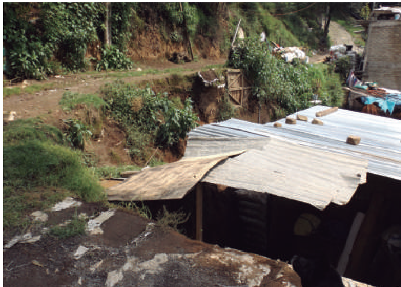
Figura 5.89. Fotografía A de la imagen 10 de vulnerabilidad del polígono San Pablo Chimalpa. Vivienda precaria asentada a orillas de un corte artificial en la ladera para construcción; en la parte superior del talud se distingue una cicatriz de derrumbe y al pie de la vivienda hay depósitos del material que colapsó (19.3535° N, 99.3126° W. Calle: sin nombre oficial).
