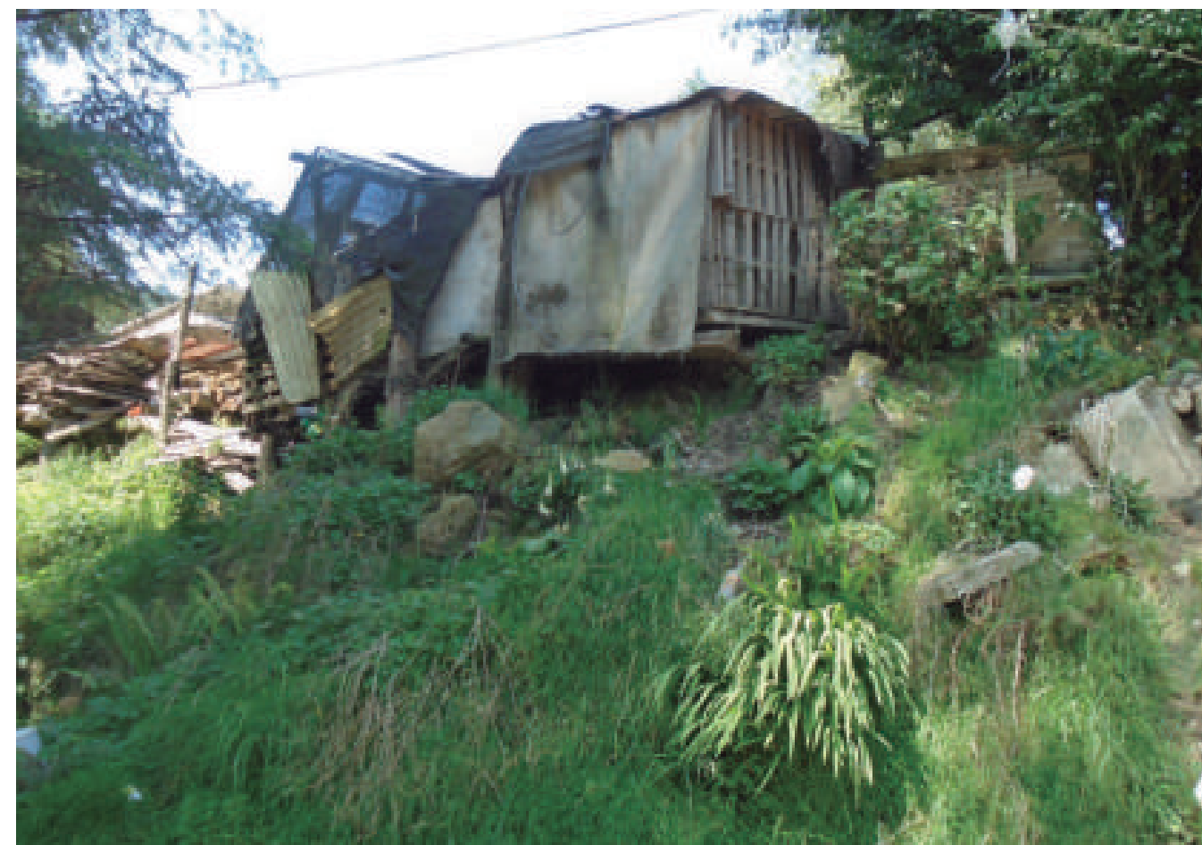
Figura 5.124. Fotografía D de la imagen 14 de vulnerabilidad del polígono San Bernabé. Construcción precaria desplantada en la cima de un talud compuesto de material inestable que presenta un volado carente de soporte debido a la remoción del material que usaba como cimientos (19.3082° N, 99.3373° W. Calle: Camino Llano Conejo).
