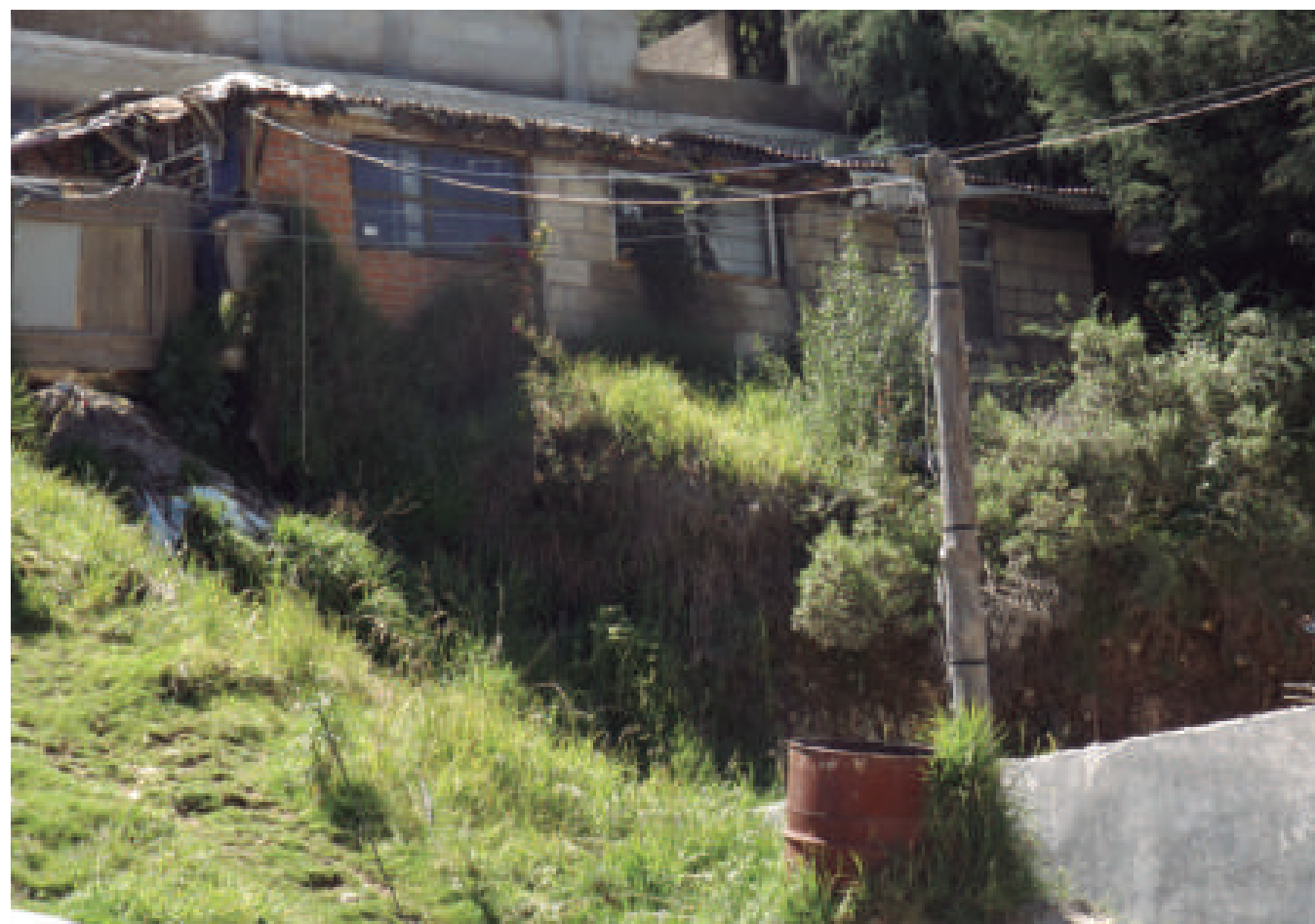
Figura 5.121. Fotografía A de la imagen 14 de vulnerabilidad del polígono San Bernabé. Vivienda de mampostería (tabique) semiconfinada desplantada a orillas de un talud inestable; la parte de la construcción que se distingue del lado izquierdo de la fotografía presenta un volado (19.3092° N, 99.3408° W. Calle: Camino a San Bernabé).
