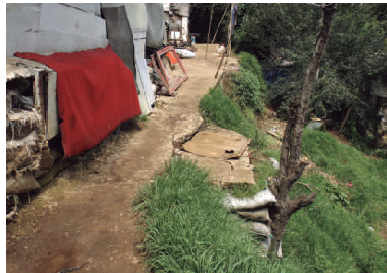
Figura 5.158. Fotografía C de la imagen 18 de vulnerabilidad del polígono Valle Conejos. El pavimento de un paso peatonal desplantado sobre un talud, presenta fracturas y colapsos parciales debido a la remoción del material que constituye su basamento. Estas áreas fueron rellenadas con costales apilados (19.3386° N, 99.2890° W. Calle: sin nombre oficial).
