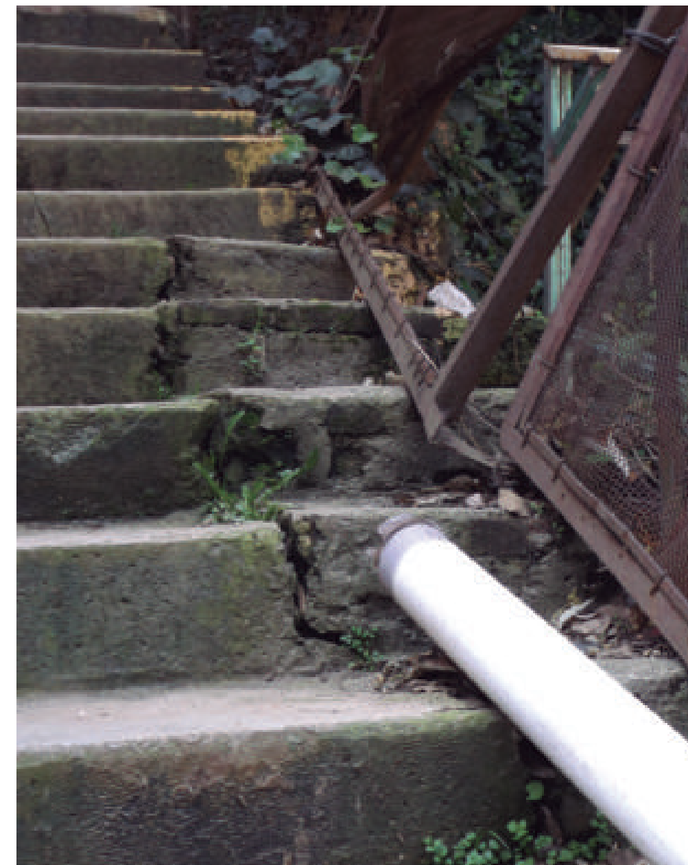
Figura 5.140. Fotografía B de la imagen 16 de vulnerabilidad del polígono La Monera. Escalera utilizada como paso peatonal desplantada a un costado de un talud inestable. Se puede observar que la vía de comunicación presenta una fractura de 5 cm de apertura, causada por la remoción del material sobre el que está asentada (19.3423° N, 99.2850° W. Calle: sin nombre oficial).
