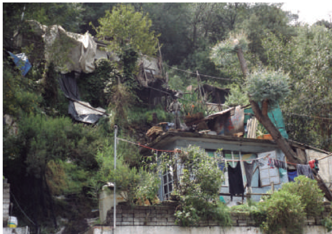
Figura 5.91. Fotografía C de la imagen 10 de vulnerabilidad del polígono San Pablo Chimalpa. Viviendas precarias construidas frente a taludes verticales que anteriormente han presentado derrumbes o deslizamientos; en la parte central de la fotografía se puede observar un volado sostenido por polines de madera (19.3479° N, 99.3167° W. Calle: Puerto México).
