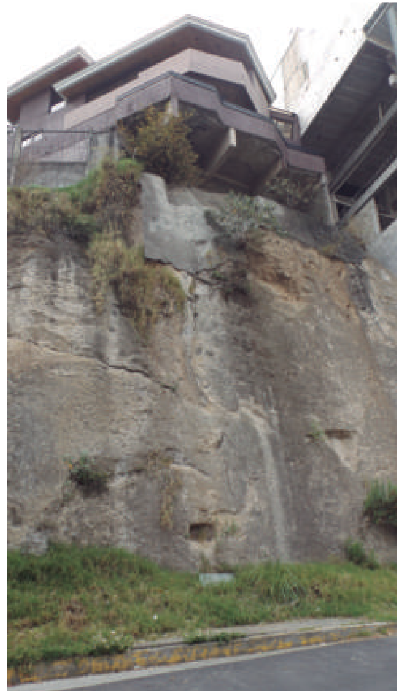
Figura 5.38. Fotografía C del polígono de peligro Tejocotes. Afloramiento de materiales deleznales (bloques y cenizas). El talud cuenta con una altura de aproximadamente 15 m donde se encuentra asentada una vivienda. En la parte superior se puede observar una porción que tiene concreto lanzado que ha sido fracturado y removido casi en su totalidad (19.3889° N, 99.2559° W. Calle: Bosque de Canelos).
