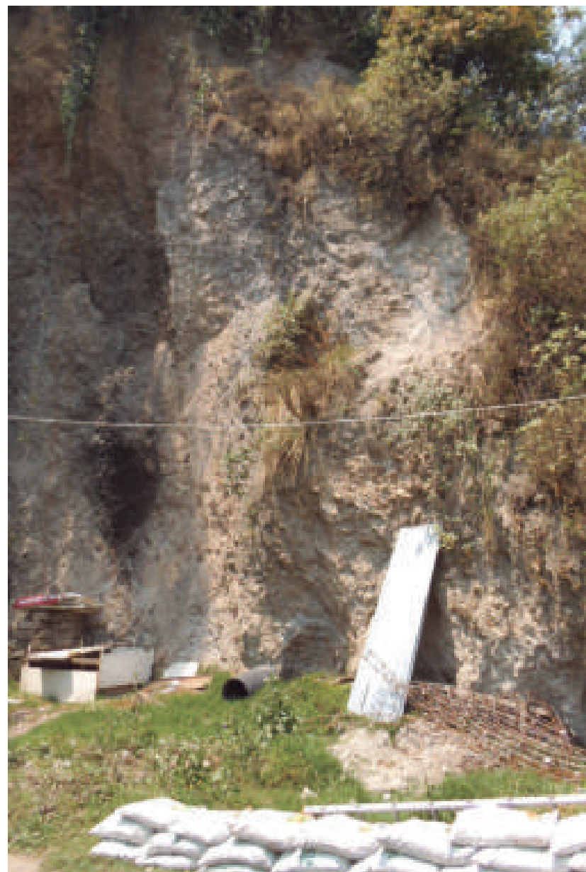
Figura 5.143. Fotografía A del polígono de peligro Vista Hermosa. Se observa un talud de aproximadamente 20 m de altura, compuesto de bloques y cenizas, que se encuentra expuesto a la erosión. Al pie del mismo se distinguen algunos costales rellenos apilados para la construcción de un muro de contención (19.3694° N, 99.2771° W. Calle: sin nombre oficial).
