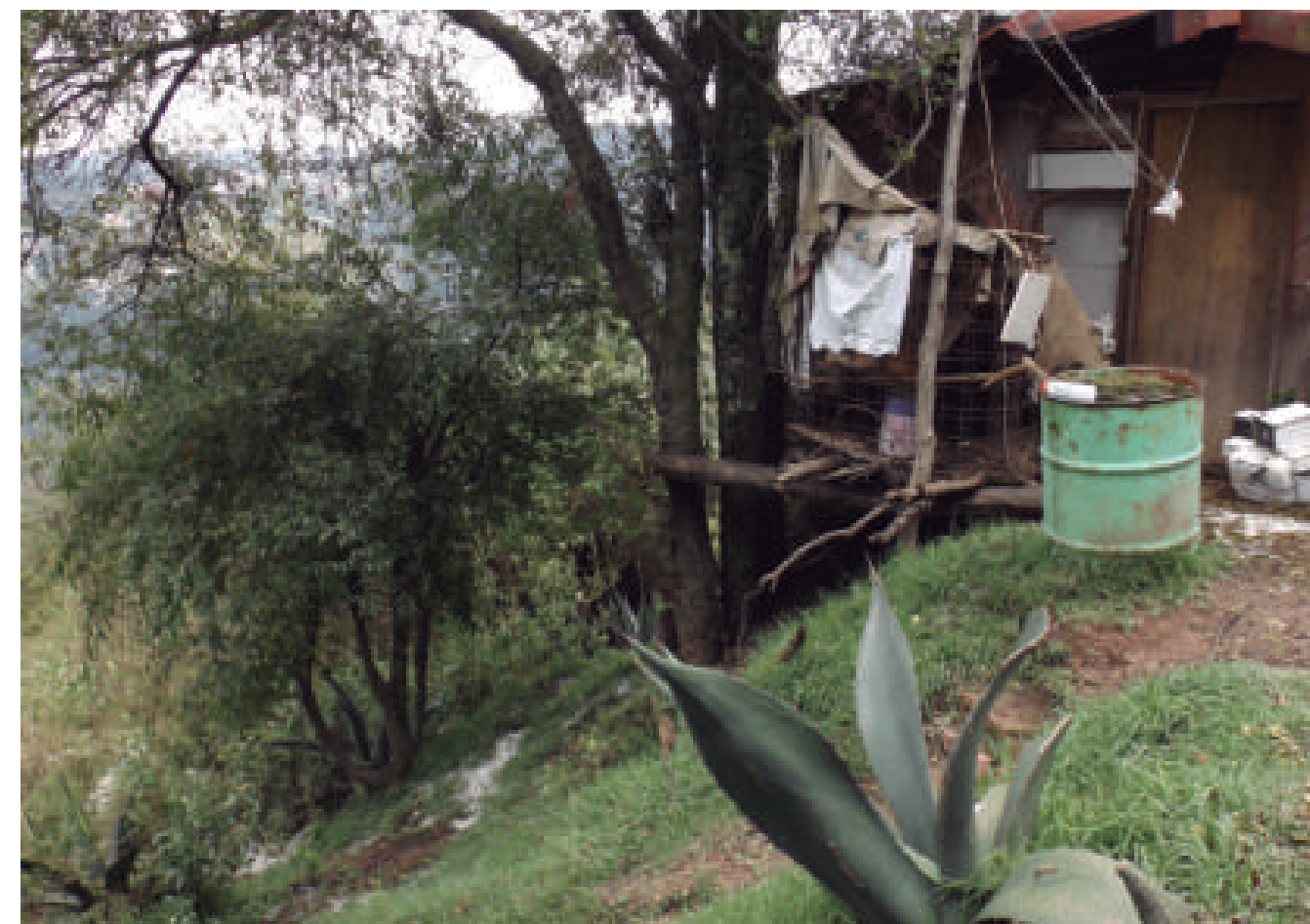
Figura 5.92. Fotografía D de la imagen 10 de vulnerabilidad del polígono San Pablo Chimalpa. Construcción precaria asentada a la orilla de una ladera con una inclinación de 50°; al centro de la fotografía se puede observar que el inmueble presenta un volado con polines de madera y apoyado sobre árboles (19.3496° N, 99.3219° W. Calle: Camino a San Pablo Chimalpa-Teopanzolco).
