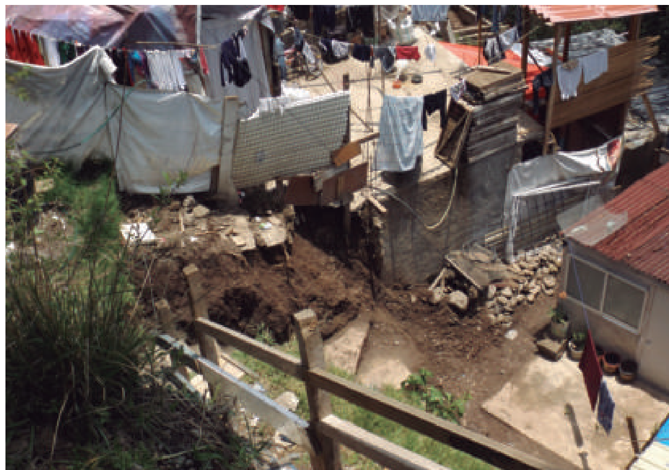
Figura 5.73. Fotografía C de la imagen 8 de vulnerabilidad del polígono Ahuatenco. Viviendas ubicadas bajo un talud compuesto de material inestable: el material de relleno (suelo) constituye el basamento de una de las viviendas; en la parte central de la fotografía se observa un área del basamento que presenta alta remoción de material (19.368599° N, 99.3044° W. Calle: sin nombre oficial).
