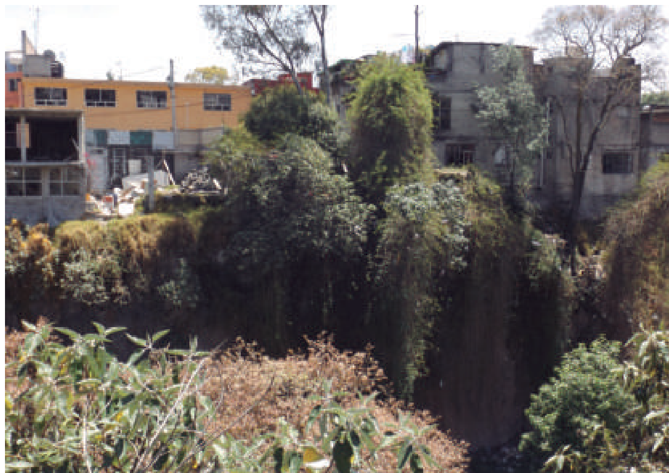
Figura 5.10. Fotografía B de la imagen 1 de vulnerabilidad del polígono San José de los Cedros. Construcciones desplantadas sobre la orilla de uno de los flancos de la barranca; el talud no tiene algún tipo de cubierta que proteja a los materiales de la erosión (19.3739° N, 99.2892° W. Calle: Retama).
