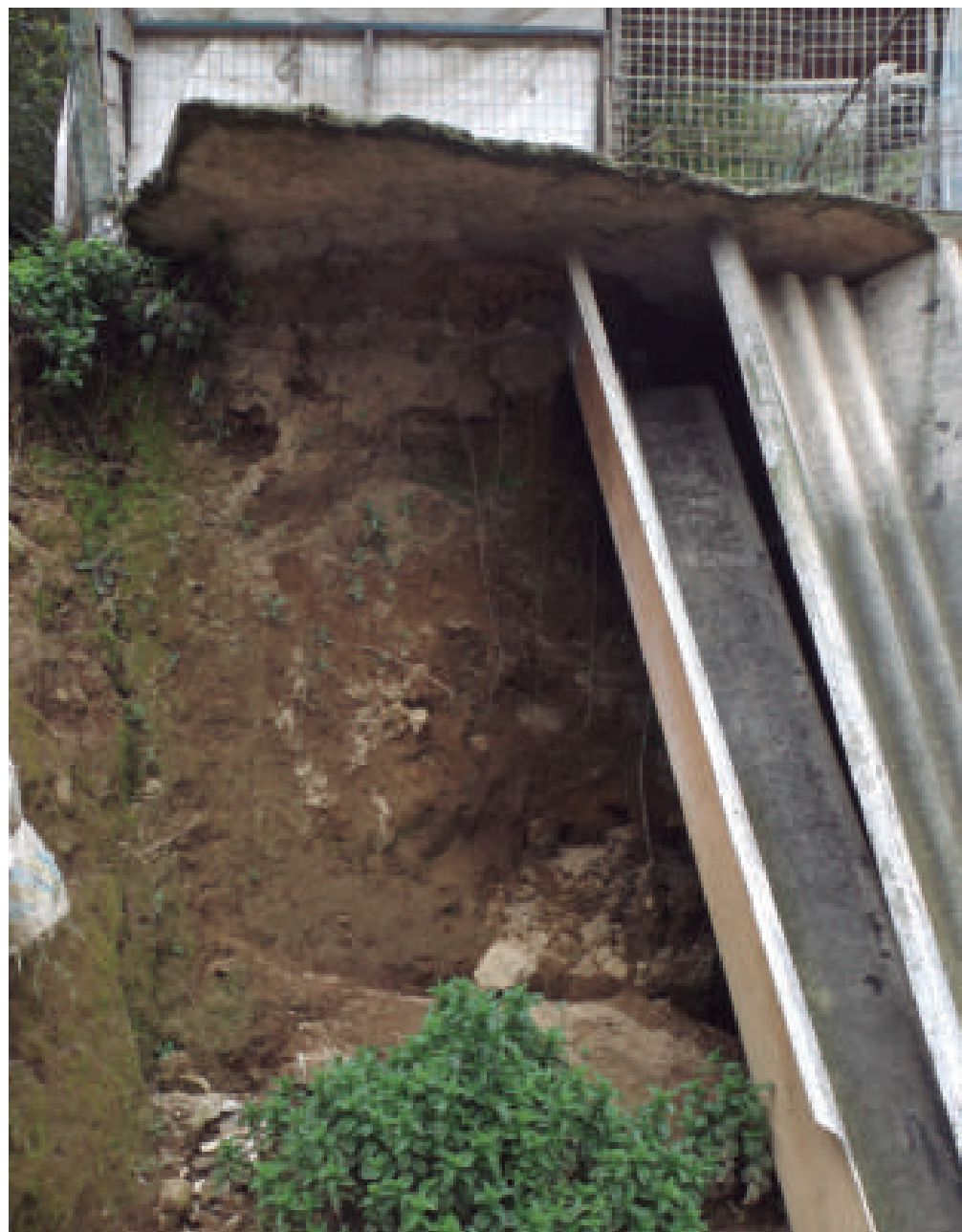
Figura 5.126. Fotografía B del polígono de peligro Las Lajas. Derrumbe de material sobresaturado ocurrido en un talud con una pendiente aproximada de 60° sobre el que se asienta un muro de mampostería con mortero; frente al derrumbe se encuentra una vivienda precaria (19.3139° N, 99.3333° W. Calle: Las Lajas).
