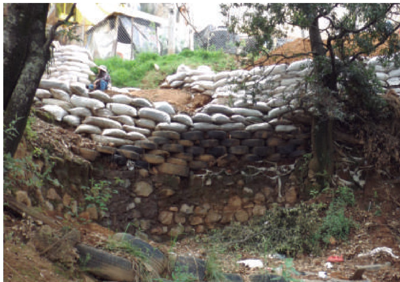
Figura 5.80. Fotografía A de la imagen 9 de vulnerabilidad del polígono 16 de Septiembre. Muro de contención desplantado al costado de un talud vertical con el fin de detener los materiales altamente deleznales que lo componen; dicho muro está elaborado con materiales de bajo costo como costales apilados rellenos de material de sitio, llantas usadas y mampostería (19.3694° N, 99.3110° W. Calle: sin nombre oficial).
