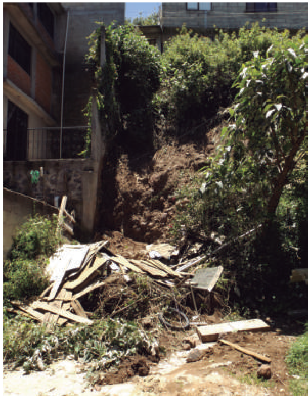
Figura 5.102. Fotografía A del polígono de peligro Texcalco. Talud expuesto que ha presentado derrumbe del material compuesto de suelo y bloques. Se observa la falta de vegetación en la superficie de erosión (19.3327° N, 99.3295° W. Calle: Pitorreal).
