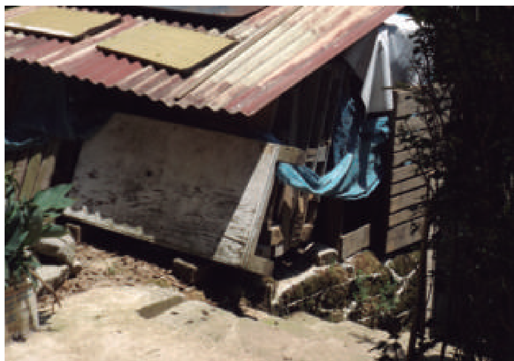
Figura 5.141. Fotografía C de la imagen 16 de vulnerabilidad del polígono La Monera. Vivienda hecha con materiales precarios y poco resistentes ante los fenómenos de remoción en masa. Dicha construcción está desplantada sobre un talud inestable cuyos materiales están en continua remoción, por lo cual la vivienda presenta inclinación favorable a la pendiente. Los cimientos están elaborados con costales rellenos apilados, los cuales se encuentran deteriorados (19.3406° N, 99.2869° W. Calle: sin nombre oficial).
