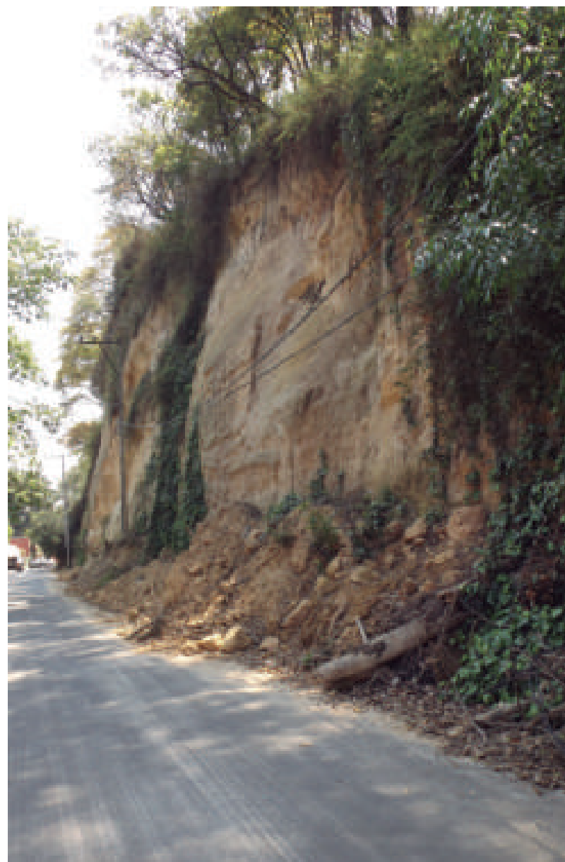
Figura 5.46. Fotografía A del polígono de peligro Tamarindos. Se observa la presencia de suelo en la parte superior del talud. El desprendimiento del material pone en peligro a los usuarios del camino así como de las viviendas que se encuentran enfrente del talud. El depósito de los materiales producto de los derrumbes que afectan la zona se puede observar en la parte baja, que en ocasiones obstruye la vía de comunicación (19.3748° N, 99.2689° W. Calle: Lomas de Tlapexco).
