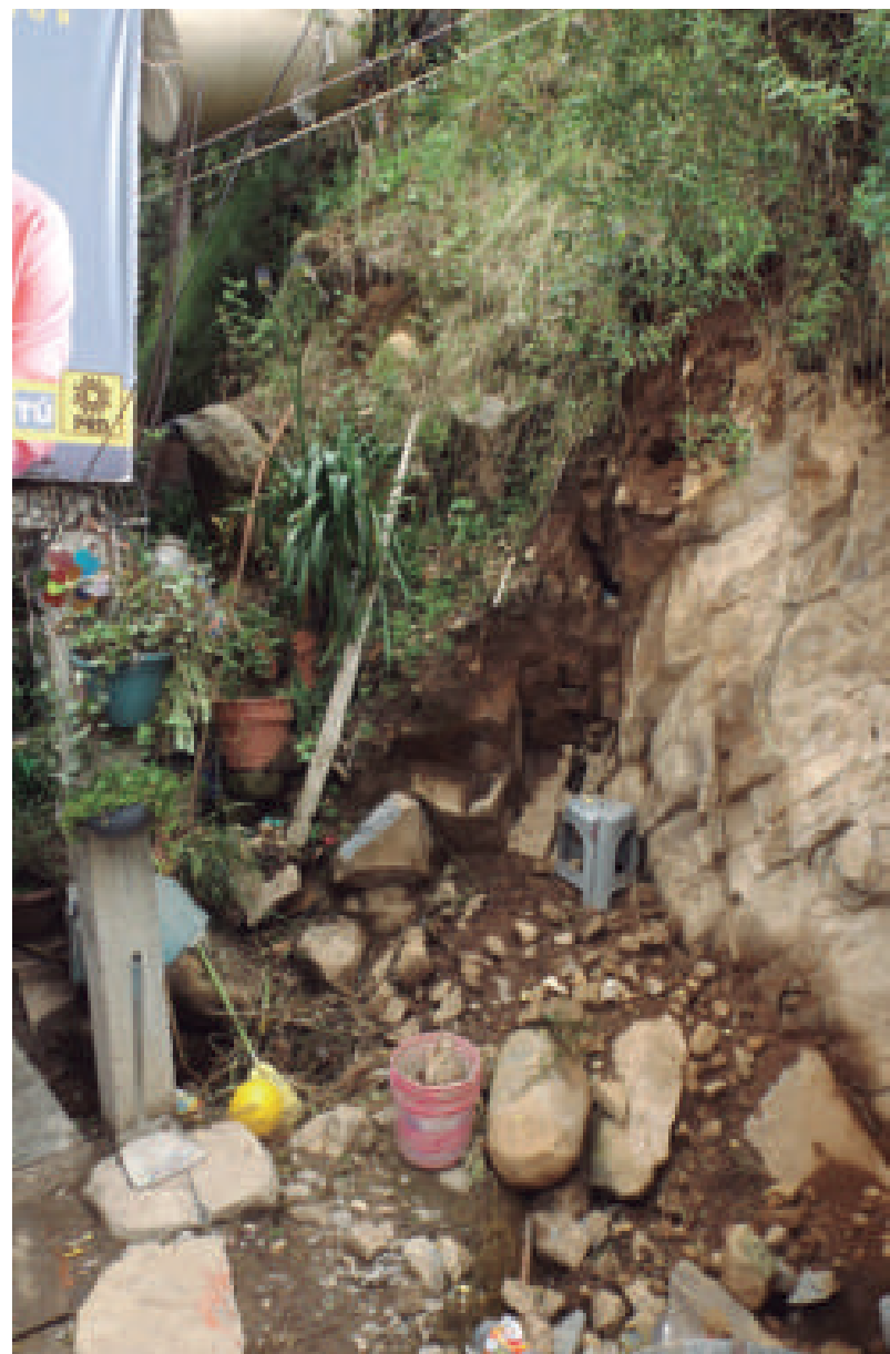
Figura 5.86. Fotografía C del polígono de peligro San Pablo Chimalpa. Ladera compuesta de bloques, algunos de los cuales han colapsado a causa de la erosión; se observa que el grado de intemperismo y fracturamiento de los mismos es alto (19.3521° N, 99.3119° W. Calle: Puerto México).
