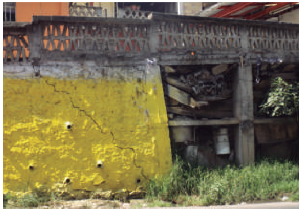
Figura 5.139. Fotografía A de la imagen 16 de vulnerabilidad del polígono La Monera. Muro fracturado por el arrastre del material que se ha removido, sobre el que se asienta una vivienda; al lado de éste se aprecian los cimientos descubiertos de la construcción de la parte superior, sostenidos por columnas de concreto poco resistentes (19.3443° N, 99.2830° W. Calle: México 68).
