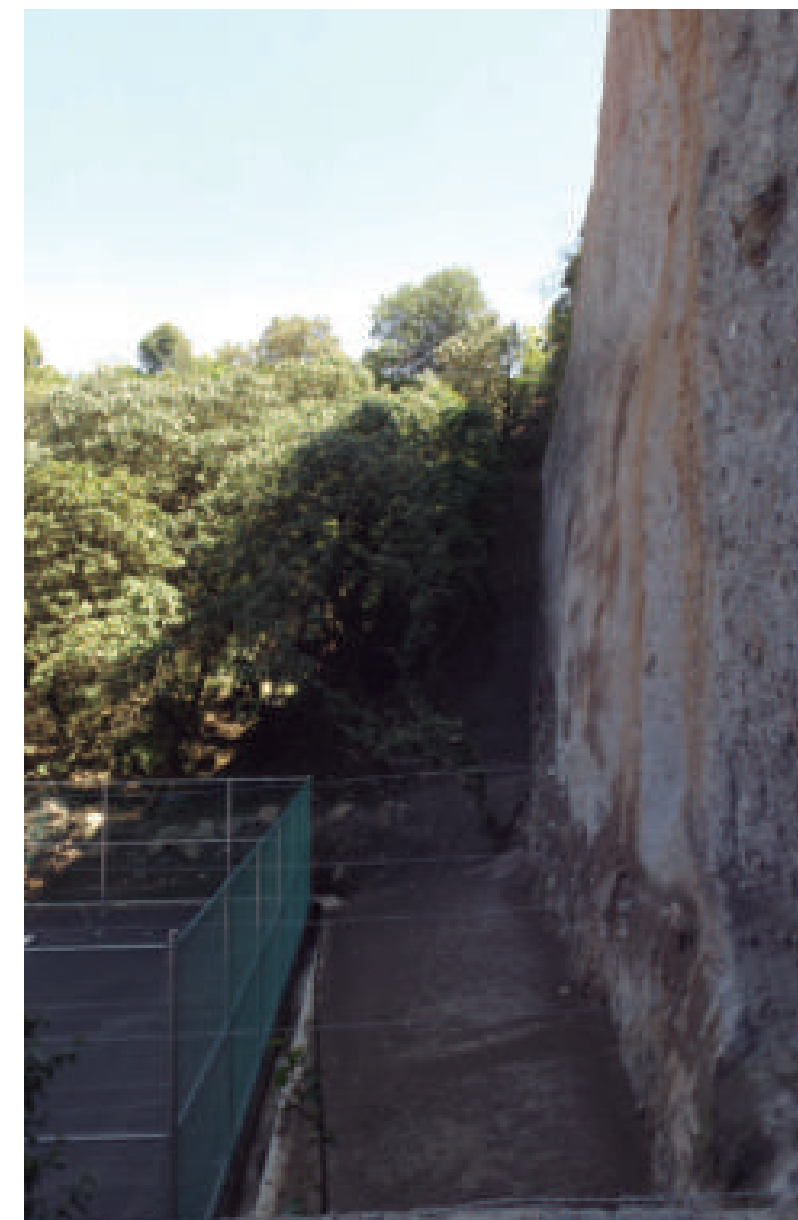
Figura 5.28. Fotografía C de la imagen 3 de vulnerabilidad del polígono Hueyatlaco. Talud de aproximadamente 30 m de altura compuesto de material deleznable (principalmente bloques y cenizas). Al ser una pared vertical y no contar con cubierta vegetal, el material del talud está expuesto y es removido fácilmente. En la parte baja se localiza un deportivo (19.3685° N, 99.2806° W. Calle: sin nombre oficial).
