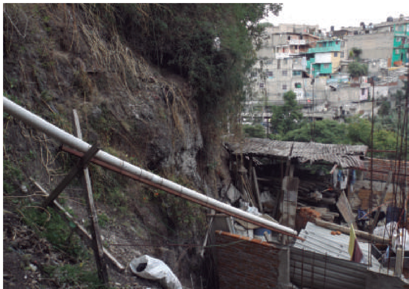
Figura 5.18. Fotografía B de la imagen 2 de vulnerabilidad del polígono 25 de Diciembre. Construcción precaria asentada a las orillas de un talud de aproximadamente 7 m de altura compuesto de depósitos volcánicos; a su vez, dicha construcción se encuentra en la orilla de uno de los flancos de la barranca (19.3811° N, 99.2817° W. Calle: sin nombre oficial).
