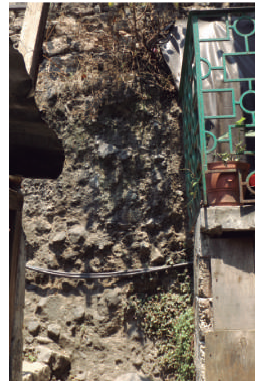
Figura 5.145. Fotografía C del polígono de peligro Vista Hermosa. Algunas viviendas aledañas a un talud compuesto de bloques con matriz de cenizas intemperizadas; no tiene algún tipo de protección o recubrimiento, dejando expuesto el material litológico a la erosión (19.3678° N, 99.2771° W. Calle: sin nombre oficial).
