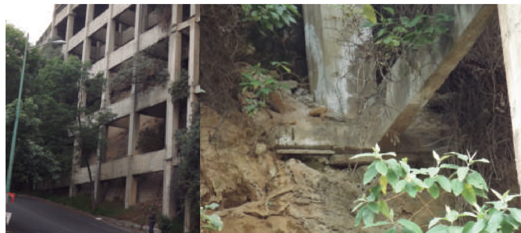
Figura 5.37. Fotografía B del polígono de peligro Tejocotes. Edificación desplantada a orillas de un talud compuesto de depósitos volcánicos poco compactos, intemperizados e inestables. En la fotografía de la derecha se distingue la remoción de los materiales en los cimientos de la construcción (19.3922° N, 99.2527° W. Calle: Bosque de Ocotes).
