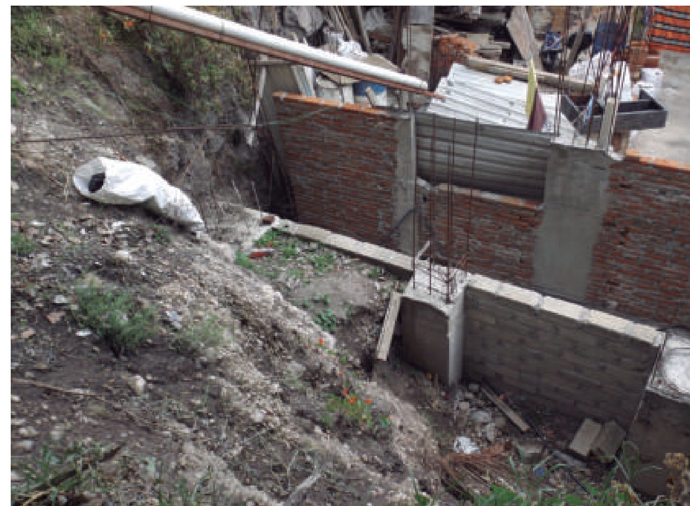
Figura 5.15. Fotografía C del polígono de peligro 25 de Diciembre. Obra negra desplantada al pie de un talud inestable. El talud supera en tamaño a los muros perimetrales de la construcción; por lo tanto, al haber un derrumbe quedaría totalmente cubierta (19.3811° N, 99.2817° W. Calle: sin nombre oficial).
