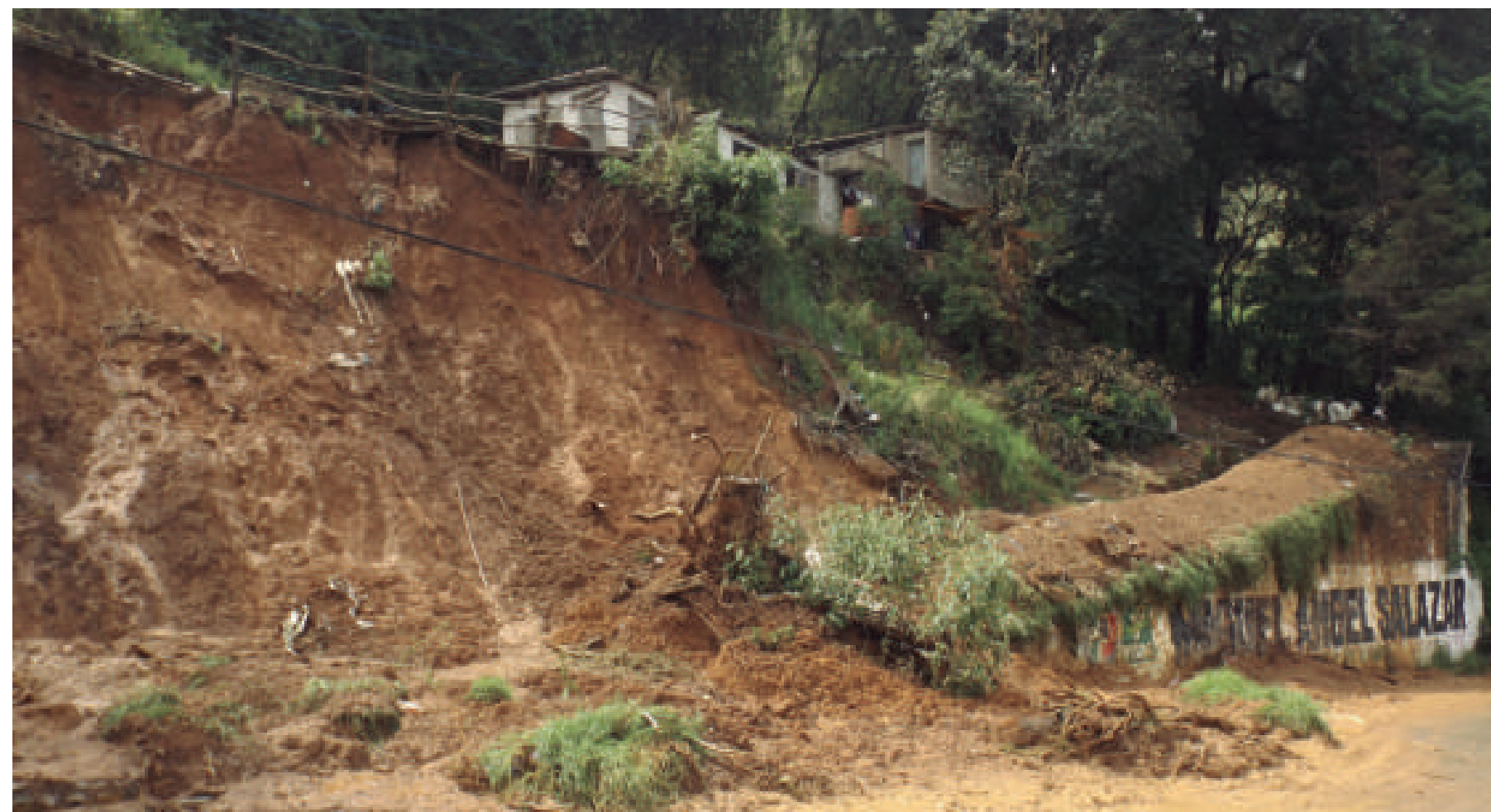
Deslizamiento en un talud inestable provocado por abundantes lluvias en San Pablo Chimalpa.
