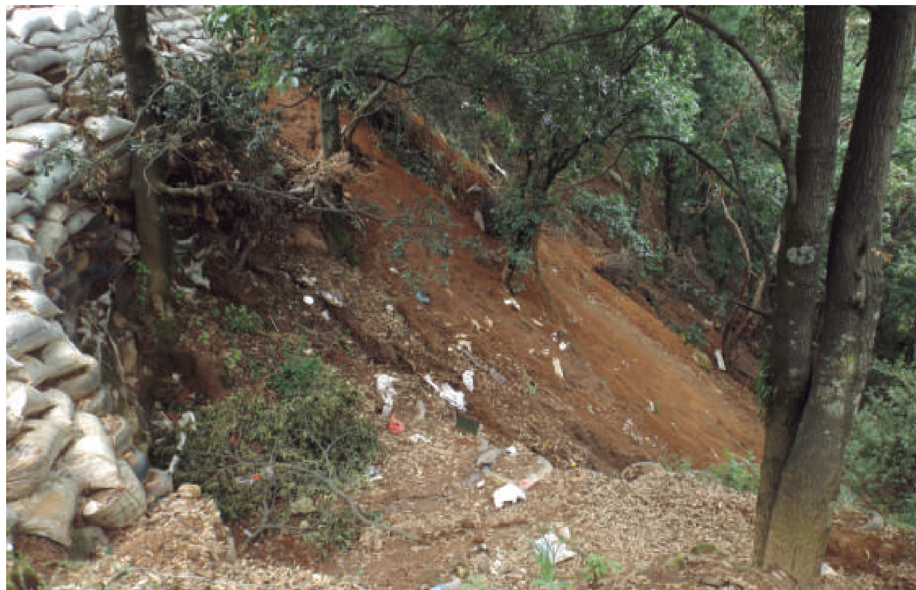
Talud inestable donde se observa la inclinación de la vegetación por el continuo desplazamiento de los materiales que lo componen en la colonia Ahuatenco.
