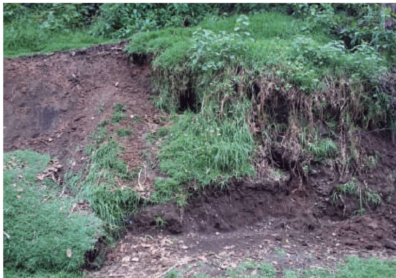
Figura 5.95. Fotografía B del polígono de peligro Acopilco. Se observa un talud altamente inestable que presenta depósitos en la parte baja del material litológico que ha colapsado; por la coloración se distingue la presencia de humedad (19.3378° N, 99.3242° W. Calle: Paseo del Bosque).
