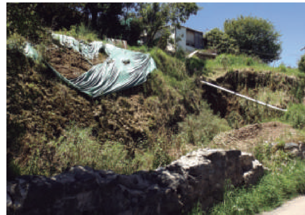
Figura 5.103. Fotografía B del polígono de peligro Texcalco. Talud elaborado con fines constructivos, cuyos materiales presentan un alto grado de erosión; en la cima se observa una lona de plástico deteriorada que fue colocada con el fin de cubrir el talud de los agentes erosivos (19.3311° N, 99.3297° W. Calle: Texcalco).
