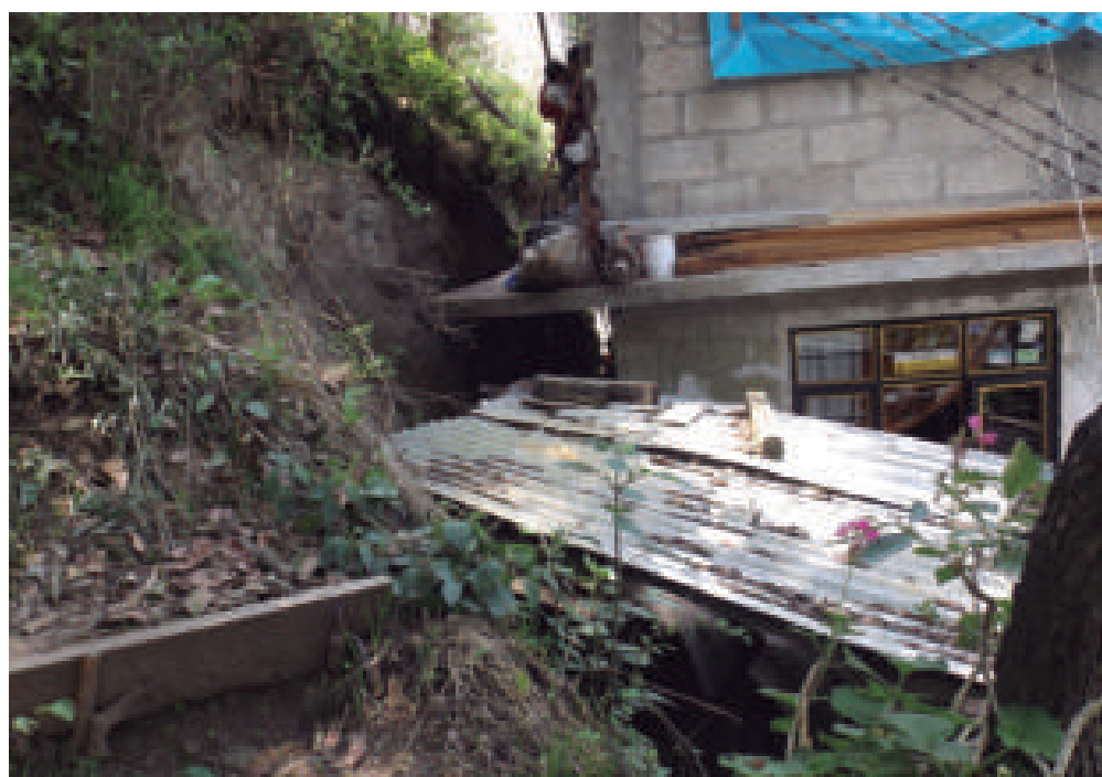
Figura 5.68. Fotografía C del polígono de peligro Ahuatenco. Talud vertical que presenta una cicatriz de derrumbe; bajo el mismo se observa una construcción hecha con materiales precarios como láminas y madera (19.3689° N, 99.3050° W. Calle: sin nombre oficial).
