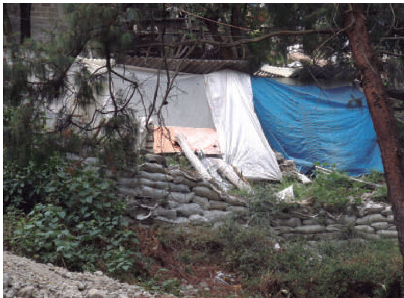
Figura 5.61. Fotografía A de la imagen 7 de vulnerabilidad del polígono Santa Rosa. Construcción precaria desplantada sobre un talud cuya pendiente es de 60° cercado por un muro de contención elaborado con costales rellenos apilados (19.3237° N, 99.2985° W. Calle: sin nombre oficial).
