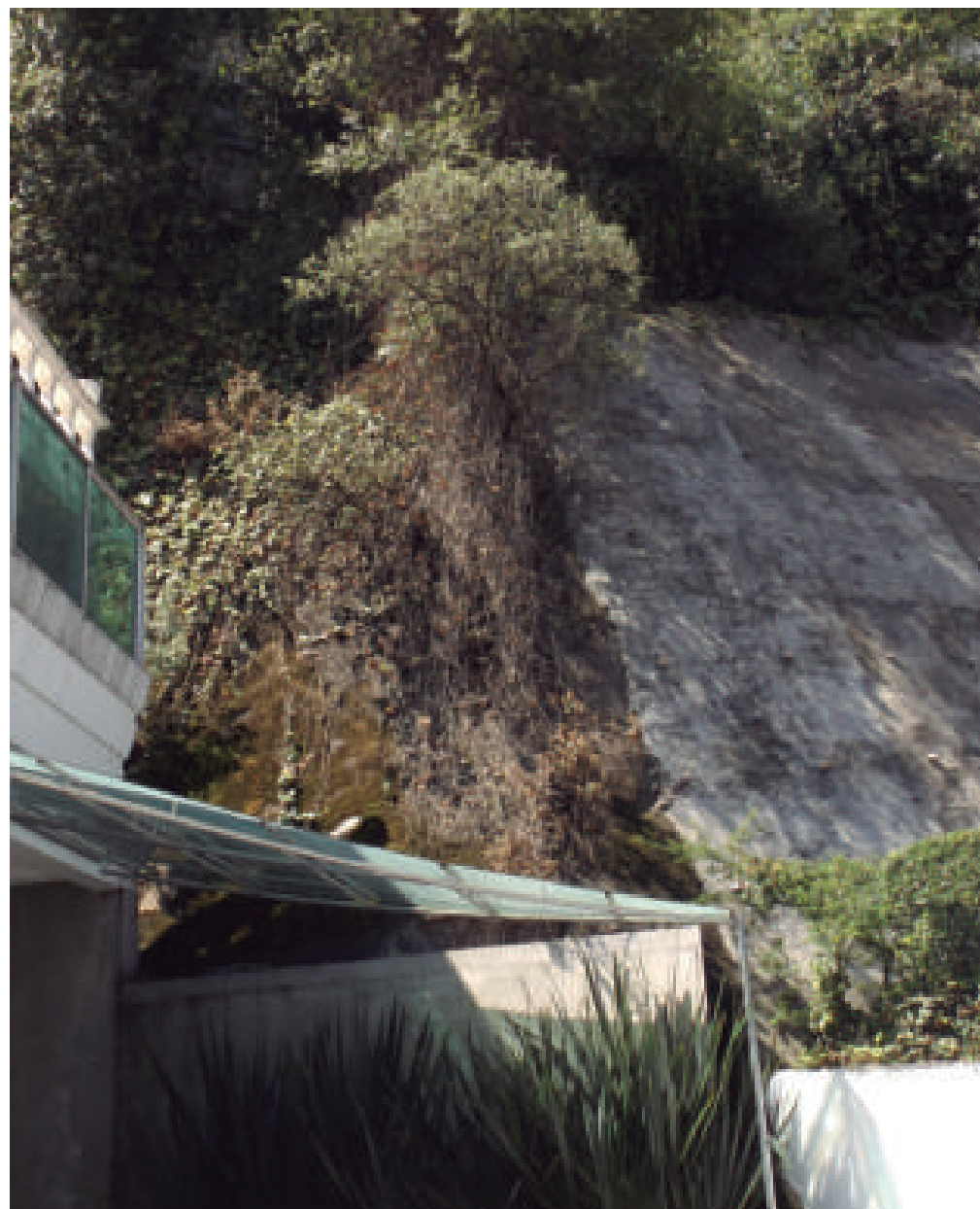
Figura 5.34. Fotografía B de la imagen 4 de vulnerabilidad del polígono Pegaso. Talud cubierto parcialmente con concreto lanzado, donde se ha desarrollado vegetación. Por debajo del talud se encuentra una vivienda, lo que la hace vulnerable ante el peligro de derrumbe de materiales (19.4000° N, 99.2581° W. Calle: Fuente de Pegaso).
