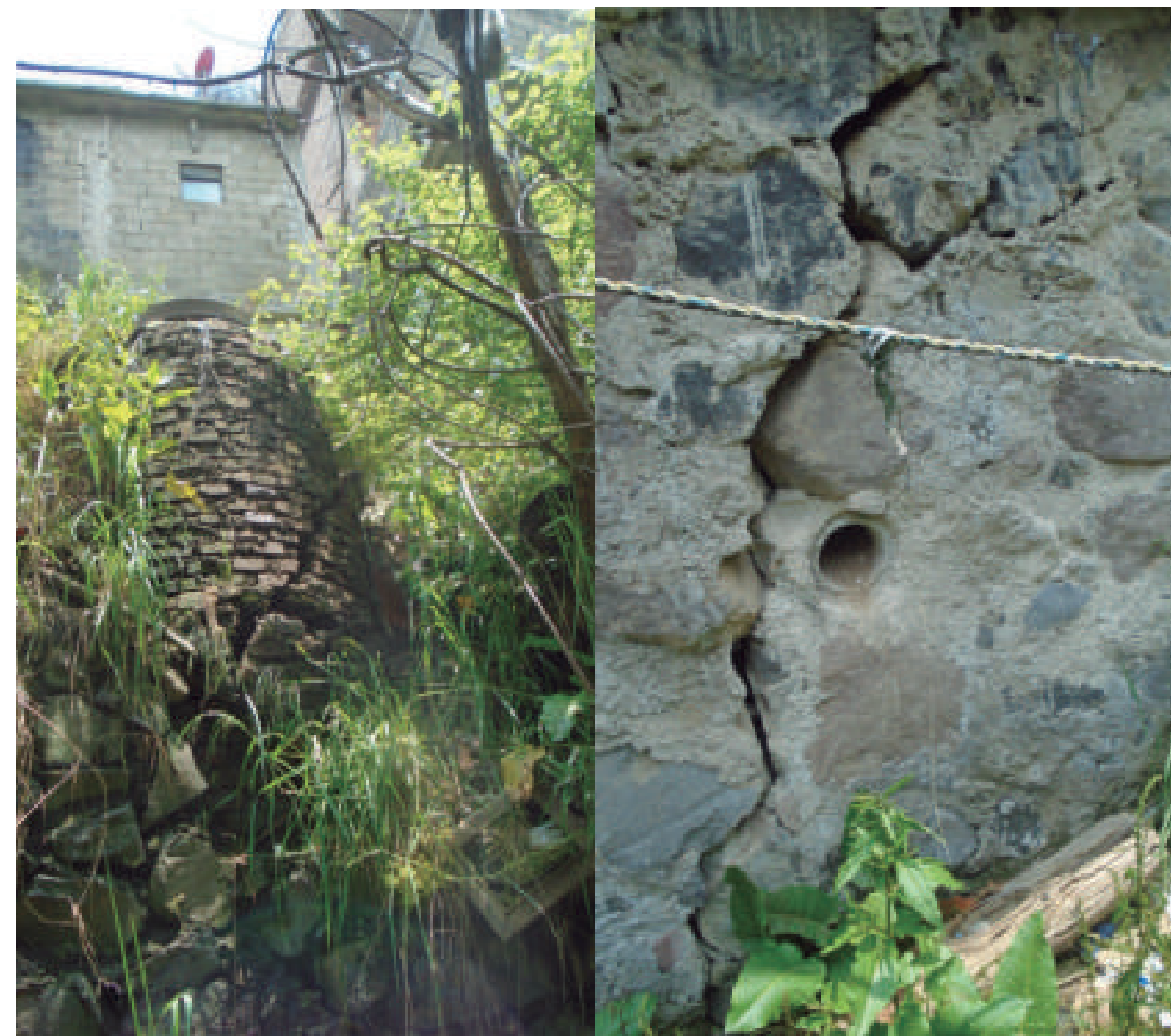
Figura 5.131. Fotografía B de la imagen 15 de vulnerabilidad del polígono Las Lajas. Estructura de drenaje fracturada a causa de la remoción del material en la ladera; la vivienda que se observa en la fotografía de la izquierda también se encuentra afectada por dicho fenómeno (19.3123° N, 99.3337° W. Calle: sin nombre oficial).
