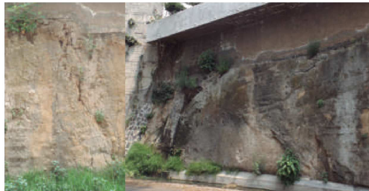
Figura 5.43. Fotografía C de la imagen 5 de vulnerabilidad del polígono Tejocotes. Corte vertical en la ladera compuesto por depósitos volcánicos no consolidados expuestos que muestran un alto grado de erosión; en la fotografía de la izquierda se pueden observar las grietas que indican el desgaste del material (19.3902° N, 99.2568° W. Calle: Bosque de Ocotes).
