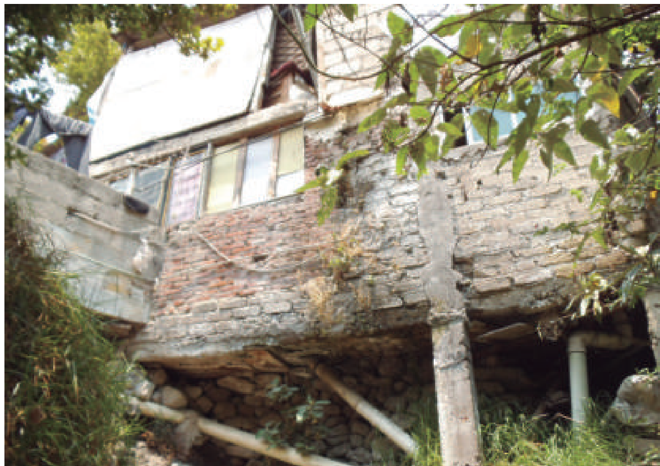
Figura 5.148. Fotografía B de la imagen 17 de vulnerabilidad del polígono Vista Hermosa.
