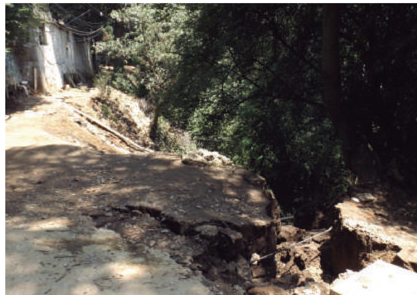
Figura 5.137. Fotografía C del polígono de peligro La Monera.
