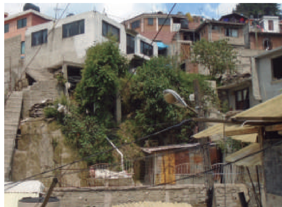
Figura 5.113. Fotografía A de la imagen 13 de vulnerabilidad del polígono Cruz Blanca. Donde se observa un conjunto de viviendas desplantadas sobre un talud que presenta remoción de sus materiales; la vivienda que se aprecia al centro de la fotografía es sostenida por columnas delgadas de cemento (19.3231° N, 99.3234° W. Calle: sin nombre oficial).
