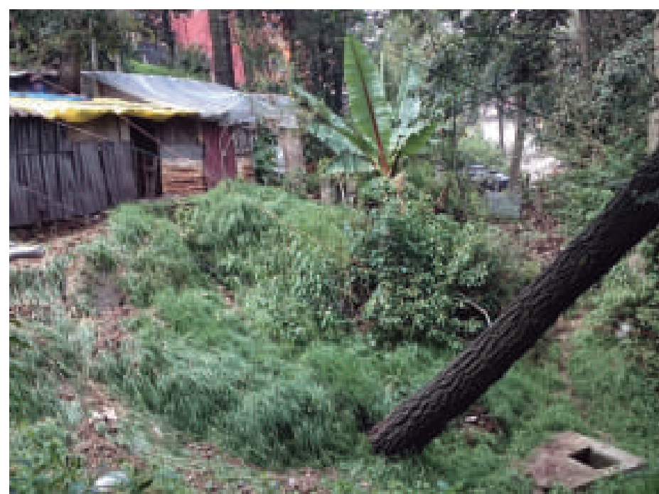
Figura 5.98. Fotografía A de la imagen 11 de vulnerabilidad del polígono Acopilco. Construcción precaria desplantada en la cima de un talud inestable, el cual presenta abundante cubierta vegetal; el árbol a la derecha de la fotografía tiene una inclinación marcada con dirección a la pendiente debido a la remoción del material (19.3377° N, 99.3240° W. Calle: Antiguo camino a Cuajimalpa).
