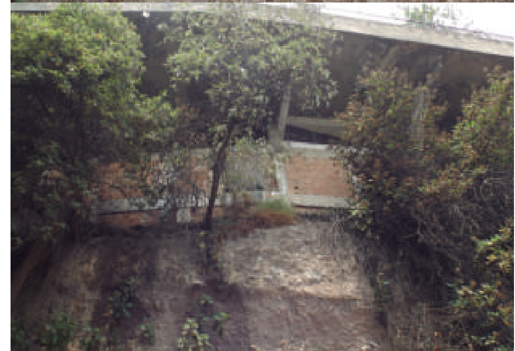
Figura 5.39. Fotografía D del polígono de peligro Tejocotes. Talud compuesto por depósitos volcánicos de bloques y cenizas, sobre el que se encuentra desplantada una construcción. La inclinación del árbol que se observa en la fotografía de abajo es una evidencia de la inestabilidad del terreno y la existencia de procesos de remoción en masa, causados por la erosión del material en las partes bajas; arriba se observa la composición del talud, que consiste en depósitos de flujos volcánicos (19.3924° N, 99.2531° W. Calle: Bosque de Icacos).
